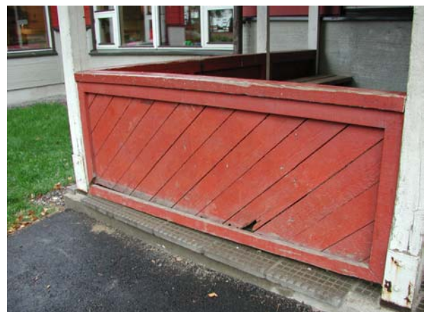
Kuva 6. Sisäänkäyntien puukaiteet ovat heikkokuntoiset.
