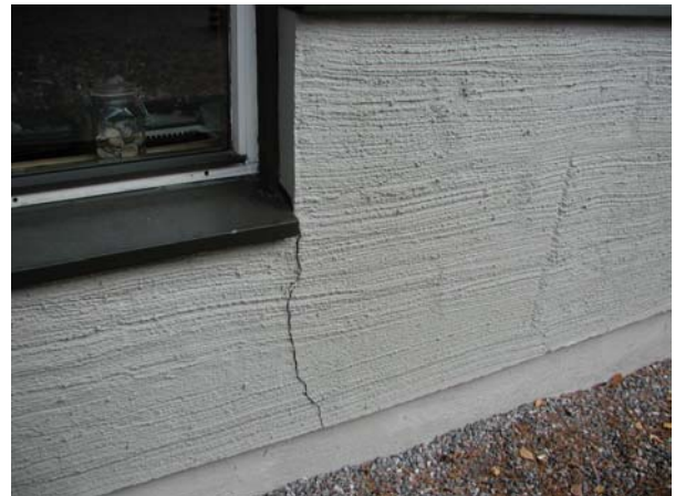
Kuva 5. Seinän alaosa, jossa on paikoin halkeamia.
