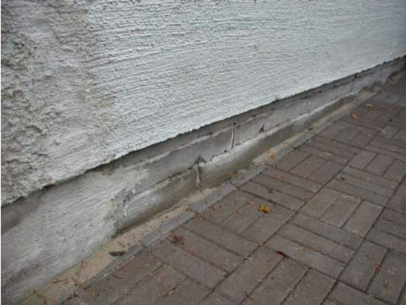
Kuva 7. Sokkelin rappaus on paikoin irronnut.
