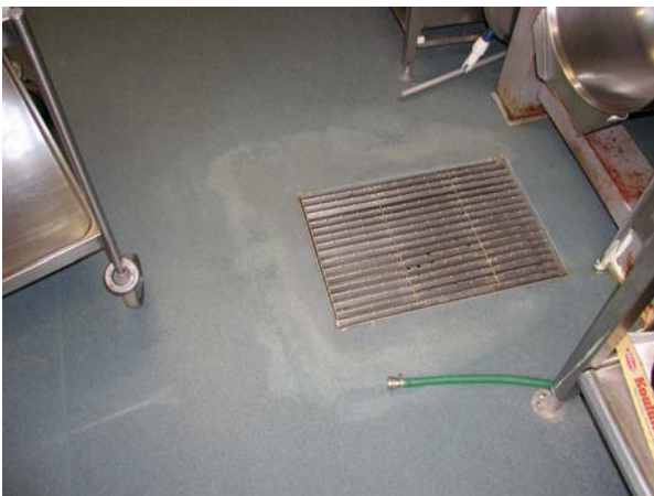
Kuva 3. Kosteusjälkiä keittiön lattialla.
