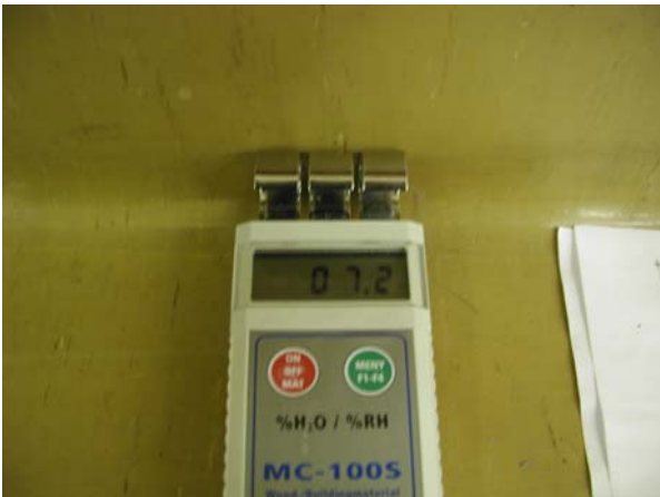
Kuva 2. Käytävän seinän alaosa, jossa on pintakosteusarvot, jotka ovat hieman kohonneet.
