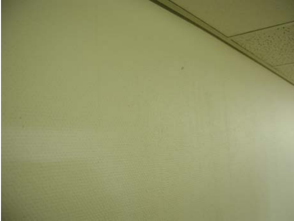
Kuva 1. Valumajälki käytävän seinässä.
