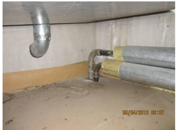
Kuva 18 IV-kojeen alla on selvä vuotoreitti keittiön kulmalla.
