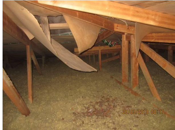
Kuva 10 Revennyt aluskate ulkojiirin vieressä. Aluskatteen päältä on varissut lehtijätettä.
