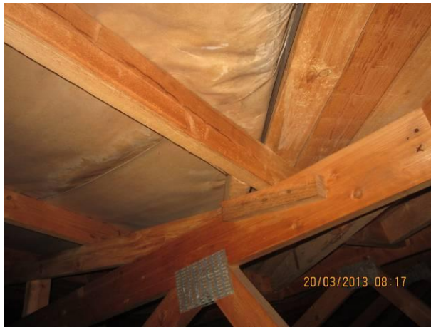
Kuva 11 Sisäjiirin alla vuotojälkiä
