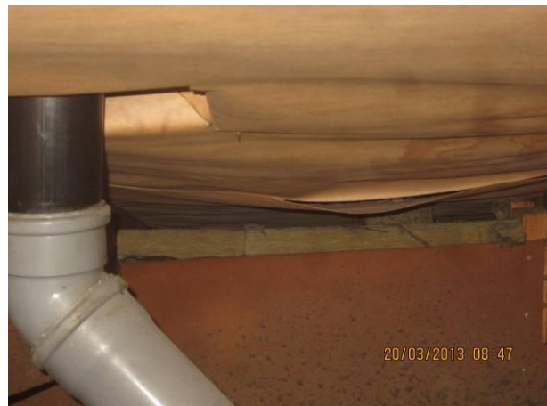
Kuva 14 Tukematon tuuletusviemäri, jonka läpivienti ei ole tiivis, lommahtanut aluskate. Viiston yläpohjan tuuletusväli tuulettuu ontelotilaan.
