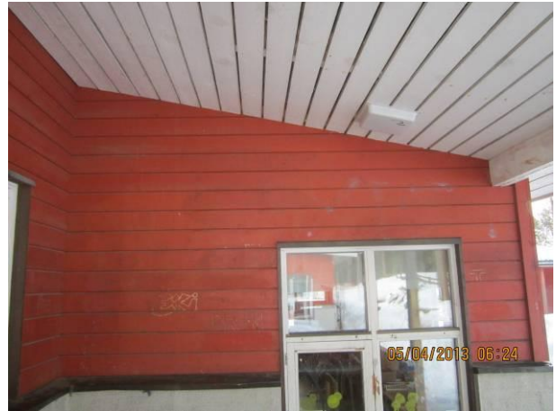
Kuva 16 Sisäänkäynnin vierellä on huoneen 31 vuotopaikka.
