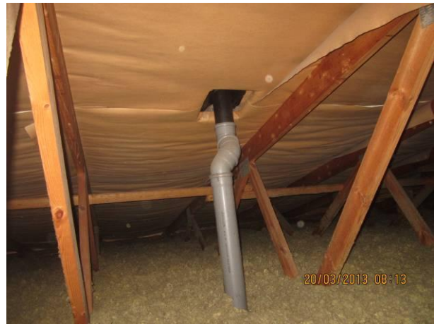
Kuva 12 Eristämätön tuuletusviemäri, jota ei ole tuettu.
