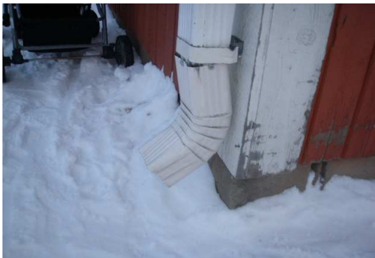
12. Ulkonurkan vääntynyt syöksytorven mutka.
