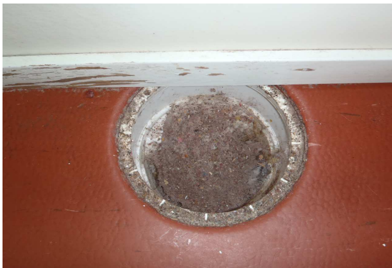
29. Yleiskuva keittiön lattiakaivosta, joka on kuiva.
