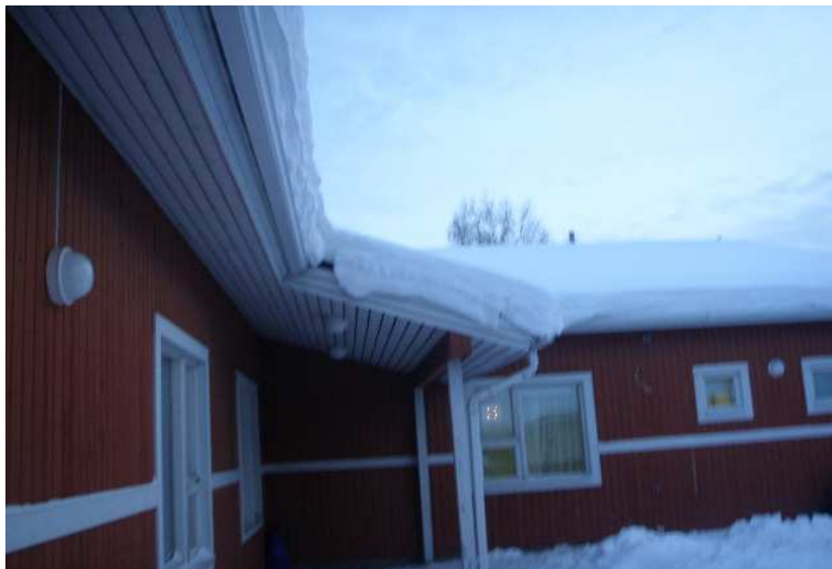
11. Lumi kasaantuu räystäälipan päälle rakennuksen sisäjiirissä. Lumen kerääntyessä kasvaa romahdusvaara.
