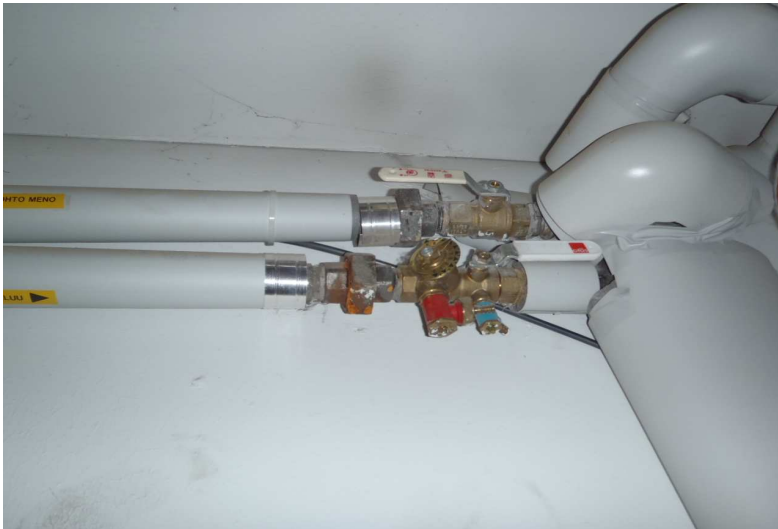
23. Yleiskuva lämpöjohtoverkoston venttiileistä.
