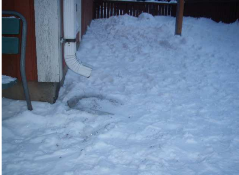
10. Rakennuksen reunoilta pinta- ja hulevesien poisjohtaminen tulee varmistaa keväällä.
