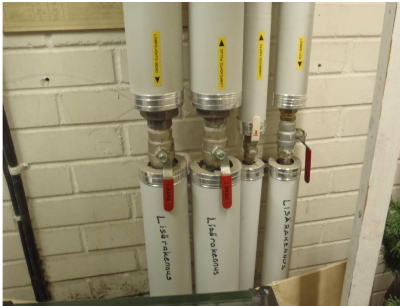
26. Yleiskuva käyttöveden sulkuventtiileistä.
