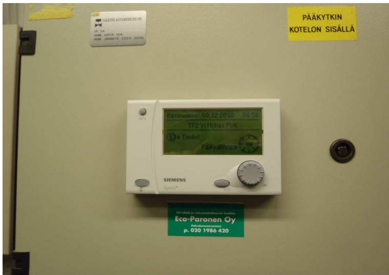
32. Yleiskuva tuloilmakoneen säätimestä.
