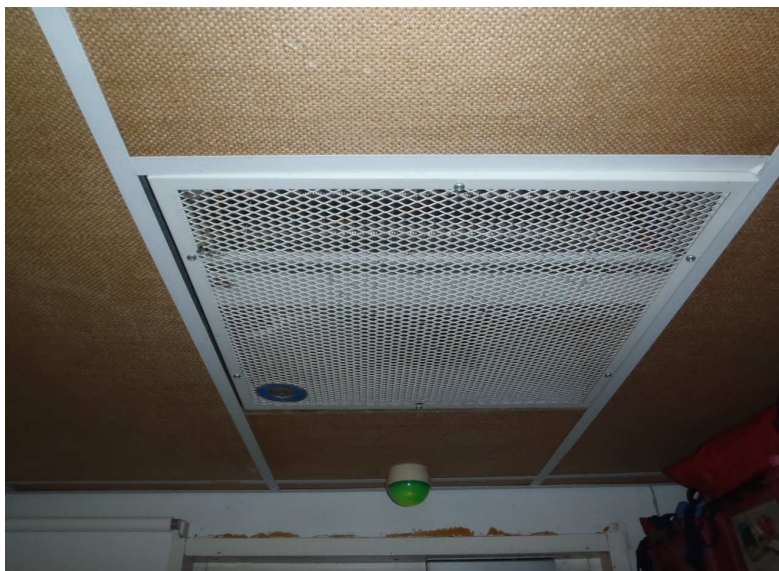
30. Yleiskuva tuulikaapin kiertoilmapiuhaltimesta.
