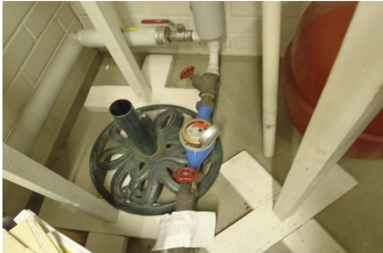
25. Yleiskuva vesimittarista ja pääsuluisista, jotka sijaitsevat Yrttitien päiväkodin lämmönjakohuoneessa.
