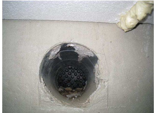
Kuva 14 Sokkelipalkin olevasta reiästä puuttuu putki/ tila 140, taustalla on sokkelilevy.
