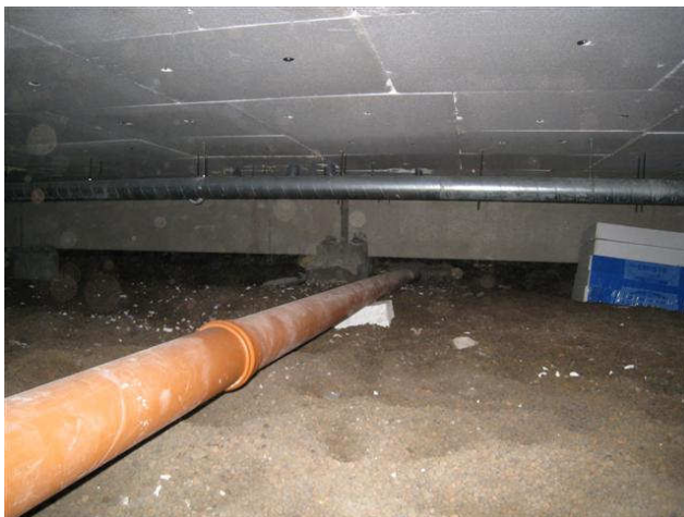
Kuva 21 Sisäpihan suunnasta tuleva viemäri, kallistusvika, oikealla styroxpaali/ tila 137 - 140 alustatilassa.
