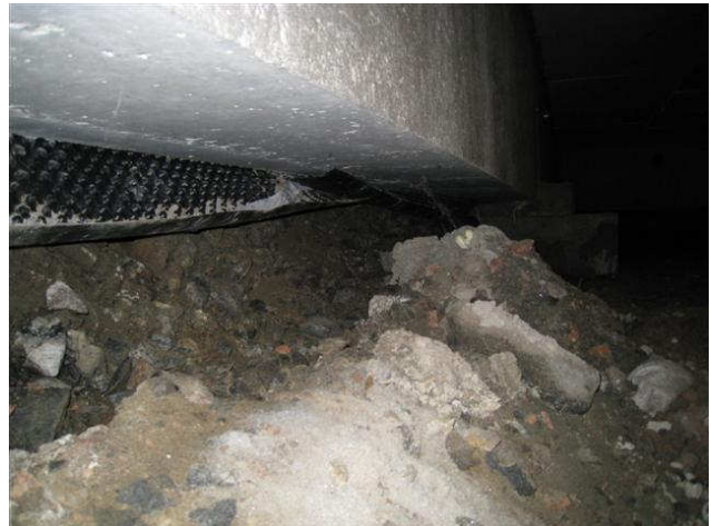
Kuva 4 Sokkelipalkin alla ei ole vastatäyttöä.
