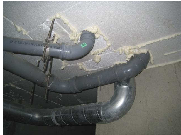
Kuva 16 Poistoilmakanava nousee alapohjan läpi tilan 134 kohdalla. Viemärikannakointien kierretangot ovat ylipitkiä.
