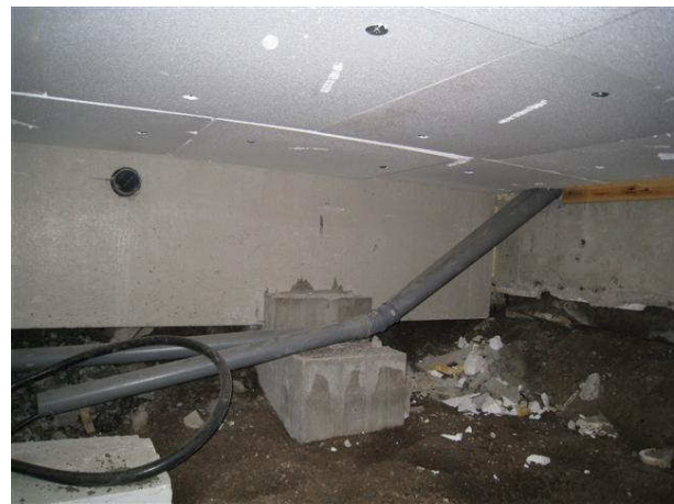
Kuva 20 Alkuperäisen ja laajennusosan väline alustatila tilojen 101 ja 107 alla. Hieman rakennusjätettä, kevytsora kostea.
