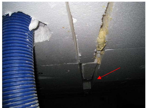
Kuva 18 Eristekaista puuttuu, uretaanisaumaukset vajaat, läpivienti tiivistämättä.
