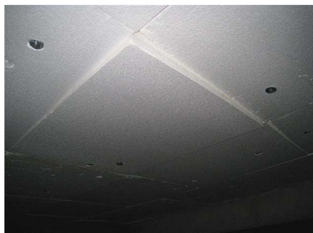
Kuva 24 Osittain irti alustastaan oleva eristelevy tilan 116 alla.
