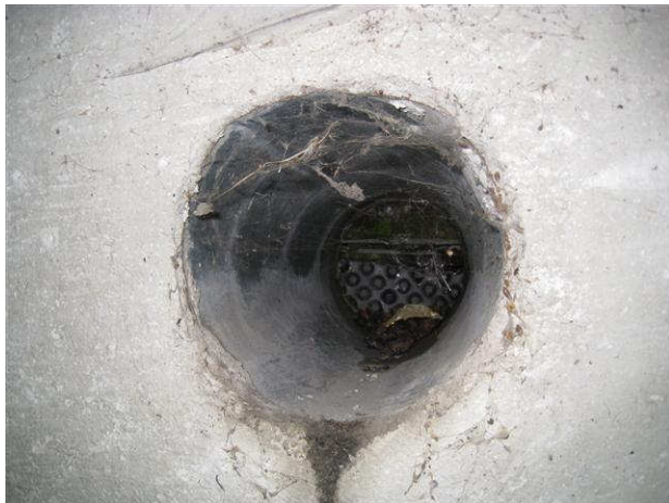
Kuva 13 Tilan 127 alla puuttuu korvausilma-putki maan rajalta, sisään pääsee vettä.
