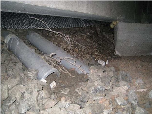
Kuva 7 Multamaata ja taimia on valunut sisäpihalta sokkelipalkin ali tila 109C kohdalla, lisäksi irtonaisia viemäriputkia.
