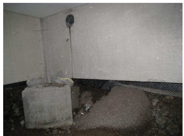
Kuva 6 Kivituhkavaluma sokkelipalkin ali tilan
