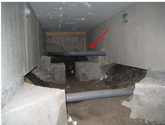
Kuva 11 Yleiskuva käytävän 133 alle, jossa on riittämätön viemärikannatus.
