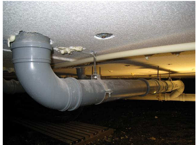
Kuva 10 Riittämättömältä vaikuttava kallistus viemärissä tilan 131 alla.
