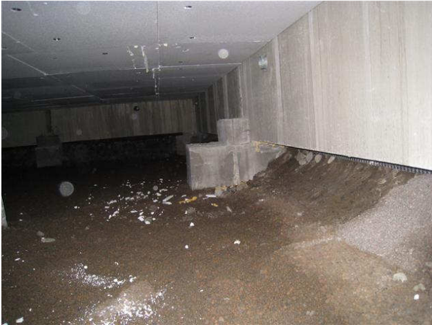
Kuva 25 Kosteaa kevytsoran pinta tilojen 118 – 120 alla. Oikealla on kivituhkaa valunut ulkopuolelta.
