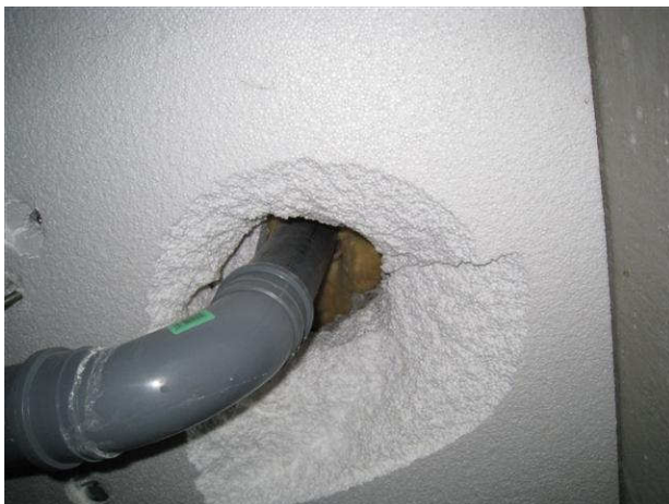
Kuva 17 Tiivistämätön viemäriläpivienti tilan 138-139 kohdalla
