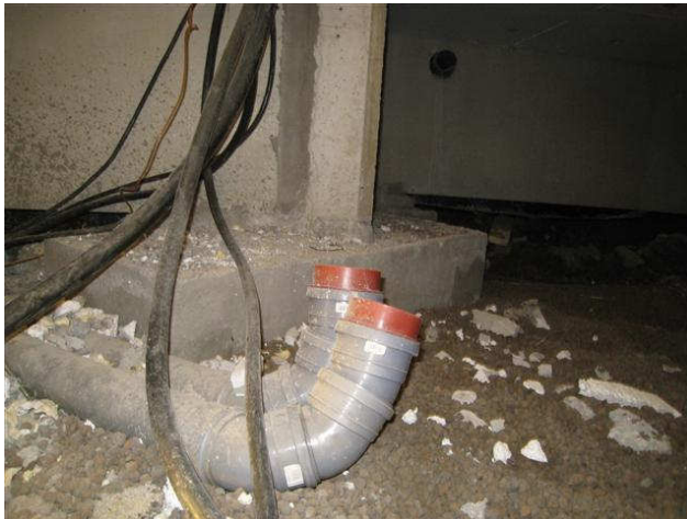
Kuva 9 Tuulikaapin 129 alla olevia viemäreitä, joiden päät on tulpattu.
