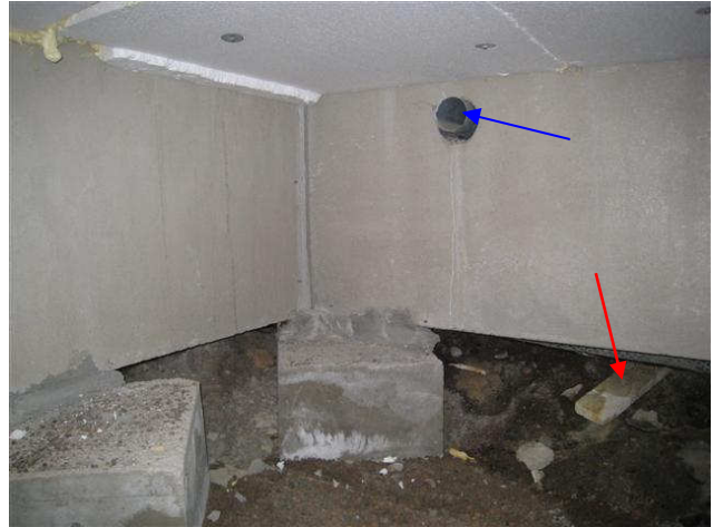
Kuva 8 Reunamilla on puujätettä., Sokkelipalkin läpi on toimiva korvausilmaputki.
