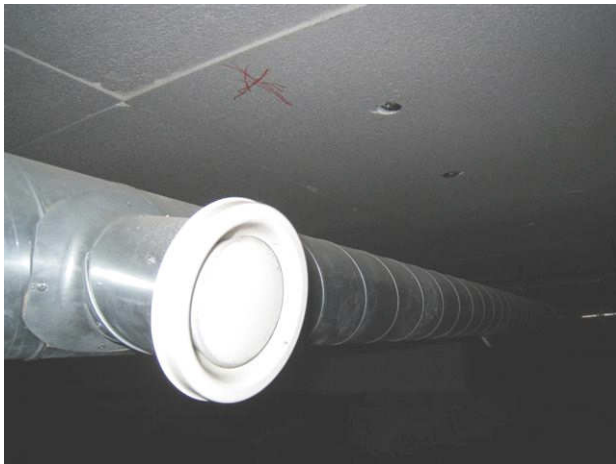
Kuva 15 Poistoilmakanava ja venttiili tilan 133 alla.
