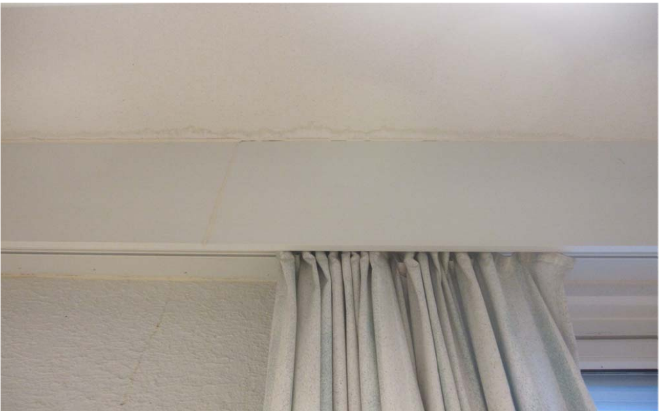
Kuva 2 Luokan 1076 katossa oleva vesivuoto jälki.
