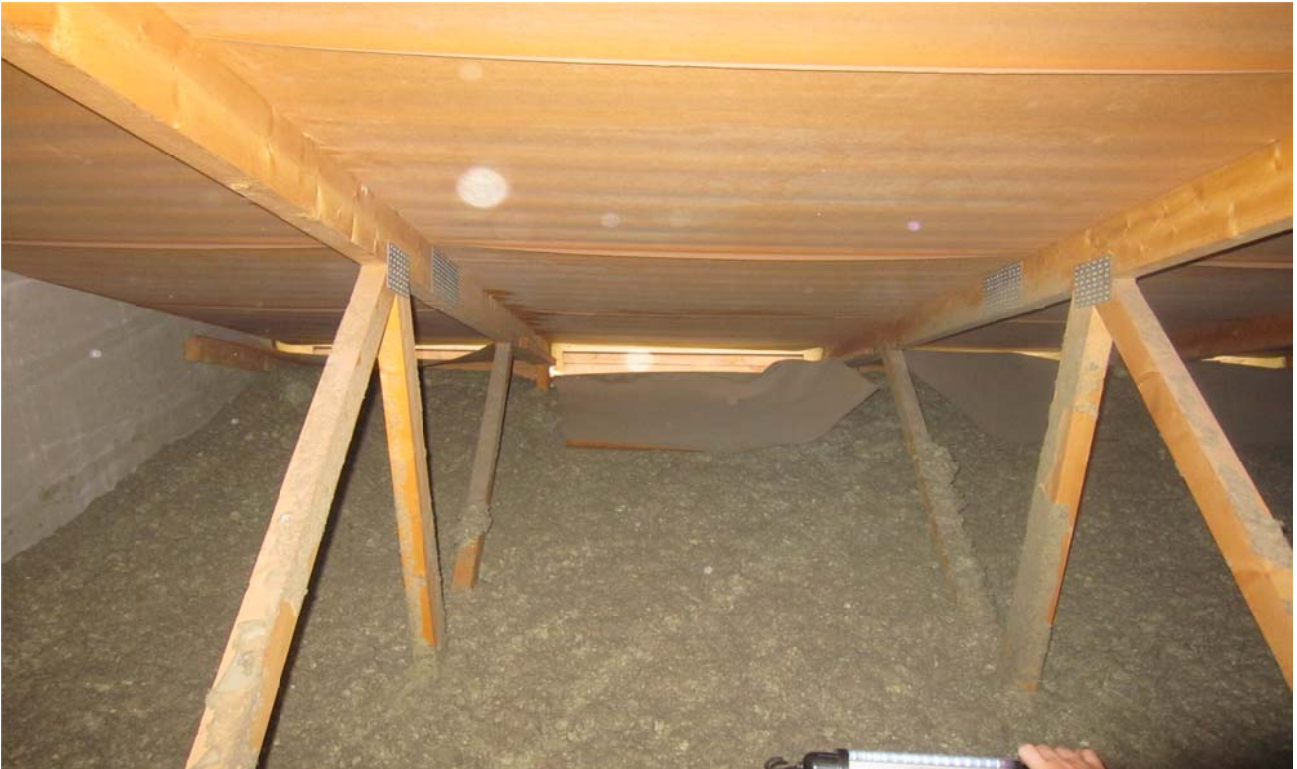
Kuva 5 Aluskate loppuu seinälinjalle, kuvassa myös irronnut tuulen ohjain.
