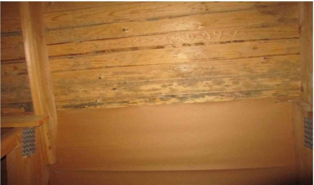
Kuva 6 Aluskate ei yllä harjalle saakka, tuuletusrako puuttuu aluskatteen ja pönttilaudoituksen välistä
