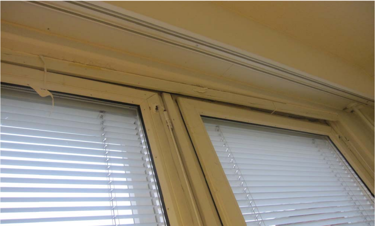
Kuva 1 Luokan 1076 ikkuna jonka yläpuolelta on vuotanut vettä.
