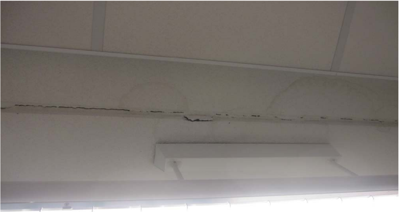
Kuva 3 Luokan 1076 katon ontelonsauma jossa on vuotoveden aiheuttama värimuutos.
