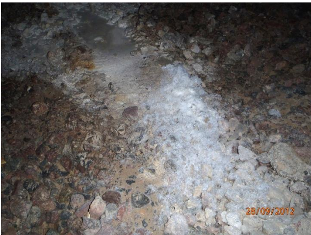
kuva 19 Pintamaassa on mikrobikasvustoa ja vaaleaa härmettä. (C4-D4)
