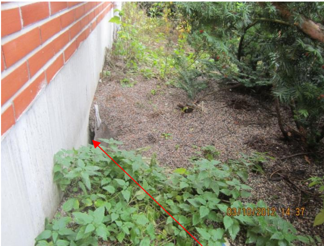
kuva 13 Sokkelivierellä on selvä kolo, josta sadevesi pääsee vapaasti valumaan muurin alle.
