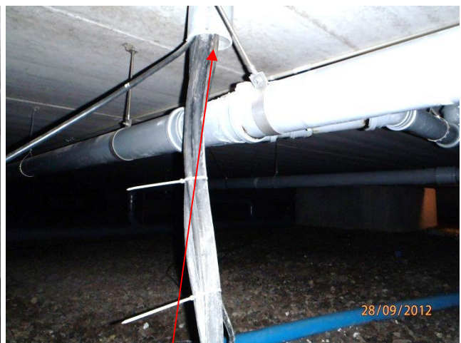
kuva 22 Sähköläpivientä ei ole tiivistetty. (C7-D8)
