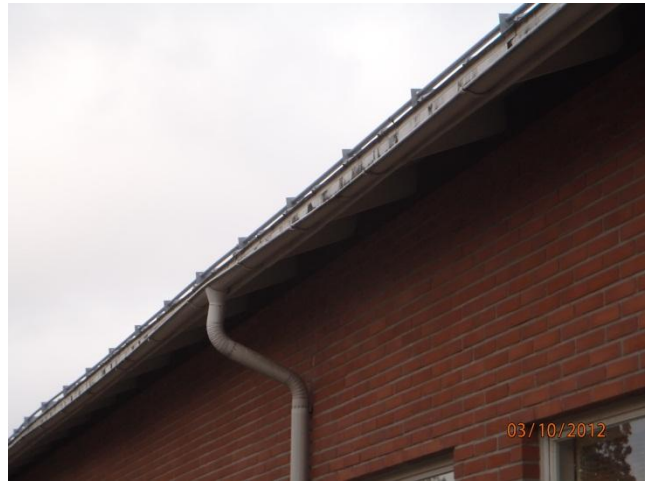
kuva 14 Rakennuksen räystäärännien reunat ovat vääntyneet ja roikkuvat pahasti useassa eri kohdassa.
