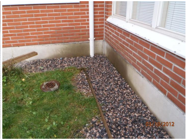
kuva 16 Repeytyneistä saumoista valuva vesi aiheuttaa kosteusrasitusta perusmuuriin. Syöksytorvet ovat yhdistetty maan alla sadevesikaivoihin.
