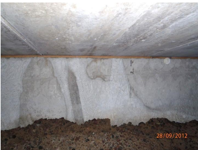
kuva 21 Pohjamaassa on selvästi kosteutta ja kosteus- ja vuotojälkiä näkyy myös perusmuurissa. Ontelolaatan ja perusmuurin välissä näkyy asennuksessa käytettyä raakalautaa.
