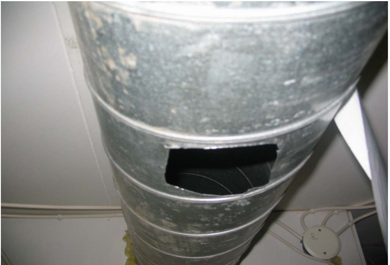
KUVA 10. Tuloilmakanavassa on reikä.
