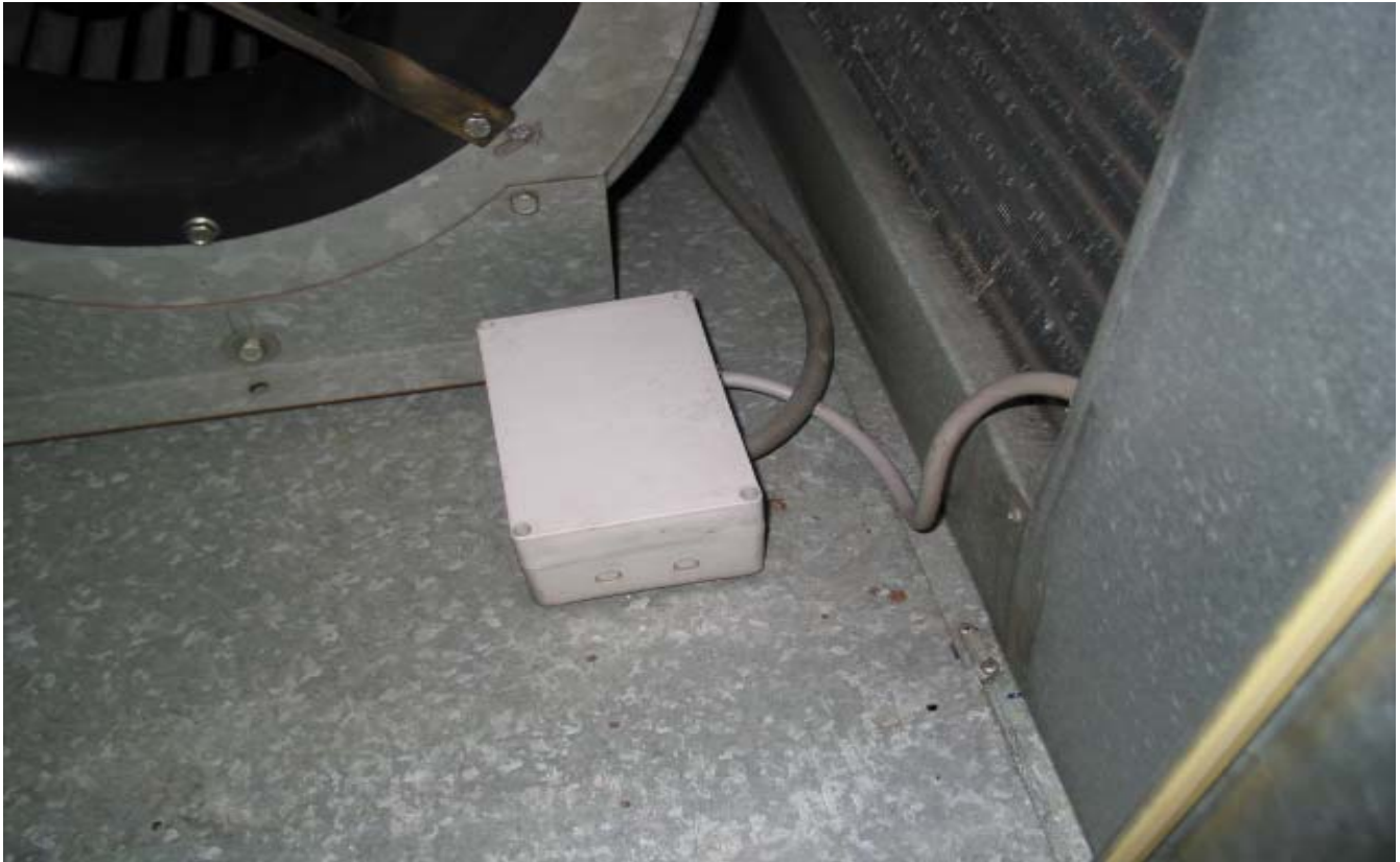
KUVA 15. Tuloilmakone on puhdas.
