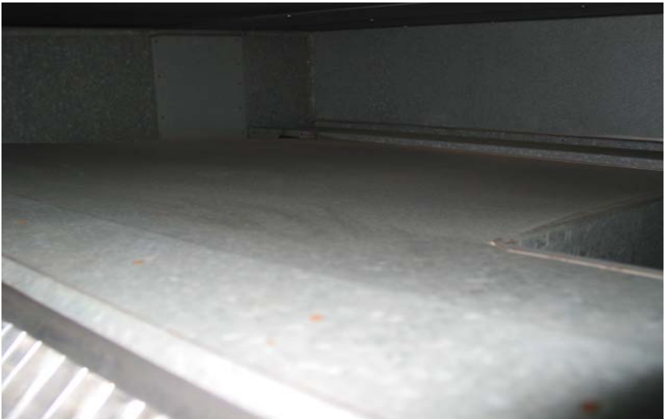
KUVA 16. Tuloilmakammio on puhdas.
