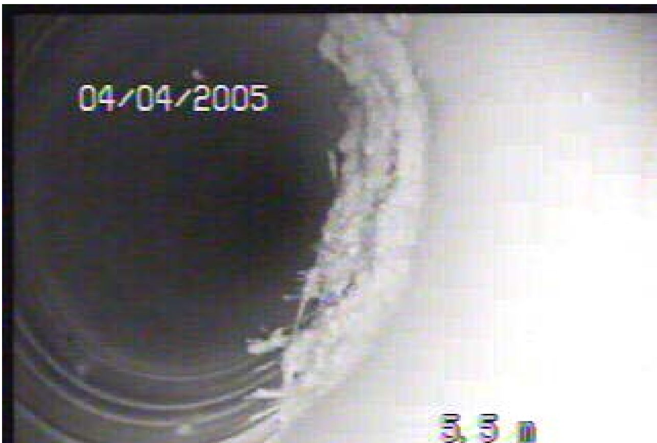
Kuva 6. Poistoilmakanavan pohjalla on pölykertymää.
