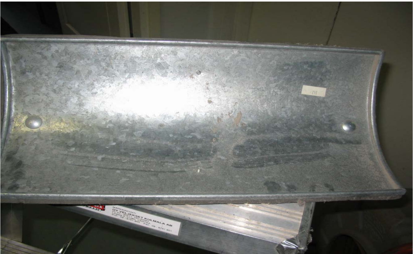
KUVA 12. Poistoilmakanavassa on pölykertymää.
