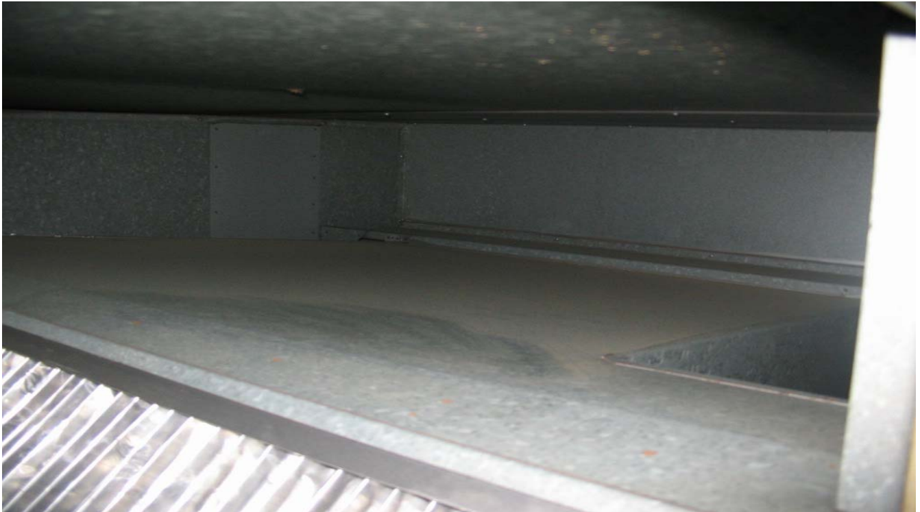
KUVA 9. Tuloilmakoneessa on hieman pölykertymää.
