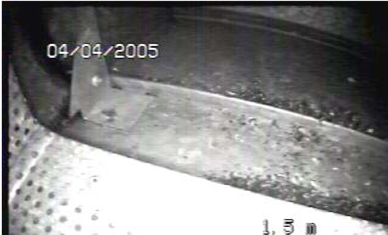
KUVA 1. Tuloilmakanavan pohjalla on melko paljon roskaa.
