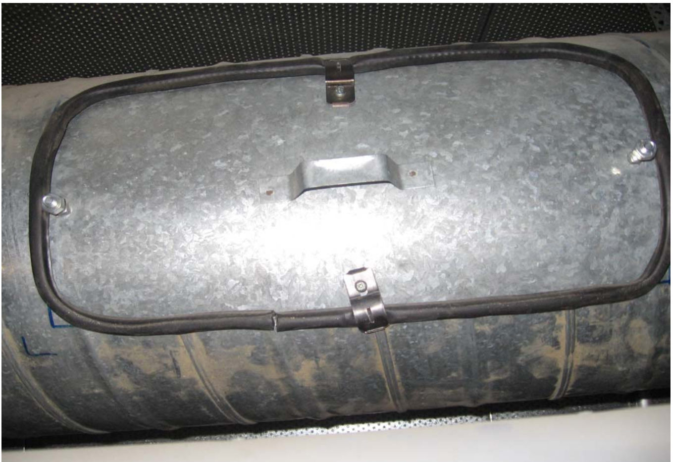
KUVA 20. Puhdistusluukun lukituspelti oli irti.
