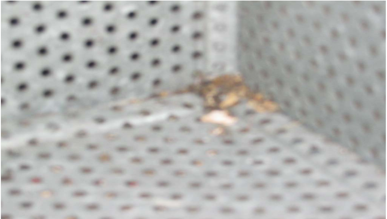
KUVA 7. Tuloilmakanavan pohjalla on hieman roskaa.
