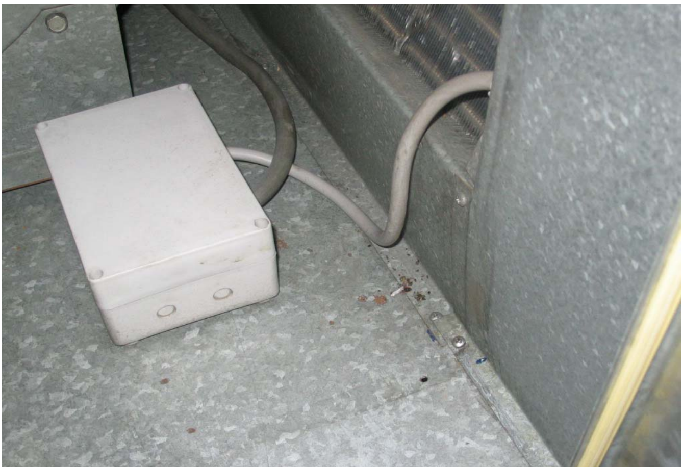
KUVA 8. Tuloilmakoneessa on hieman roskakertymää.
