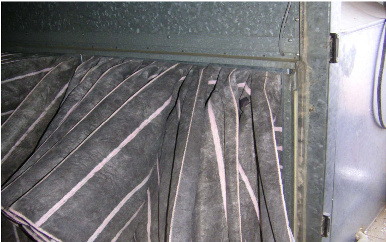
KUVA 2. Suodattimista tapahtuu ohivirtausta (= suodattamaton ilma pääsee huoneilmaan).
