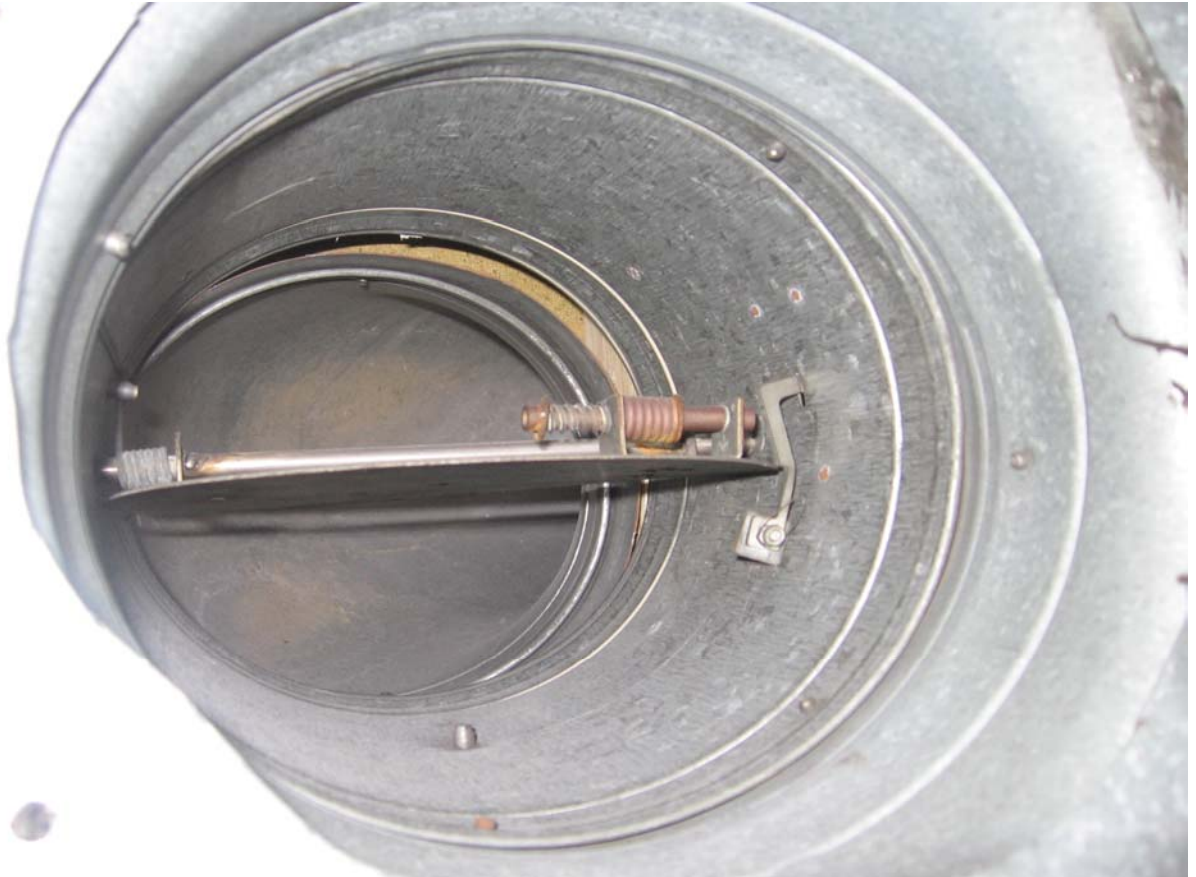
KUVA 21. Keittiön tuloilmakanava on irti ennen tasauslaatikkoa.
