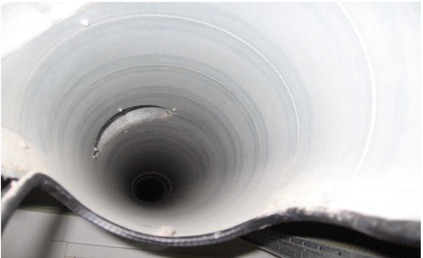
KUVA 24. B- osalla olevassa runkokanavassa on pölykertymää .
