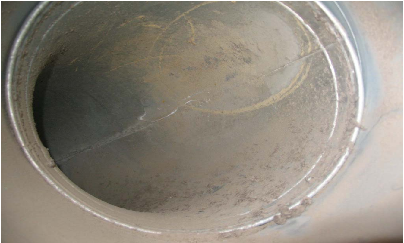
KUVA 13. Poistoilmakanavassa on melko paljon pölykertymää.
