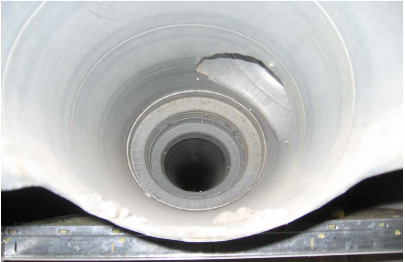
KUVA 23. B- osalla olevassa runkokanavassa on pölykertymää.
