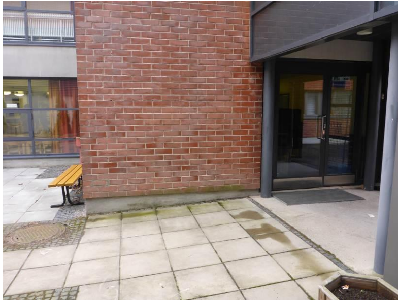
Kuva 12. Porrashuoneen 159 sokkelirakenteen ulkopinnassa ja pihalaatoituksessa seinän vierustalla on havaittavissa sammaloitumista.
