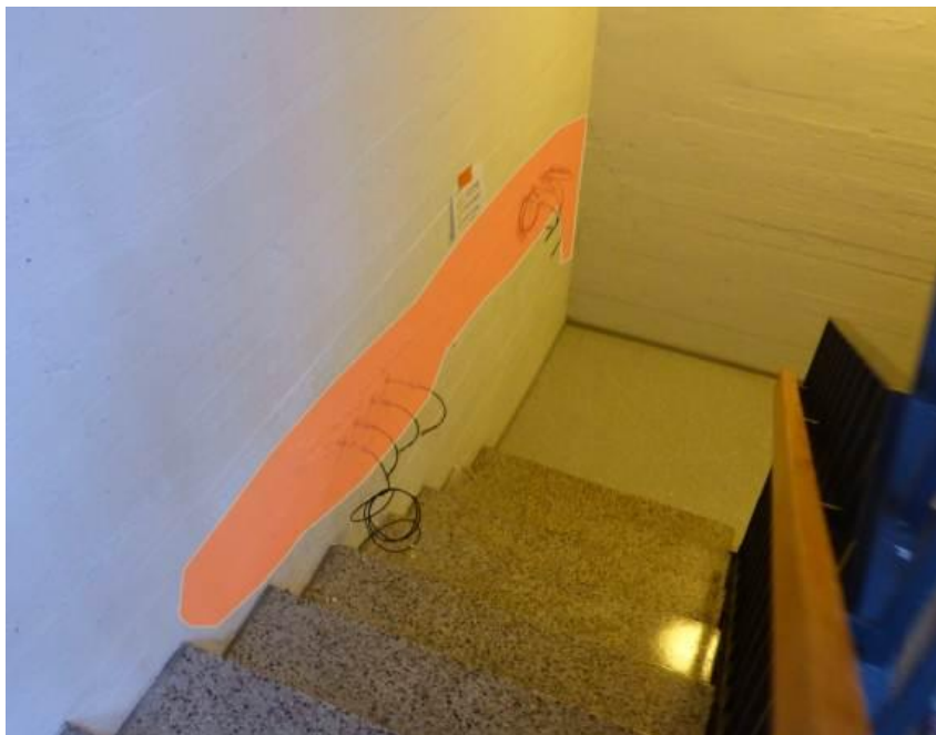
Kuva 14. Porrashuoneen 159 seinän pintakosteuslukemat olivat muuta aluetta korkeammat kuvassa ruskealla värillä esitetyillä alueella.
