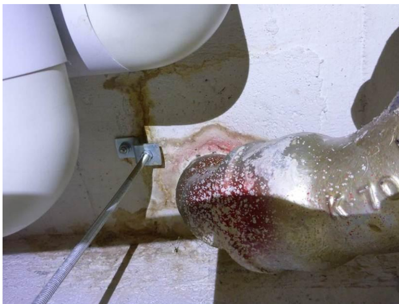
Kuva 4. Käytävän 016 katon viemäriputken läpivientikohdassa on havaittavissa kosteuden aiheuttamaa jälkeä.
