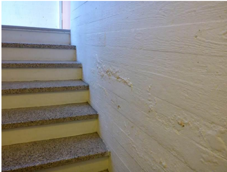
Kuva 3. Porrashuoneen 159 seinän maalipinnan kupruilut ovat välipohjarakenteen (VSS:n yläpohjarakenteen) tasolla.
