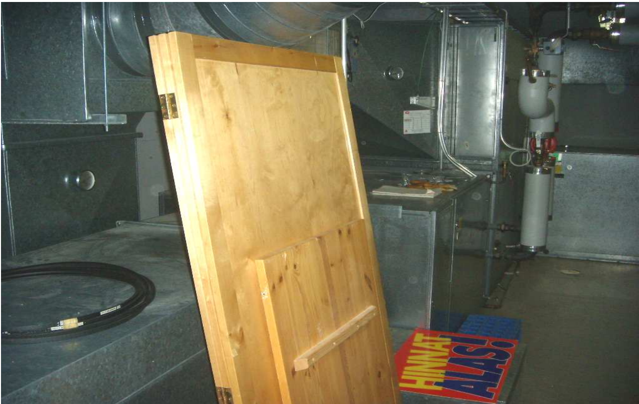
LVI- kuva 8. Yleiskuva IV- konehuoneesta.
