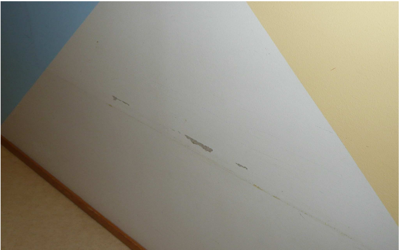
RAK- kuva 9. Päiväkodin seinissä esiintyy kulumia.
