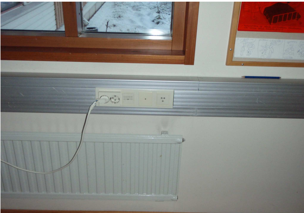
S- kuva 6. Toimistokouru.
