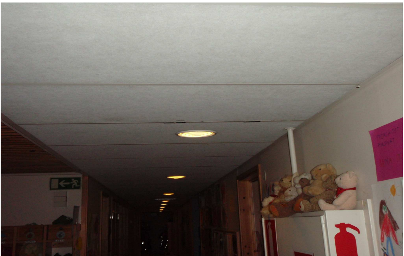
S-kuva 8. Käytävän valaistus.
