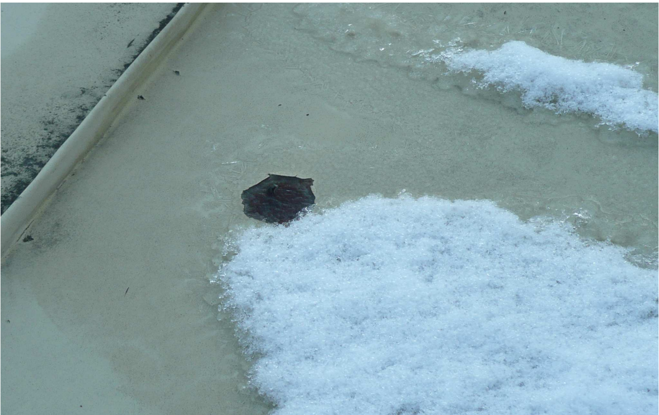
RAK- kuva 6. Vesikatolla todettiin melko runsaasti ruosteen aiheuttamia vaurioita.
