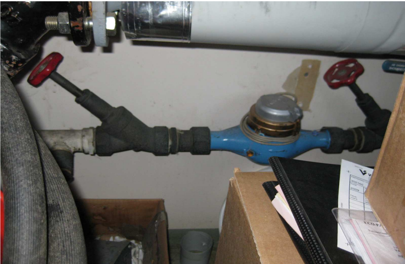
LVI- kuva 4. Yleiskuva vesimittarista ja pääsuluista.
