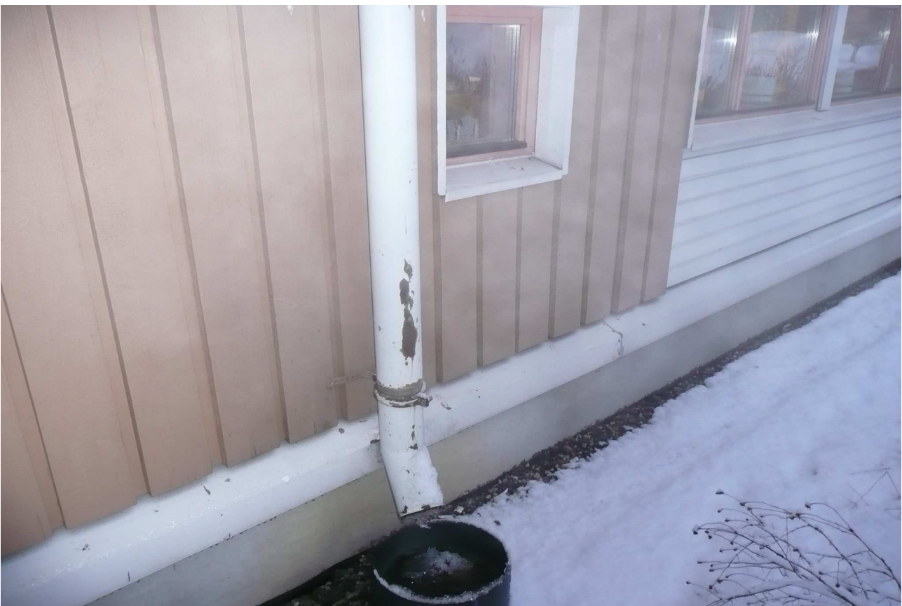
RAK- kuva 8. Syöksytorvien maalipinta hilseilee paikoitellen melko voimakkaasti.
