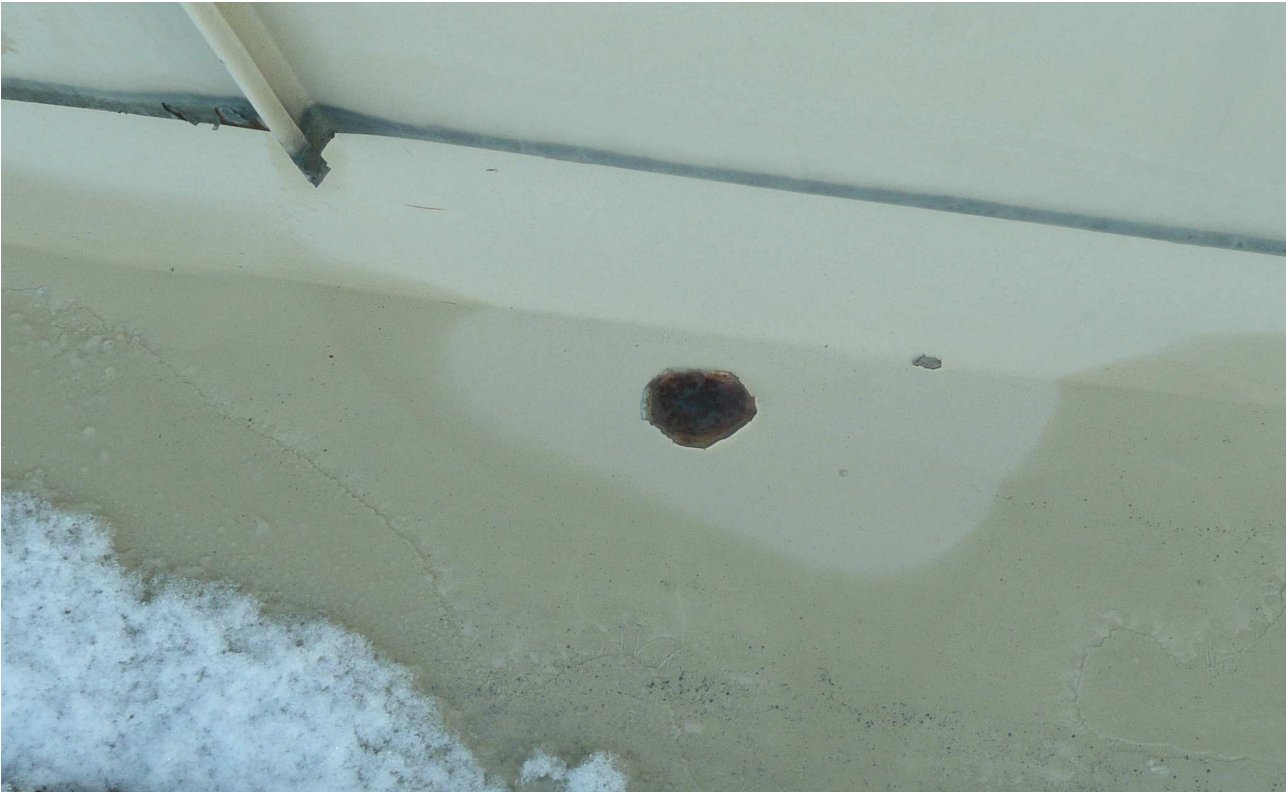
RAK- kuva 7. Vesikatolla todettiin melko runsaasti ruosteen aiheuttamia vaurioita.
