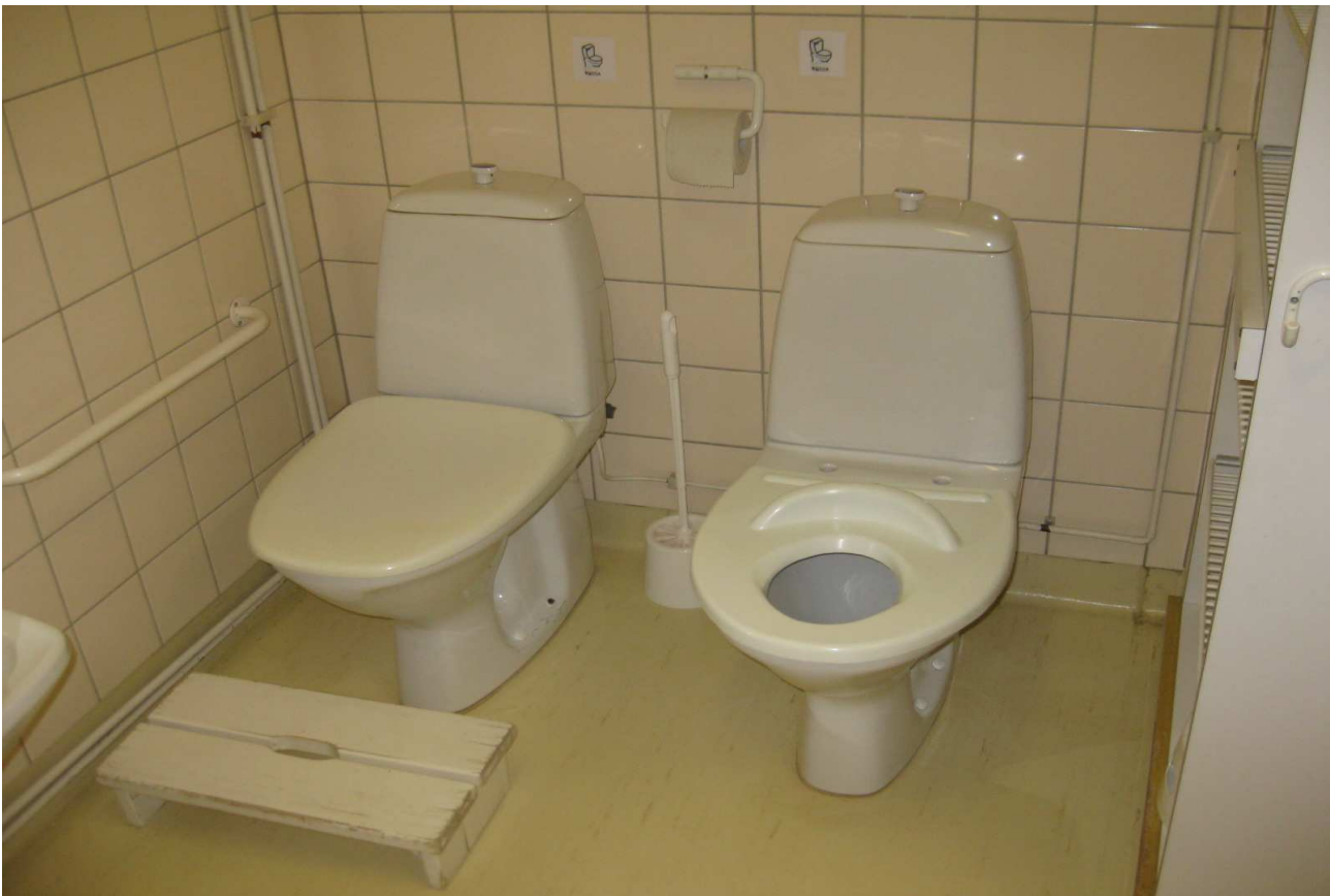
LVI- kuva 7. Yleiskuva vesikalusteista.
