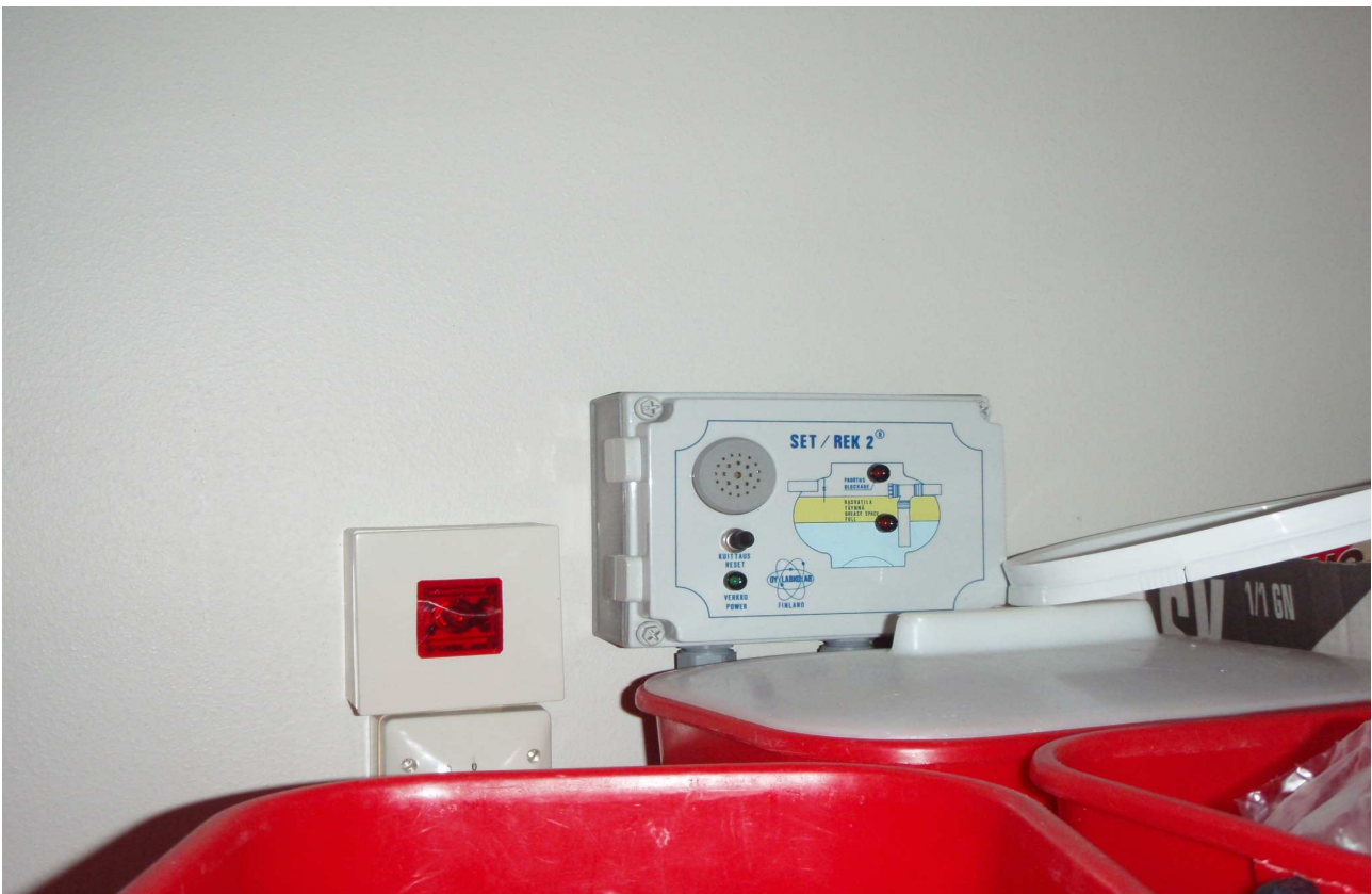
S- kuva 14. Rasvanerotuskaivon hälytyskeskus.
