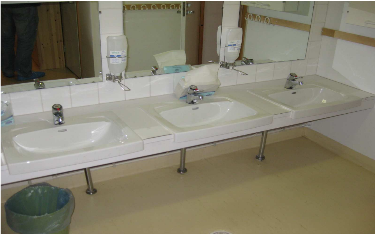
LVI- kuva 6. Yleiskuva vesikalusteista.
