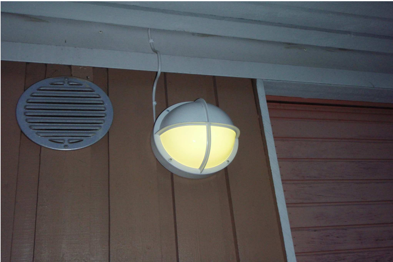
S-kuva 1. Sisäänkäynnin valaistus.
