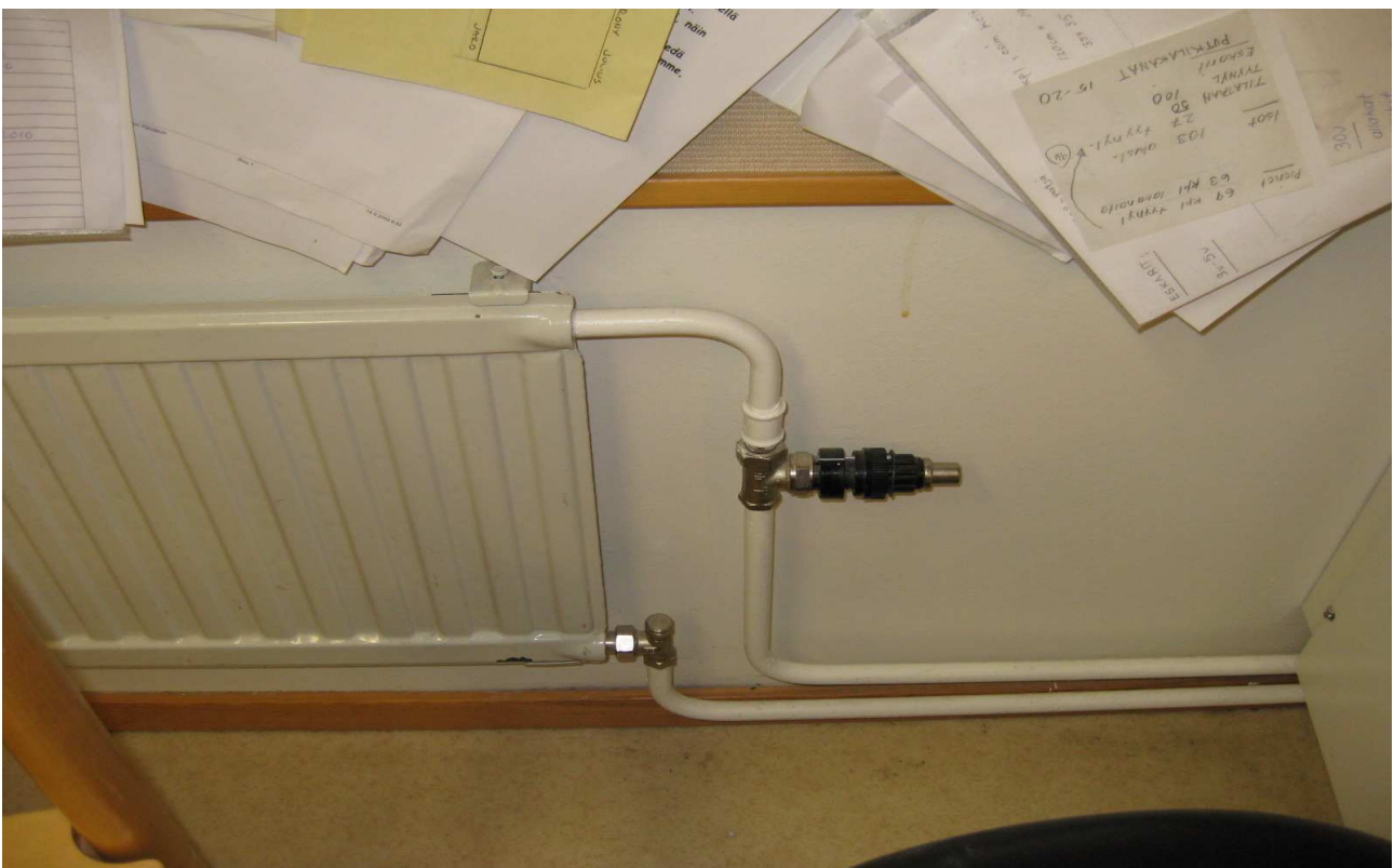
LVI- kuva 3. Yleiskuva patteriventtiilistä, jotka ovat osin rikki.
