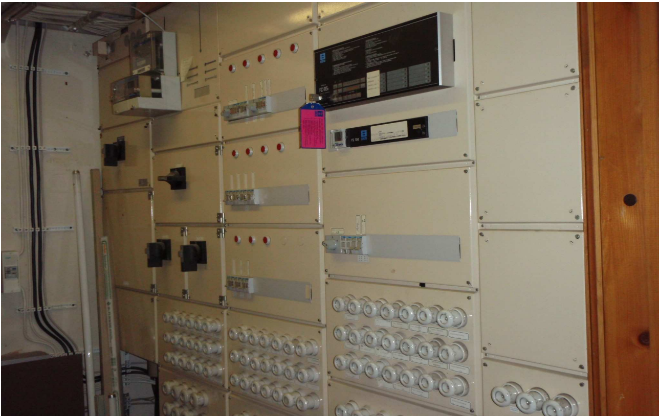
S- kuva 3. Sähköpääkeskus.
