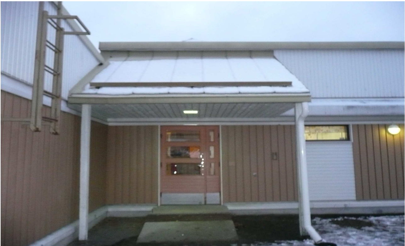
RAK- kuva 3. Alakaton maalipinnassa esiintyy pinnan väri vaihteluja ja pinnan kulumaa.
