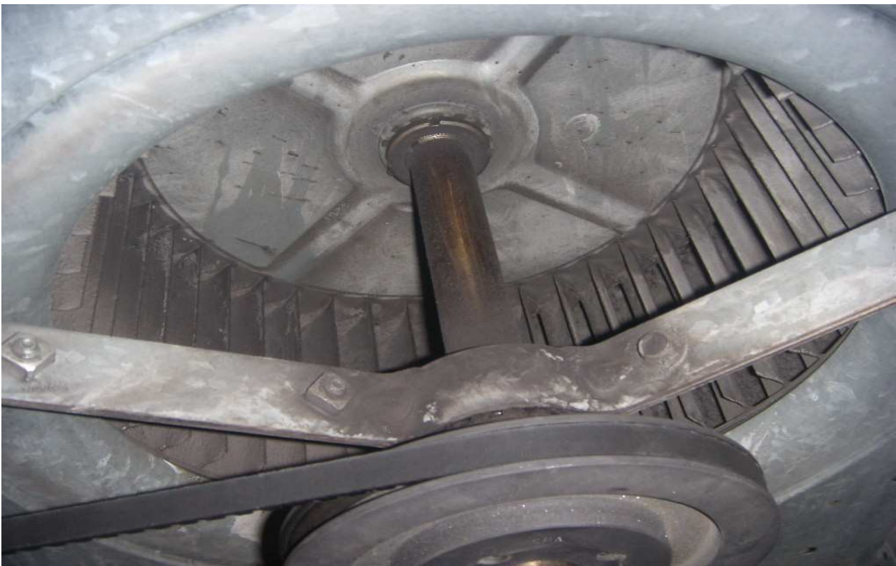
LVI- kuva 11. Yleiskuva poistoilmapuhaltimesta.
