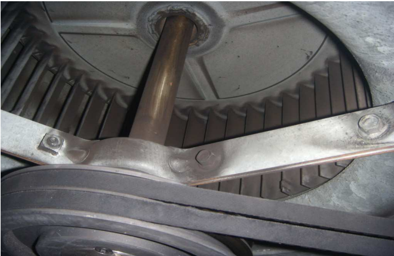
LVI- kuva 10. Yleiskuva tuloilmapuhaltimesta.
