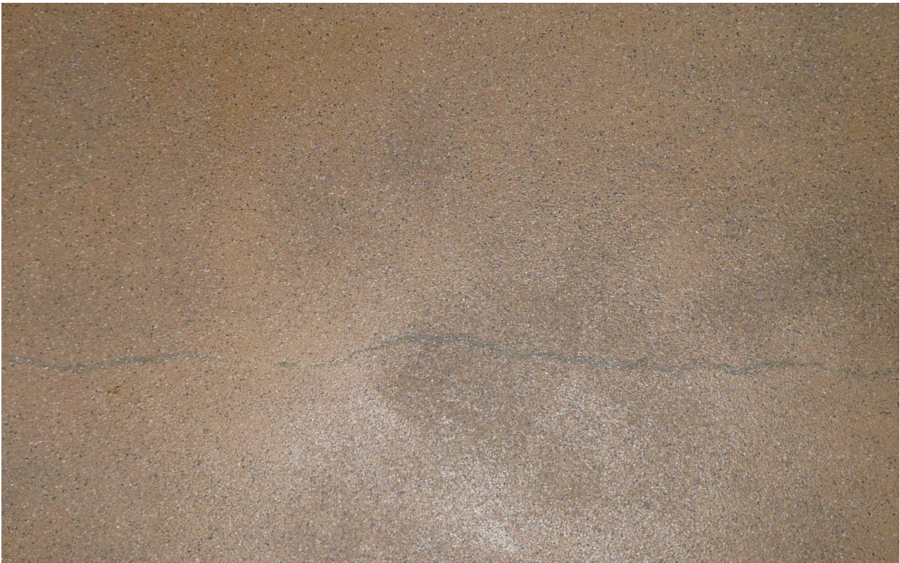
RAK- kuva 11. Keittiön lattiassa on halkeama.
