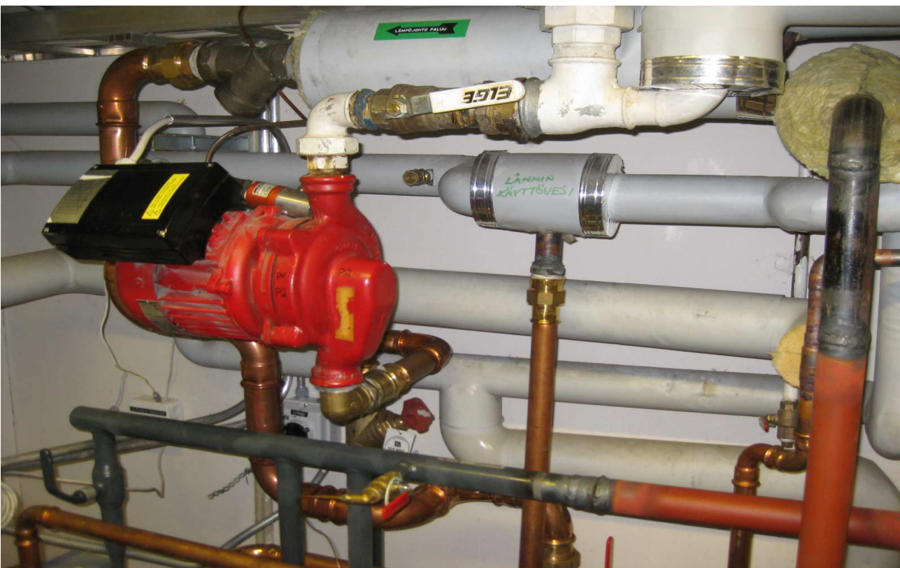
LVI- kuva 5. Yleiskuva käyttöveden sulkuventtiilistä.
