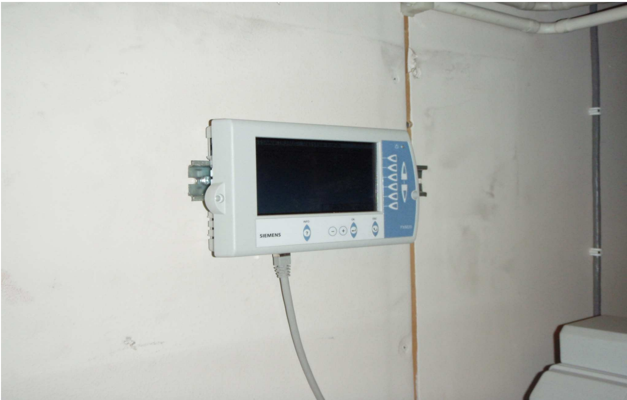
S- kuva15. Lämmönjaon yksikkösäädin.
