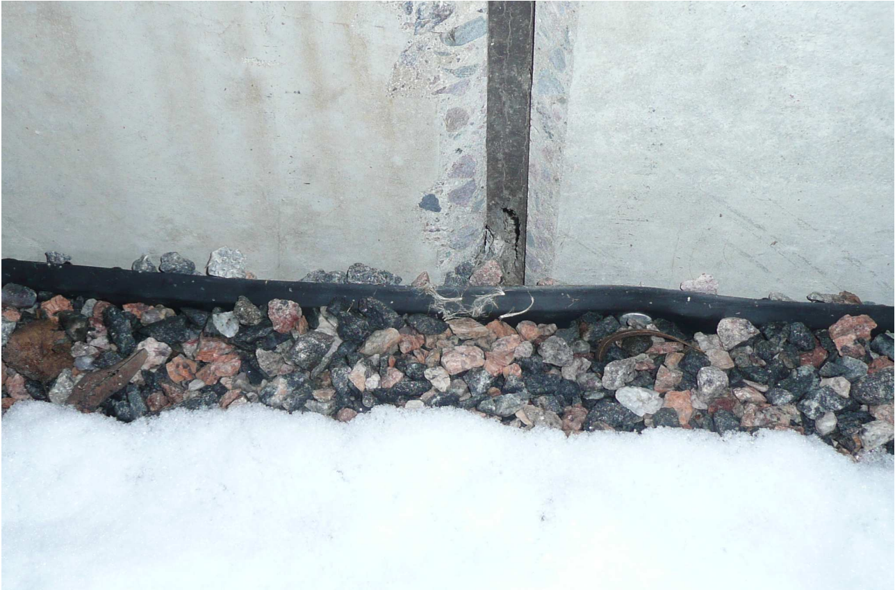
RAK- kuva 4. Sokkeleiden elastisissa saumauksissa on havaittavissa ratkenneita kohtia.
