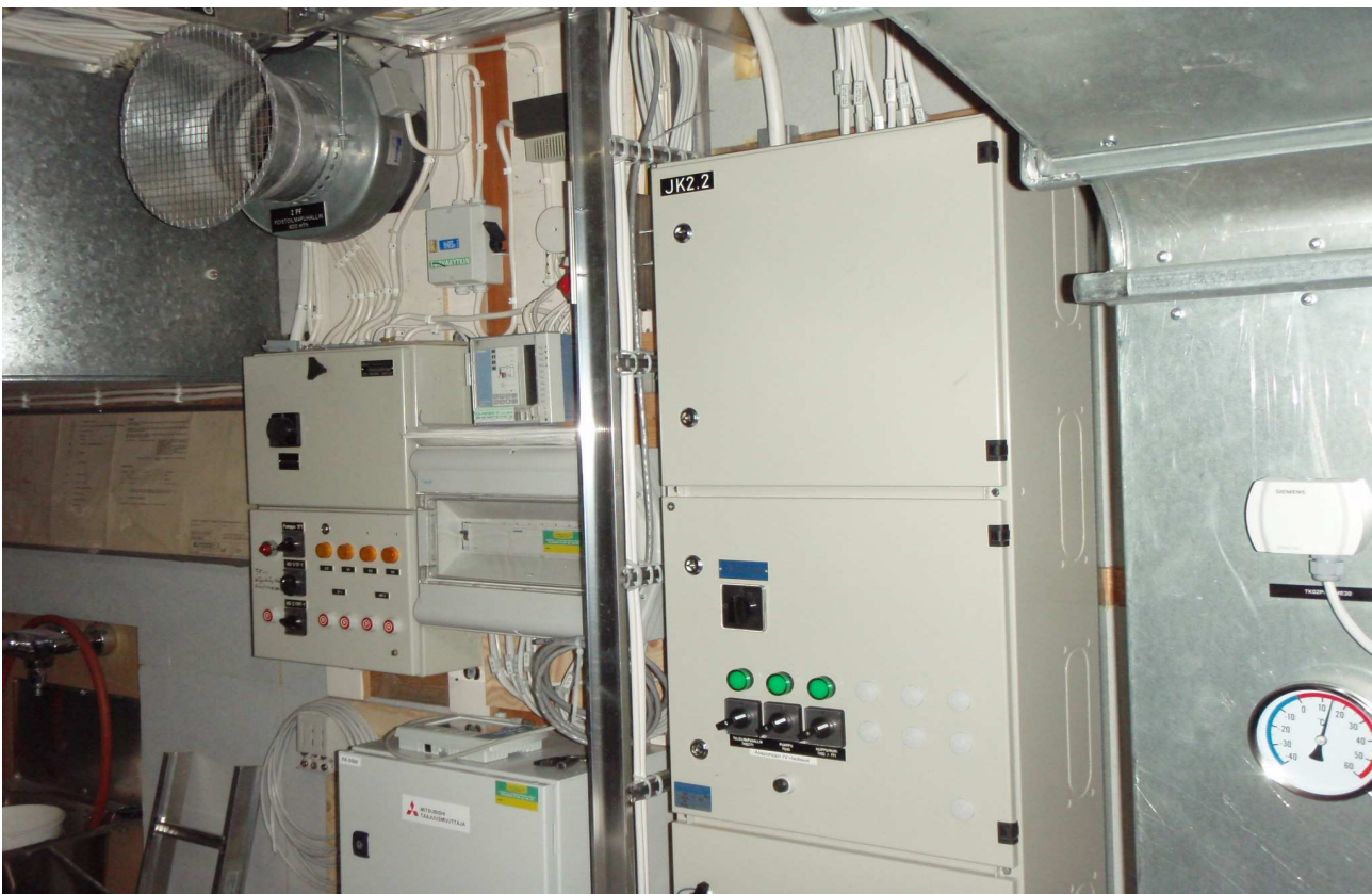
S- kuva 4. IV- konehuoneen keskus.
