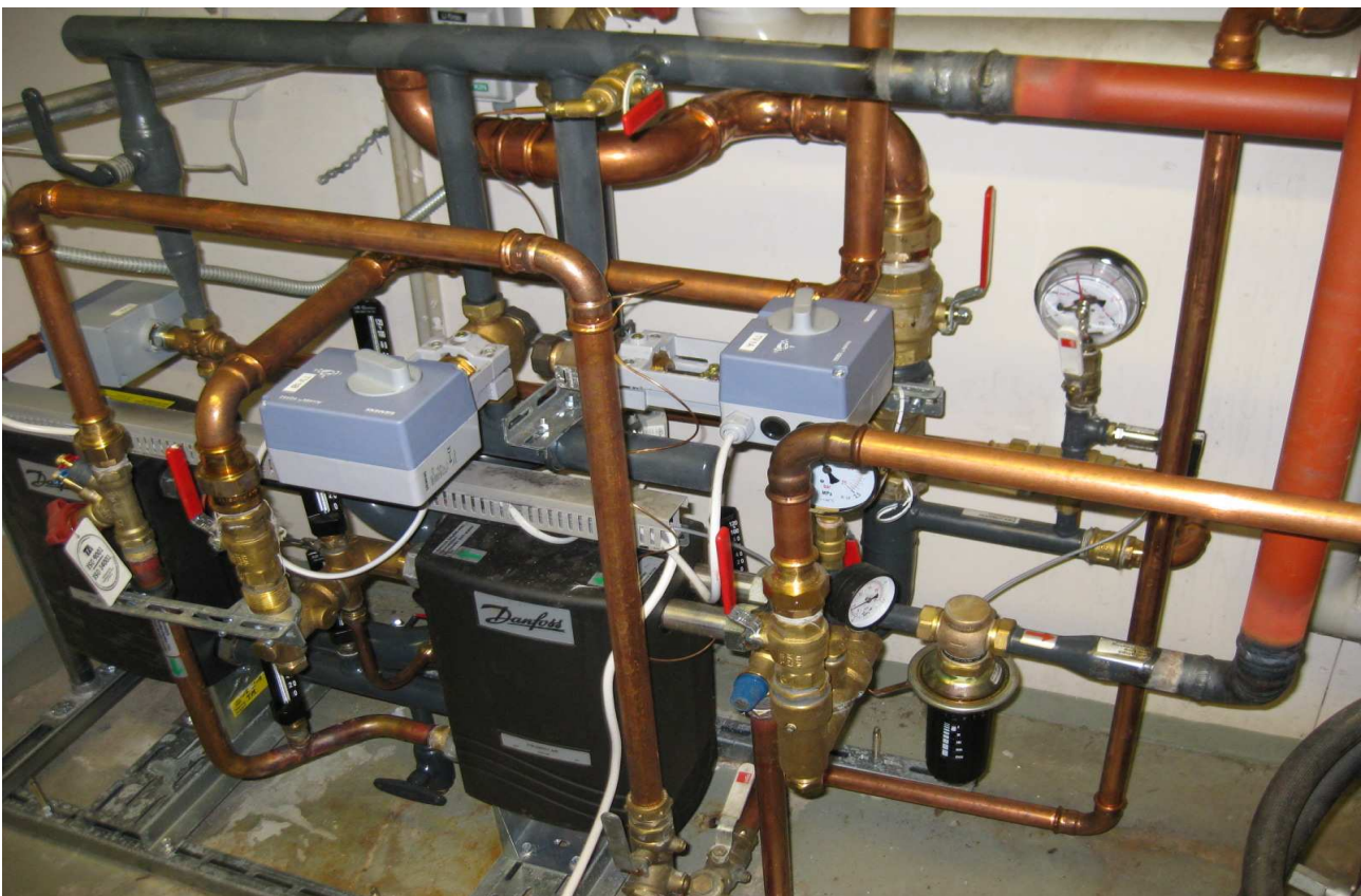
LVI- kuva 1. Yleiskuva lämmönjakuhuoneesta.
