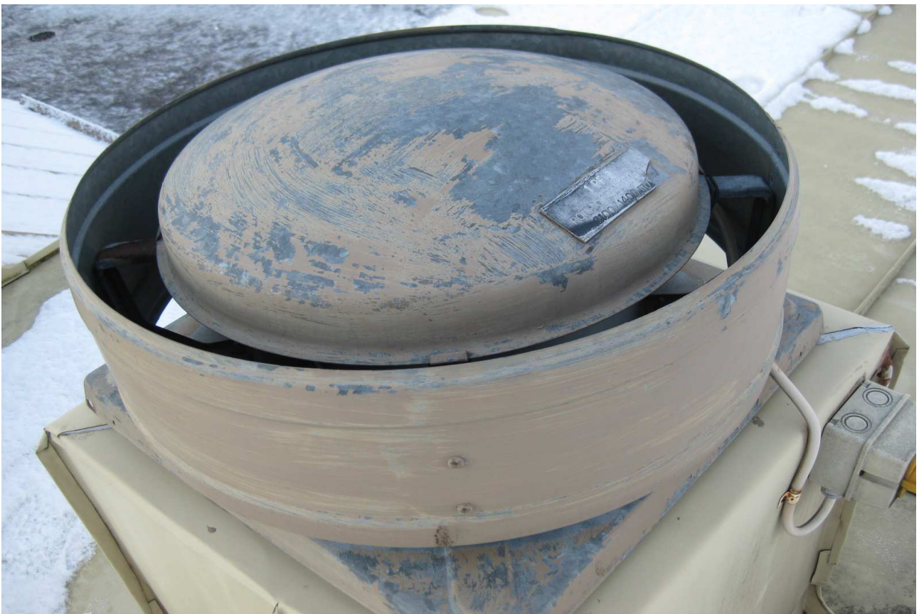
LVI- kuva 13. Yleiskuva vesikatolla olevasta huippuimurista.
