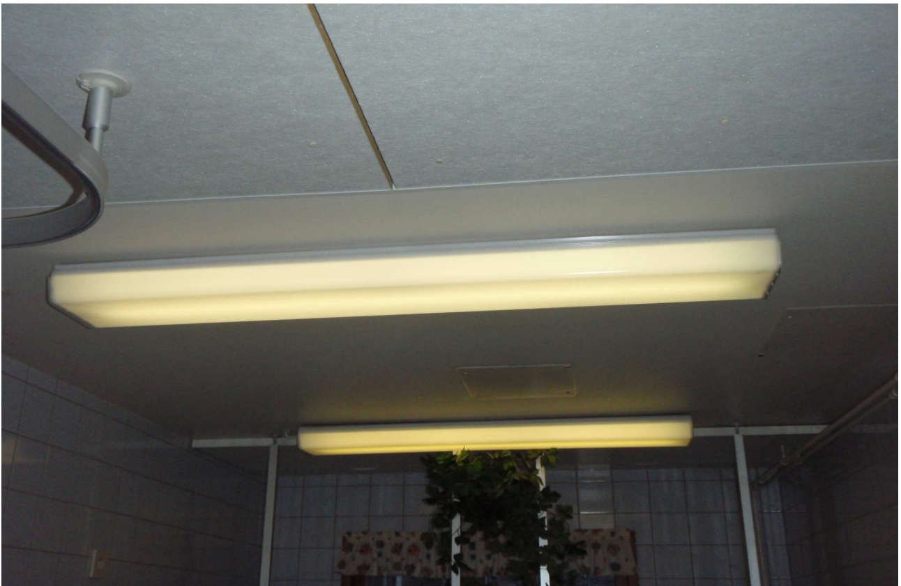
S-kuva 10. WC-tilojen valaistus.
