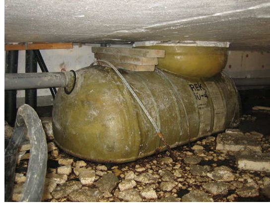
Kuva 2 Rasvanerotuskaivo on veden varassa.
