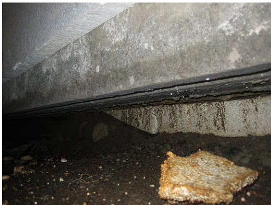
Kuva 5 Katoksen kohdalla polystyreenieristyslevyt ovat painuneet alas sokkeli-palkin vieressä.
