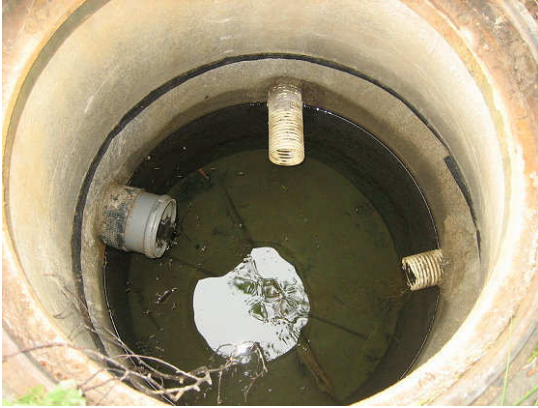
Kuva 13 Yksi salaojajärjestelmän keräilykaivoista. Salaojaputkia ja purkuputki.
