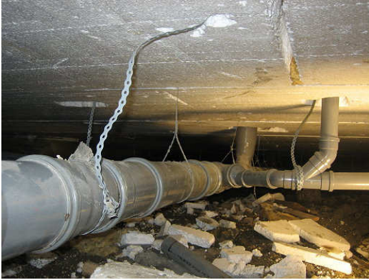
Kuva 7 Viemäreiden kannattamia on irronnut ja läpiviennit on tiivistämättä.
