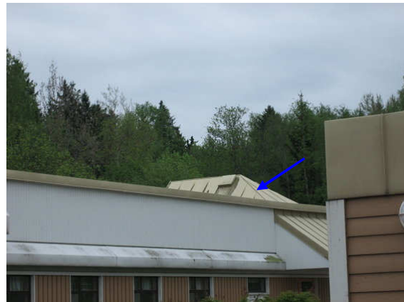
Kuva 16 Vesikatolla olevien kolmioiden tuulettamista ei ole järjestetty.
