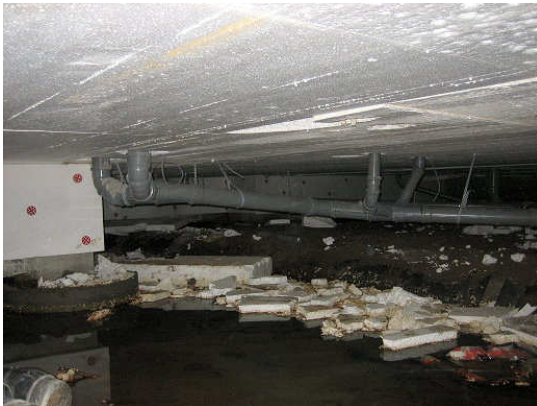
Kuva 3 Painanteissa runsaasti vettä (n. 300 mm). Alustatilassa on runsaasti polystyreenilevyjen kappaleita.
