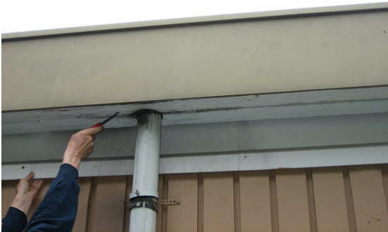
Kuva 15 Räystäskourujen kotelorakenteessa lahonnutta laudoitusta. Ränniliitos vuotaa.
