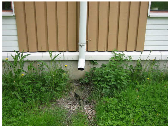
Kuva 12 Syöksytorvien ja loiskekivien keskinäisessä sijoittelussa havaittiin puutteita.
