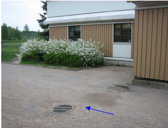
Kuva 9 Etupihalla maanpinta on painunut sadevesikaivon kohdalla.
