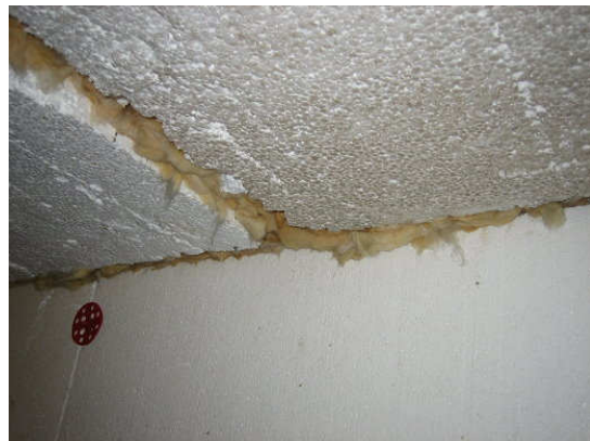
Kuva 6 Paikoitellen sokkelielementin ja ontelolaattojen polystyreenilevyjen välejä on tilkitty.
