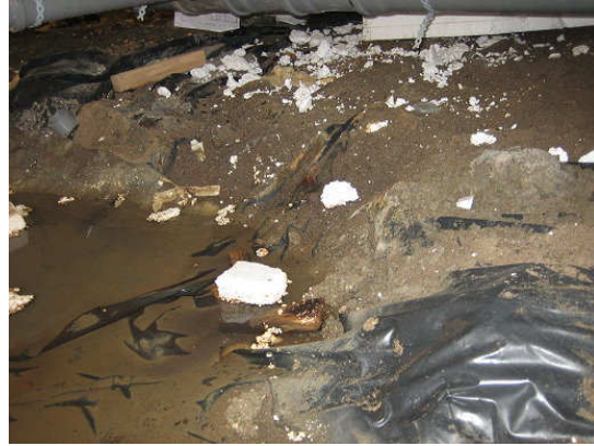
Kuva 8 Alustatilassa on kapillaarikatkona muovia. Alustatilassa on mikrobivaurioitunutta puutavaraa.
