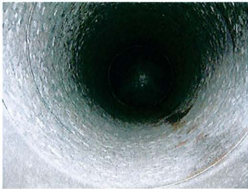
Kuva 1. Tuloilmakanava, tyttöjen pukuhuone.
