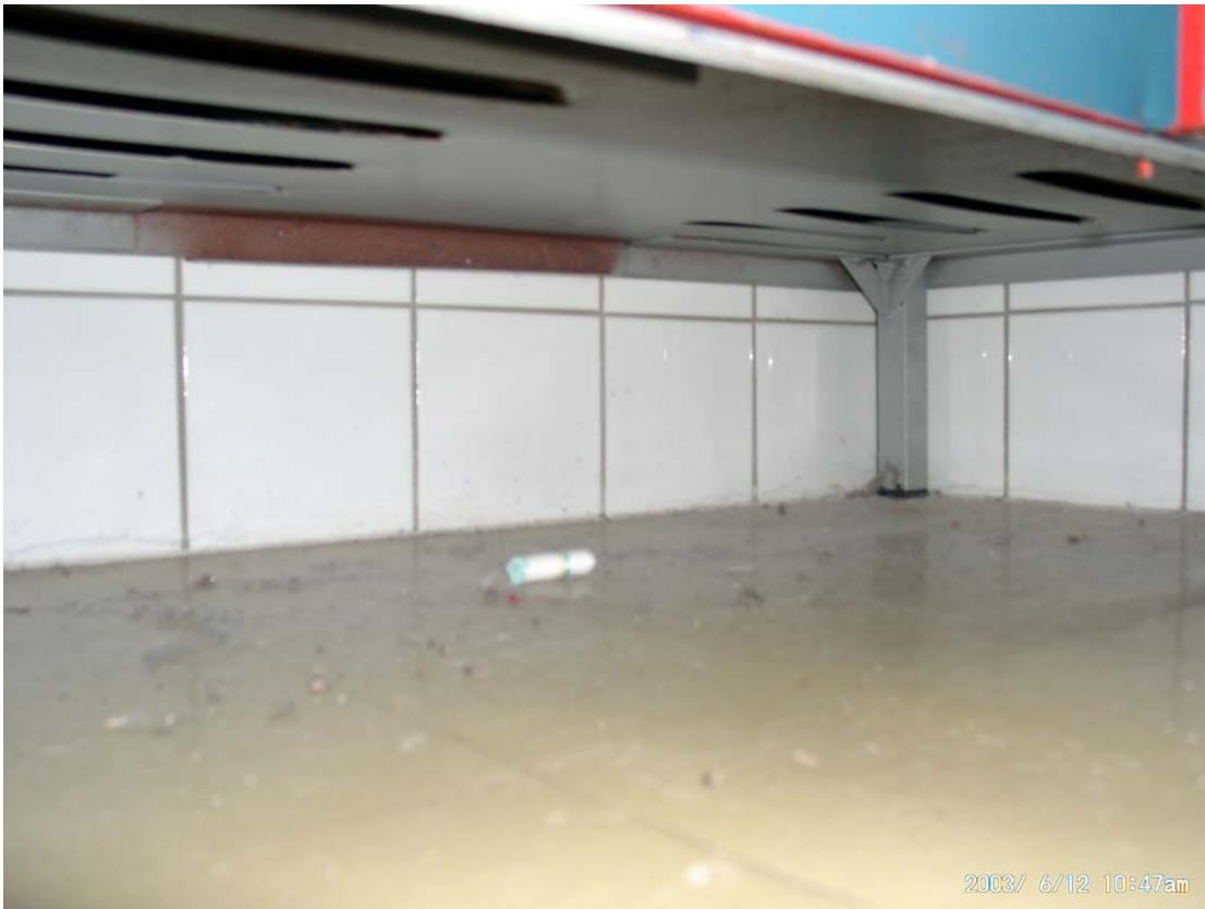
Kuva 3. Huoneessa 014 oli lattialla ja pelivälinelaatikoissa paljon pölyä.
