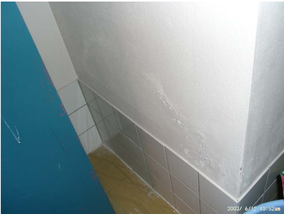
Kuva 4. Huoneessa 014 oli huoneessa olevan suihkuhuoneen vastaisesta seinästä maali kopo. Seinä oli ko. kohdasta kuiva, mutta seinän toisella puolella suihkuhuoneessa seinä oli alemmaa 1...3 laatan korkeuteen märkä.
