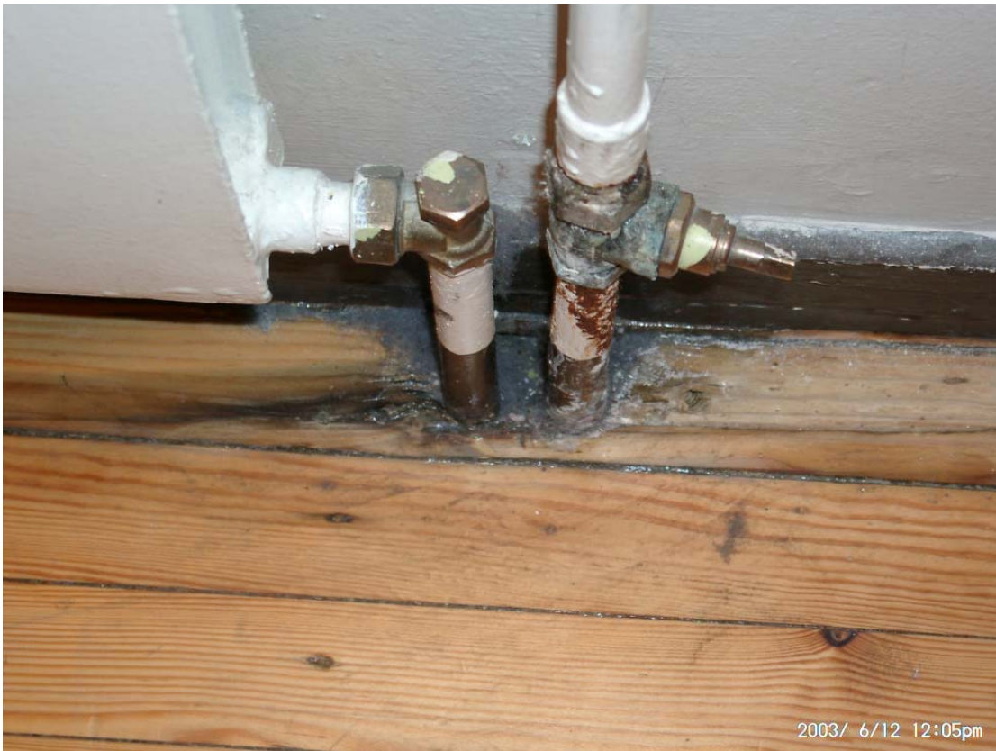
Kuva 5. Voimistelusalin lämmityspattereiden vesiputkien läpiviennit olivat luonnonopin luokan puoleisella seinällä 2/5 kohdasta märkiä, läpivientirei'istä tuli ilmaa saliin ja ilman tuoksu viittasi voimakkaasti mikrobikasvustoon. Kosteusjälkiä oli läpivientien ympärillä kummankin ikkunaseinän vierellä.
