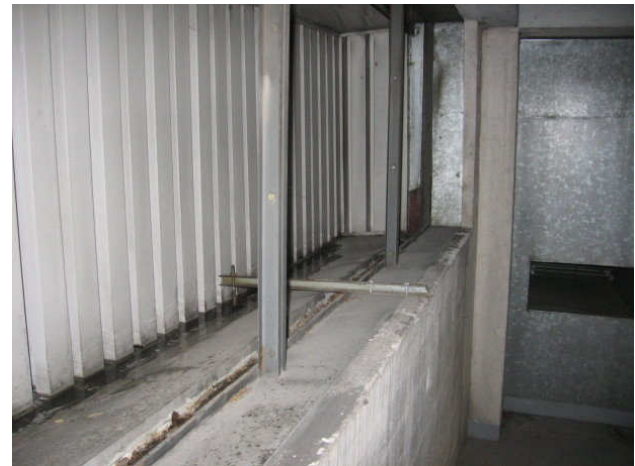
Kuva 6 Säleikön tuloilmakammion puoleiselle sivulle pääsee vesi.
