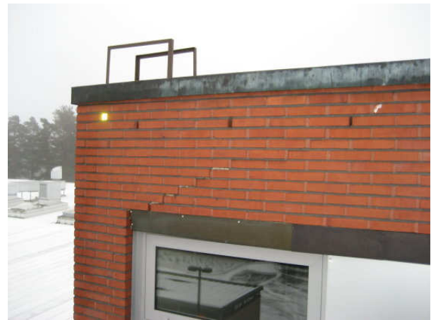
Kuva 24 Julkisivumuuraus on hajonnut pohjoispäädyn kulmalla. Ikkunan yläpuolinen pellitys voi johtaa vettä rakenteisiin.
