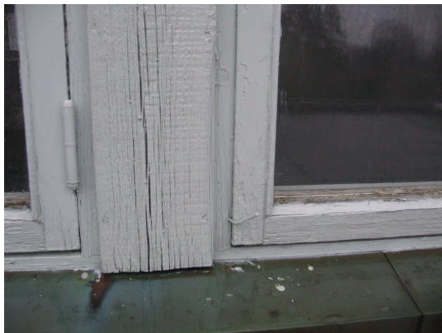
Kuva 13 Tästä länsisivun ikkunavälistä on lähtenyt suojapeltti irti. Puite on lukittu naulalla.
