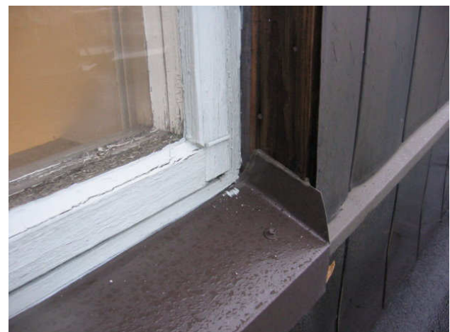
Kuva 8 Itäsivun vesipellitykset on uusittu. Sivupielen liittymä ei ole tiivis.
