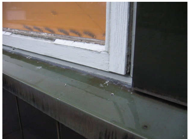
Kuva 14 Lohjennut ikkunakittaus länsisivulla. Ikkuna ei ole tiiviisti kiinni
