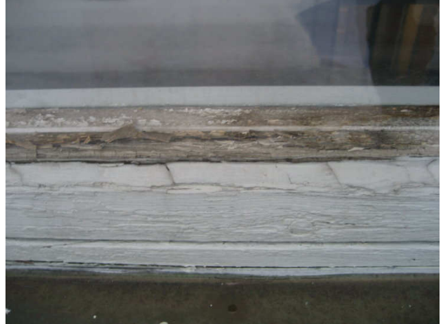
Kuva 16 Lohjonneita kittauksia ja kosteusvaurioitunut lasiväli.
