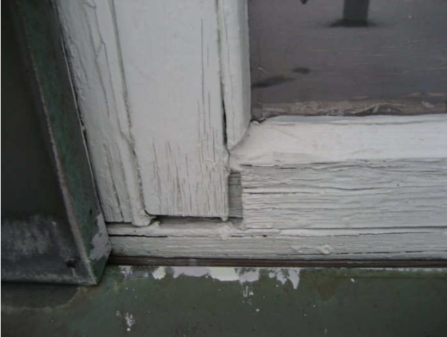
Kuva 15 Pettänyt liitos länsisivulla. Vesipellin ja karmin välissä on rako.
