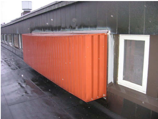
Kuva 5 IV-konehuoneen tuloilmakammion säleikköpömpeli vuotaa.
