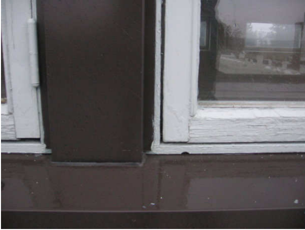
Kuva 9 Ikkunoiden välisat on pellitetty. Liitoksen tiiveys on kitin varassa
