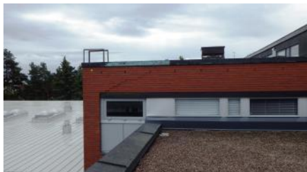
Kuva 8. ja (7.) Tiiliverhouksessa halkeamia koillisnurkan itä- ja pohjoissivulla.
