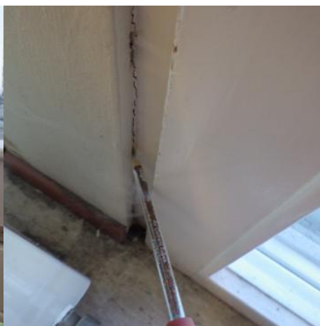
Kuva 2. Ilmavuotoa ikkunan ja ulkoseinän liitoksesta (auditorio).
