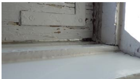
Kuva 37. Puuikkunoiden ulkopuitteet ovat huonokuntoisia. Puitteen ja karmin välisestä raosta pääsee pölyä ja hienojakoista lunta puitteiden väliin.
