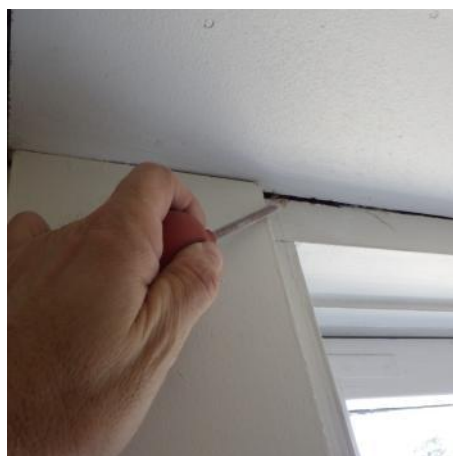
Kuva 3. Ilmavuotoa ikkunan ja ulkoseinän liitoksesta (A308).
