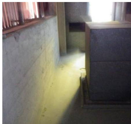
Kuva 54. Ulkoilmakammion pohjalla ulkoilmapölyä
