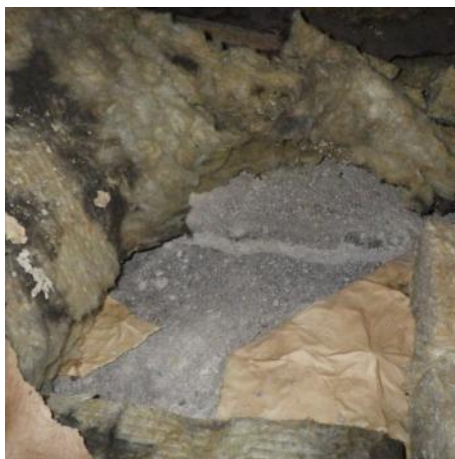
Kuva 10. Kuva otettu yläpohjan tuulettu-tilasta. Yläpohjalaatta liikuntasauaman kohdalla. Lämmöneriste on tummunut, mikä viittaa ilmapuotoihin.
