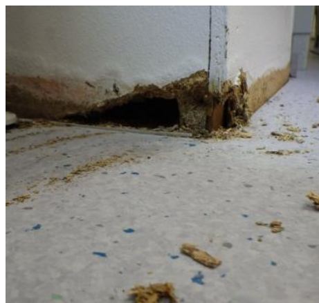
Kuva 345. Kotelon levytys kosteusvaurioitunut alaosastaan.
