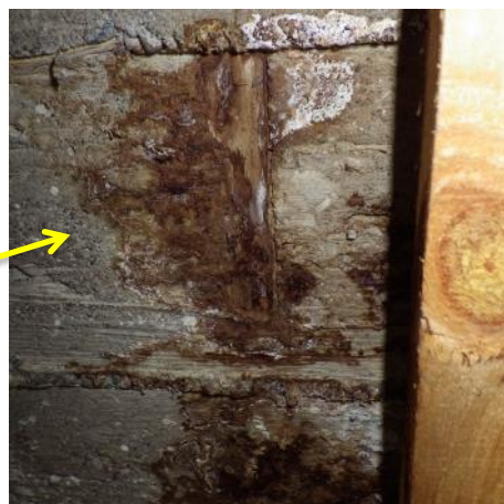
Kuva 26. Vesikatolta vuotanut vesi on tullut yläpohjan betoniholvin läpi lautapalikan kohdalta. Rakenteen pinnalla on pienialaisesti kuivunutta pinta-mikrobikasvua.
