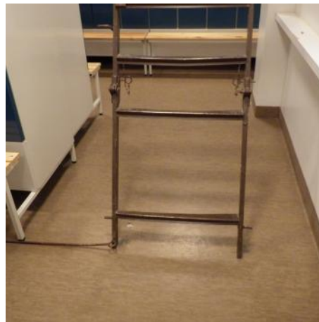
Kuva 43. 4. kerroksen iv-konehuoneeseen johtavat portaat. Yksi askelma on irronnut.
