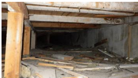
Kuva 14. Yleisnäkymä 3. kerroksen yläpohjan tuulettuvasta tilasta. Seinän vieressä olevissa kattovasoissa ja seinälevyn pinnalla on havaittavissa vanhoja kosteusvauriojälkiä.
