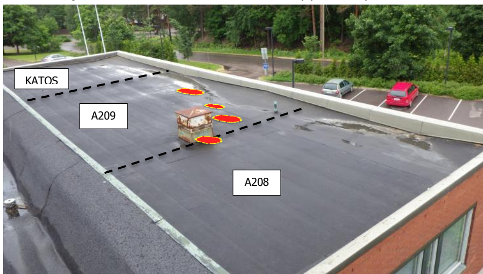
Kuva 20. Auditoriosiiiven vesikattoa. Mustalla katkoviivalla on esitetty tilojen välisten seinien paikat. Punakeltaiset merkit kuvaavat alapuolella havaittuja kosteusvauriojälkiä.
