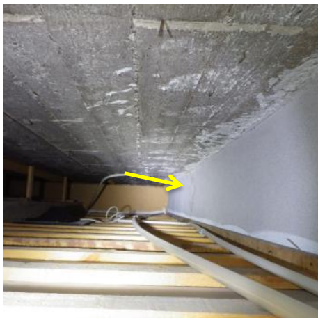
Kuva 27. Auditorion alakaton rakenneavauksesta otettu kuva. Palkissa näkyy kosteusvauriojälki.
