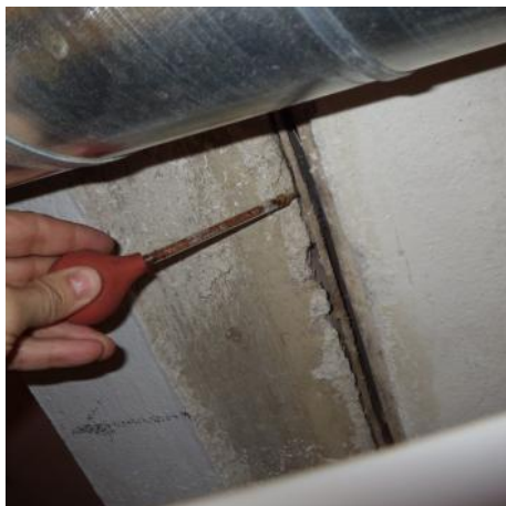
Kuva 12. Alakattotilasta otetussa kuvassa ilmavuotoa yläpohjan liikuntasaumasta.
