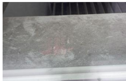
Kuva 46. Liikuntasalin yläikkunan penkillä pölykertymä.
