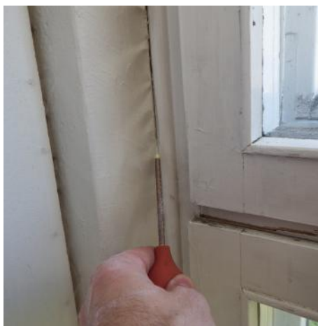
Kuva 1. Ilmavuotoa ikkunan ja ulkoseinän liitoksesta (auditorio).
