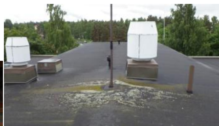
Kuva 17. 4. kerroksen vesikatolla sammaloitumista, mikä on aiheutunut todennäköisesti antennilla oleskelleiden lintujen ulosteista.
