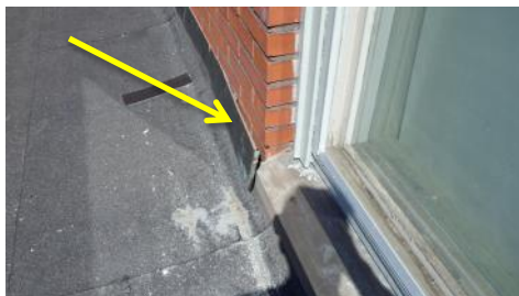
Kuva 21. Vesikaton rintataitepellin kiinnitys tiiliseinäen on irronnut lyhyeltä matkalta.
