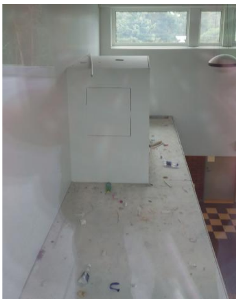
Kuva 44. 3. kerroksen käytävän A313 tason päällä runsas pölykertymä.
