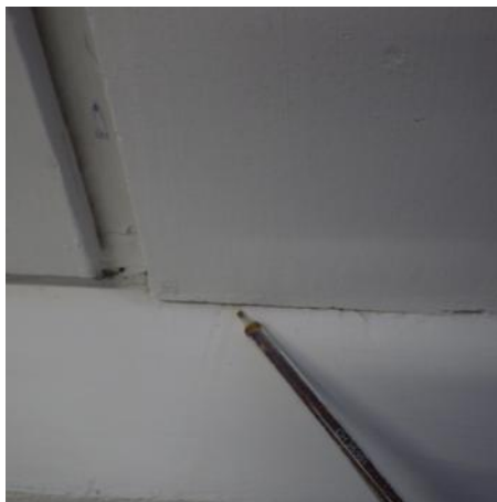
Kuva 5. Ilmavuotoa ikkunoiden välisen peitelevyn alareunasta.
