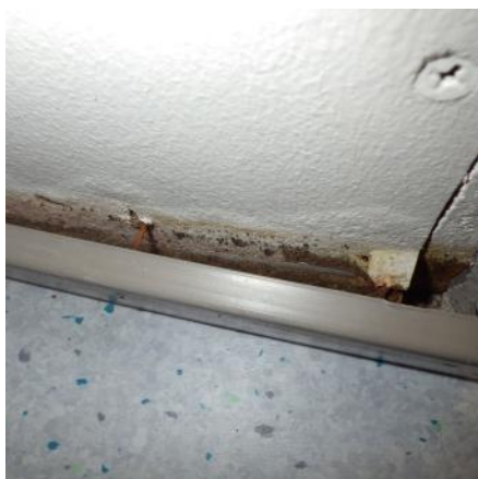
Kuva 33. Tilassa A320 sadevesiviemärin kotelon jalkalistan takana pintahometta.
