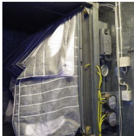
Kuva 50. Tuloilmakoneen 2 suodatin. Likaantumisesta päätellen hihna on voinut olla poikki pitkiä aikoja.
