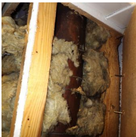
Kuva 31. Viemäriputki on eristetty puutteellisesti.
