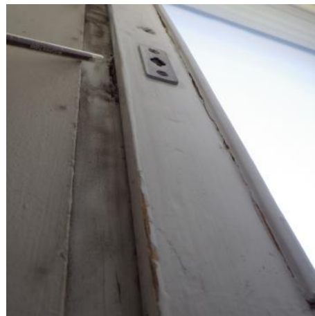
Kuva 41. Auditorion ikkunatiivisteissä on vuotoa. Karmissa on havaittavissa ulkoilmapölykertymää.
