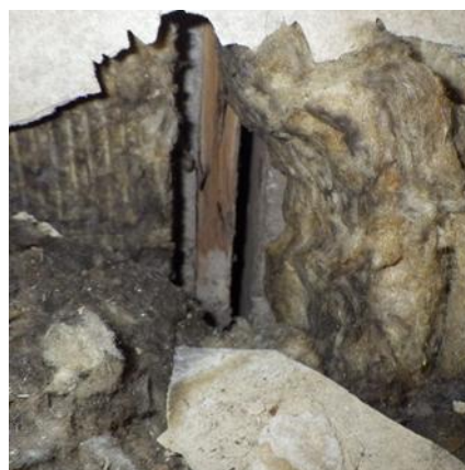
Kuva 9. Vesikaton tuulettuvassa tilassa oleva 4. kerroksen ulkoseinärakenteen avauskohta. Vuurivillaeriste on tummunutta. Eristeen takana näkyy avoin liikunta- ja sauma.
