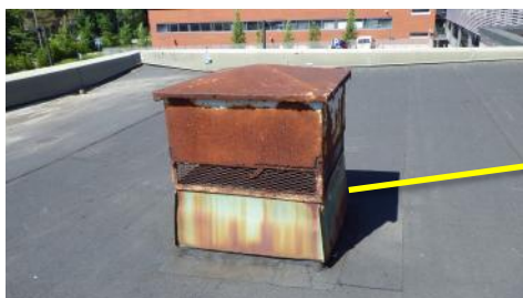
Kuva 23. Käytöstä poistettu poistopuhaltimen läpivientipiippu.
