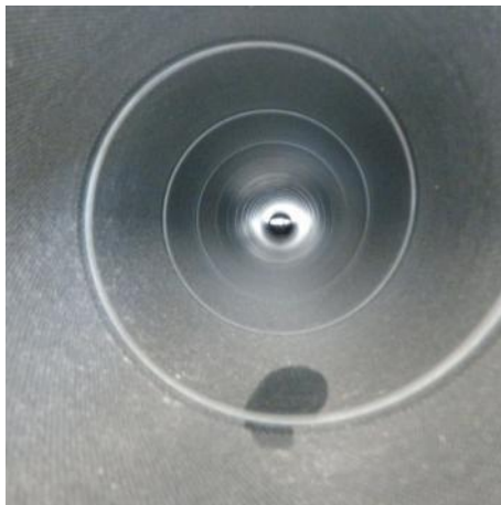
Kuva 47. Tilan A355 tuloilmakanava.
