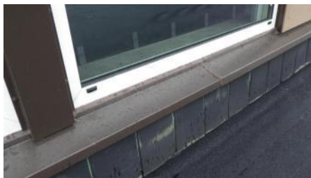
Kuva 18. Yläpohjan tuuletuksen pitäisi tapahtua osaksi 4. kerroksen ikkunoiden alapuolella olevan seinän tuuletusvälin kautta. Ikkunan vesipellitys estää tuuletusvälin toiminnan.
