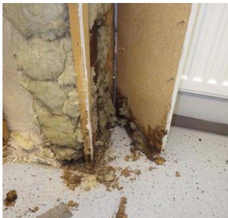
Kuva 29. Tilassa A308 sadevesiviemärin kotelon alaosa kosteus- ja mikrobivaurioitunut.
