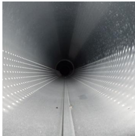
Kuva 48. Tilan A323 tuloilmakanava
