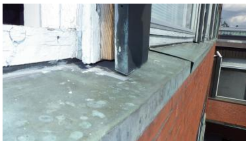
Kuva 39. Ikkunapeltien kallistukset ovat loivat. Vesipeltien saumat epätiivitä
