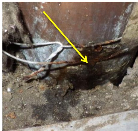
Kuva 30. Sadevesiviemärissä ruuvin tekemä reikä.
