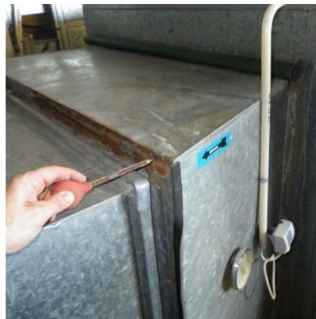
Kuva 56. TP3 IV-koneen kammion kulma on epätiivis.
