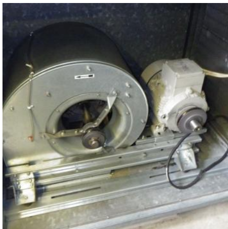
Kuva 49. Tuloilmapuhaltimen (TP2) hihna katkennut.
