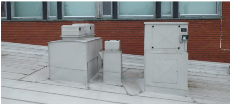
Kuva 57. Vesikatolla sijaitsevien poistoilmalaitteiden (3 kpl vas. puoleiset) etäisyys tuloilmalaitteesta (oikealla) on liian lyhyt.
