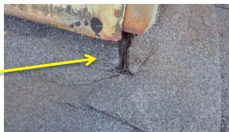
Kuva 24. Piipun juuren bitumikatteessa vaurio.
