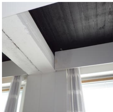
Kuva 32. Kirjaston ikkunan verholaudassa ja -kotelossa kosteusvauriojälkiä.
