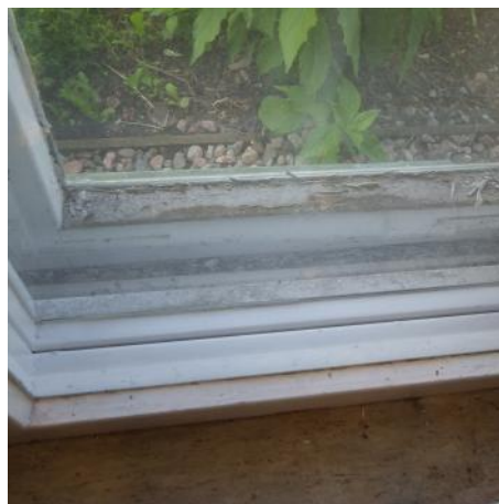
Kuva 38. Auditorion ikkunan välissä on pölyä ja likaa.
