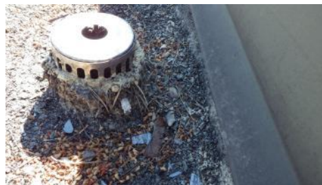
Kuva 22. Katon sadevesiviemärin suojaritilä on roskainen.
