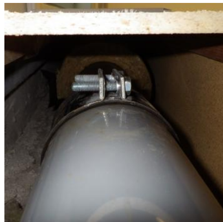
Kuva 36. Tilan A320 sadevesiviemärissä mansetti-liitos. Putken alaosasta puuttuu eristeet.
