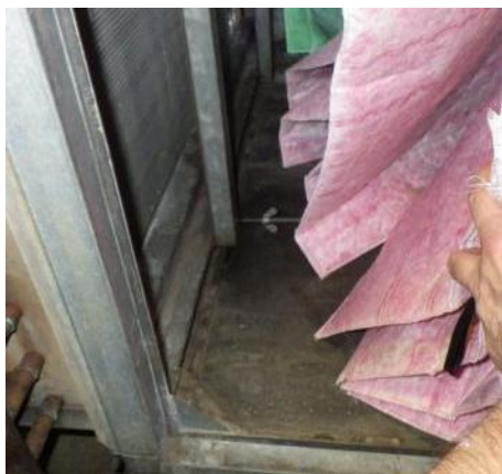
Kuva 53. Tuloilmakammion pohjalla on kosteusjälkiä.
