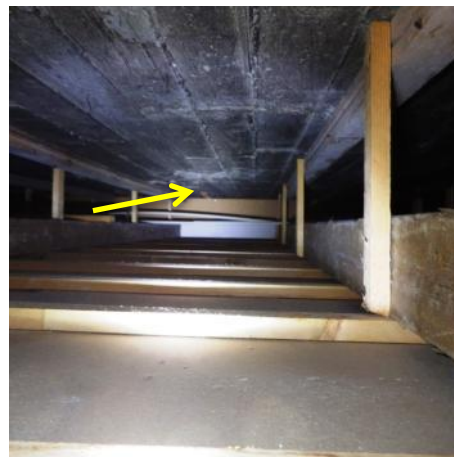
Kuva 28. Auditorion alakaton rakenneavauksesta otettu kuva. Betoniholvin alapinnalla näkyy kosteusvauriojälki.
