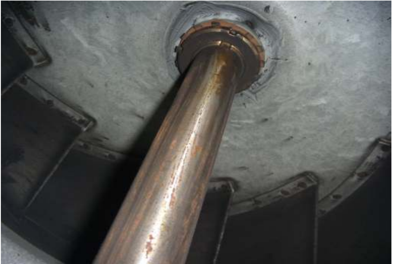
KUVA 18. Yleiskuva tuloilmakoneen 4TK1 tuloilmapuhaltimesta.
