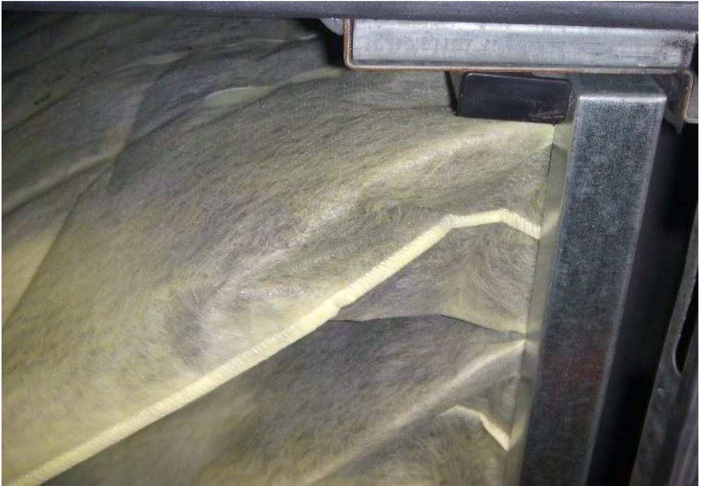
KUVA 16. Yleiskuva tuloilmakoneen 4TK1 suodattimista.
