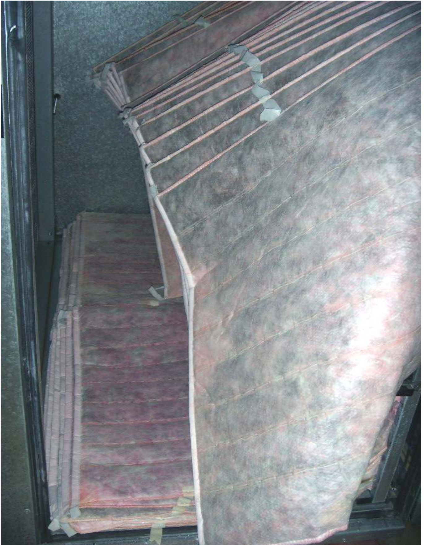
KUVA 7. Yleiskuva tuloilmakoneen 2TK1 suodattimista.
