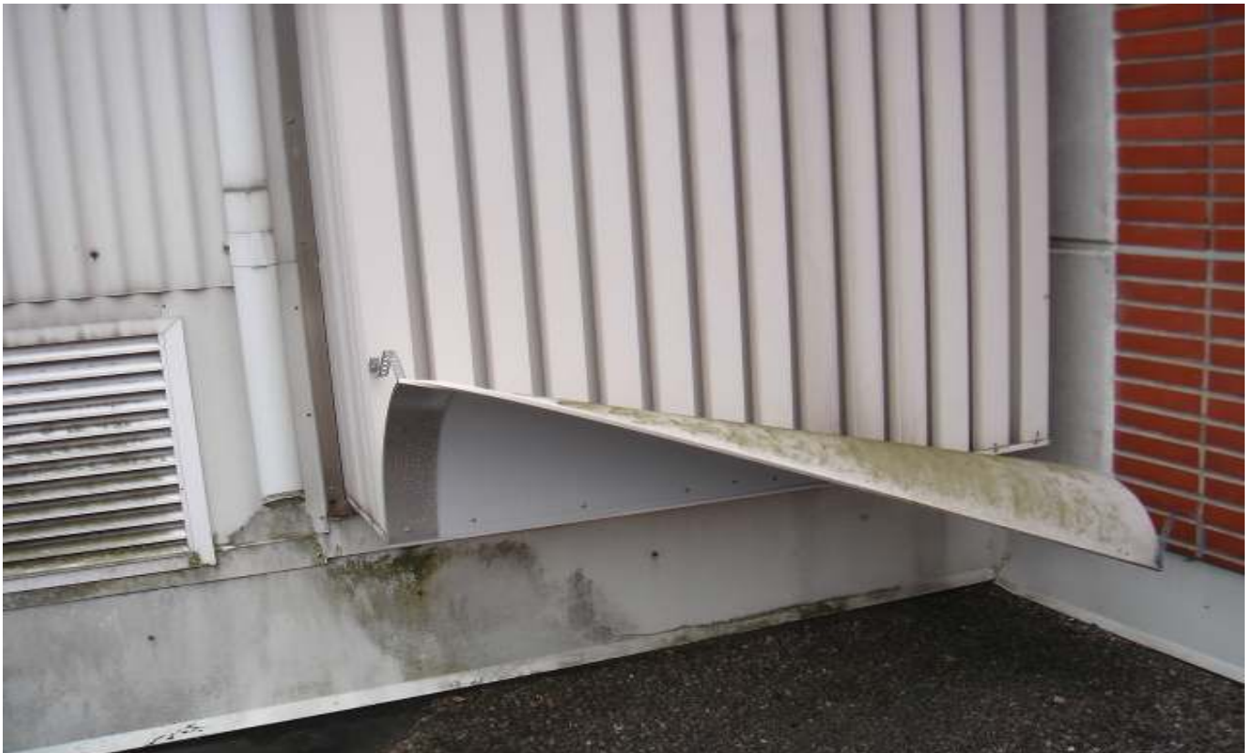
KUVA 31. Yleiskuva vesikatolla olevasta tuloilmasäleiköstä.
