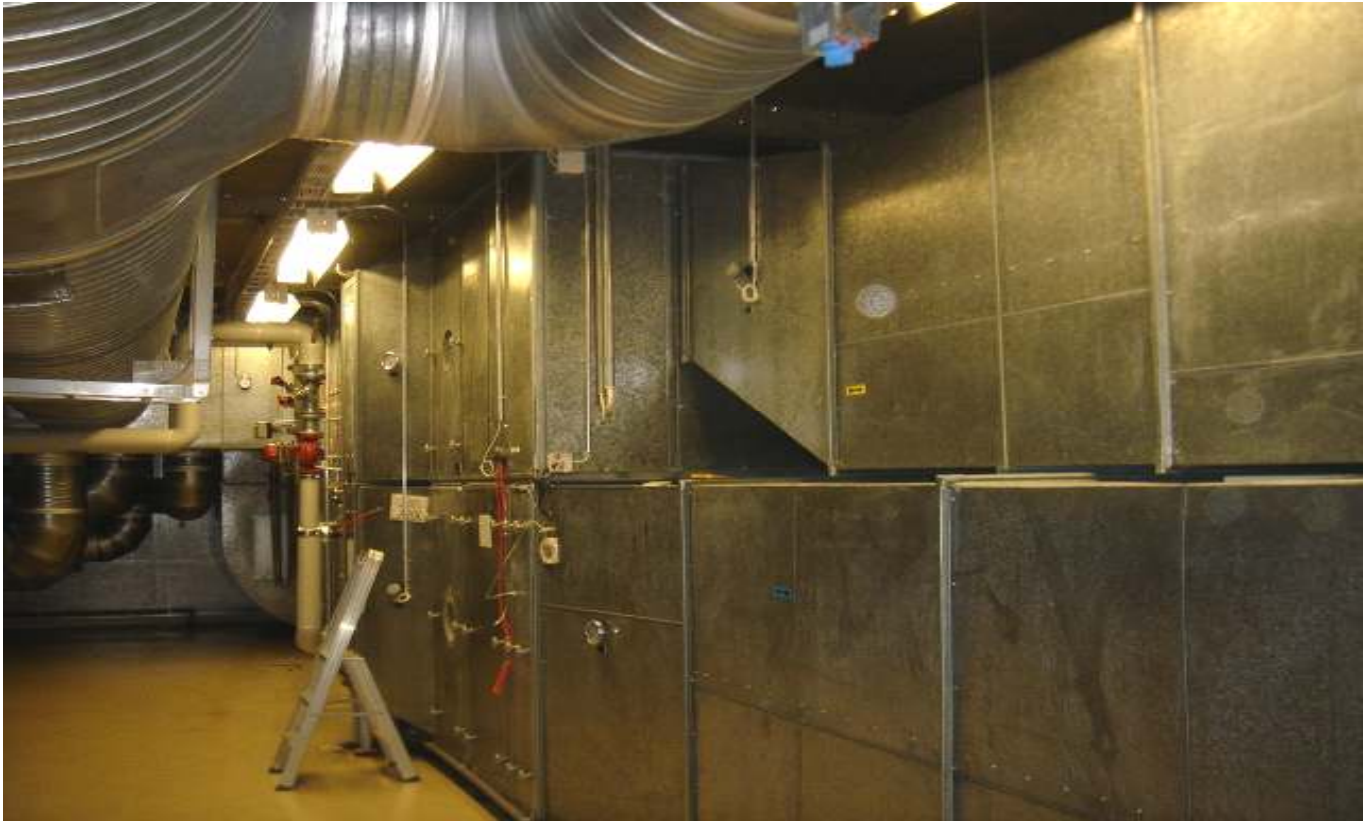
KUVA 1. Yleiskuva opetustiloja palvelevasta tuloilmakoneesta.
