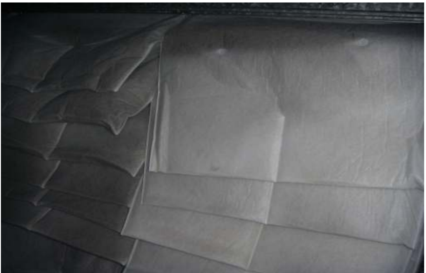
KUVA 6. Yleiskuva poistoilmakoneen 1PK1 suodattimista.
