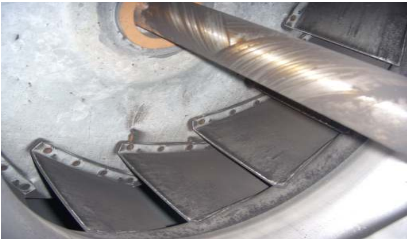
KUVA 19. Yleiskuva poistoilmakoneen 4PK1 poistopuhaltimesta.
