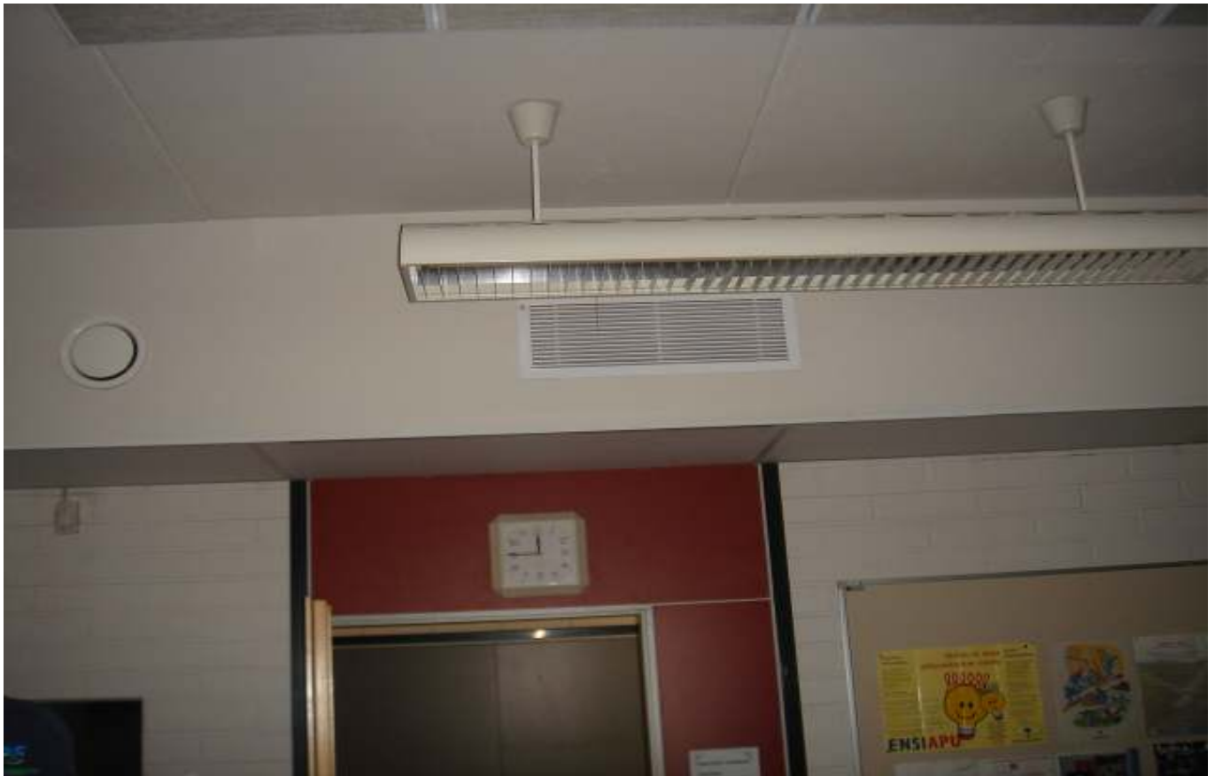
KUVA 28. Yleiskuva luokkahuoneesta, jossa valaisimet on asennettu tuloilmaelimen eteen.
