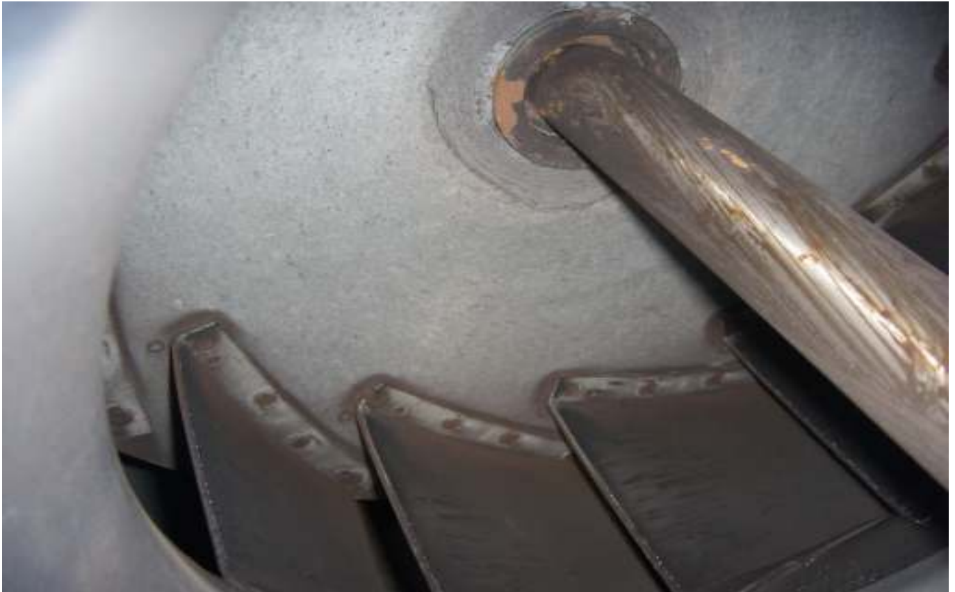
KUVA 12. Yleiskuva poistoilmakoneen 2PK1 poistopuhaltimesta.
