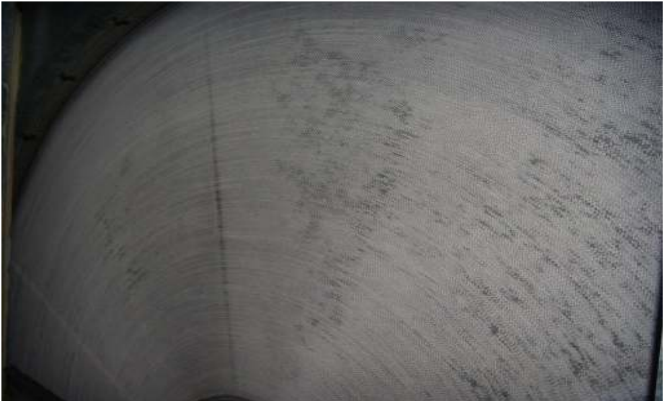
KUVA 9. Yleiskuva tuloilmakoneen 2TK1 LTO- kiekosta.
