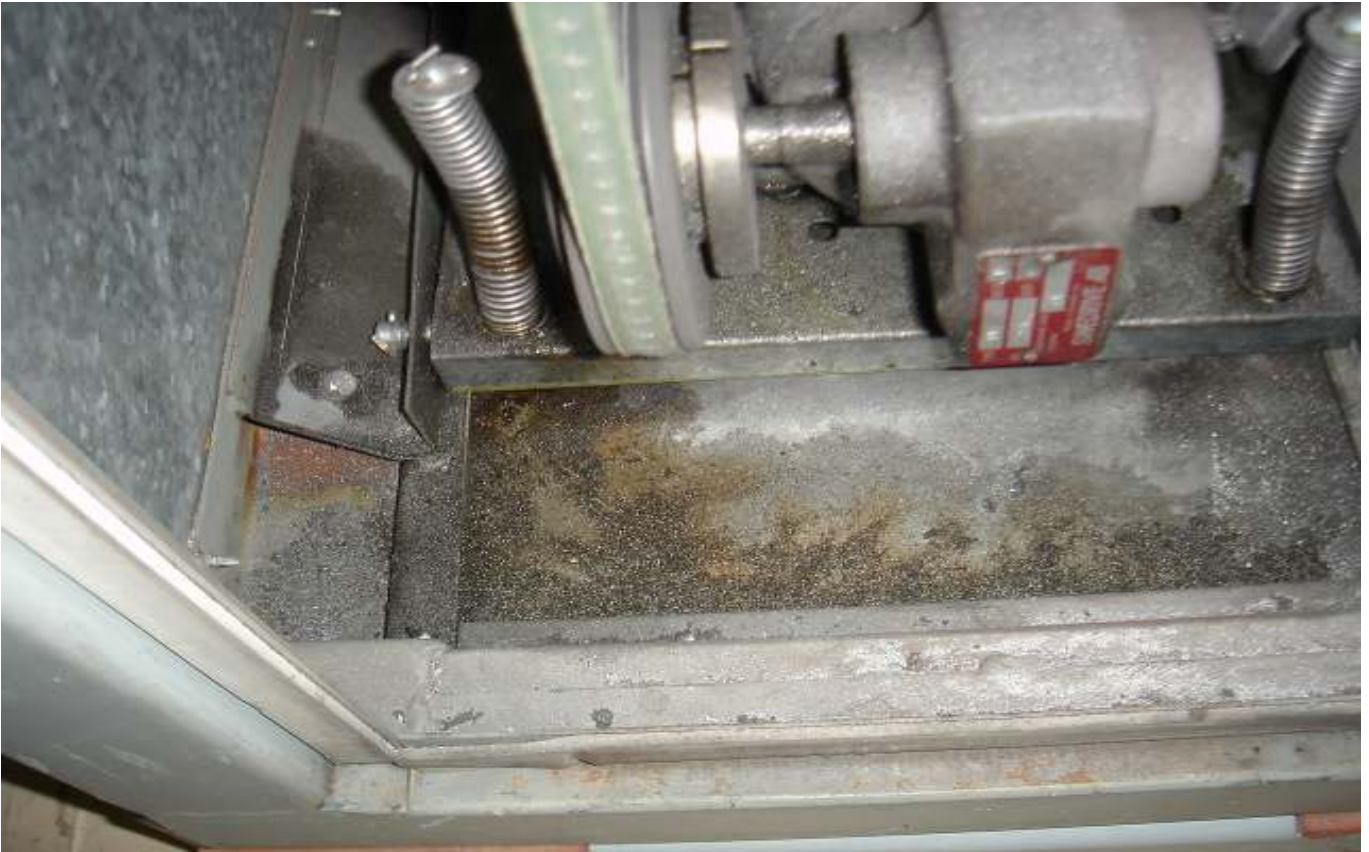
KUVA 14. Yleiskuva tuloilmakoneen 3TK1 LTO- kammiosta.
