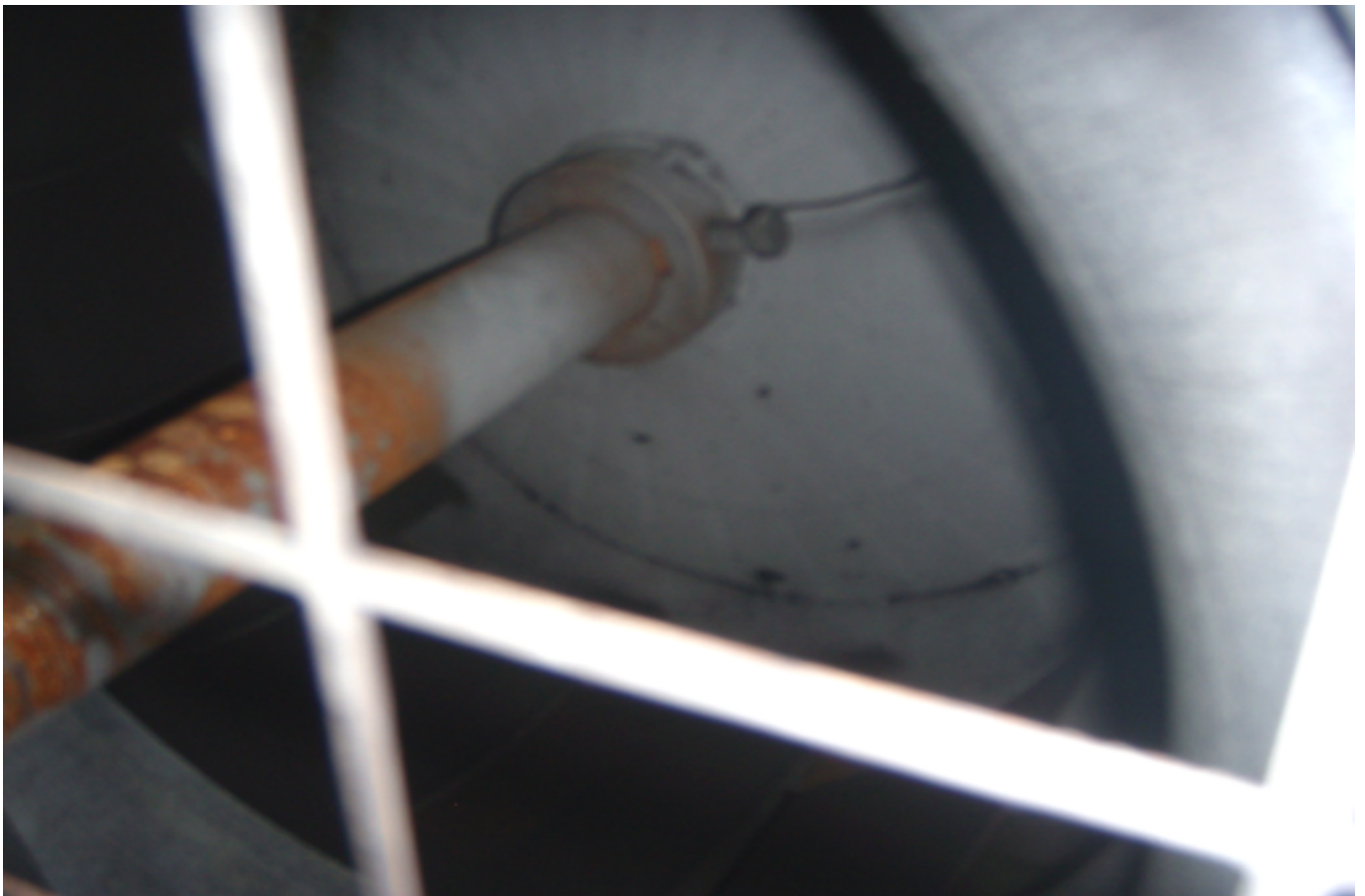
KUVA 4. Yleiskuva tuloilmakoneen 1TK1 tuloilmapuhaltimesta.
