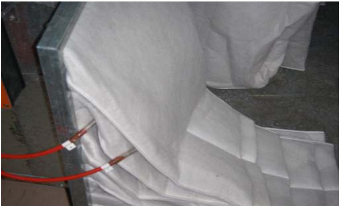
KUVA 13. Yleiskuva tuloilmakoneen 3TK1 suodattimista.
