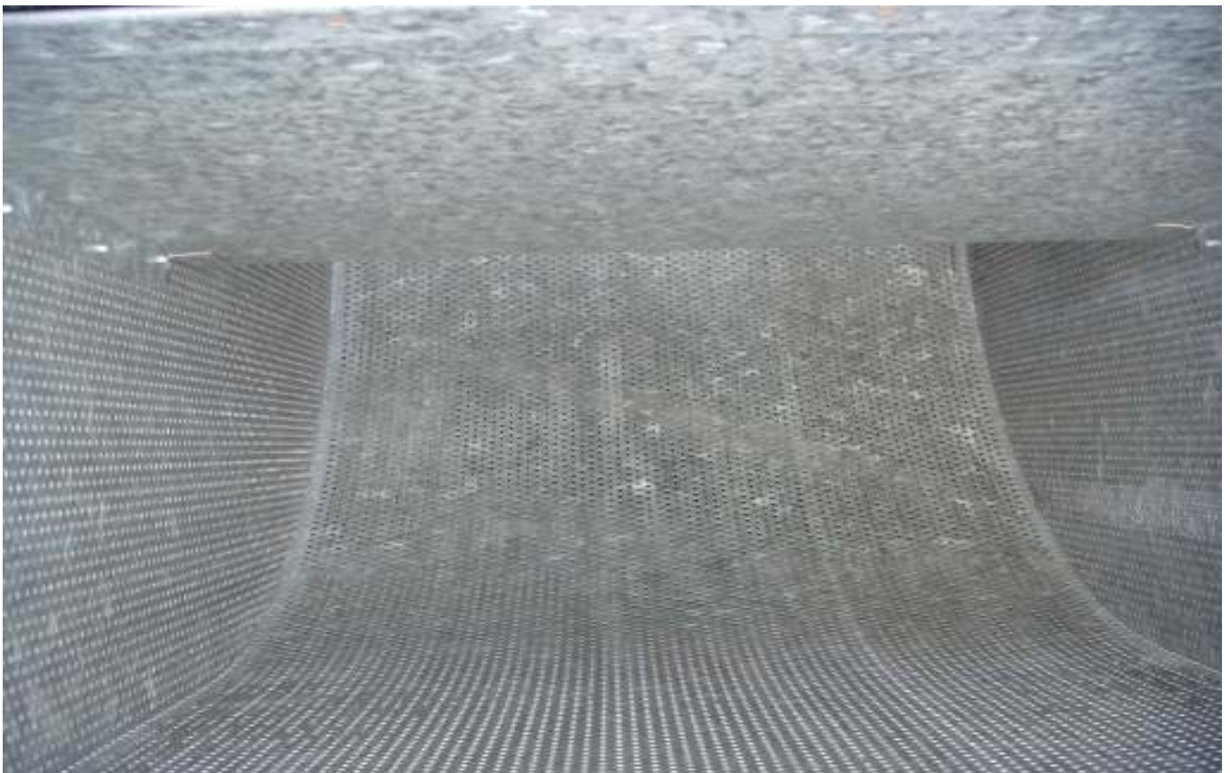
KUVA 11. Yleiskuva tuloilmakoneen 2TK1 tuloilmakammista.
