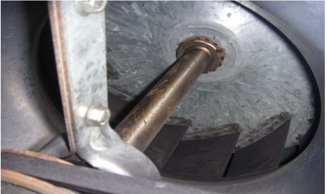
KUVA 10. Yleiskuva tuloilmakoneen 2TK1 tuloilmapuhaltimesta.
