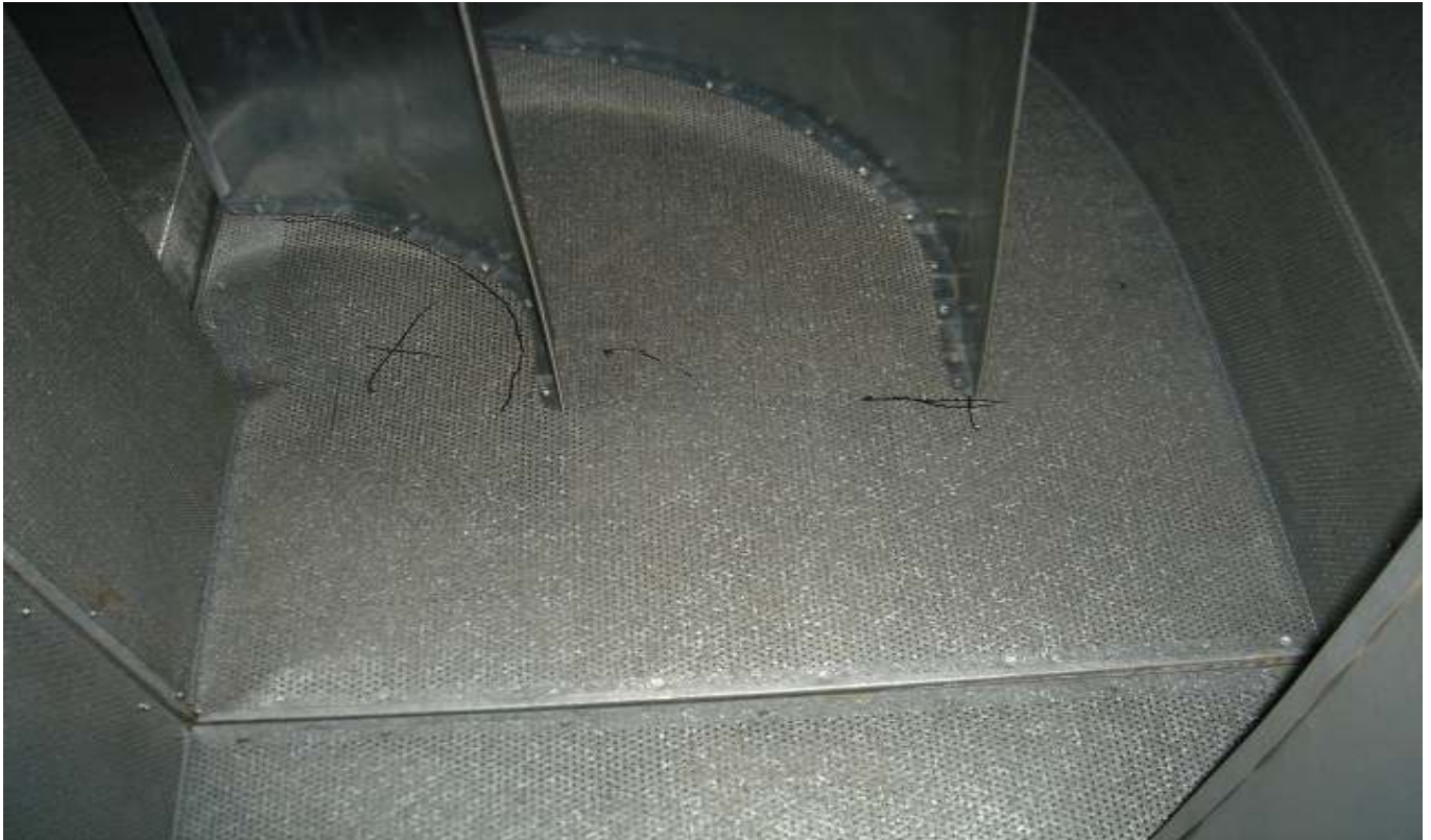
KUVA 5. Yleiskuva tuloilmakoneen 1TK1 tuloilmakammista.
