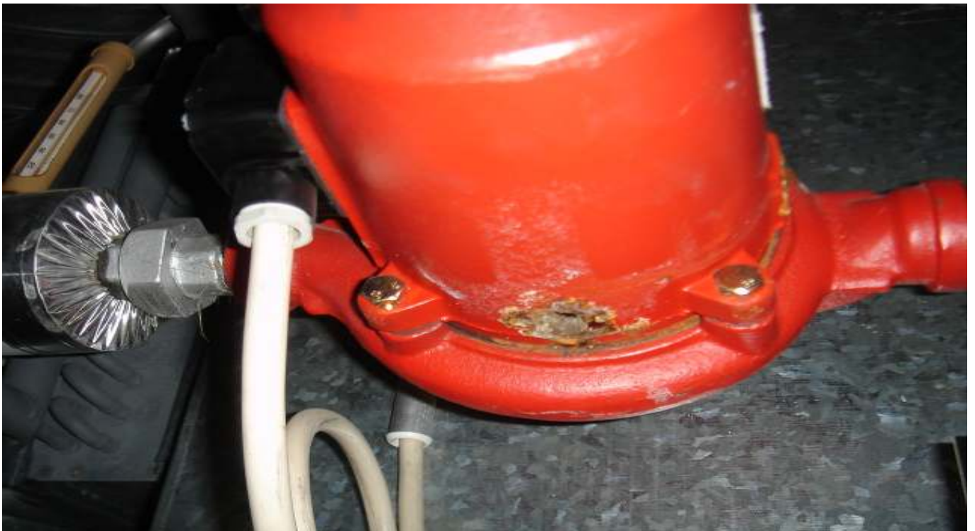
KUVA 17. Yleiskuva tuloilmakoneen 4TK1 jälkilämmityspatterin kiertovesipumpusta.
