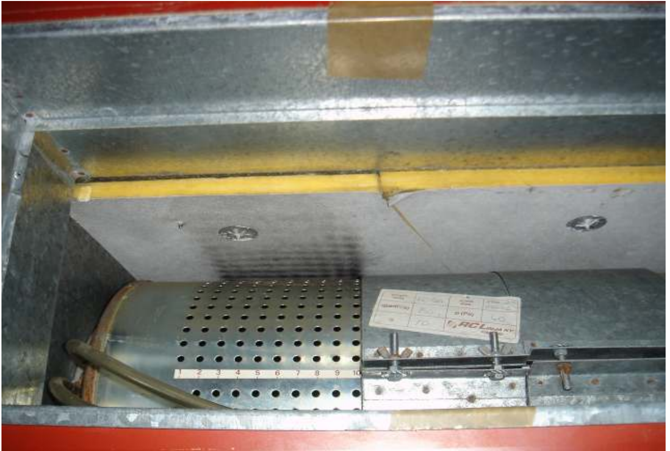
KUVA 24. Yleiskuva luokkahuoneen tasauslaatikosta.
