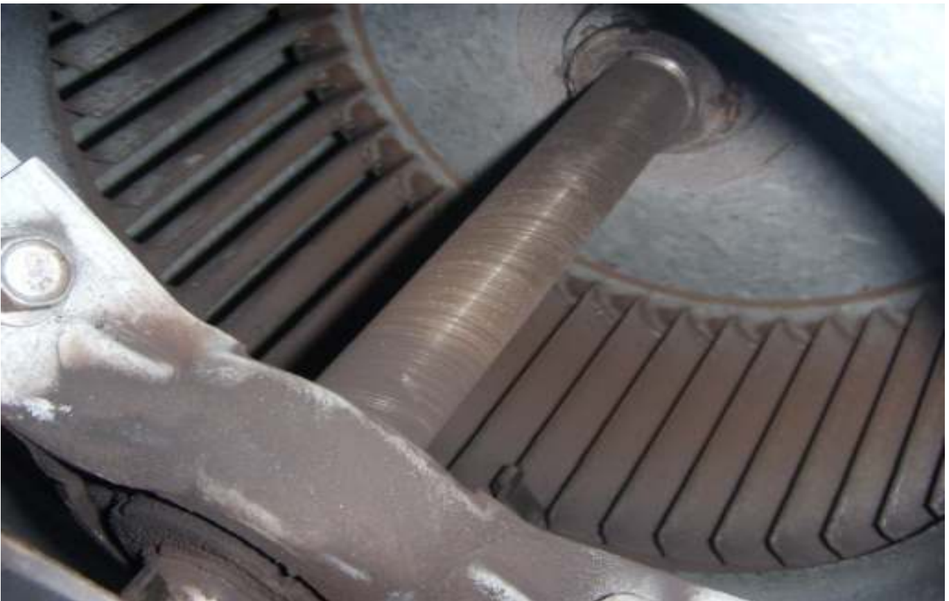
KUVA 15. Yleiskuva poistoilmakoneen 3PK1 poistopuhaltimesta.
