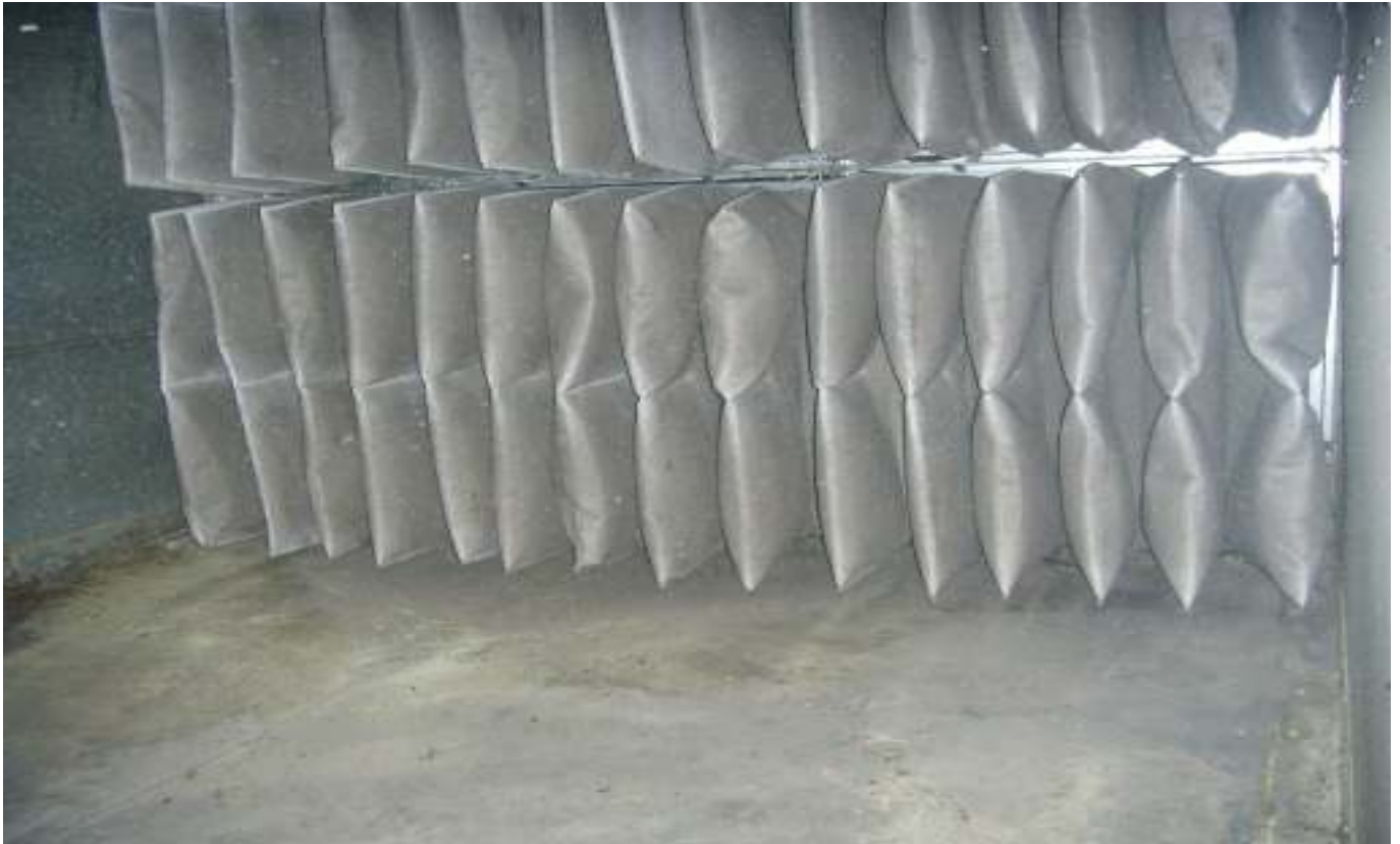
KUVA 20. Yleiskuva tuloilmakoneen 5TK1 esisuodatin kammiosta.
