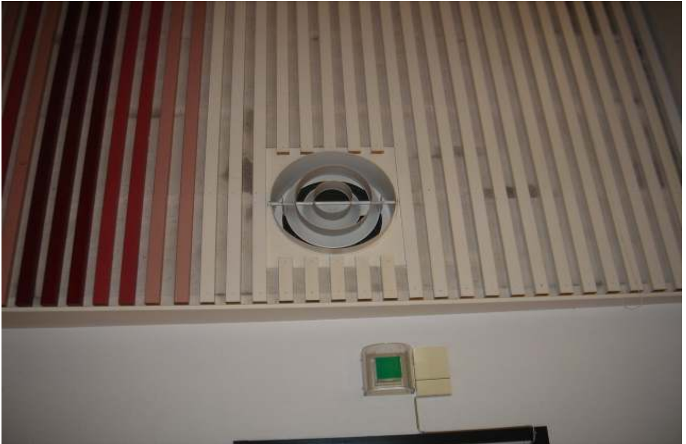
KUVA 30. Yleiskuva liikuntasalin tuloilmaelimestä.
