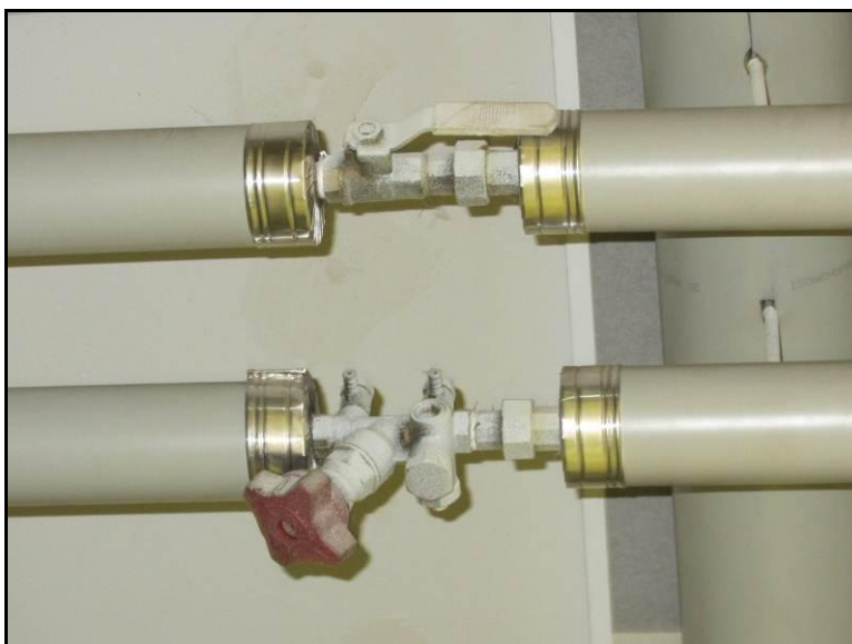
Yleiskuva lämpöjohtoverkoston sulku- ja säätöventtiileistä.
