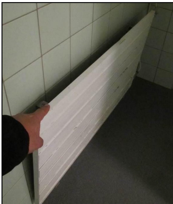
Rakennuksen VSS- tilassa havaittiin lähes irti oleva lämpimänkäyttöveden kiertovesipatteri.
