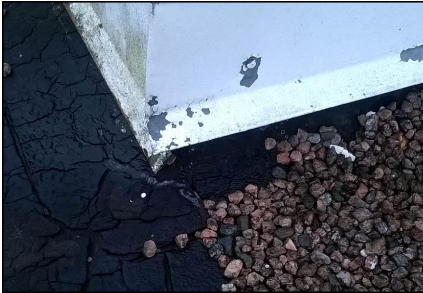
Vesikatteen tekninen käyttöikä on lopussa ja siinä havaittiin yleisesti halkeamia ja kulumia.
