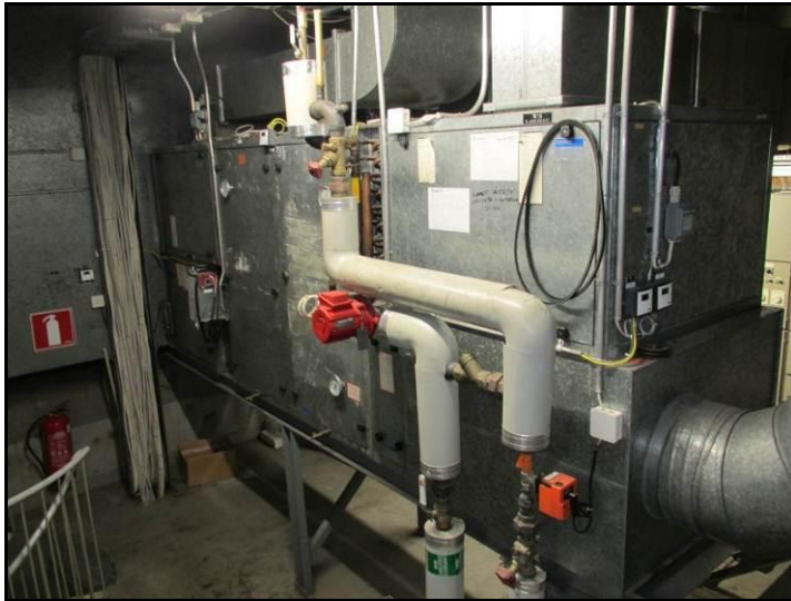
Ilmanvaihtokonehuoneessa sijaitseva alkuperäinen tuloilmakone.
