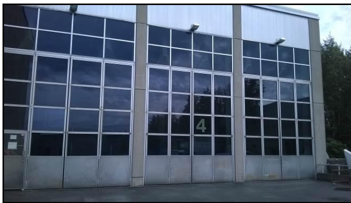
Autohallin suurissa ulko-ovissa esiintyy ilma- ja lämpövuotoja.
