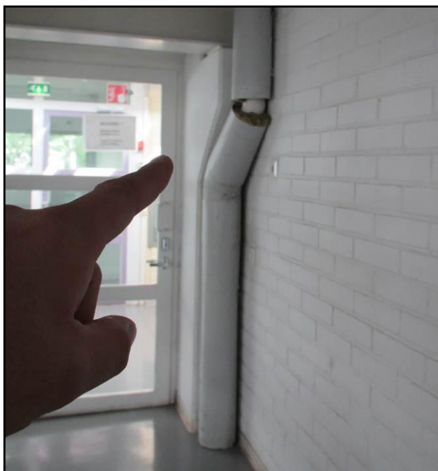
Rakennuksen sisäpuoliset sadevesiviemärit on eristetty.
