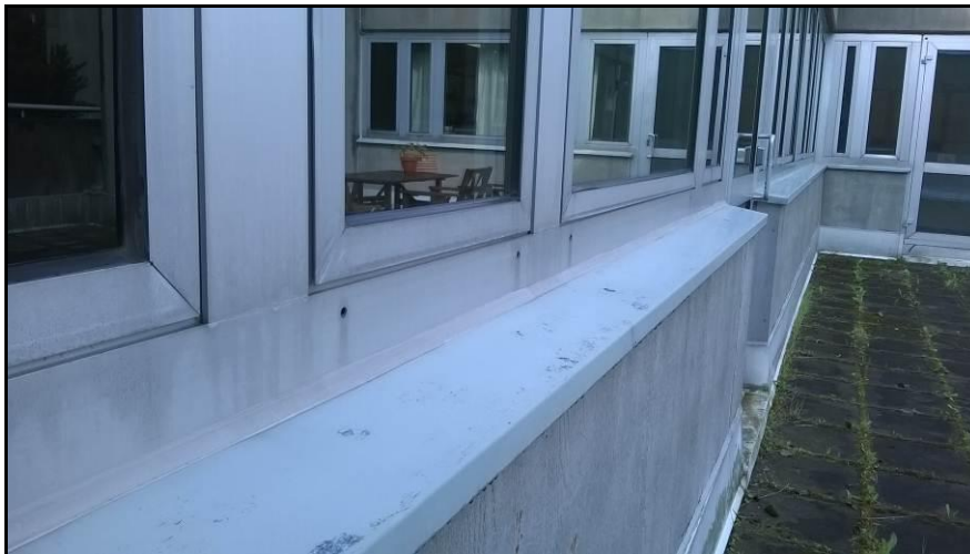
Ikkunat ovat metallirakenteisia ikkunoita, joista on koettu yleisesti lämpövuotoa.
