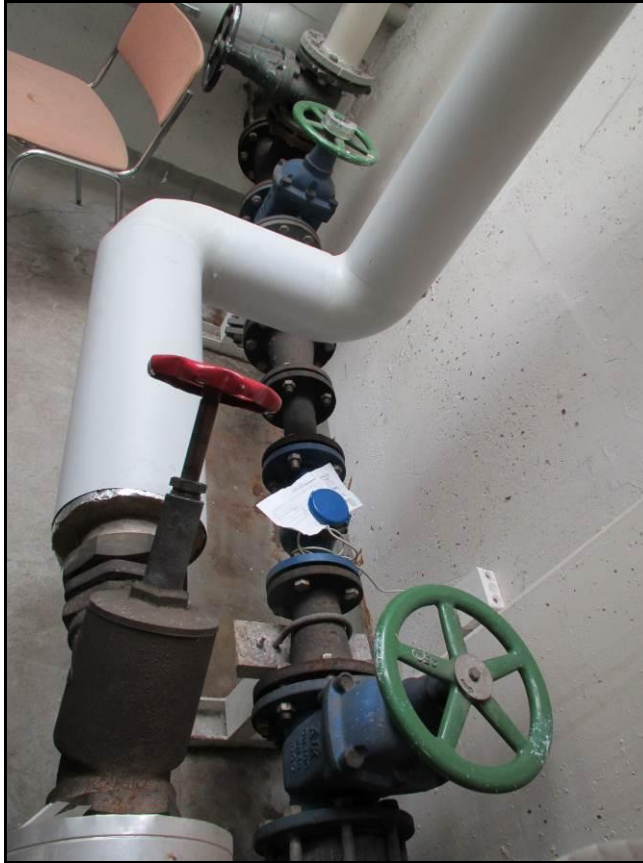
Päävesimittari sijaitsee lämmönjakohuoneessa.
