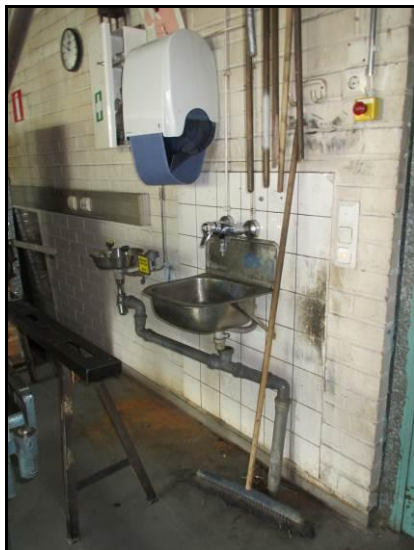
Tilojen pintarakenteet ovat vaihtelevassa kunnossa.
