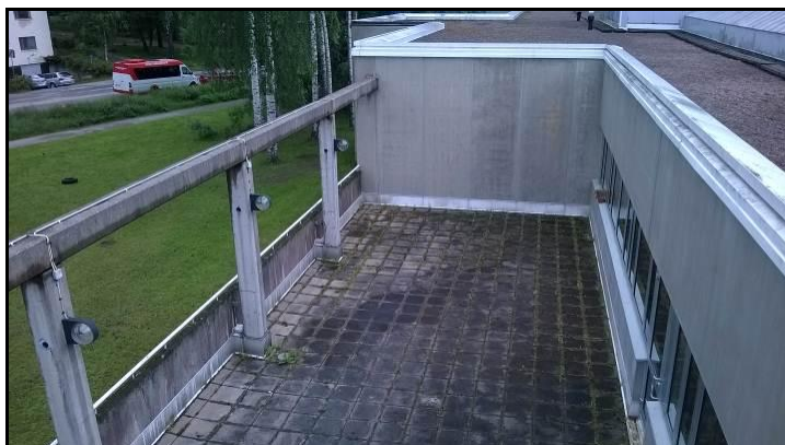
Ulkoterassi on heikossa kunnossa ja sen peruskorjaus on ajankohtaista.
