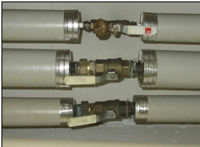
Yleiskuva käyttövesiverkoston sulku- ja säätöventtiileistä.
