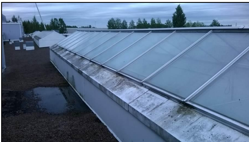
Kattoikkunoiden alapuoella havaittiin vuotojälkiä yleisesti.
