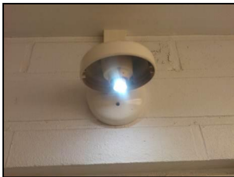
Ovimerkkivalaisimesta puuttuu kupu.
