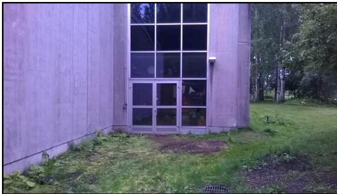
Maanpintojen kallistuksissa on paikallisia puutteita. Pääosin kallistukset ovat toimivat.
