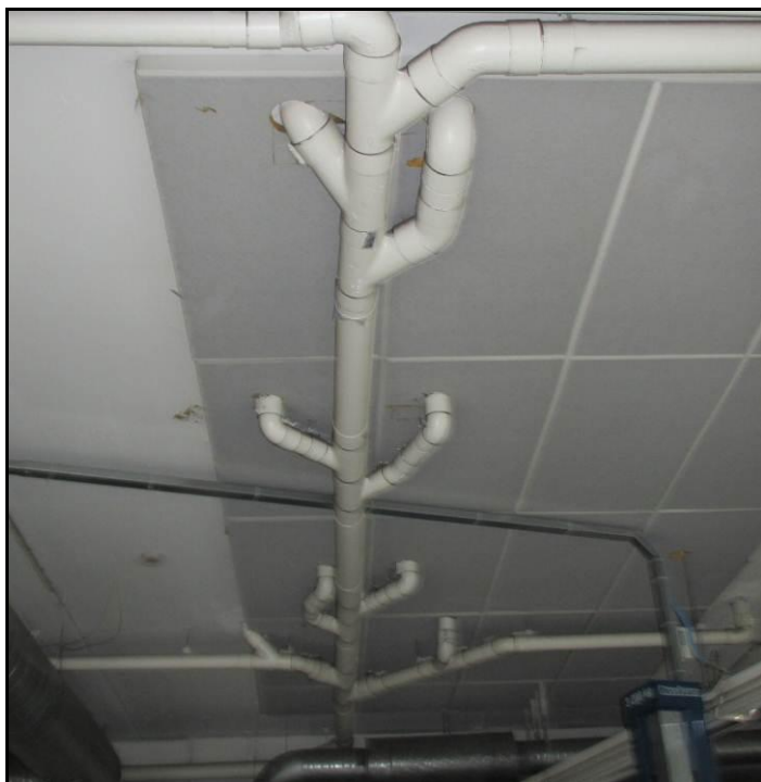
Rakennuksen sisäpuoliset jätevesiviemärit on tehty valurauta putkesta pantaliitoksin.
