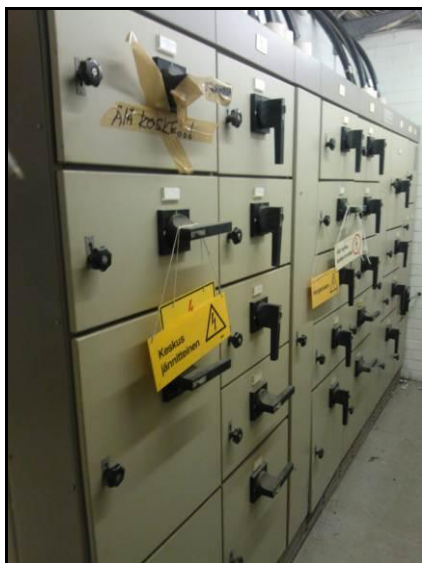
Kiinteistön vanhan osan pääkeskus
