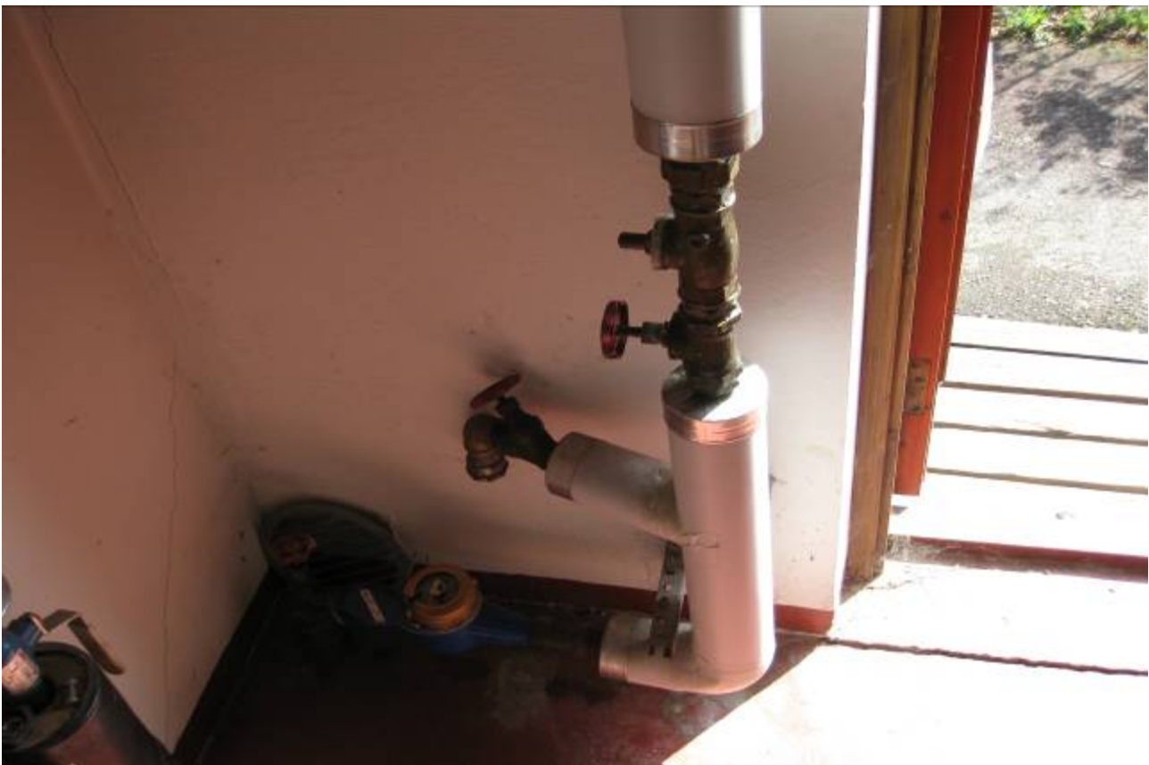
LVI-kuva 4. Yleiskuva vesimittarista ja pääsuluista.
