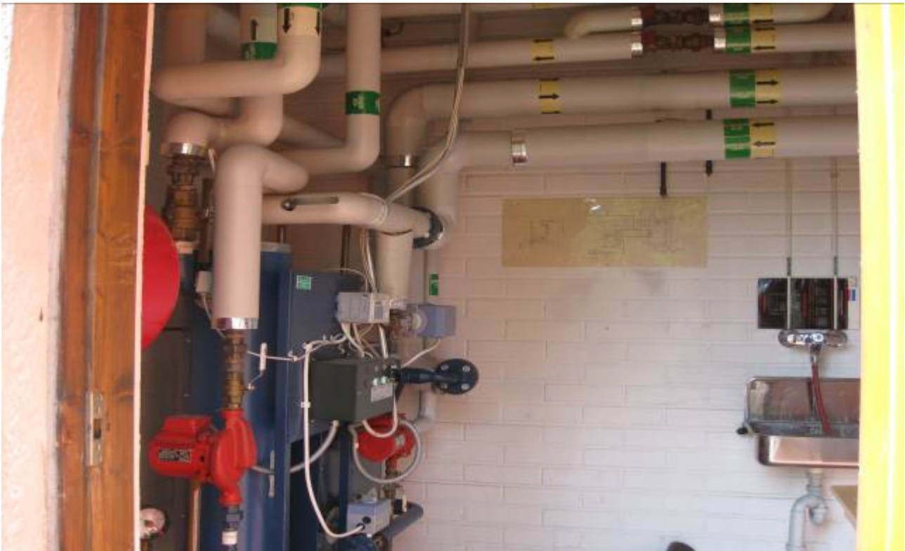
LVI-kuva 1. Yleiskuva lämmönjakuhuoneesta.
