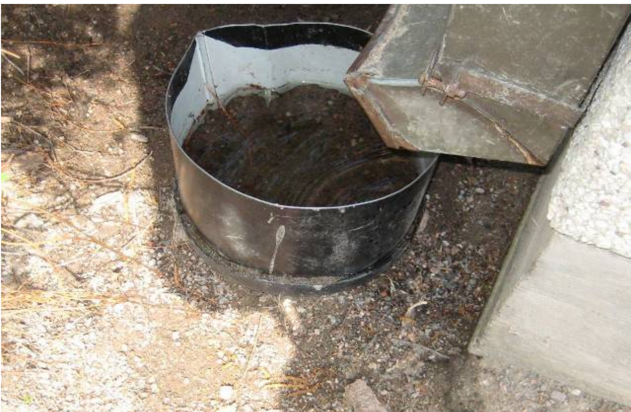
RAK-KUVA 6. Syöksytorven alla oleva sadevesisuppilo oli puhdistamatta.
