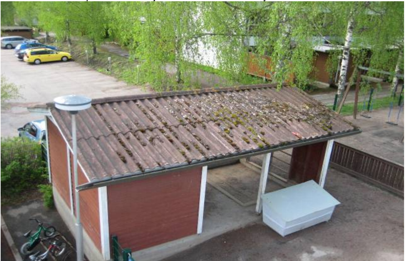
RAK-KUVA 4. Ulkopuoliset katos- ja varastorakenteet edellyttävät huoltokunnostusta.
