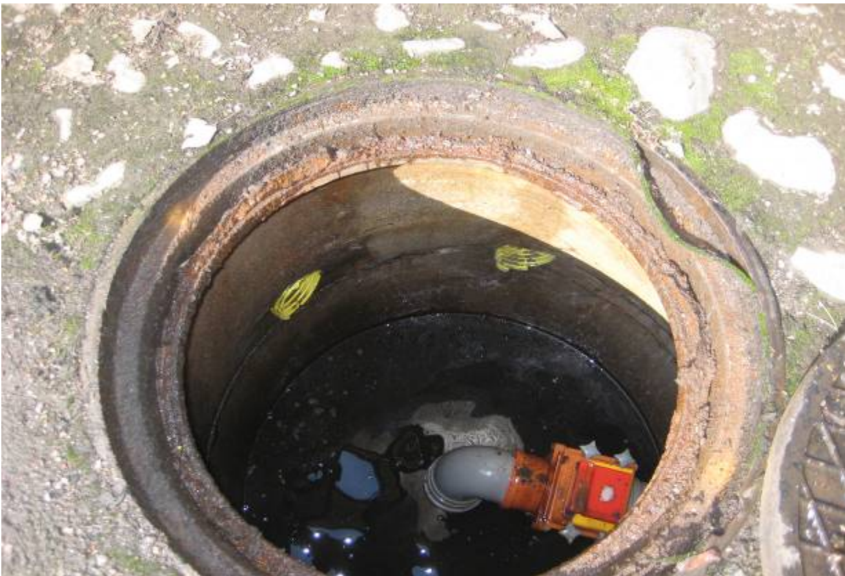
RAK-KUVA 8. Salaojarakenteen kokoojakaivo.
