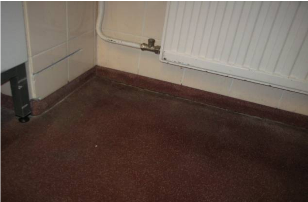
RAK-KUVA 9. Lattiarakenteiden ja seinärakenteiden liittymäkohdissa esiintyi merkkejä maanvaraisten alapohjarakenteiden painumisesta.
