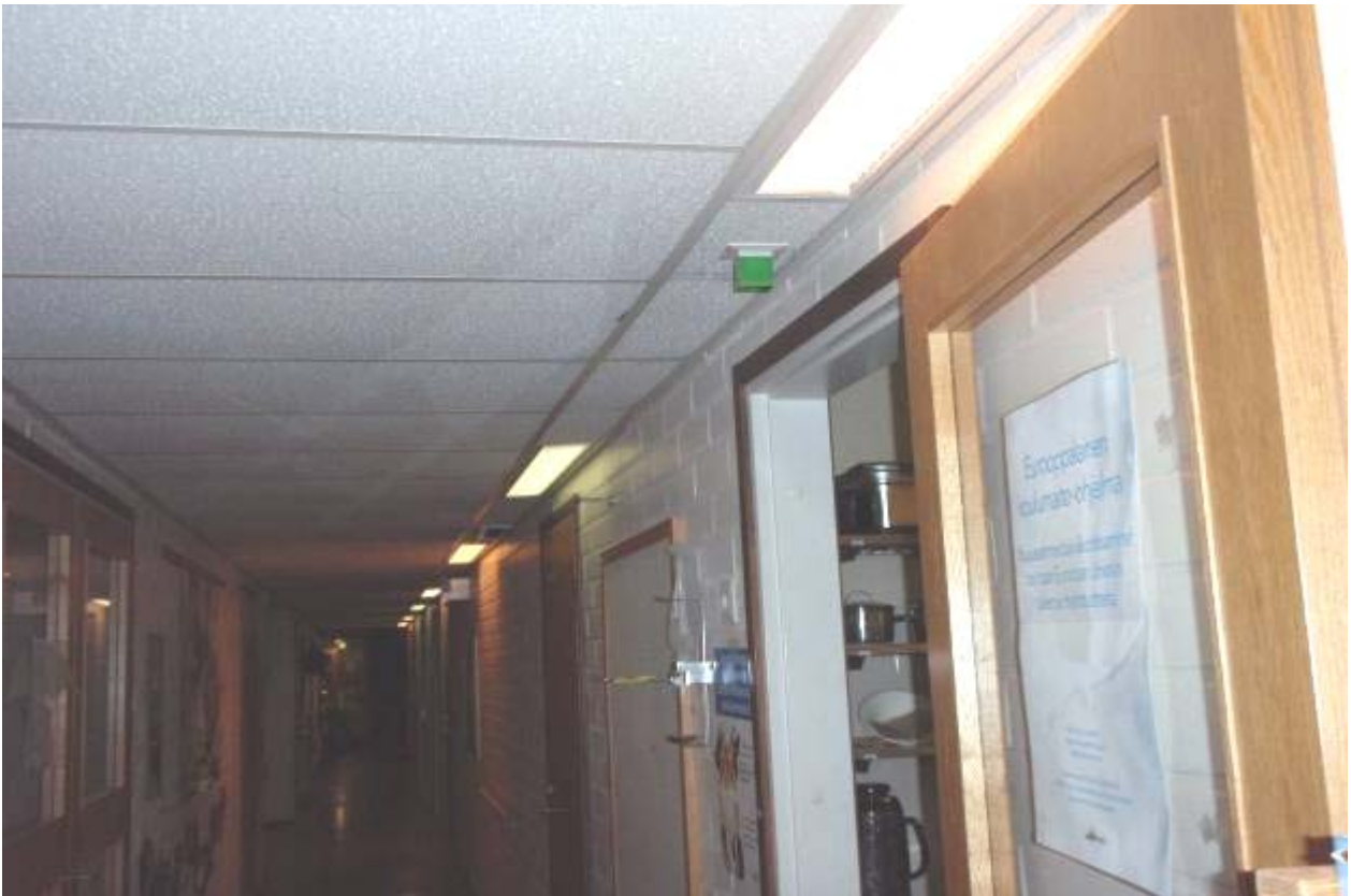
S-KUVA 7. Käytävän valaistus alkuperäinen osa
