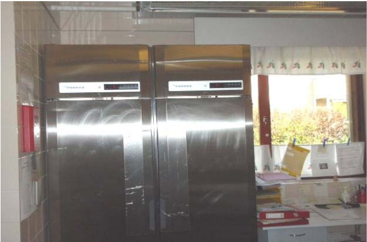
S-KUVA 11. Keittiön kylmälaitteet
