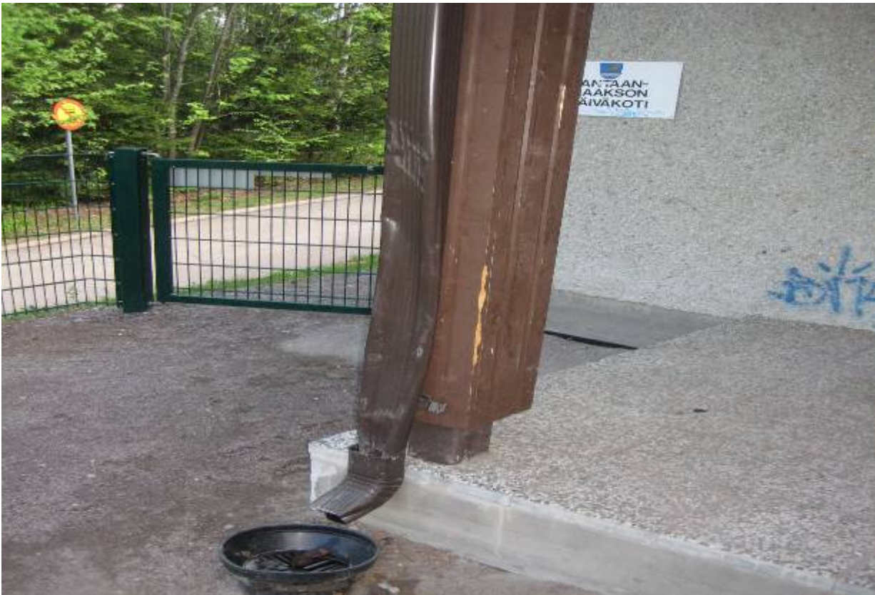
RAK-KUVA 7. Syöksytorvissa on mekaanisia vaurioita.
