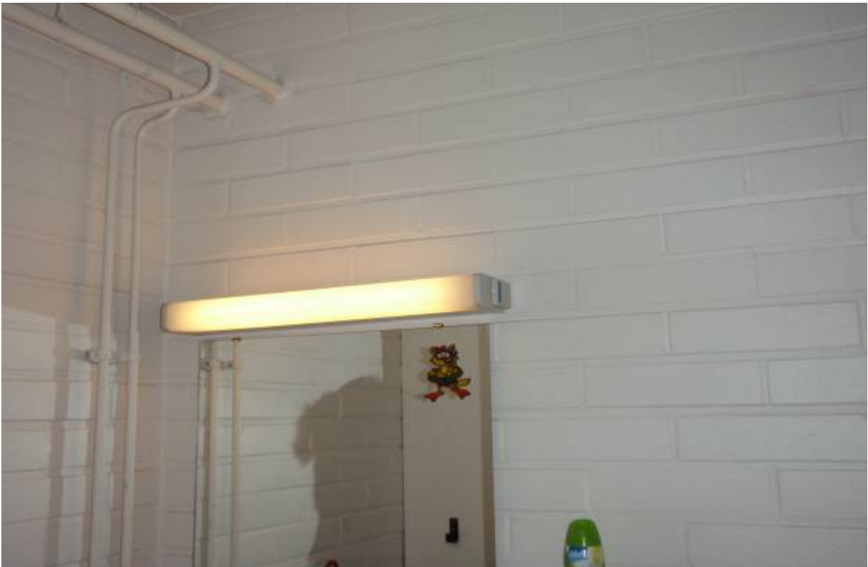
S-KUVA 9. WC- tilojen valaistus
