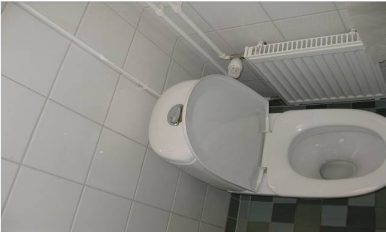
LVI-kuva 8. Yleiskuva uusista wc-istuimista.
