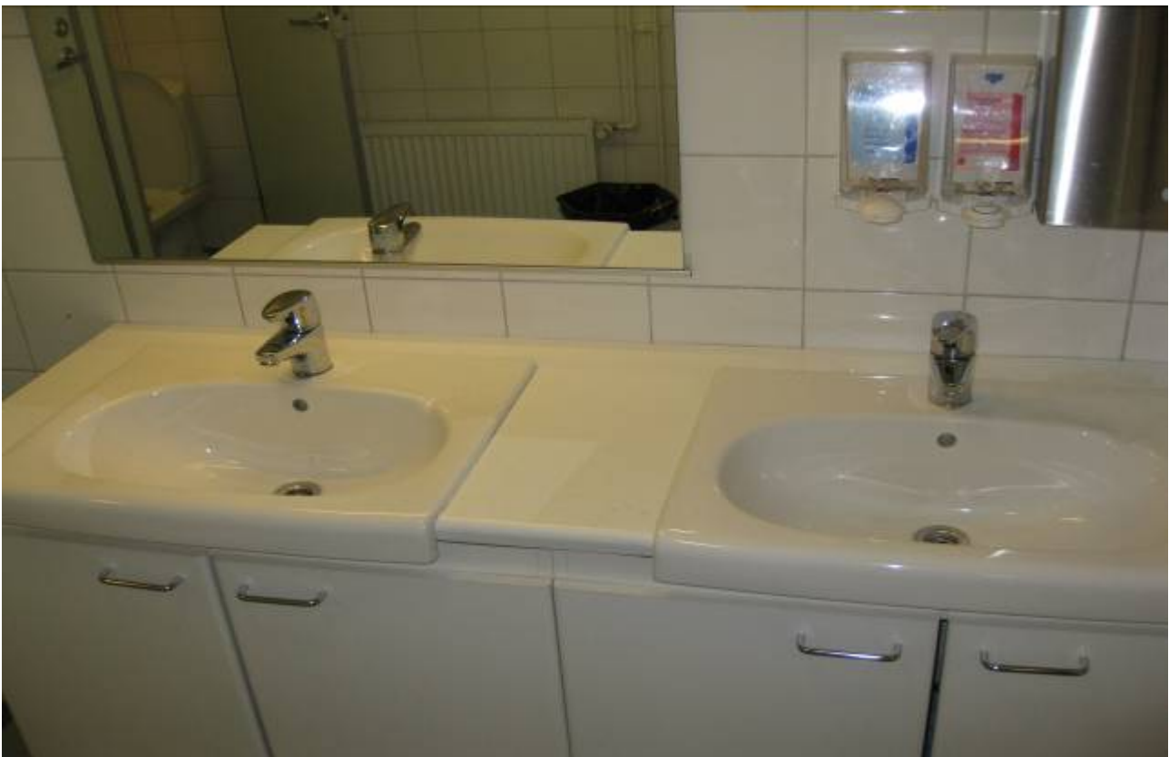
LVI-kuva 6. Yleiskuva uusista vesikalusteista.
