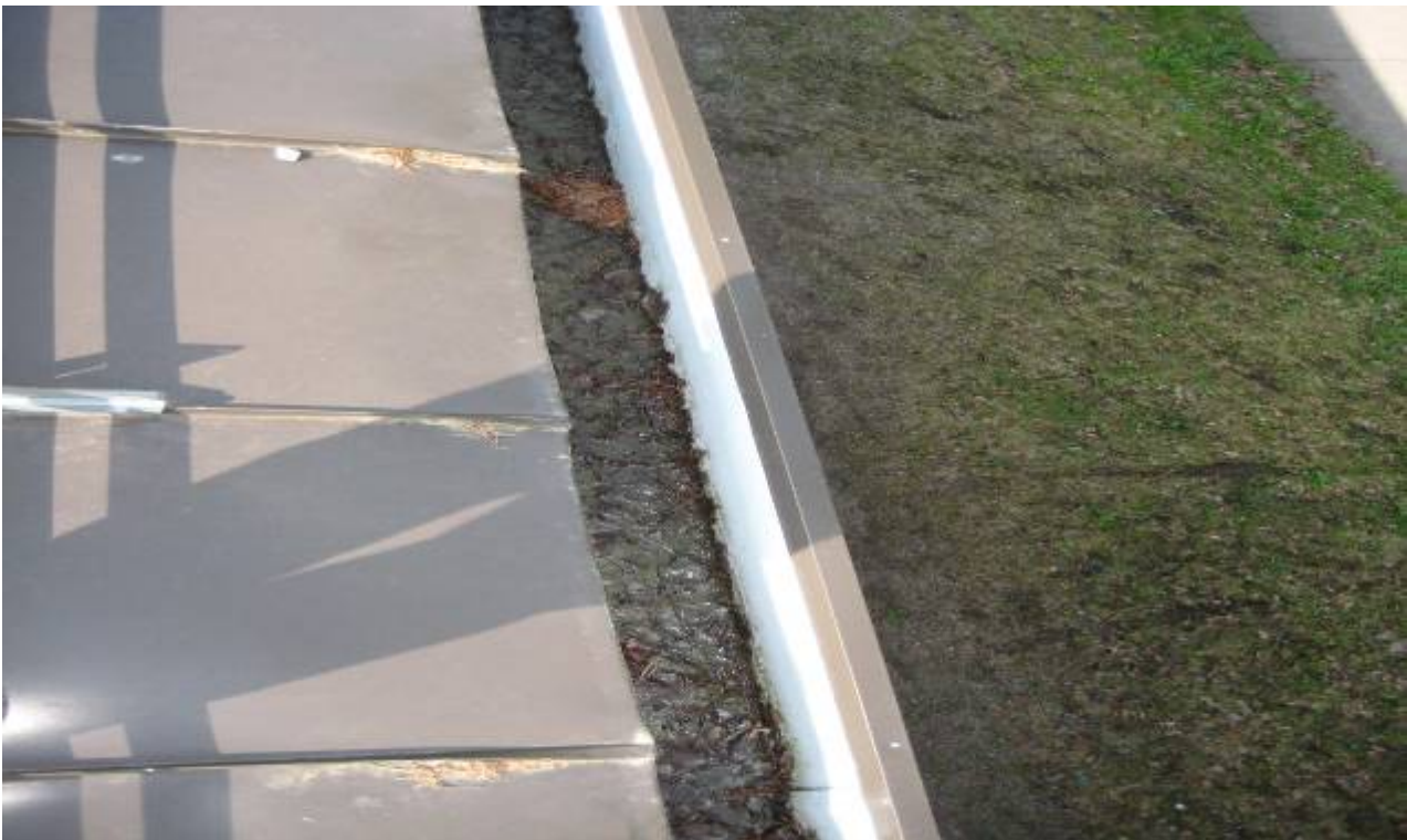
RAK-KUVA 12. Räystäskoururakenteiden puhdistukseen tulee kiinnittää nykyistä enemmän huomiota.
