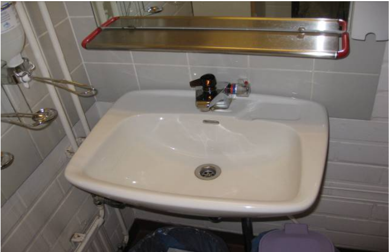
LVI-kuva 5. Yleiskuva vanhoista vesikalusteista.
