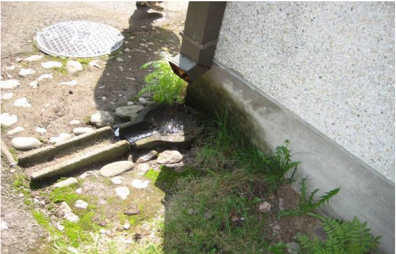
RAK-KUVA 5. Betonirakenteisissa sadevesikourujen asennuksissa esiintyy puutteita.
