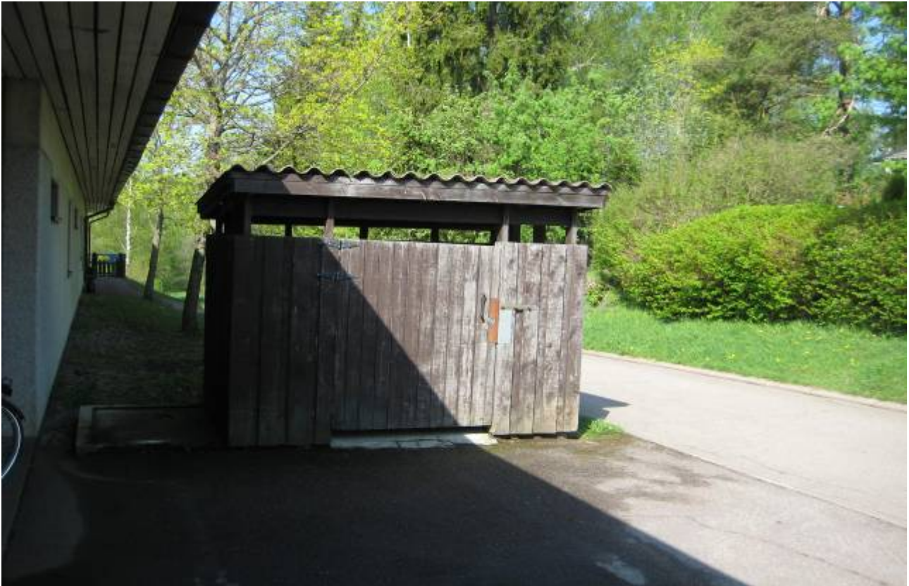
RAK-KUVA 3. Ulkopuoliset katos- ja varastorakenteet edellyttävät huoltokunnostusta.
