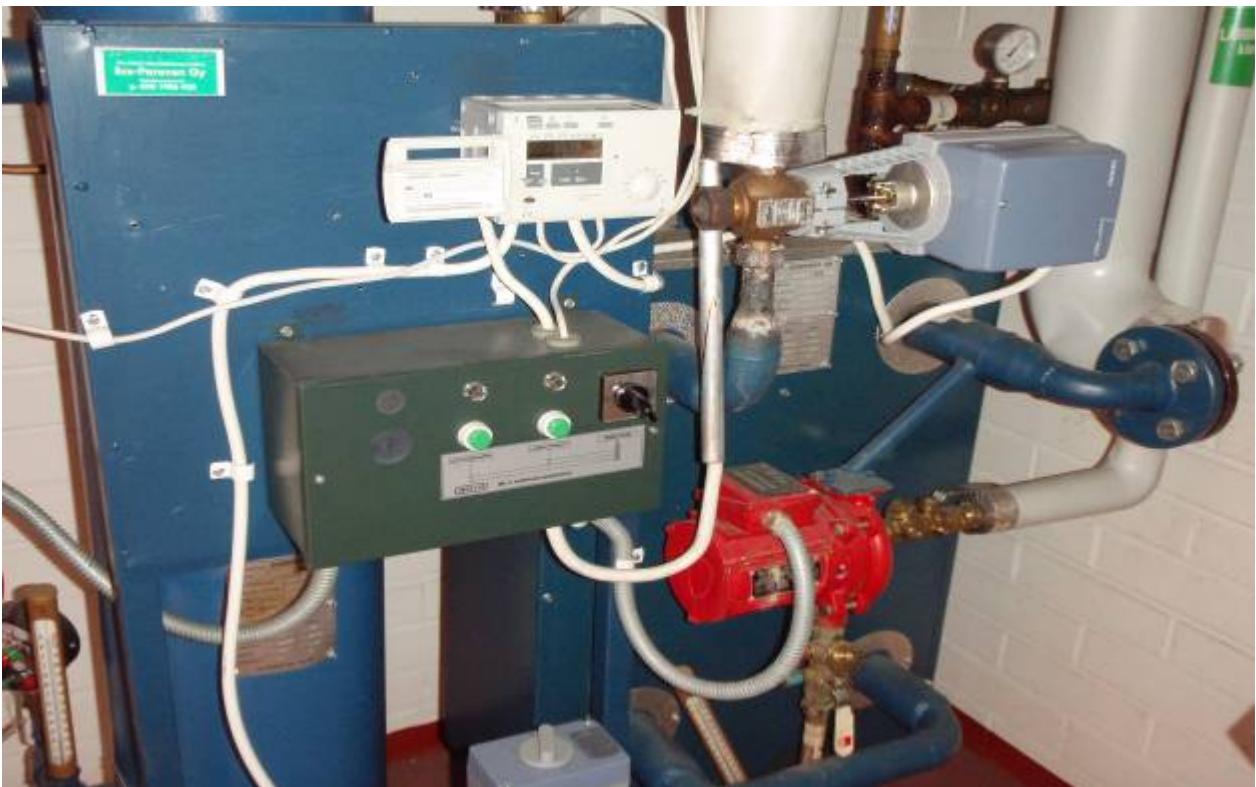
S-KUVA 14. Lämmönjaon rakennusautomaatiojärjestelmä
