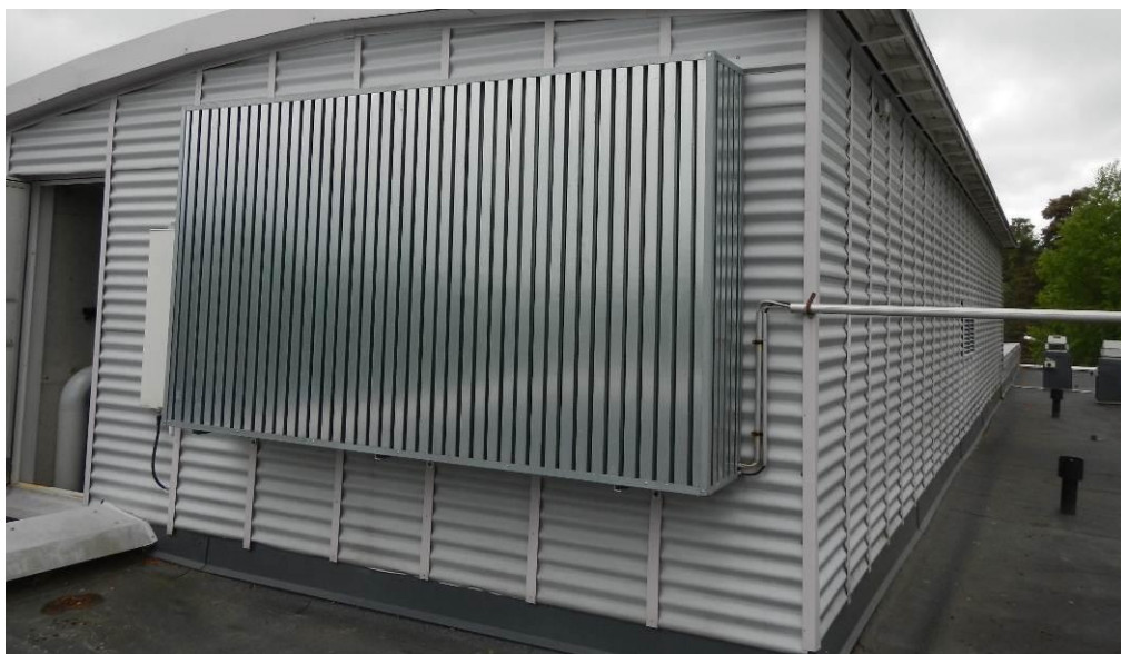
Kuva 4. Tuloilmakoneiden ulkoilmasäleikköön on asennettu lumisieppari, joka estää lumen ja veden pääsyn raitisilmakammioon.
