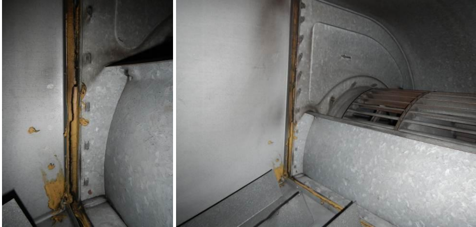
Kuvat 29-30. Tuloilmapuhaltajan ja kammion välinen tiiviste on repeytynyt ja siinä tapahtuu ohivirtausta. Suosittelemme uusimaan puhaltajan ja kammion välisen tiivistyksen.
