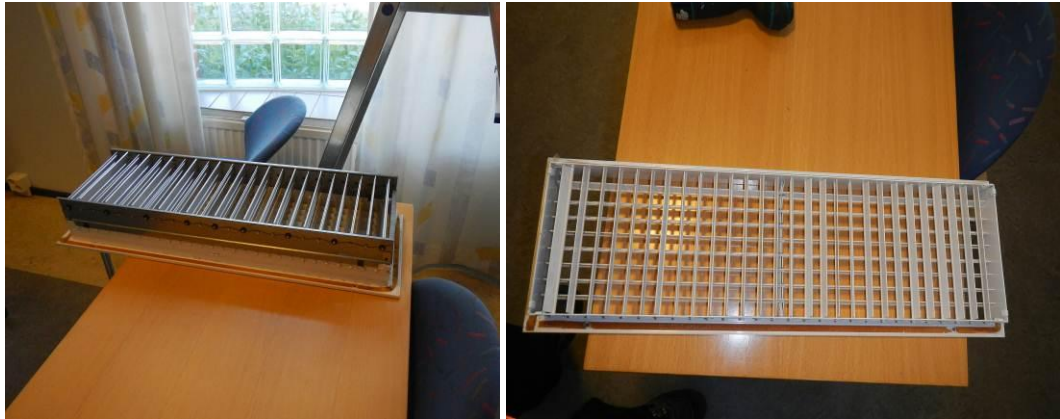
Kuvat 45-46. Tuloilman pääte-elimessä on säätöpelti, mutta poiston pääte-elimestä se puuttuu.
