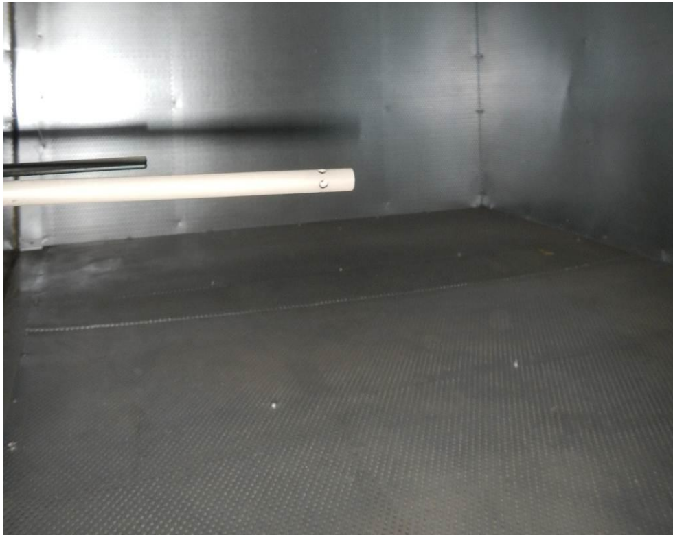
Kuva 31. Tuloilmakoneen tuloilmakammiossa on mineraalivilla. Kammioista saattaa päästä villakuituja huoneilmaan. Suosittelemme kammioiden mineraalivillapintojen poistoa ja kammioiden pellitystä.
