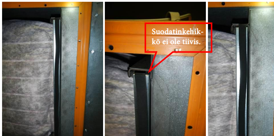
Kuvat 13-14-15. Tuloilmakoneessa on asennettuina pussisuodattimet, jotka on vaihdettu 20.6.2012. Suodatinkehikön tiivisteet ovat rikki. Suosittelemme uusimaan tiivisteitä suodattimen vaihdon yhteydessä.
