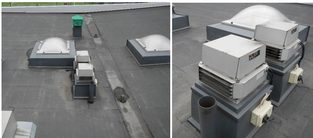
Kuvat 37-38. Yleiskuvat vesikatolla olevista huippuimureista.
