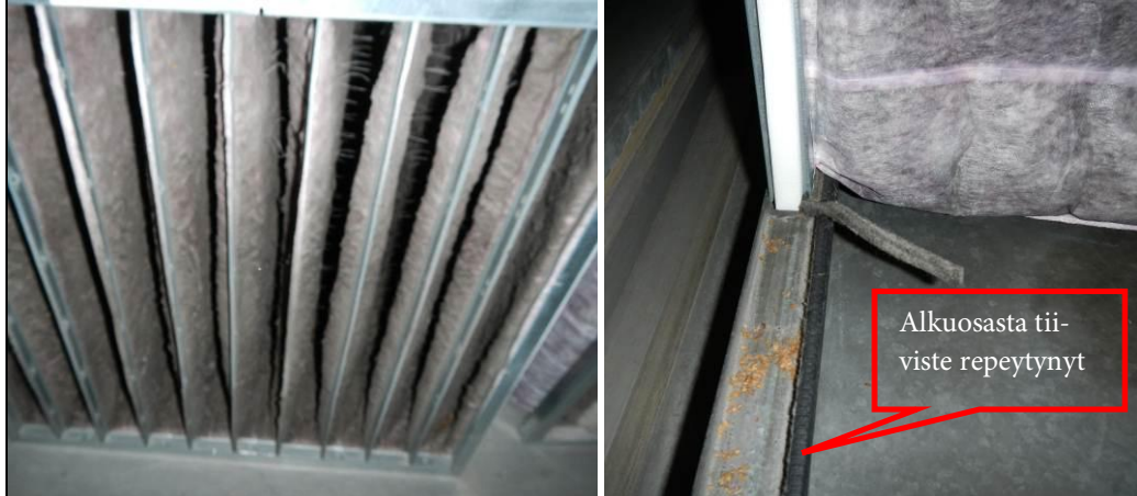
Kuvat 5-6. Tuloilmakoneissa on asennettuina pussisuodattimet, jotka on vaihdettu 20.6.2012. Suodatinkehikon tiivisteet ovat rikkoontuneet ja kuluneet. Suosittelemme uusimaan tiivisteitä suodattimien vaihdon yhteydessä.
