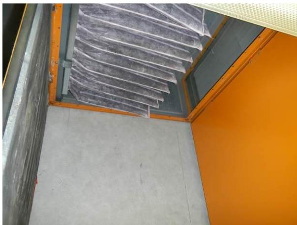
Kuva 32. Tuloilmakoneessa on asennettuina pussisuodattimet, jotka on vaihdettu 20.6.2012. Suosittelemme uusimaan suodattimet ja suodatin kehyksen tiivisteet perushuollon yhteydessä. Samalla tulee uusia suodattimien paine-eromittari.
