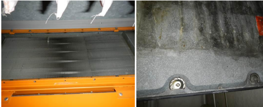
Kuvat 33-34. Ilmanvaihtokoneen sisäpinnoilla on havaittavissa epäpuhtauksia. Suosittelemme puhdistamaan ilmanvaihtokoneen kammiot kokonaisvaltaisesti perushuollon yhteydessä.
