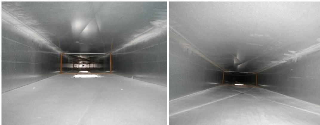
Kuvat 41-42. Poistoilmakanava ja tuloilmakanava.
