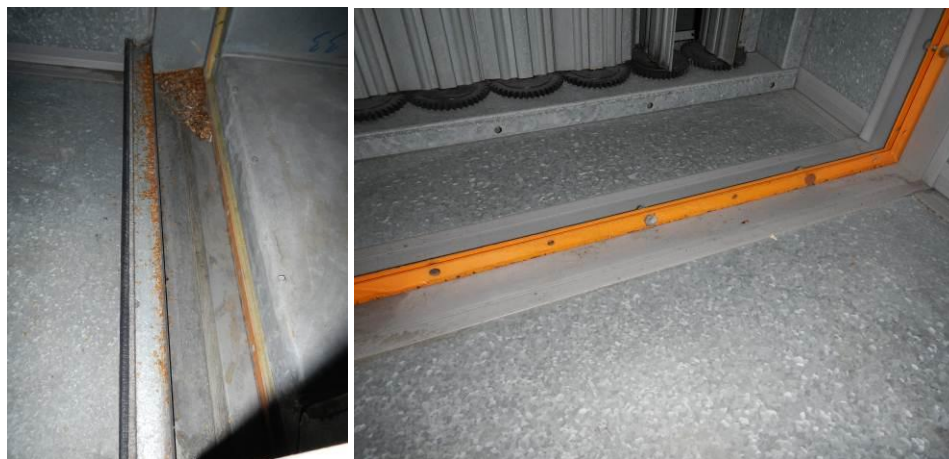
Kuvat 16-17. Ilmanvaihtokoneen sisäpinnoilla on havaittavissa pölykertymää ja roskia. Suosittelemme puhdistamaan ilmanvaihtokoneen kammiot kokonaisvaltaisesti perushuollon yhteydessä.
