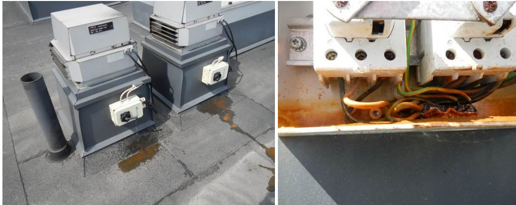
Kuvat 39-40. Huippuimureiden turvakytkimissä on vettä ja turvakytkin on rikki (IPF3).
