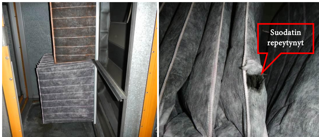
Kuvat 23-24. Tuloilmakoneessa on asennettuina pussisuodattimet, jotka on vaihdettu 20.6.2012. Yksi suodatin on repeytynyt ja suodatinkehikon tiivisteet ovat rikki. Suosittelemme uusimaan suodattimet ja suodatin kehiksen tiivisteet perushuollon yhteydessä.
