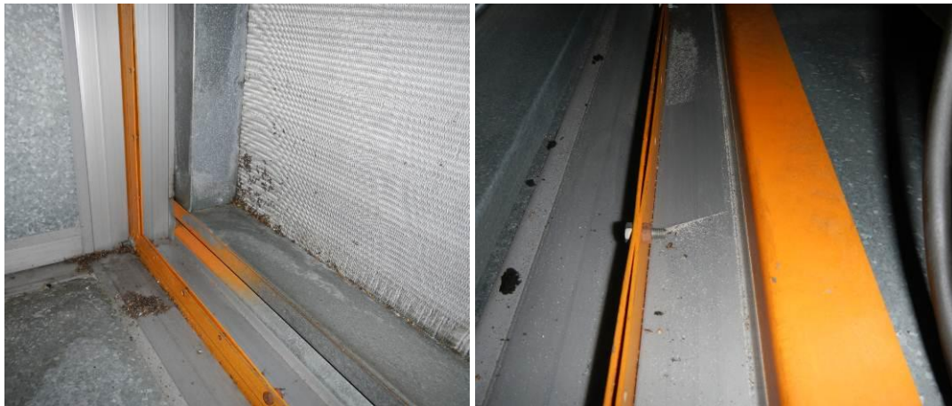
Kuvat 7-8. Ilmanvaihtokoneen sisäpinnoilla ja LTO- patterissa oli havaittavissa pölykertymää ja roskia. Suosittelemme puhdistamaan ilmanvaihtokoneen kokonaisvaltaisesti korjausten perushuollon yhteydessä.
