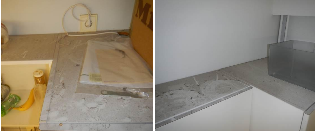
Kuvat 52-53. Kaappien päällä on pölykertymää.
