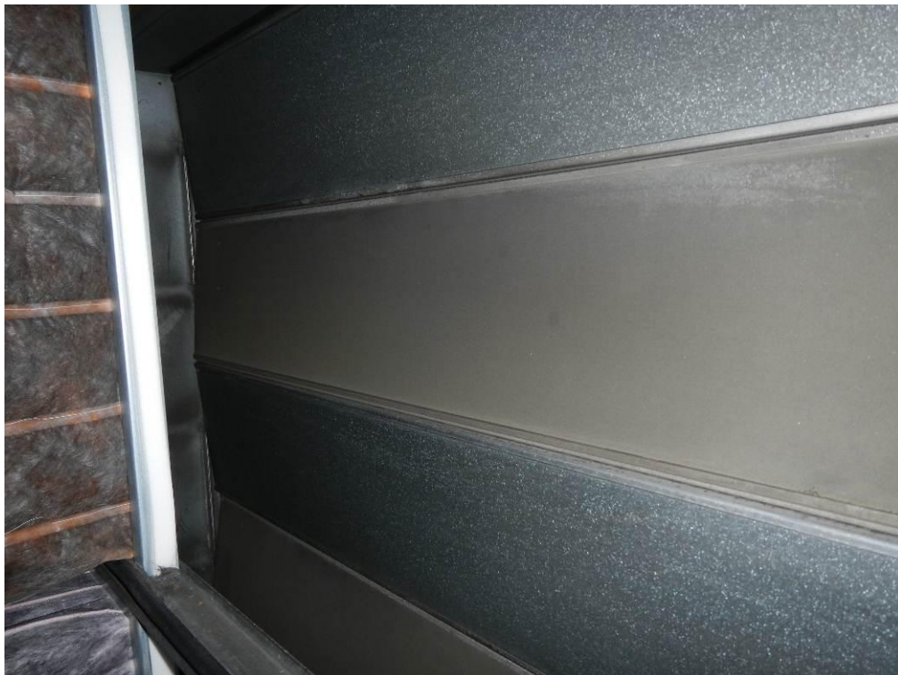
Kuva 22. Tuloilmapuhaltimen raitisilmapelti ei sulkeudu täysin. Suosittelemme säätämään peltimoottorin niin, että pelti sulkeutuu tiiviisti perushuollon yhteydessä.
