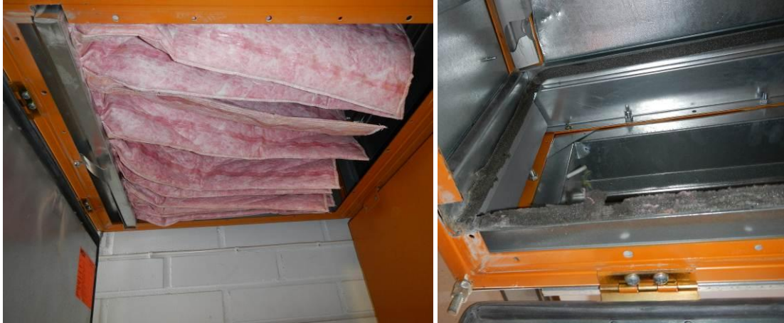
Kuvat 35-36. Tuloilmakoneessa on asennettuina pussisuodattimet, jotka oli juuri vaihdettu. Suosittelemme uusimaan suodatin kehyksen tiivisteitä seuraavan suodatin vaihdon yhteydessä.
