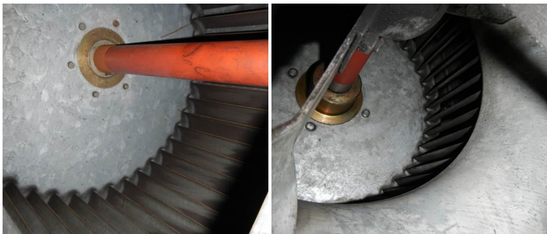
Kuvat 9-10. Tulo- ja poistoilmapuhaltimet ovat pölyiset/nokiset ja niiden puhdistamista suosittelemme perushuollon yhteydessä.
