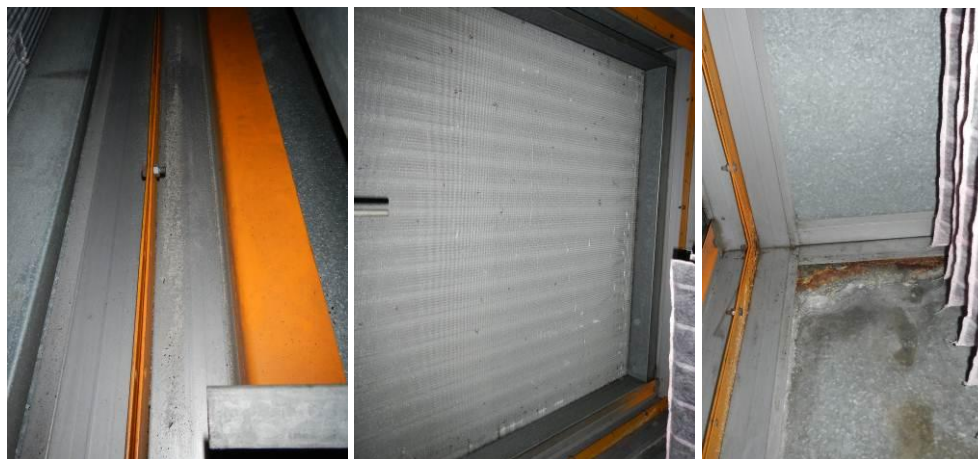
Kuvat 25-26. Ilmanvaihtokoneen sisäpinnoilla on havaittavissa pölykertymää ja roskia. Suosittelemme puhdistamaan ilmanvaihtokoneen kammiot kokonaisvaltaisesti perushuollon yhteydessä. Puhdistuksen jälkeen ruosteiset kohdat on syytä maalata.
