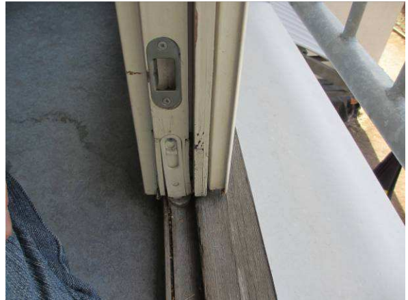
yläkerroksen päädyn oviliittymä ei ole tiivis, vettä pääsee liittymästä matolle
