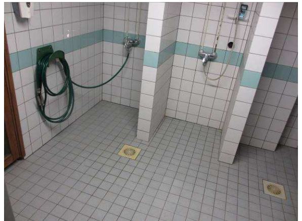
Pohjakerroksen pesutiloissa pinnoilla irtovettä, ei voitu mitata
