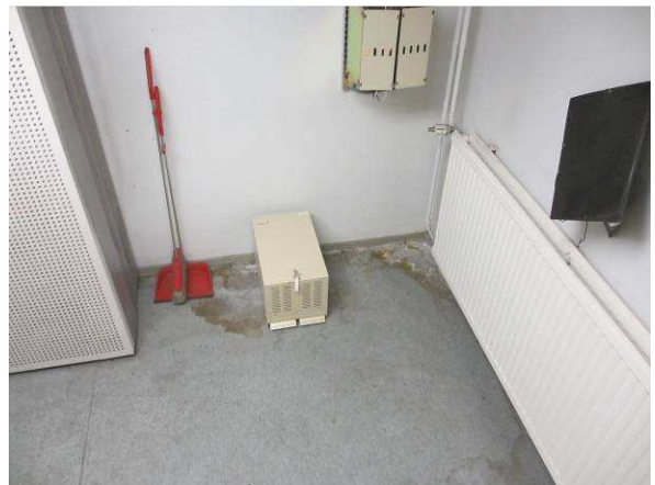
Porrashuoneen seinän alaosassa selviä kosteusvauriojälkiä
