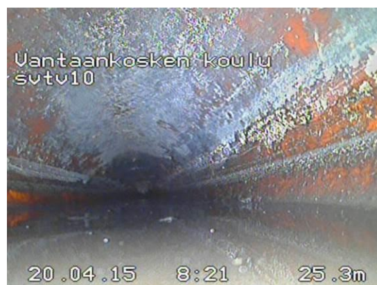
Kuva 26. Painumasta johtuvaa vesitäyttöä sadevesiviemäriässä, svtv10.
