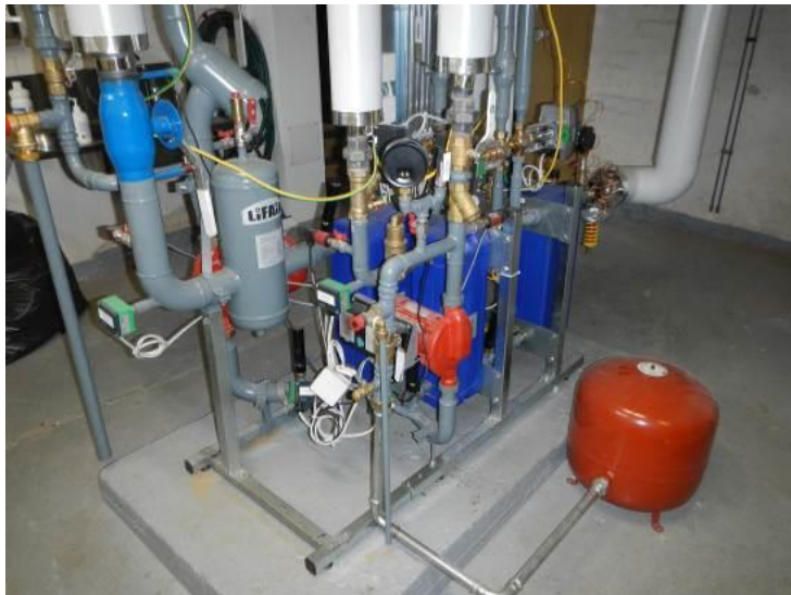
Kuva 1. Kaukolämmön alajakokeskus varusteineen.
