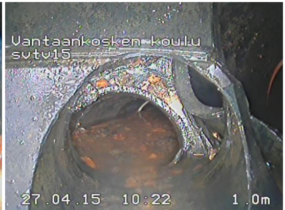
Kuva 31. Linjan svtv15 liitos rikki kaivossa svk1, pesun jälkeen.
