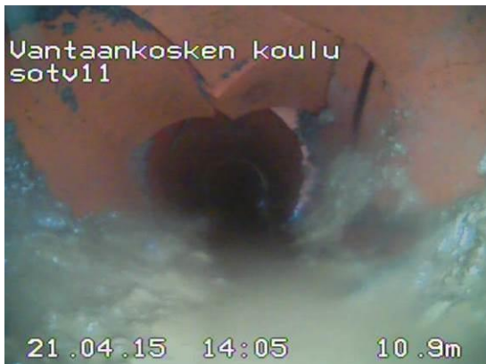
Kuva 41. Ruukkusalaoja vaurioitunut, sotv11.
