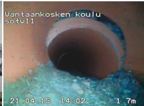
Kuva 40. Hiekkaa ja liitoksia auki ruukkusalaojassa, sotv11.
