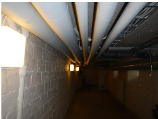
Kuva 8. Käyttöveden runkojohtoja kellari-kerroksessa.
