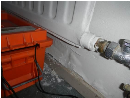
Kuva 39. Kosteusvauriojälkiä osan A kellarin seinällä.
