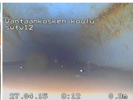
Kuva 27. Painumasta johtuvaa vesitäyttöä sadevesiviemäriässä, svtv12.
