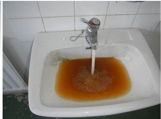
Kuva 13. Ruosteista/likaista vettä kuuma-vesipuolella.
