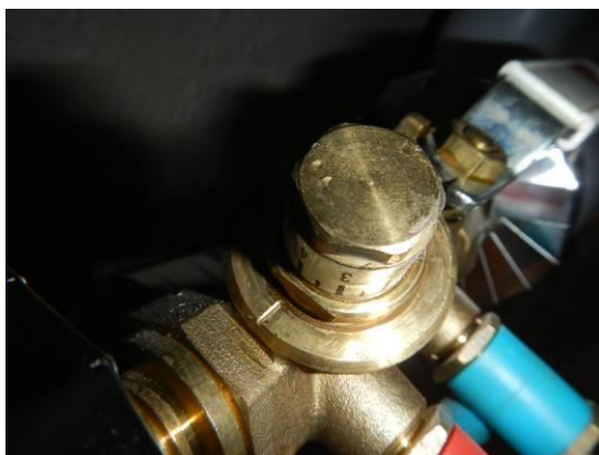
Kuva 16. Virtaamat säädetty linjasäätöventtiilin näyttötaulun mukaan.
