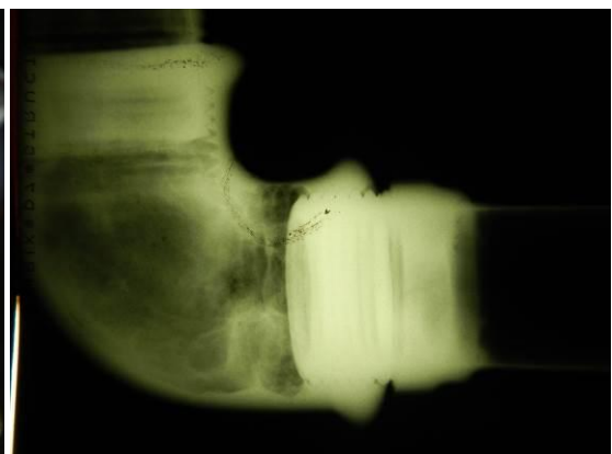
Kuva 17. Syvä syöpymä sinkityn kylmävesiputken kulmaosassa.
