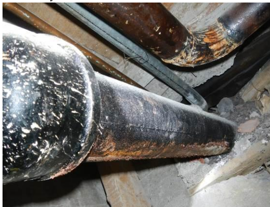
Kuva 20. Valurautaviemärin alapinta ruosteinen, läpisyöpymisen merkkejä.
