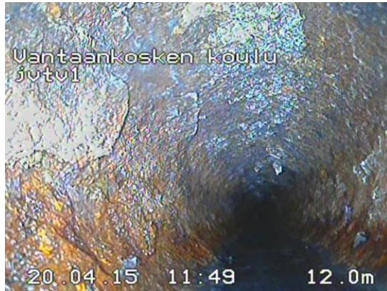
Kuva 22. Pohjaviemäri sisäpinnaltaan ruosteinen, lastumaista ruostetta.
