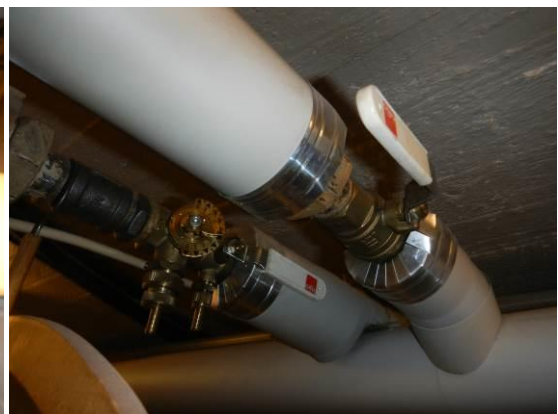
Kuva 3. Lämpöjohtoverkoston linjasulku- ja säätöventtiileitä.
