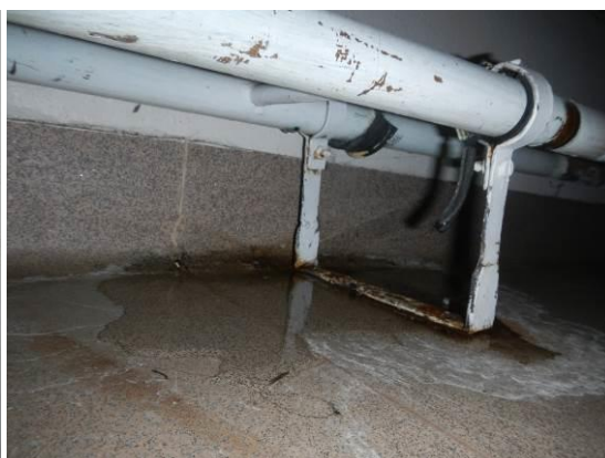
Kuva 11. Kiertovesiputkipatterissa aktiivinen tihkuvuoto.
