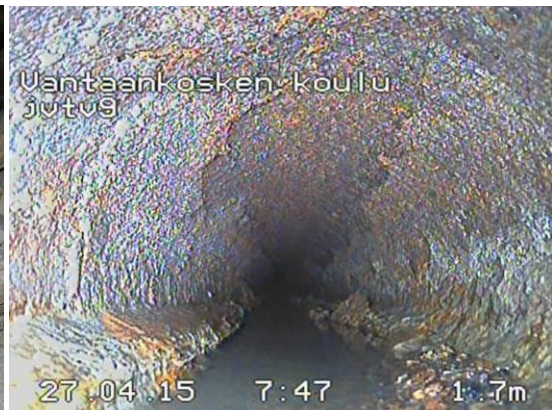
Kuva 21. Pohjaviemäri sisäpinnaltaan ruosteinen, lastumaista ruostetta.
