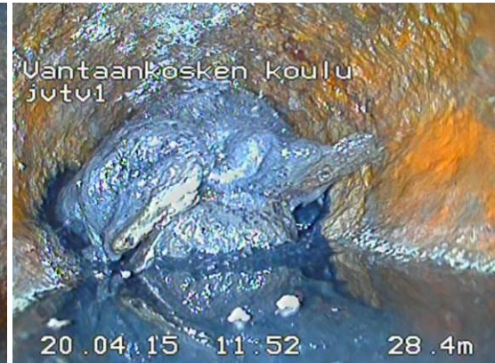
Kuva 23. Tukkeuma pohjaviemärissä jvtv1.
