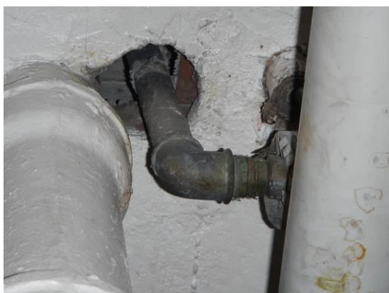
Kuva 10. Asuntojen nousujohdot kylmän käyttöveden osalta sinkittyä teräsputkea.
