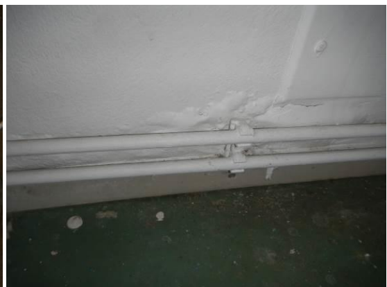
Kuva 38. Kosteusvauriojälkiä osan A kellarin seinällä.
