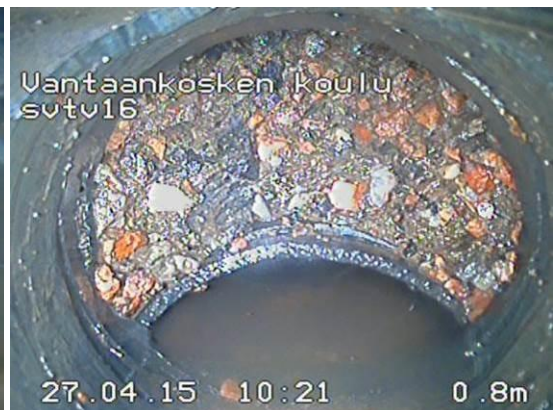
Kuva 33. Linjan svtv16 liitos rikki kaivossa svk1, pesun jälkeen.
