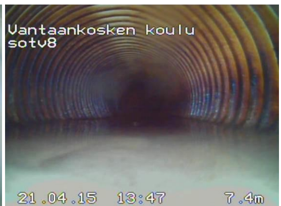
Kuva 44. Painumasta johtuvaa vesitäyttöä, sotv8.
