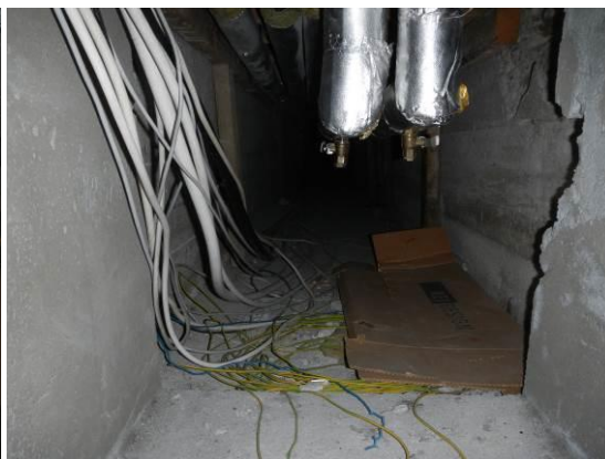
Kuva 9. Käyttöveden runkojohtoja putkitunnelissa.
