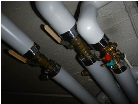
Kuva 14. Käyttövesiverkoston linjasulku- ja säätöventtiileitä.
