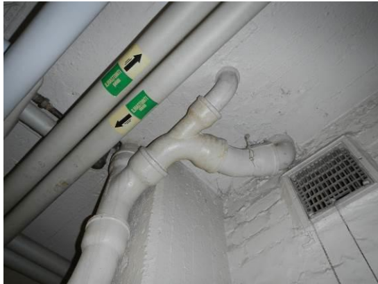
Kuva 18. Vanhoja valurautaviemäreitä lämmönjakohuoneessa.
