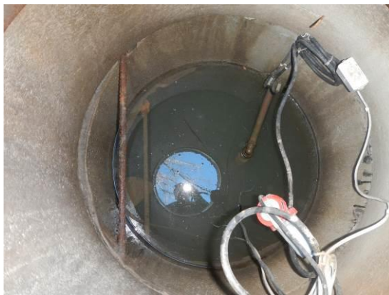
Kuva 35. Perusvesipumppaamo PVP1. vedenpinta korkealla, koho veden alla, pumppu ei käynnistynyt.
