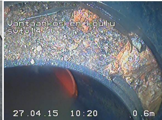
Kuva 29. Linjan svtv14 liitos rikki kaivossa svk1.
