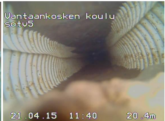
Kuva 42. Painumasta johtuvaa vesitäyttöä, sotv5.
