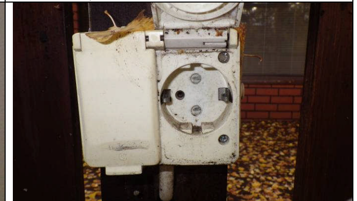
35. Vaurioitunut ja hapettunut ulkopistorasia
