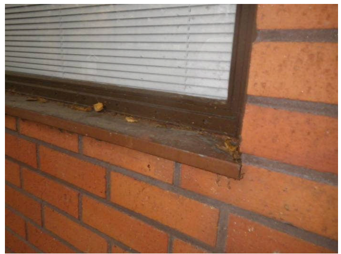
12. Vesipellin väärää kaatoa
