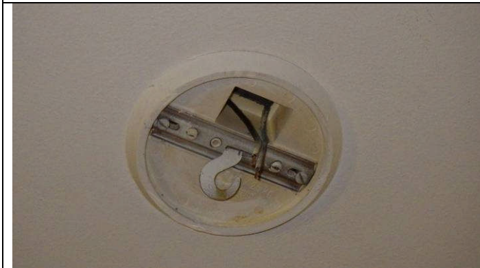
34. Suojaamattomia johtimia kattorasiassa
