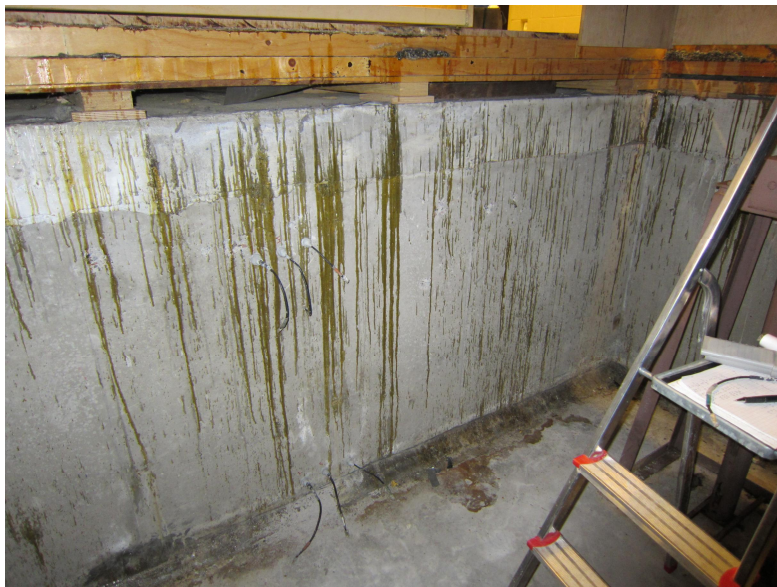
Kuva 5. Liikuntasalin näyttämön alla oleva maanvastainen syvennyks on noin 150 cm syvä. Syvennyksen seinärakenteissa olevat valumajäljet ovat todennäköisesti liikuntasalin pintarakenteissa käytettyä lakkaa.
