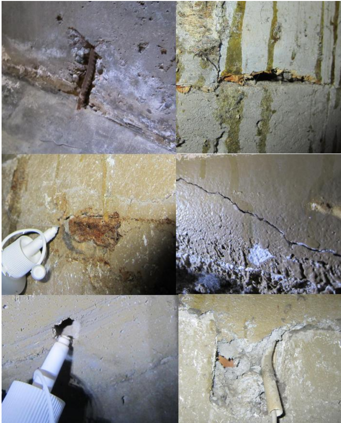
Kuva 9–14. Ilmavuotoja havaittiin ulkoseinällä ja maanvastaisissa rakenteissa olevien reikien ja halkeamien kohdilla.
