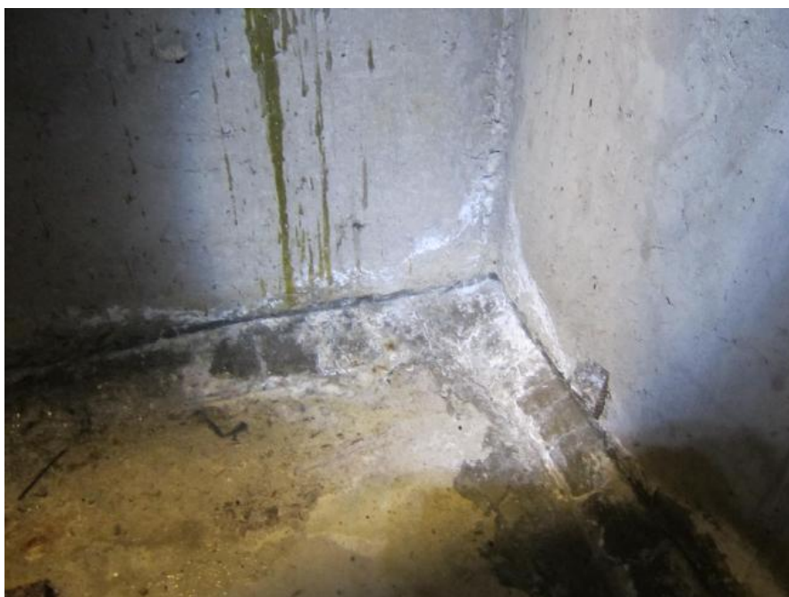
Kuva 6. Näyttämön alla olevan syvennyksen betonirakenteisissa seinä- ja lattiapinnoissa oli havaittavissa maaperästä kapillaarisesti tulevan kosteuden aiheuttamia jälkiä.
