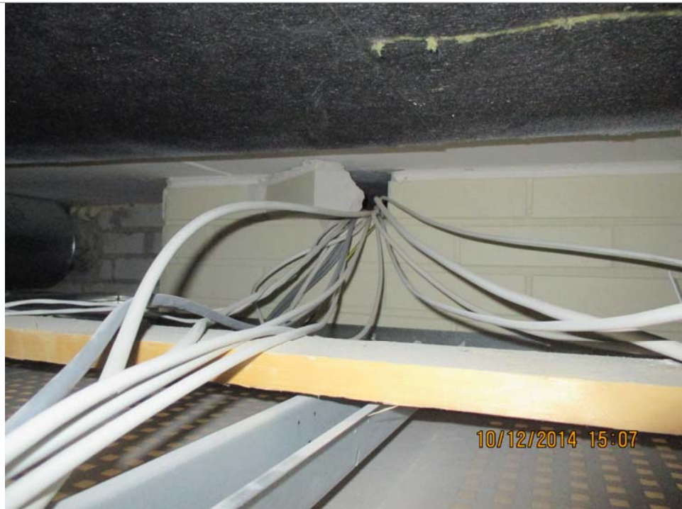
Kuva 11: Sähkökeskuksen läpivienti luokan B038 lasketunkaton päälle on tiivistämättä. Tilassa on pölyä ja pienissä määrin kuitulähteitä.
