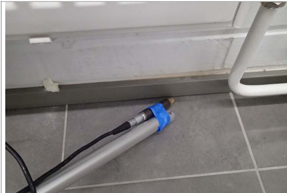
Kuva 6: Merkkiainekoe: tyypillinen vuotopaikka, ulkoseinä-lattia liitos.
