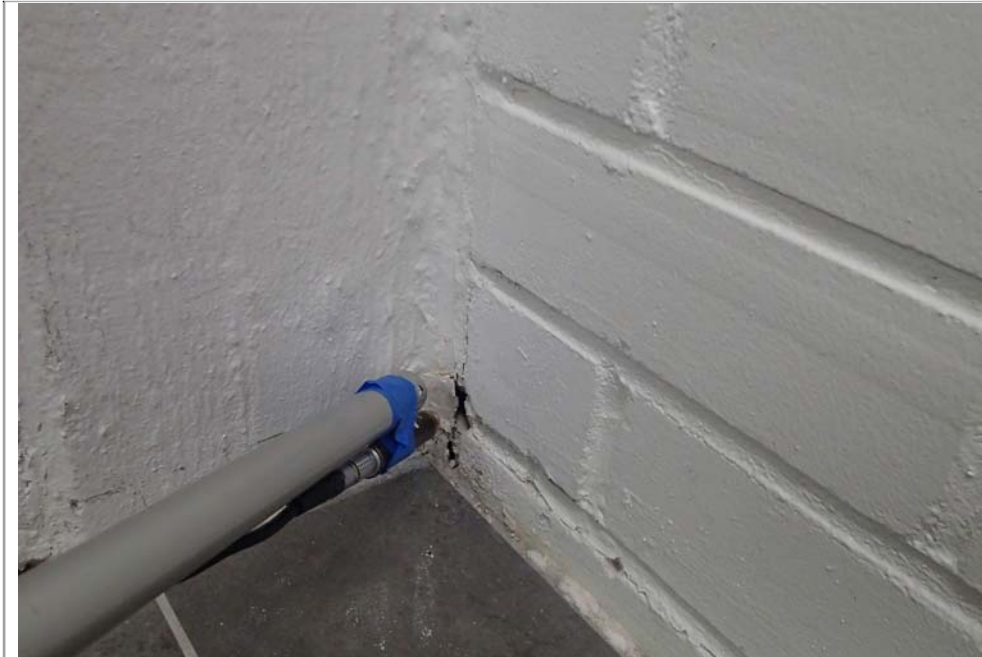
Kuva 7: Merkkiainekoe: tyypillinen vuotopaikka, ulkoseinän halkeamat.
