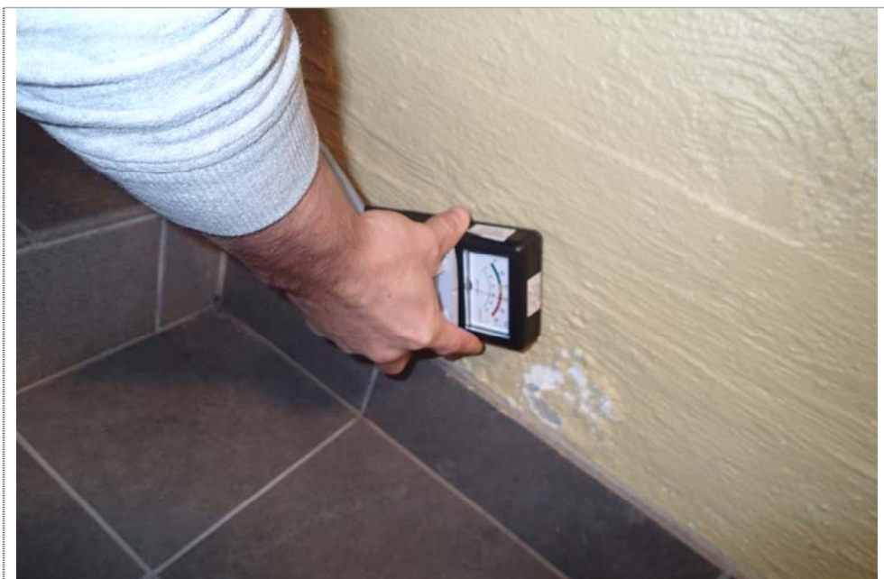
Kuva 14: Käytävän B094 seinien alaosissa havaittiin poikkeavaa kosteutta.
