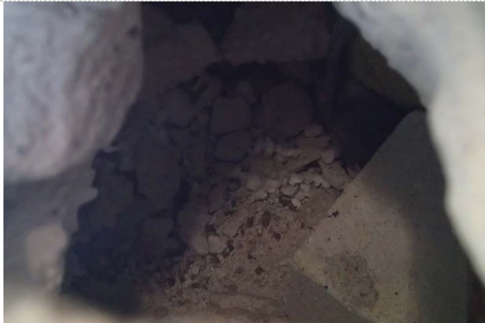
Kuva 3: Väliseinän alapuolinen tila, materiaalinäytteissä vahva viite mikrobivauriosta.
