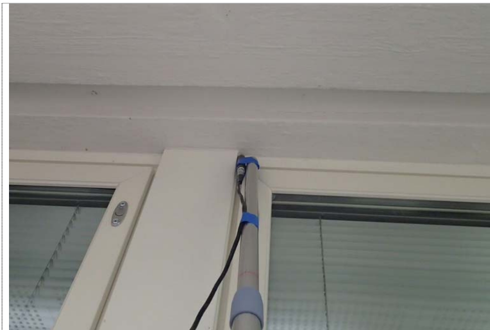
Kuva 10: Merkkiainekoe: tyypillinen vuotoaikka, ulkoseinä- ikkunakarmirakenteen liitos katon rajassa.
