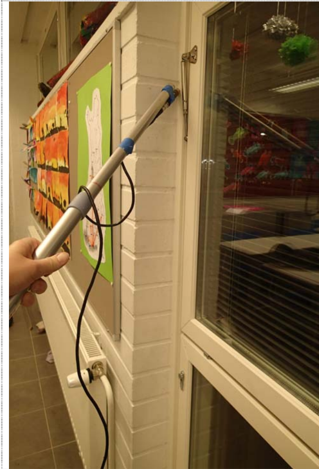
Kuva 9: Merkkiainekoe: tyypillinen vuotoaikka, ulkoseinä- ikkunakarmirakenteen liitos.
