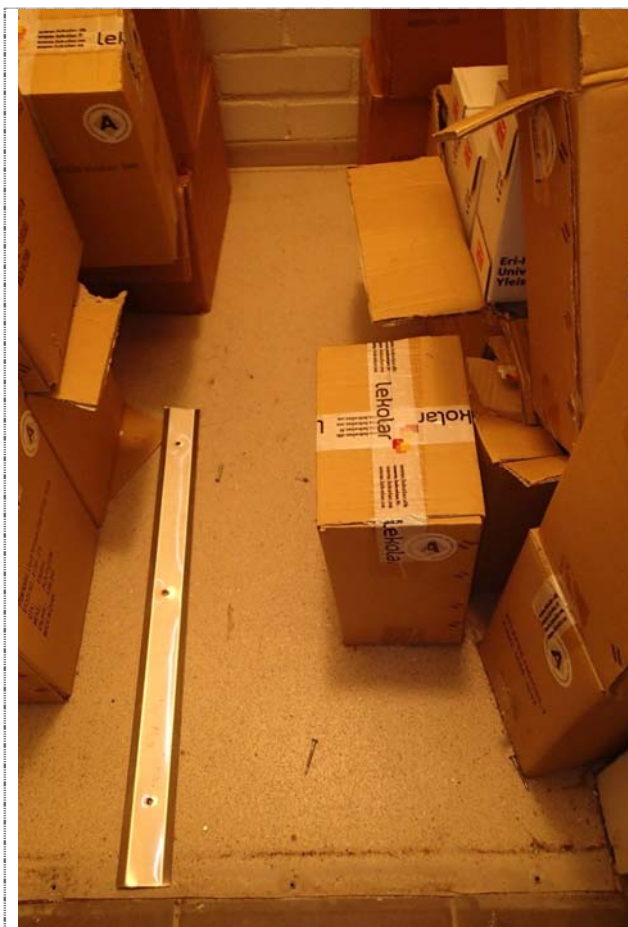
Kuva 16: Varaston B073 lattiapinnoitteena on muovimatto, sen alla on ylimäärin kosteutta.
