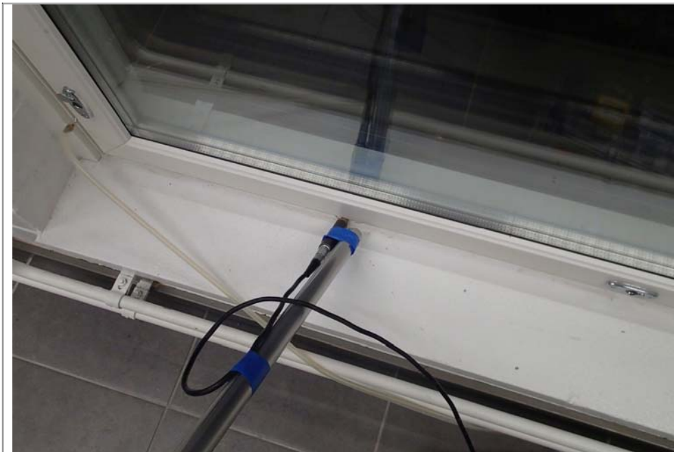
Kuva 8: Merkkiainekoe: tyypillinen vuotopaikka, ikkunakarmirakenteet.
