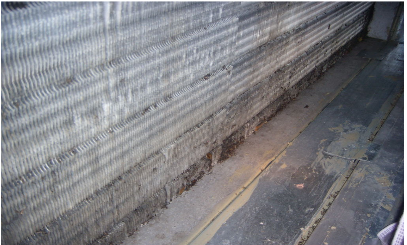
KUVA 4. Yleiskuva tuloilmakoneen N:o 1 lämpöpatterista.
