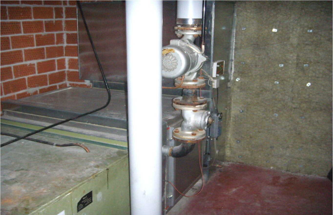
KUVA 1. Yleiskuva IV- konehuoneesta.
