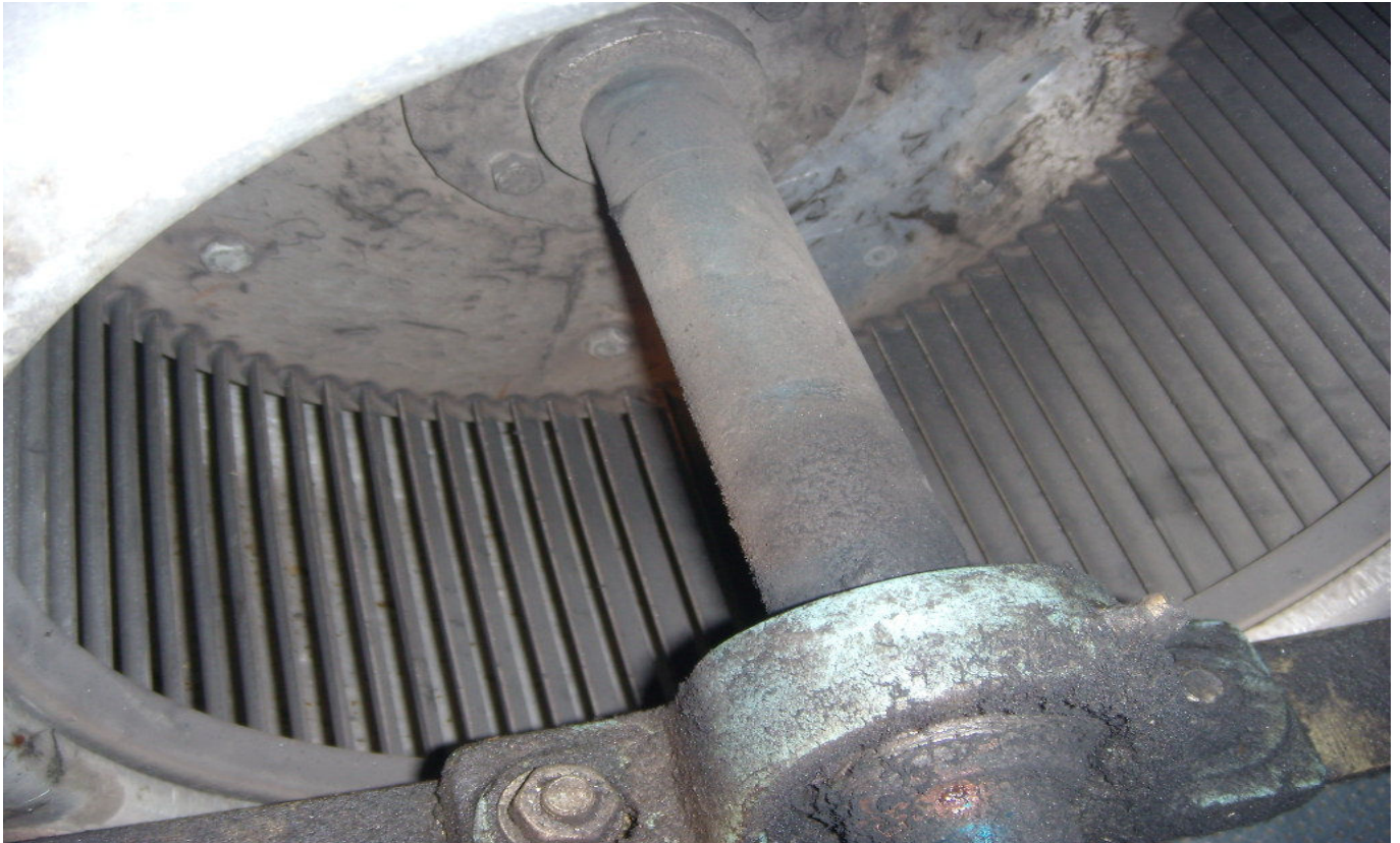
KUVA 5. Yleiskuva tuloilmapuhaltimesta N:o 1.
