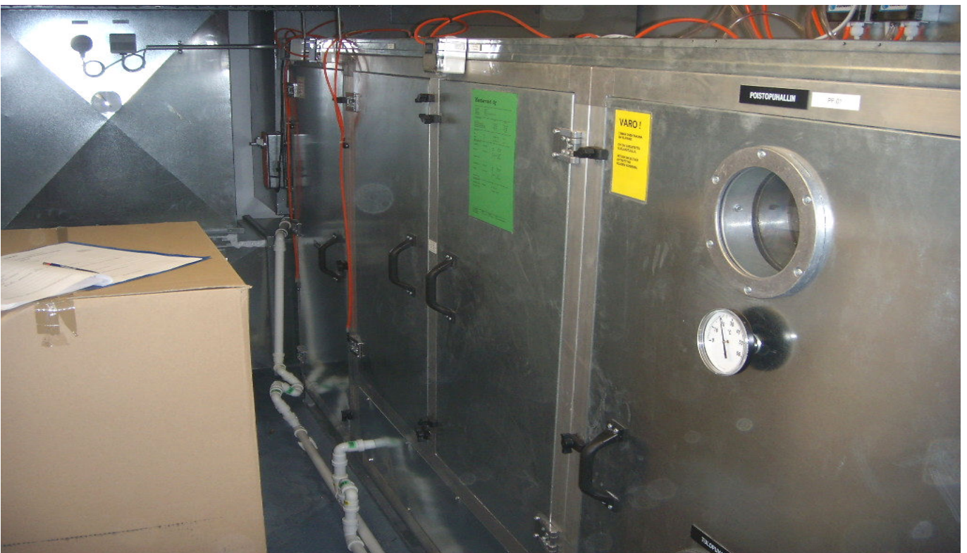
KUVA 2. Yleiskuva IV- konehuoneesta.
