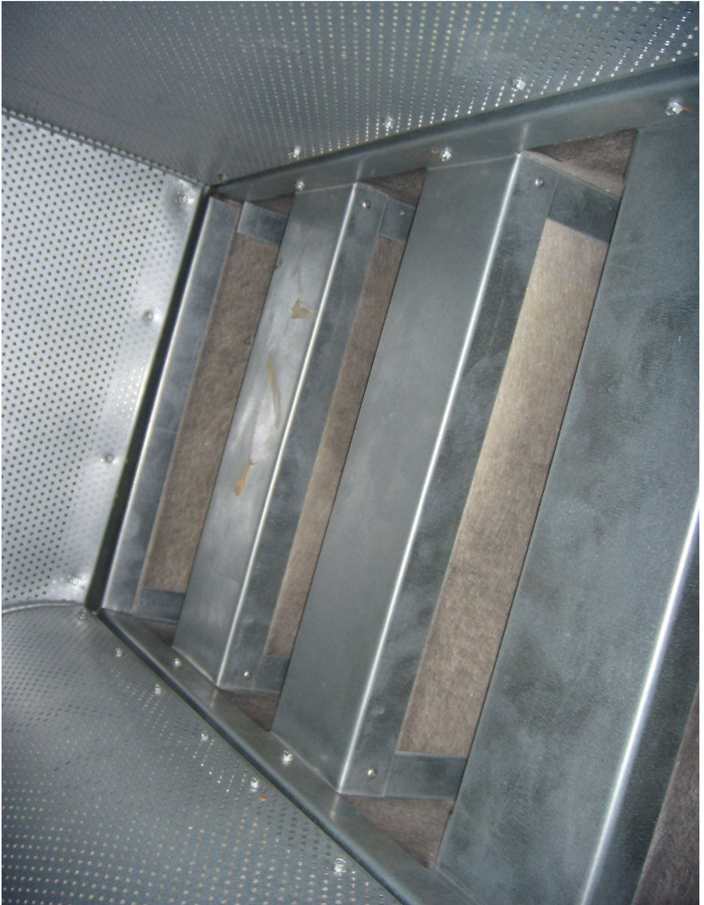
KUVA 7. Yleiskuva tuloilmakoneen äänenvaimentimesta.
