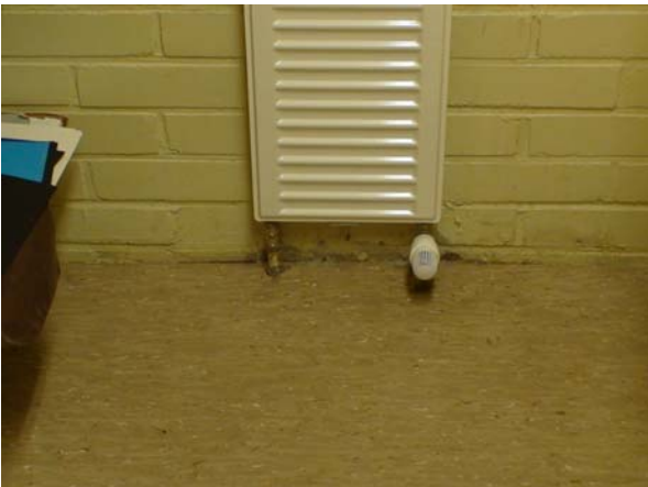
Kuva 8. Patterin alla lattialaatta oli "kosteaa" (tila 049). Seinän maalipinta on hilseillyt.
