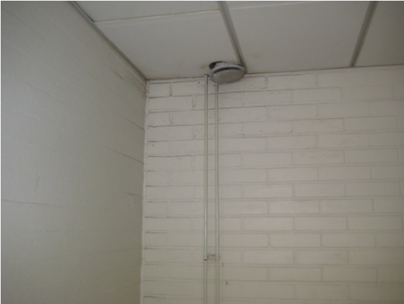
Kuva 7. Seinänurkassa ilmastointiventtiin alla oli "kosteutta".
