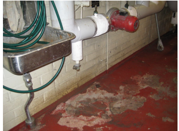
Kuva 5. Lämmönjakuhuoneen 092 lattianssa on kosteuden aiheuttamia maalipinnan vaurioita.
