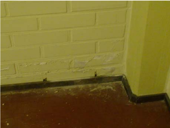
Kuva 2. Maalipinta hilseillyt väliseinässä (tila 016). Pintakosteus oli kuiva.
