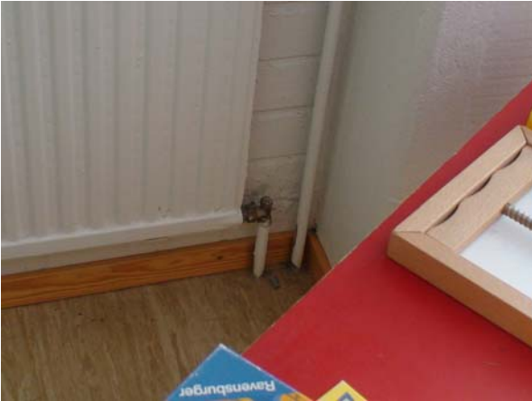
Kuva 1. Ulkoseinässä maalipinta on hilseillyt kosteuden seurauksena. Myös lattia oli märkä seinän vierustalla (tila 006).
