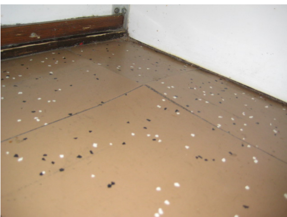
Kuva 9. Käytävällä 157 keittiön edustalla lattialaatat ovat irronneet (todennäköisesti kosteusvaurio).
