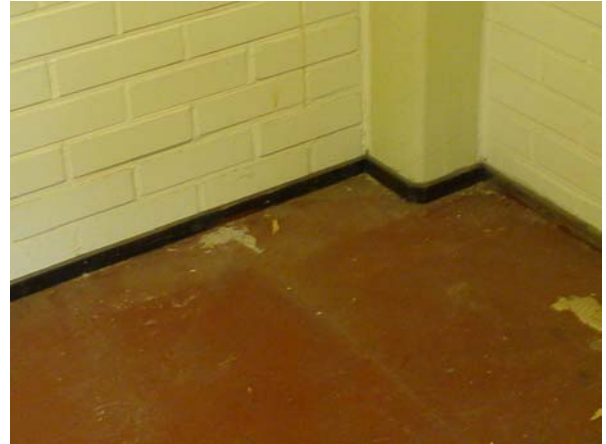
Kuva 4. Varastotilan lattian maalipinta on hilseillyt (vanhat kosteusvauriot).
