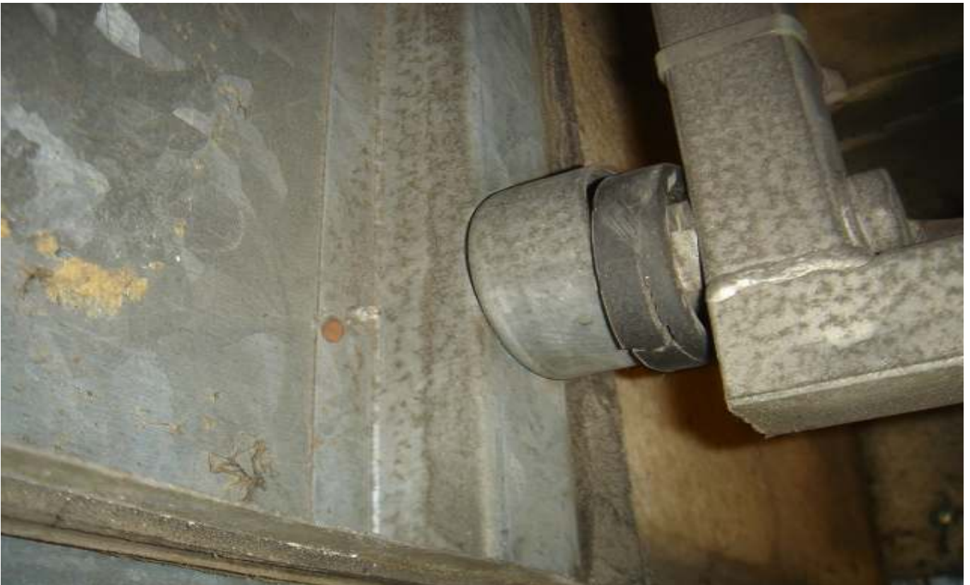
KUVA 8. Puutyöluokan tuloilmakoneen tärinävaimentimet ovat huonossa kunnossa.
