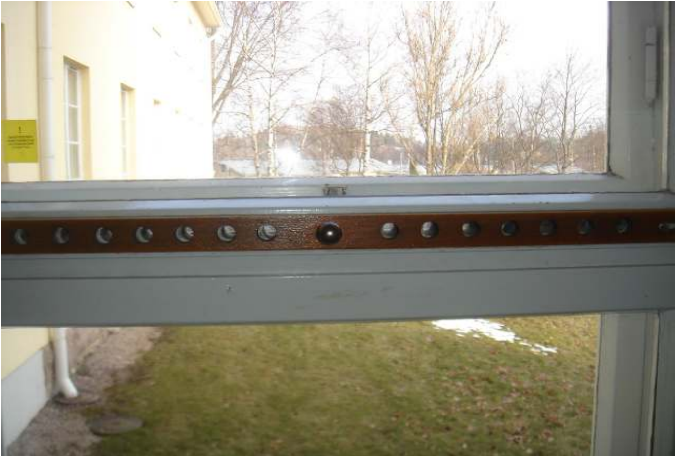
KUVA 15. Yleiskuva käytävän ikkunassa olevasta korvausilmaventtiilistä.
