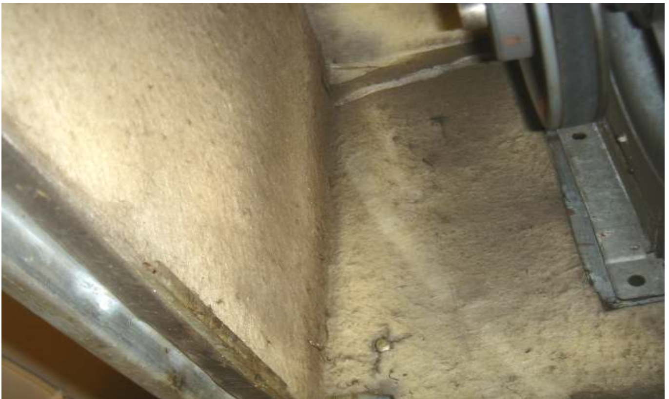
KUVA 6. Puutyöluokan tuloilmakoneen villapinnat ovat osin likaisia ja paikoin kolhiintuneita.
