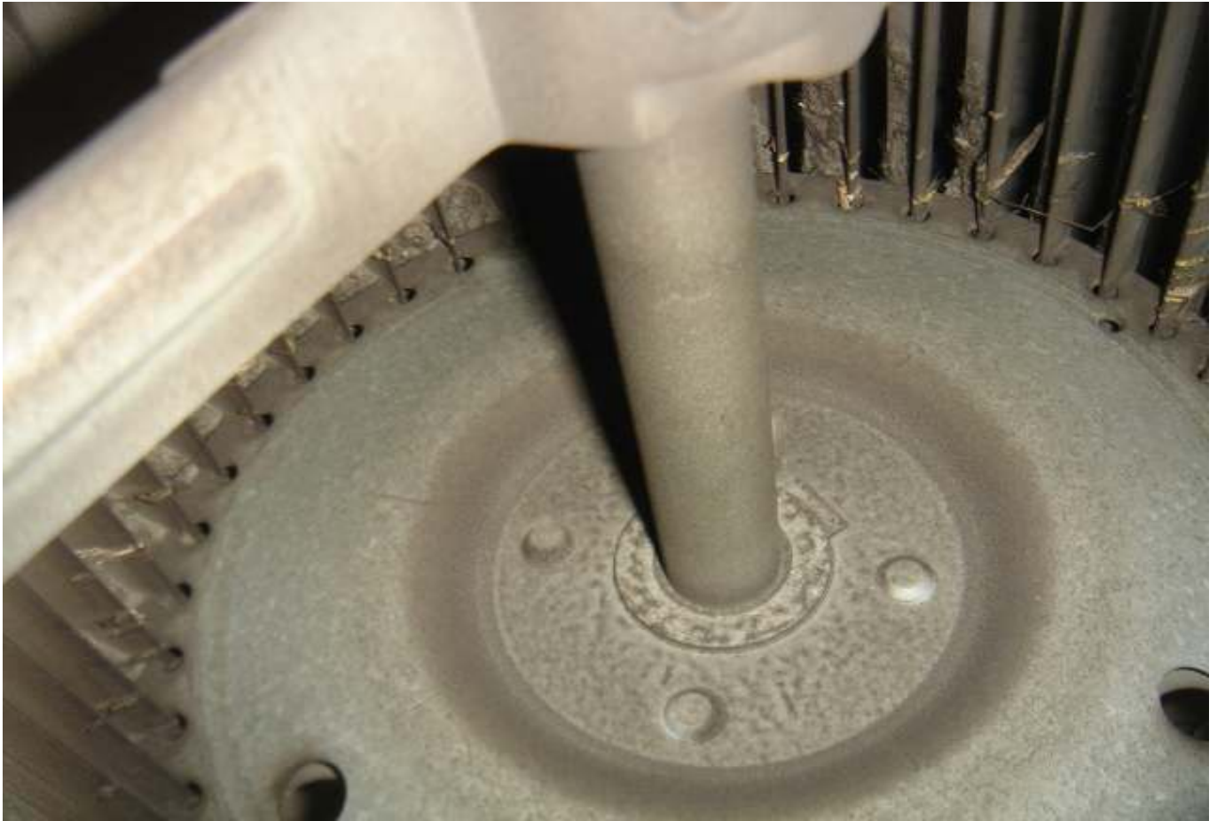
KUVA 5. Puutyöluokan tuloilmakoneen puhallin on pölyinen.
