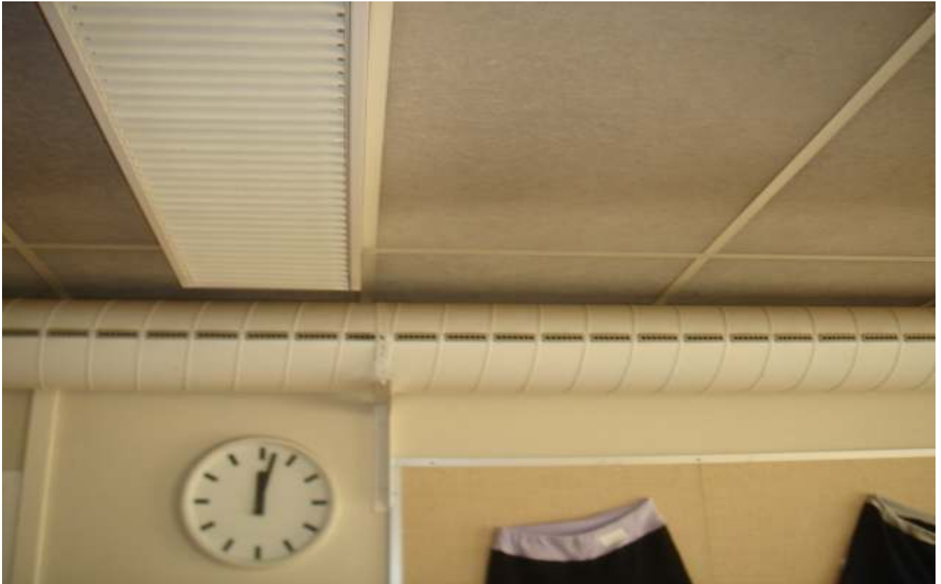
KUVA 11. Yleiskuva ruokalan tuloilmaelimestä.
