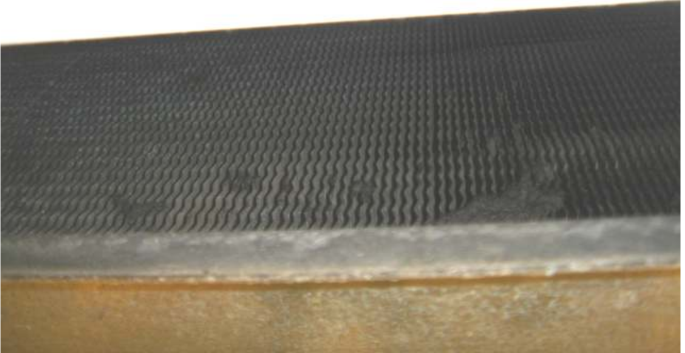
KUVA 7. Puutyöluokan tuloilmakoneen lämmityspatteri on pölyinen.
