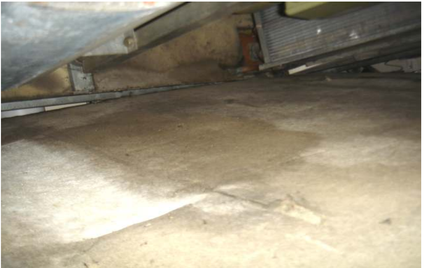
KUVA 4. Ruokalan tuloilmakoneen villapinnat ovat osin likaisia ja paikoin kolhiintuneita.
