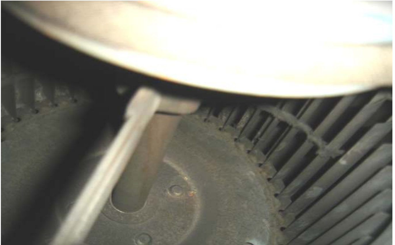
KUVA 3. Ruokalan tuloilmakoneen puhallin on pölyinen.
