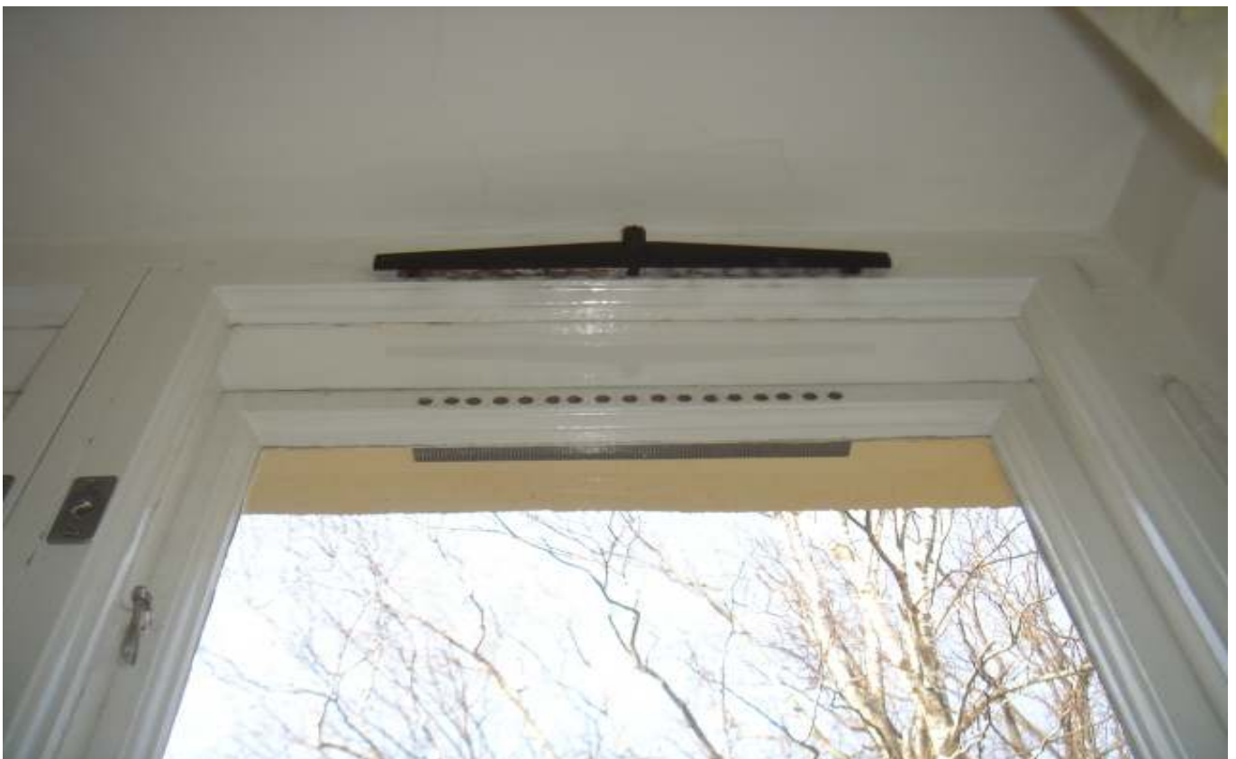
KUVA 14. Yleiskuva luokan korvausilmaventtiilistä, jossa ulkokarmissa myös rakoventtiili.
