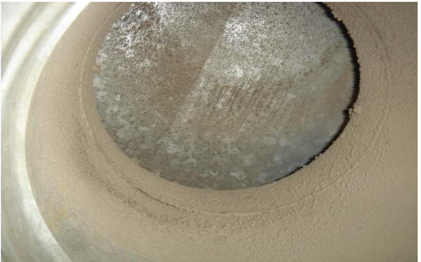
KUVA 10. Yleiskuva ruokalan poistoilmakanavasta.
