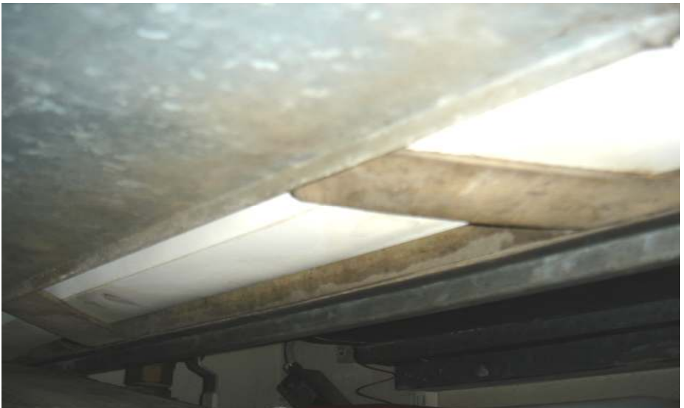
KUVA 2. Ruokalan ilmastointikoneen tuloilmasuodattimen kehikko ei ole tiivis.
