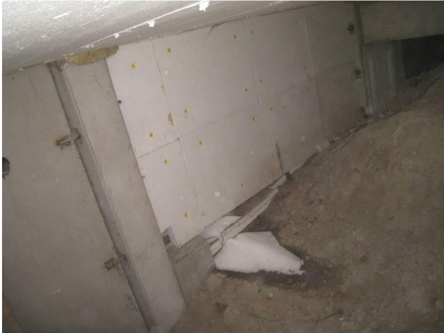
KUVA 6 Näyttämön päätyseinän maanpinnan vajoaman kohdalta on tuiskunnut lunta. Perusmuurin alla on routasuojalevyt ja perusmuuria vasten on styrox-eriste. Tältä kohdin olisi mahdollista tehdä kulkuaukko sokkelin ali.
