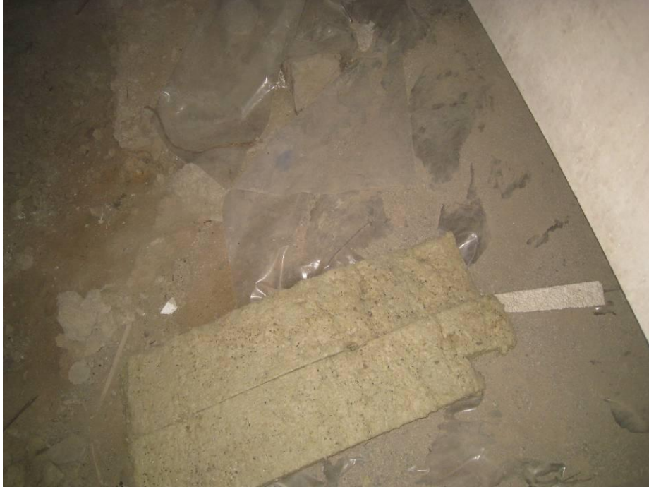
KUVA 7 IV-konehuoneen vieressä olevaa hienoa hiekkaa, jonka alla on muovikalvo. Maanpinnassa ei havaittu kasvustoa. Ontelotilan ilma ei vaikuttanut haisevan.
