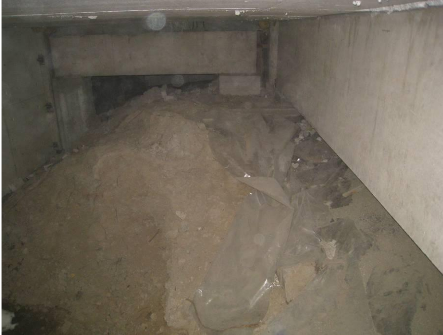
KUVA 5 Kuvaussuunta näyttämön alapuolelle. Alapohjan ontelolaatan alapinnassa on styrox-eriste. Perällä on palkki, jonka ali pääsee ryömimään.
