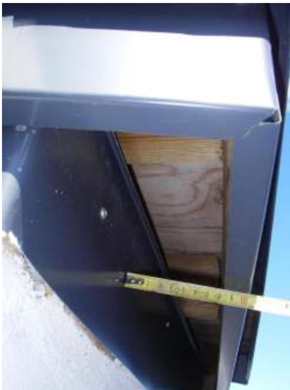
Kuva 14. Räystään tuuletusaukon leveys paikallisesti kulmakohdassa noin 80 mm, suunniteltu 30 mm, linja 29 (itäsivu)
