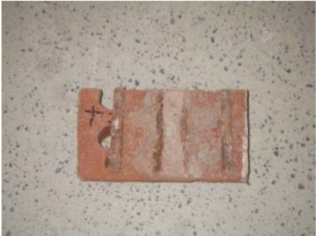
Kuva 1. Teräset vahvassa ruosteessa näytteessä T3 (näyte otettu vaakahalkeaman kohdalta)
