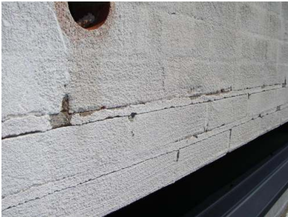
Kuva 6. Tiiliseinän yläosassa, kahdessa alimmassa tiilivarvissa vaakahalkeama, linja D (näytepisteessä T3 teräkset todettiin ruosteiseksi).
