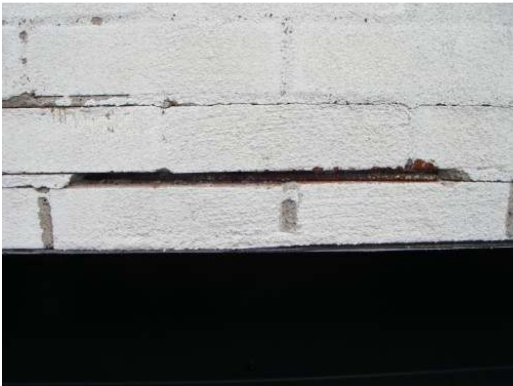
Kuva 8. Ruosteinen teräs yläosissa julkisivua linjalla G
