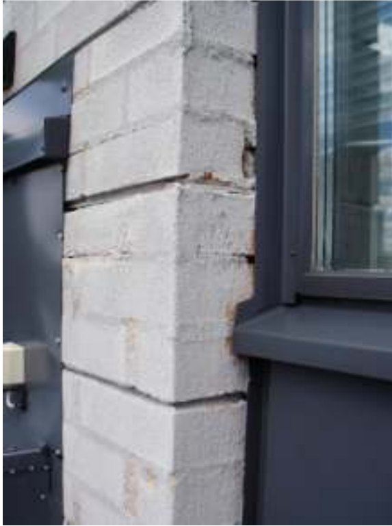
Kuva 7. Rappauksen irtoamista G linjalla
