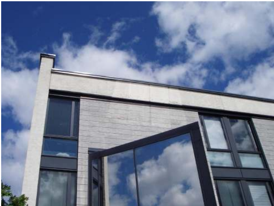
Kuva 12. Lasiulkoneman päällä ei havaittu tuuletusaukkoa
