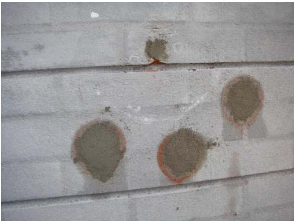
Kuva 2. Melko ehjänä säilynyt julkisivuosuus, näytekohta T2
