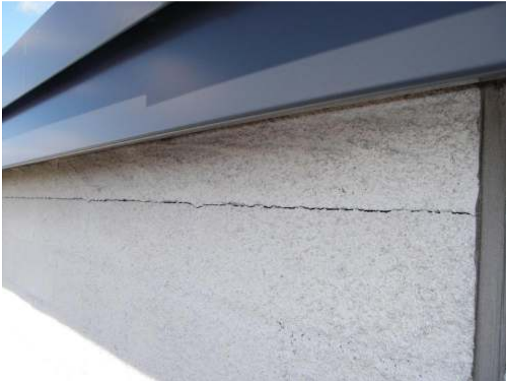
Kuva 5. Tiiliseinän yläosassa vaakahalkeama linjalla A
