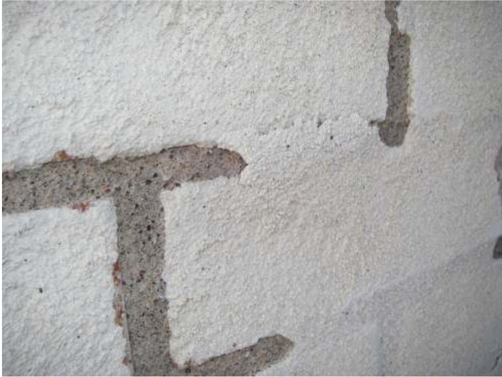
Kuva 3. Irtoamassa oleva kuultorappaus, pääsisäänkäyntisivu, linja M
