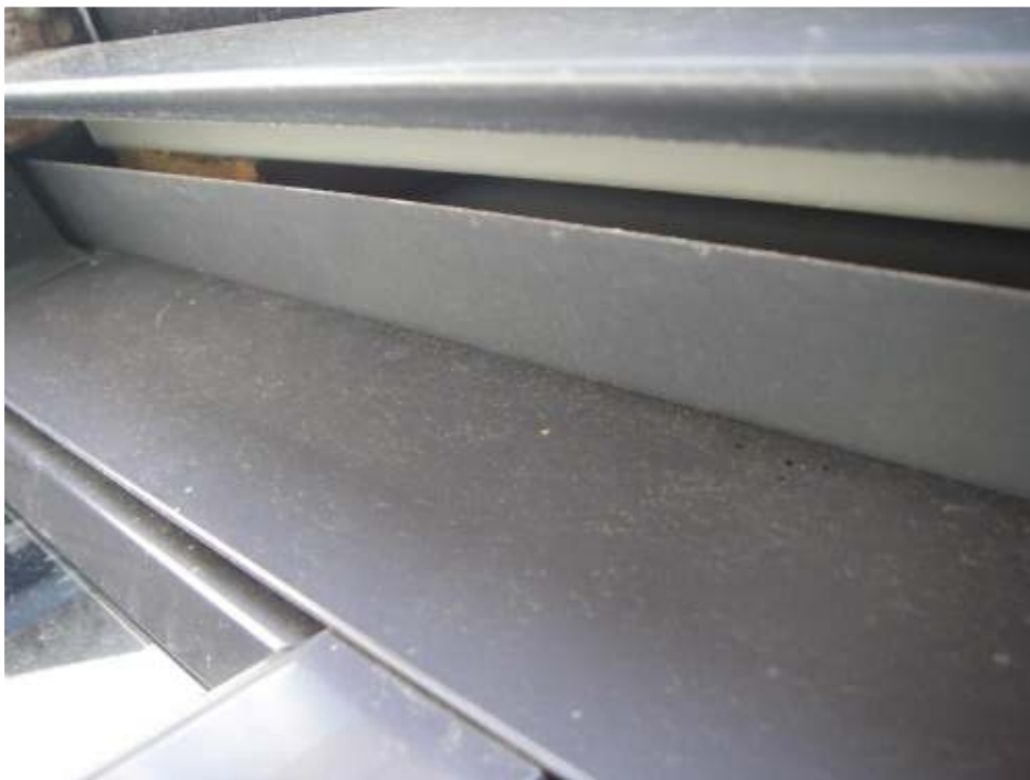
Kuva 10. Tuuletusrako ikkunan yläpuolella, linja A
