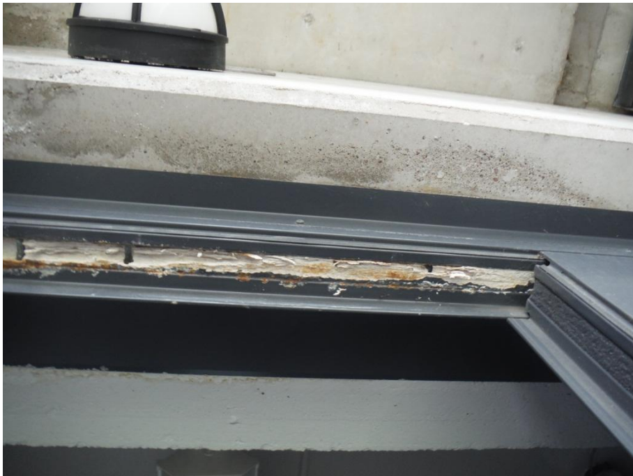
Kuva 5. Vesivahingon jälkiä tilan b1.081 vieressä.
