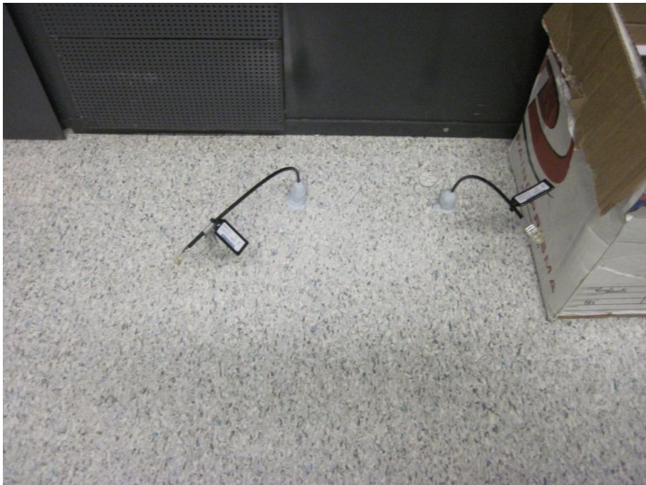
Kuva 2. Kosteusmittausanturit tilan b1.081 lattiassa
