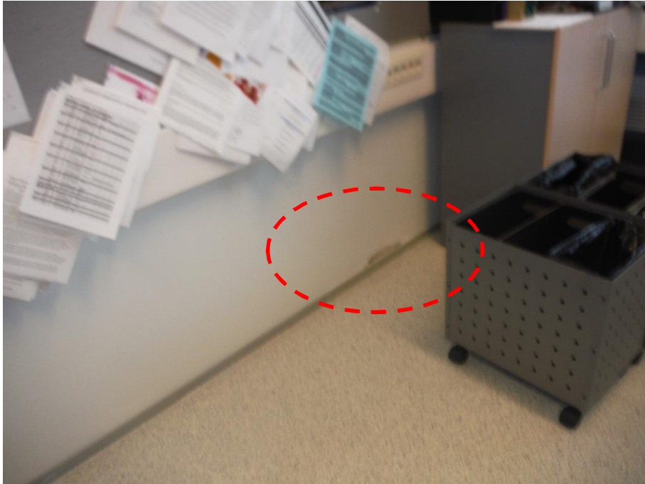
Kuva 1. Tilassa b1.081 seinässä maalissa vaurio
