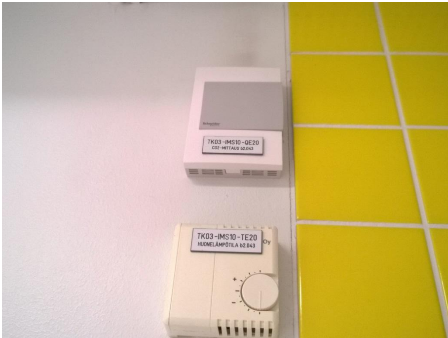
Kuva 7. IV-järjestelmässä on hiilidioksidi- ja lämpötilaseuranta
