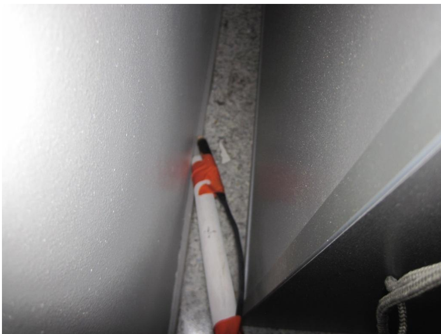
Kuva 15. Vuotokohta tilassa b3.047 lattia/seinäliittymässä
