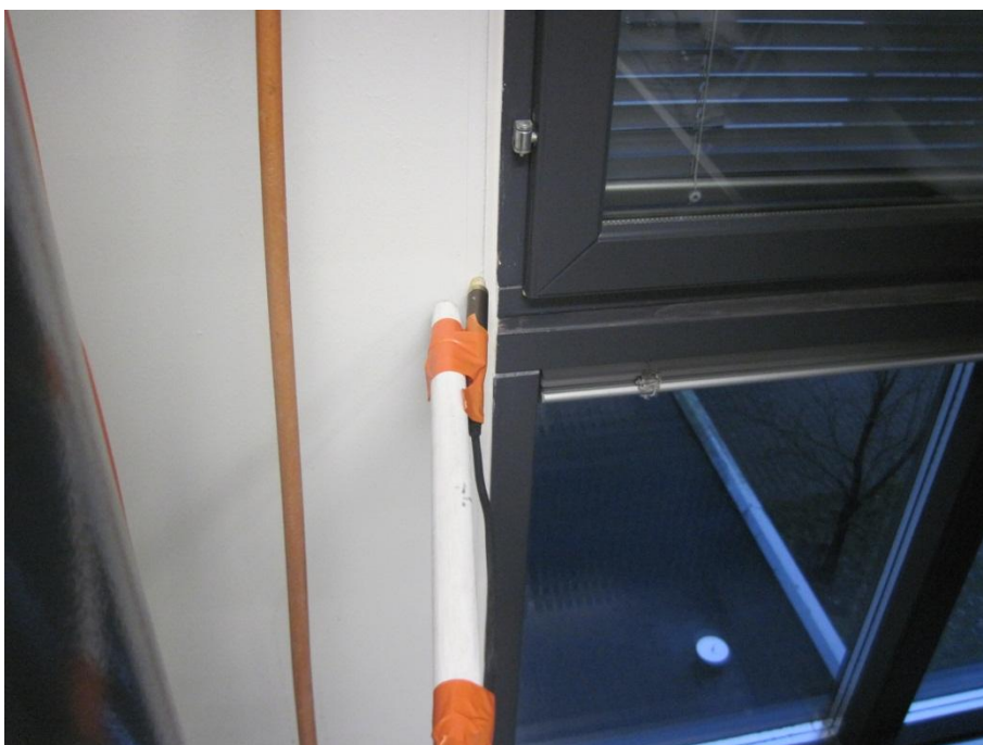
Kuva 10. Tilassa b3.043 merkkiainekokeessa vuotokohta ikkunan ja seinän liittymässä
