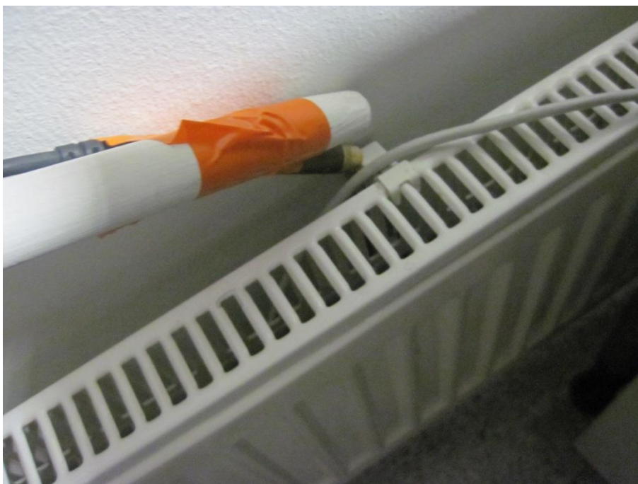
Kuva 17. Vuotokohta patterin kiinnityksessä
