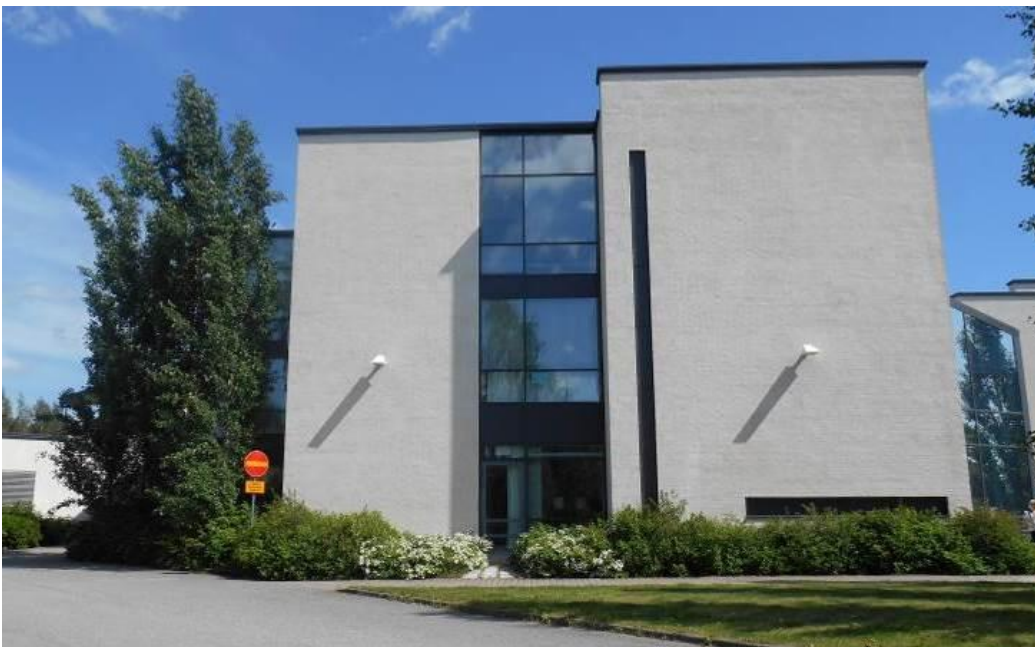
Kuva 4. Julkisivu C, länsiluoteen suuntaan, koostuu monesta eri osasta. Suurimmalta osin julkisivussa ei esiinny silmin havaittavaa vaurioitumista.
