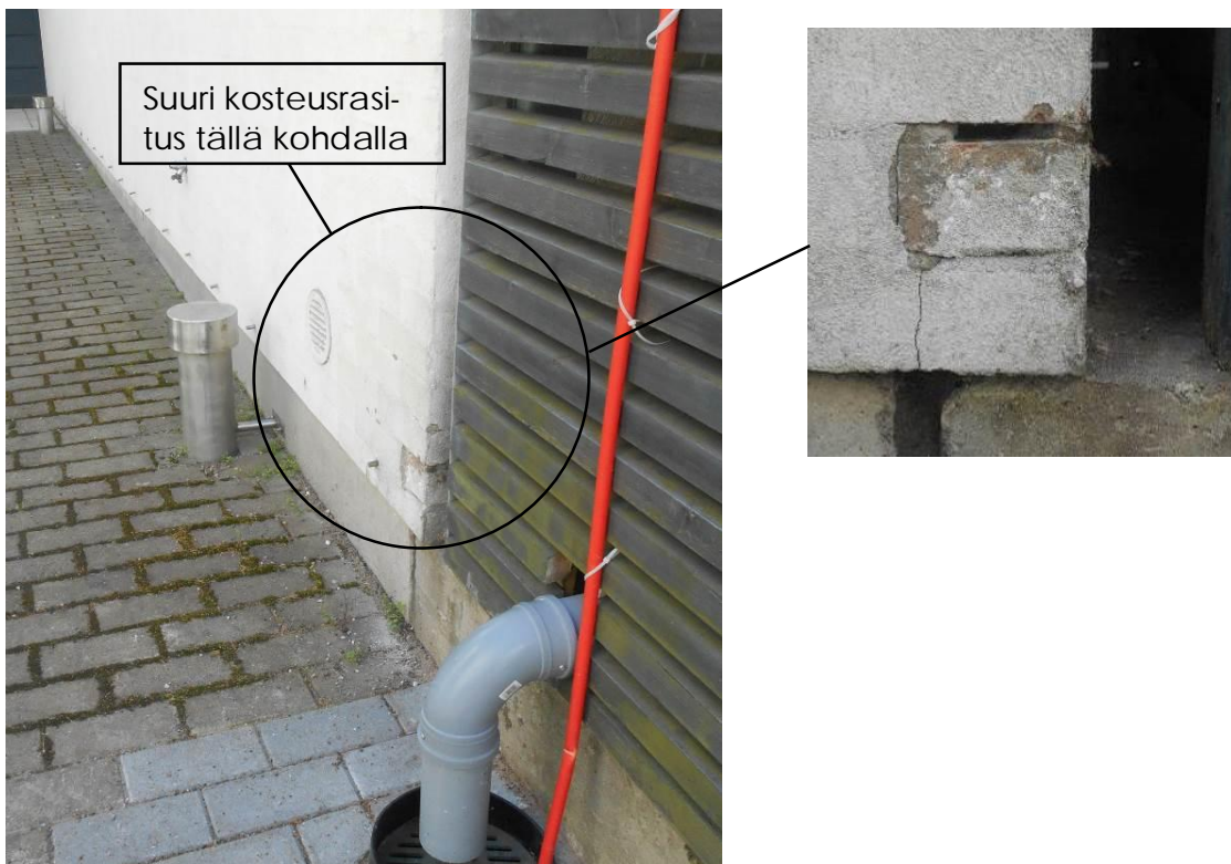
Kuva 6. Julkisivu D on koillispohjoisen suuntaan oleva julkisivu, jossa ei pääosin esiinny vaurioitumista, mutta yhden tiilin saumoista muurauslaasti on rapautunut.
