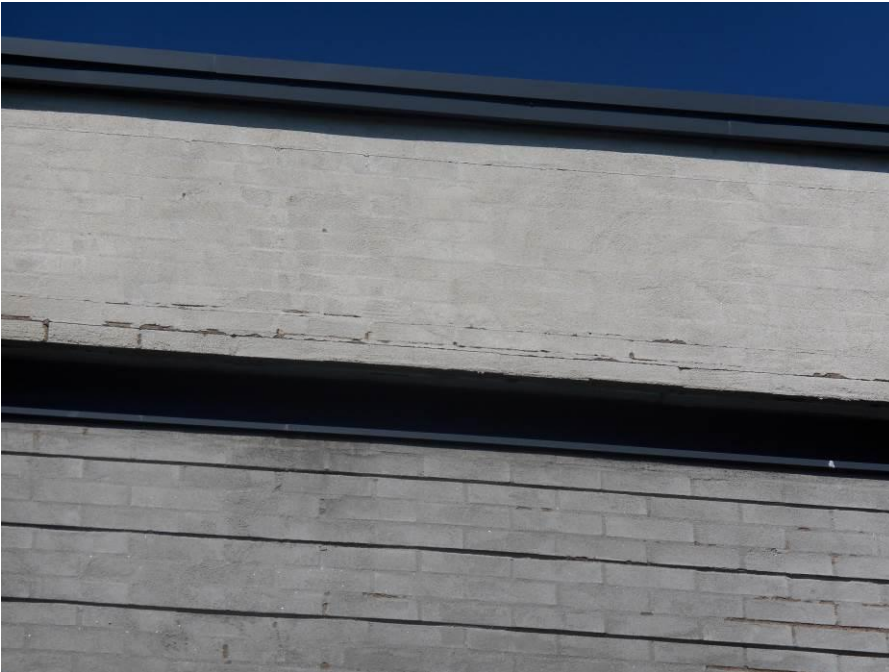
Kuva 7. Julkisivut E ja G ovat etelälounaan suuntaan. Näiden julkisivujen vauriot ovat samankaltaiset toisiinsa verrattuna: Vaaleanharmailla alueilla on tiilisaumoissa alkavaa vaurioitumista. Yläosassa tiilisaumoja pitkin on vaakahalkeilua ja paikoittain syväälle rapautuneita saumoja. Osittain julkisivut ovat silmämääräisesti vaurioitumattomia.
