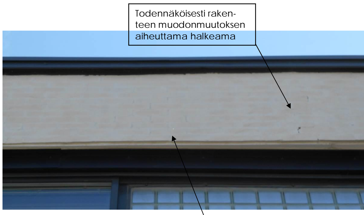
Kuva 9. Julkisivulla K on havaittavissa alkavaa rapautumista tiilisaumojen kohdalla.
