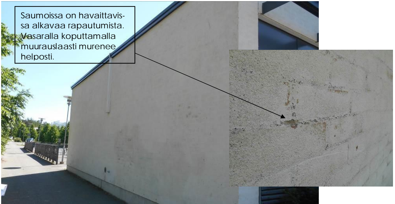
Kuva 13. Julkisivu O, itäkoillisen suuntaan. Itäisimmältä seinältä on puhdistettu graffiteja, mistä johtuen rappaus on todella ohutta tällä kohdalla. Muuten rappaus näyttää hyväkuntoiselta. Vaurioituminen on kuitenkin alkamassa.
