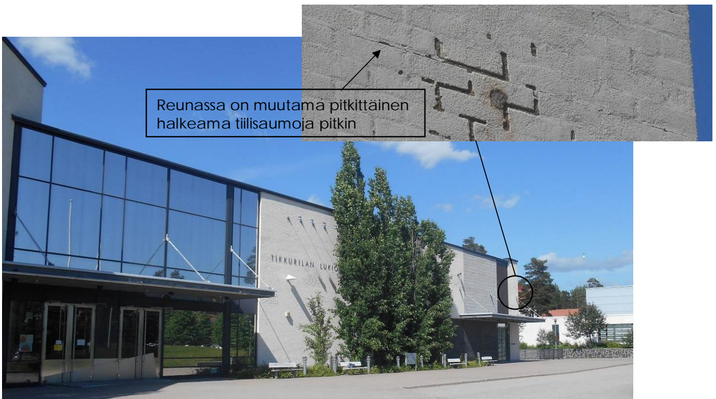
Kuva 14. Julkisivu P on eteläkaakon suuntaan oleva pääjulkisivu. Tämä julkisivu on vaurioitunut suurelta osin.
