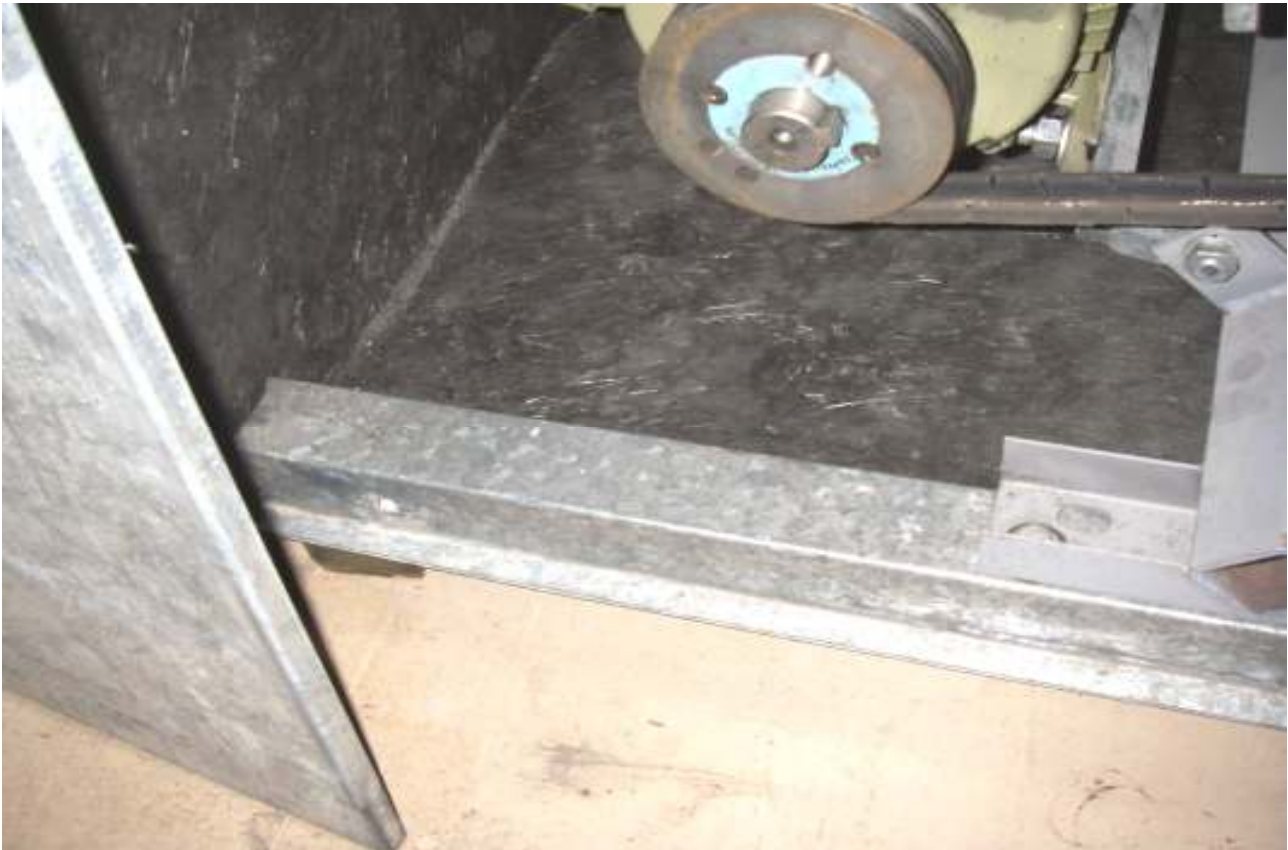
LVI-kuva 4. Tuloilmakoneen TK 1 kammiot on eristetty villamateriaalilla.
