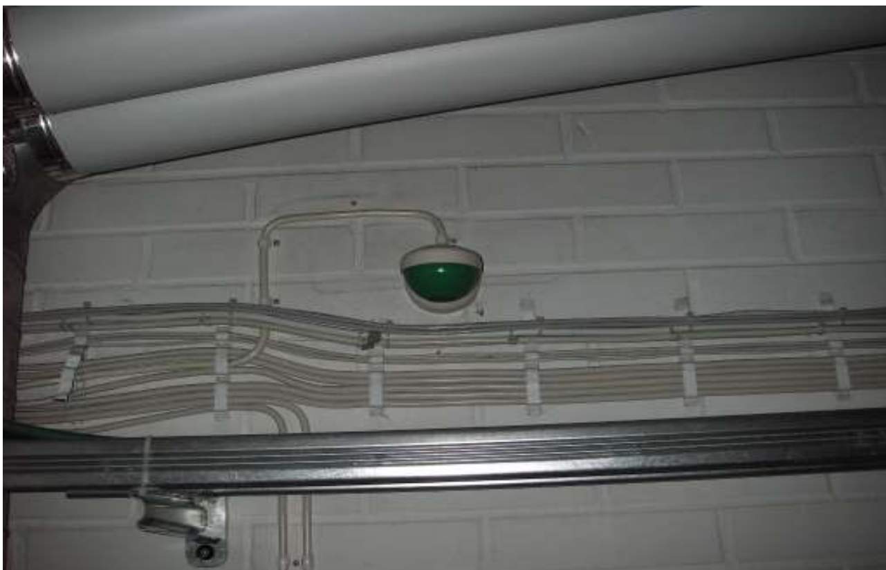
S-KUVA 1. Rikkinäinen ovimerkkivalaisin IV- konehuoneessa (lamppu on palanut).
