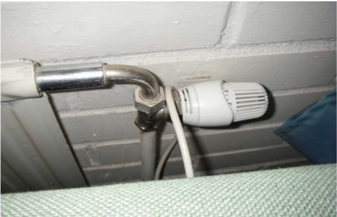
LVI-kuva 2. Päärakennuksen patteriventtiilit ovat pääosin uusittuja ja hyväkuntoisia.
