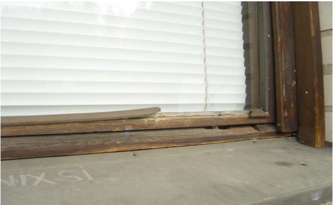
RAK-kuva 2. Päärakennuksen puuikkunan lahovaurioita.
