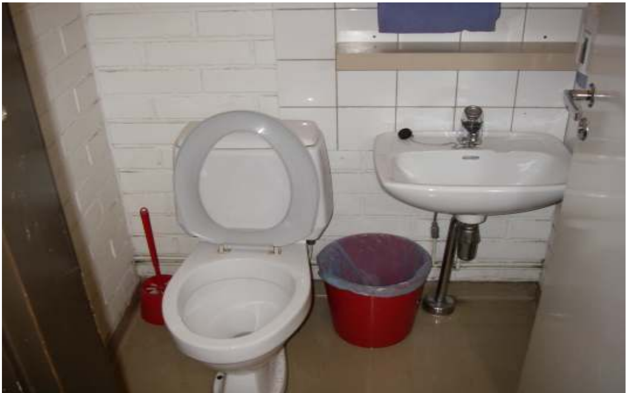
LVI-kuva 3. Yleiskuva päärakennuksen vanhoista vesikalusteista.
