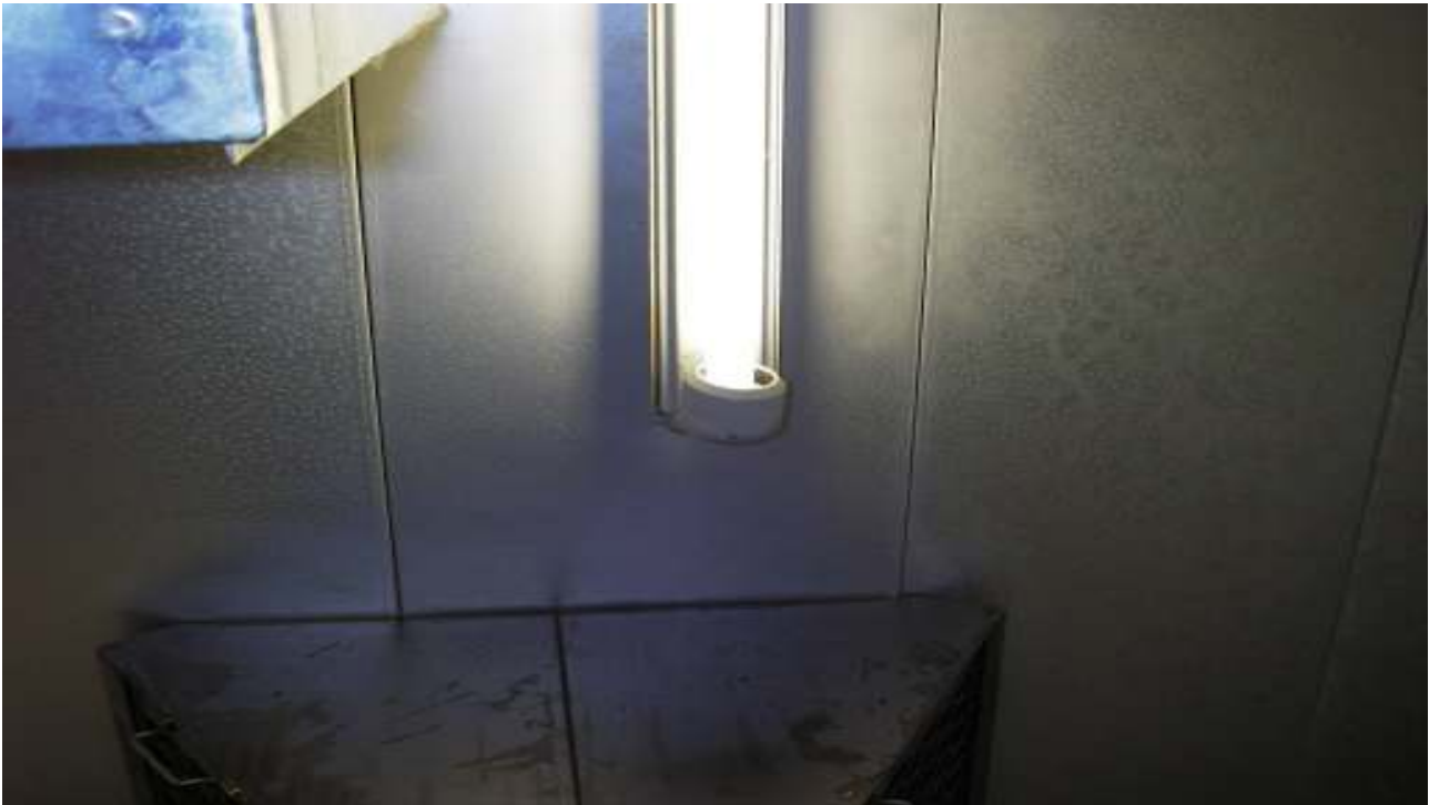
S-KUVA 4. Päärakennuksen keittiön valaisimessa on vääräkokoiset loistelamput.
