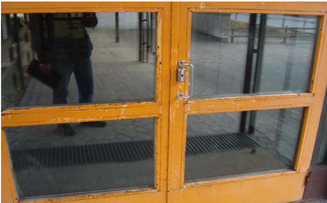
RAK-kuva 5. Päärakennuksen metallirakenteisen ulko-oven pintavaurioita.
