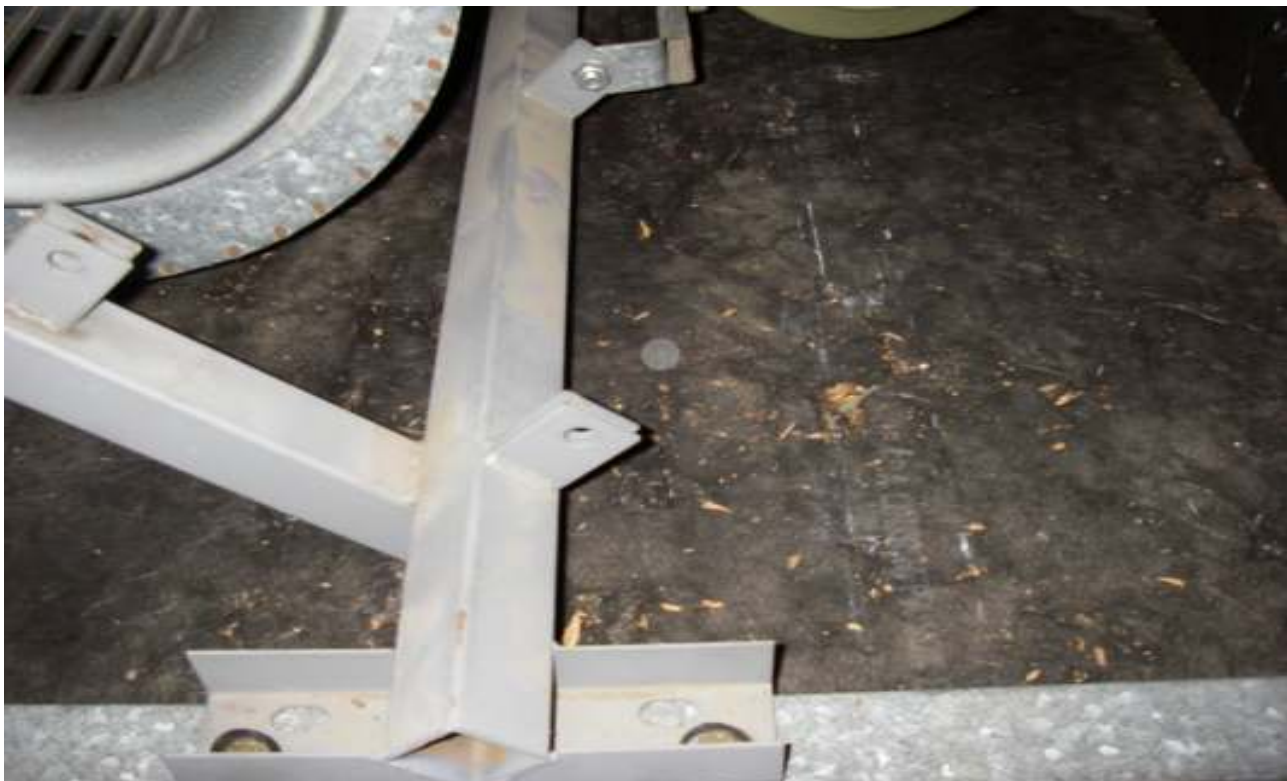
LVI-kuva 8. Tuloilmakoneen TK 2 kammioiden on roskaa.
