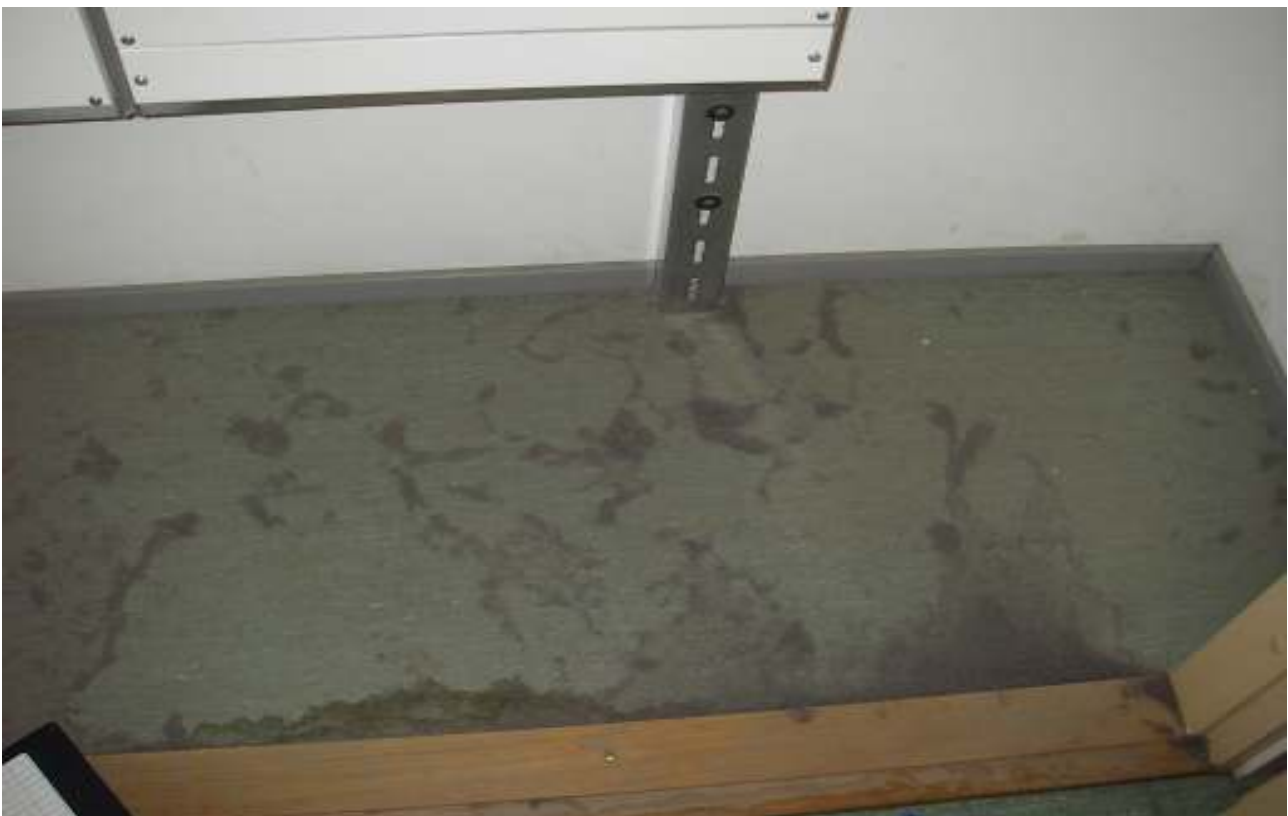
S-KUVA 3. Lisärakennuksen pölyinen pääkeskustila.
