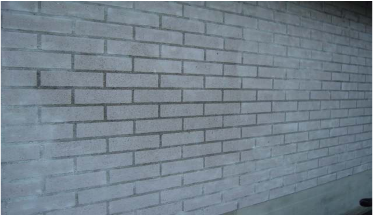
RAK-kuva 1. Päärakennuksen tiilijulkisivun rapautuneita laastisaumoja.
