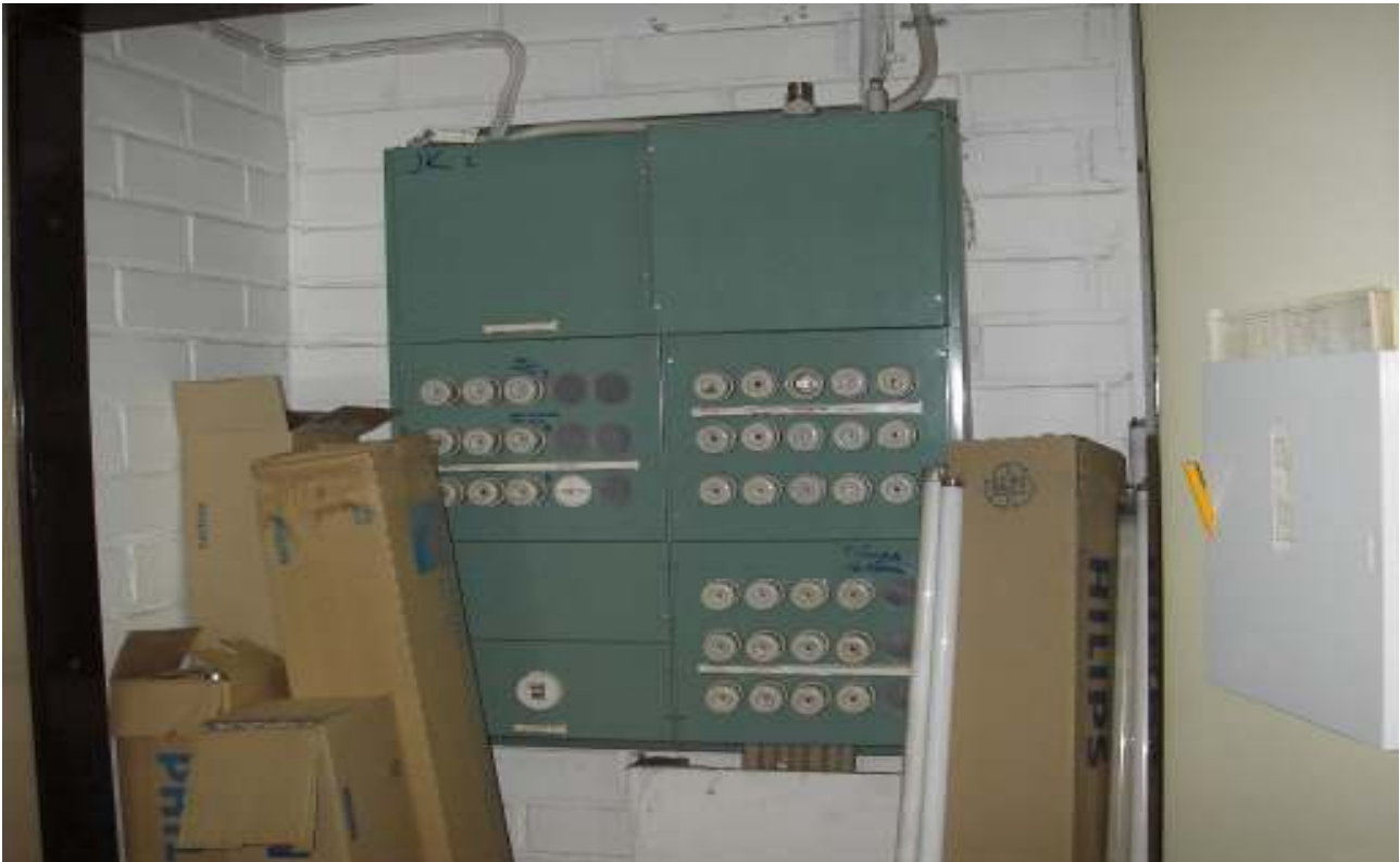
S-KUVA 2. Päärakennuksen JK 2 keskuksesta puuttuu sulakekansi.
