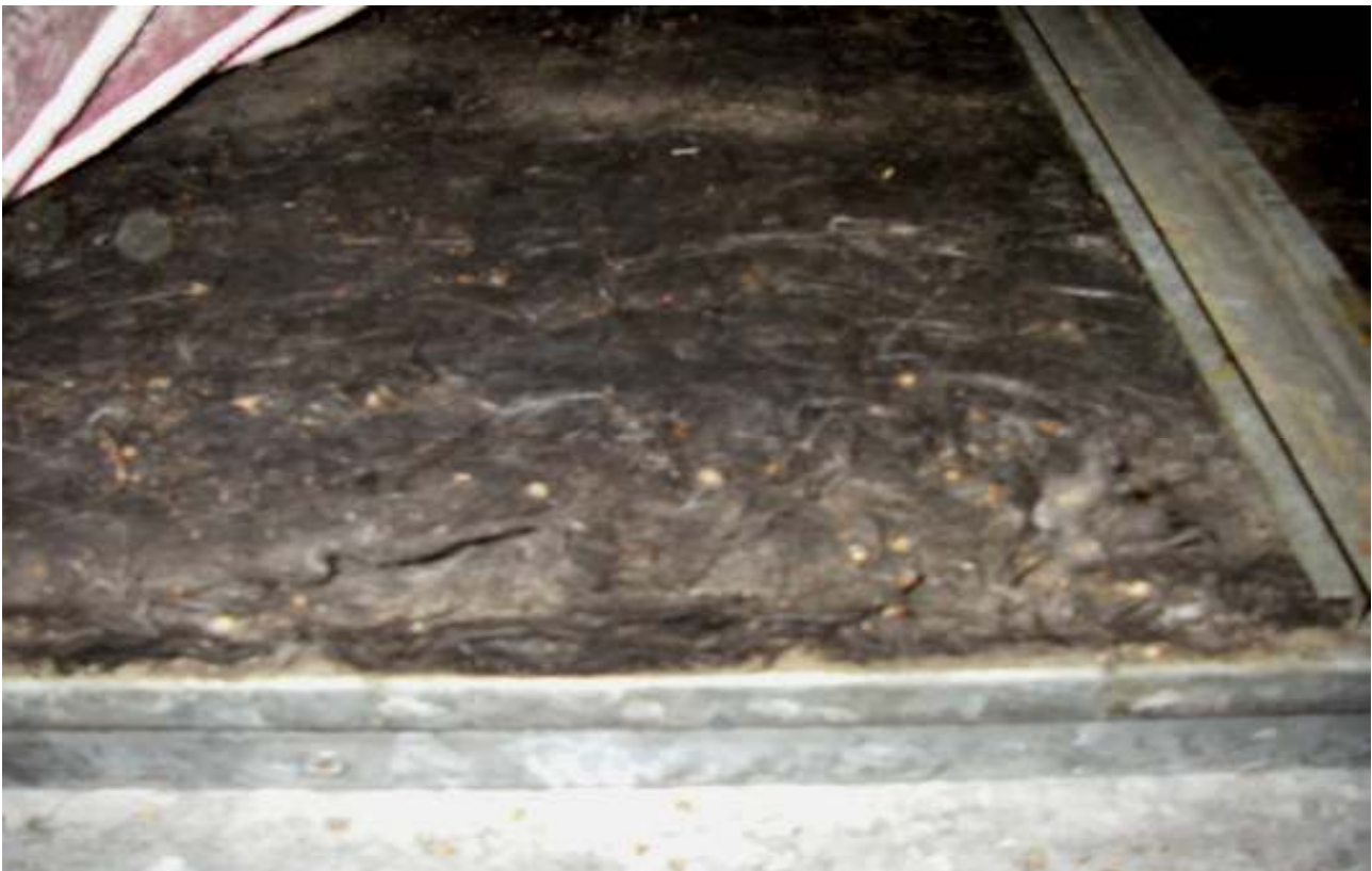
LVI-kuva 7. Tuloilmakoneen TK 2 kammiot on eristetty villamateriaalilla, joka on osin rikki.
