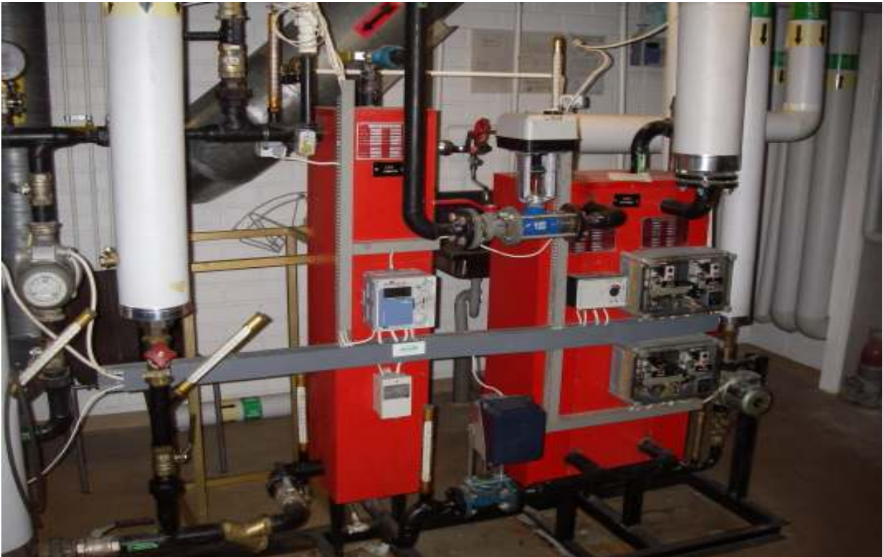
LVI-kuva 1. Kaukolämmön alajakokeskus on alkuperäinen ja ainoastaan välttävässä kunnossa.
