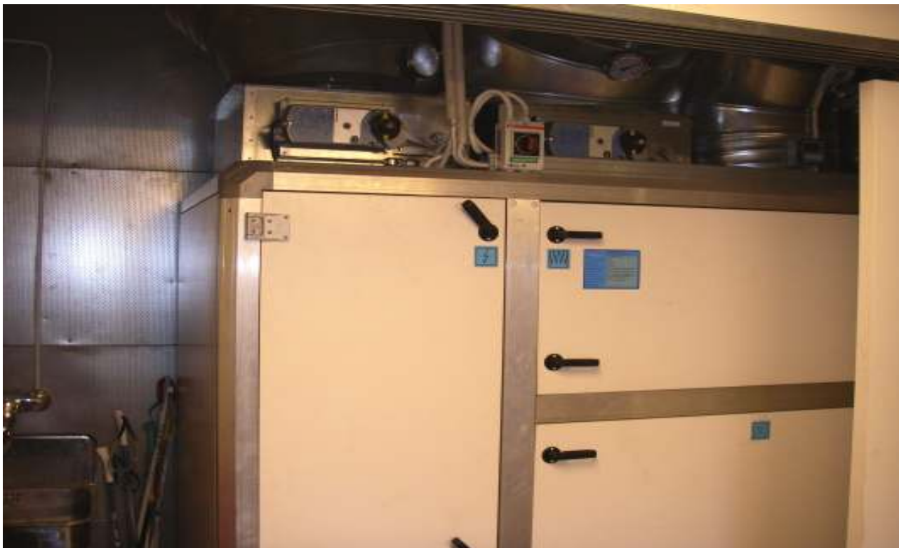
LVI-kuva 10. Yleiskuva lisärakennuksen tuloilmakoneesta.
