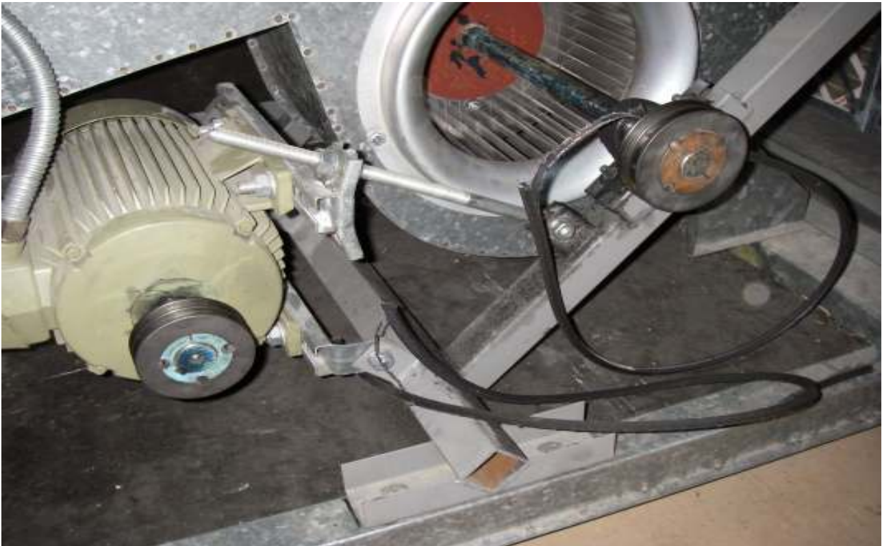
LVI-kuva 6. Poistoilmapuhaltimen PK 1 hihnat ovat poikki.
