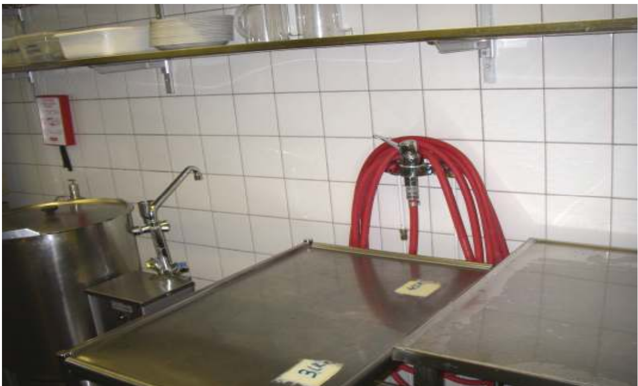
LVI-kuva 4. Yleiskuva keittiön vesikalusteista
