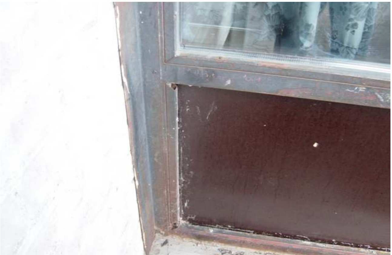
RAK-kuva 4. Päärakennuksen metalli-ikkunan ruosteaurioita.
