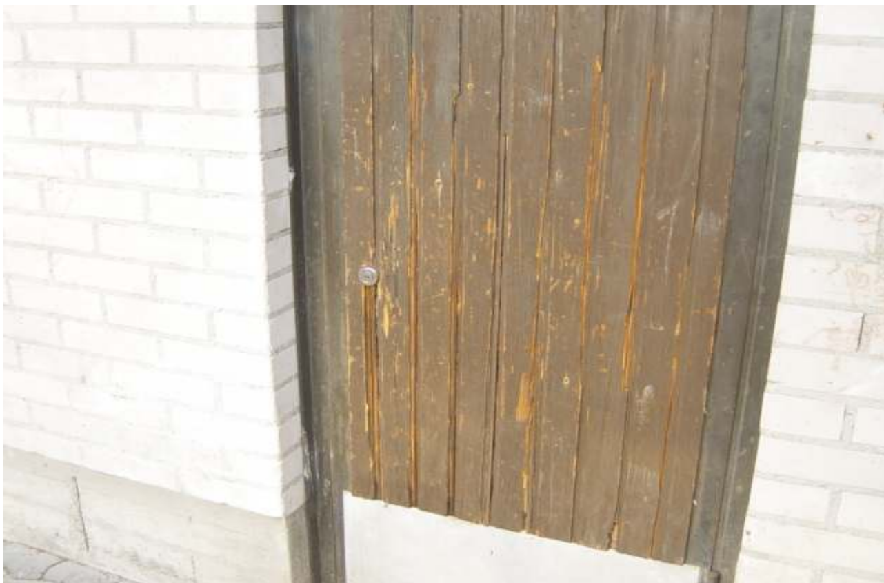
RAK-kuva 6. Päärakennuksen paneelipintaaisessa ulko-ovessa on pintavaurioita.
