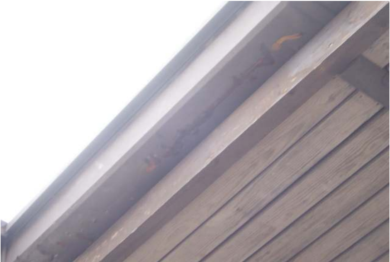
RAK-kuva 9. Päärakennuksen räystääkouru on paikoitellen ruostunut puhki.
