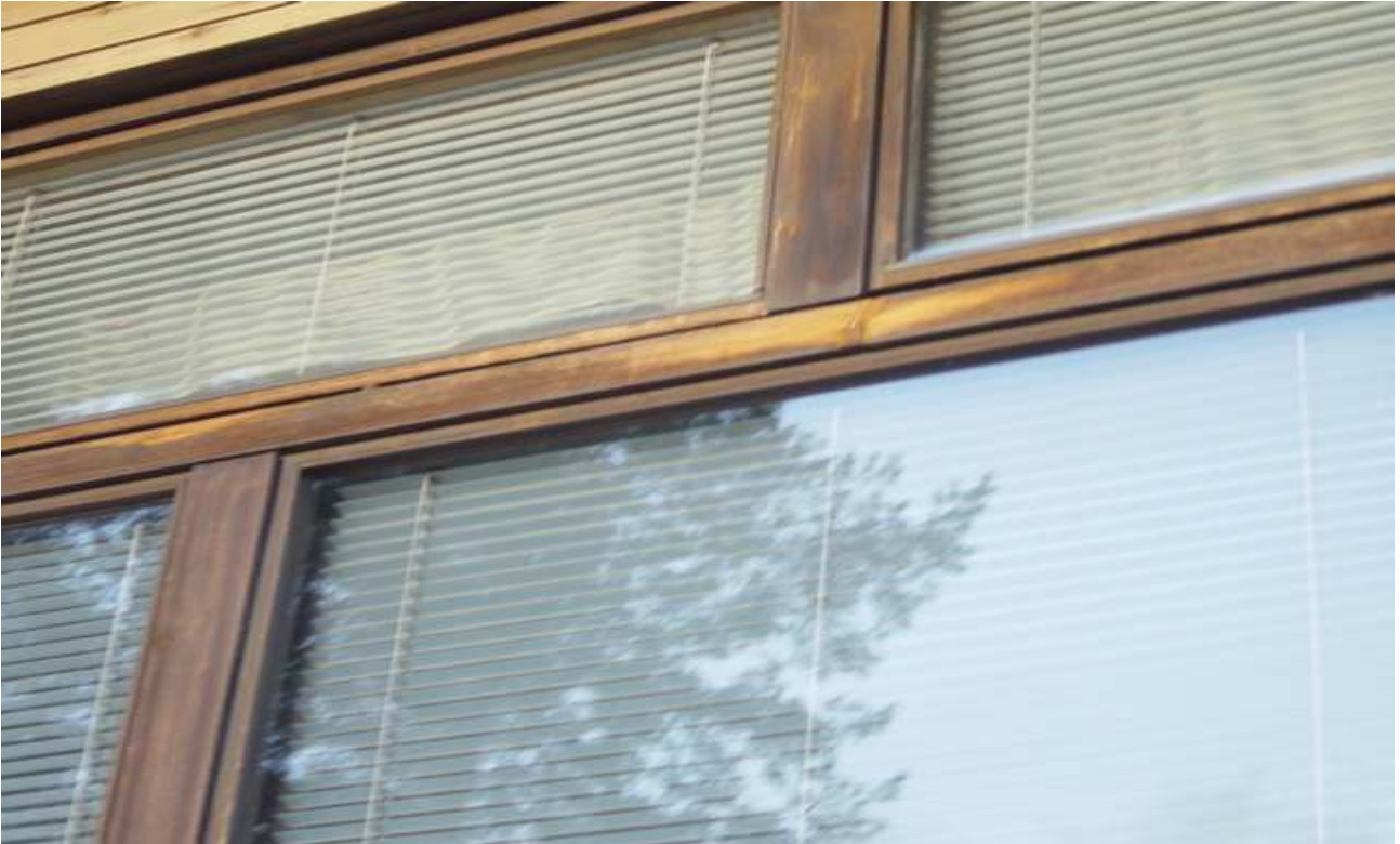
RAK-kuva 3. Päärakennuksen puuikkunan pintavaurioita.
