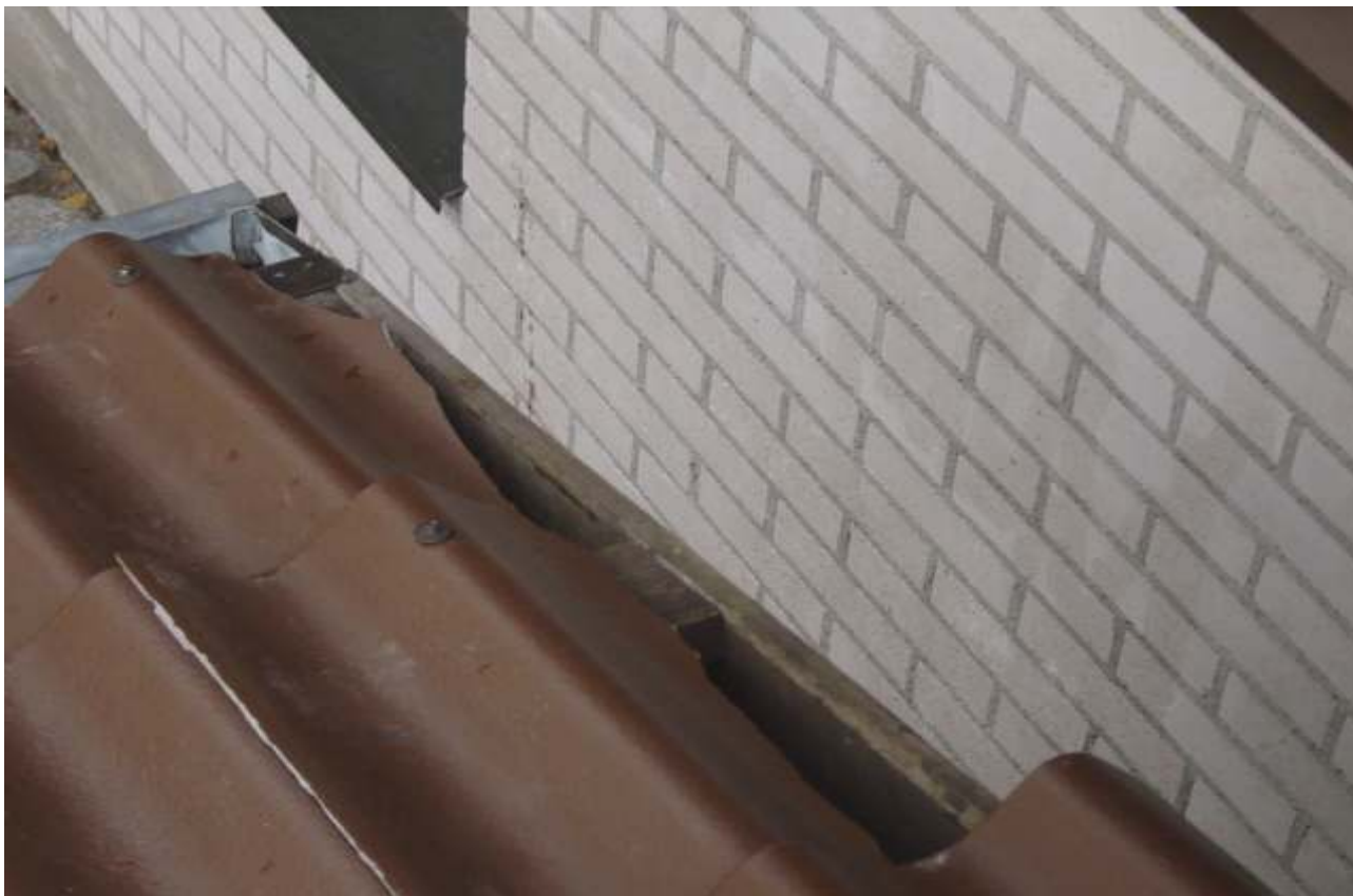
RAK-kuva 7. Päärakennuksen vesikaton on rikkoontunut kattolevy.
