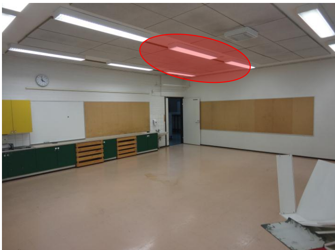
Luokkahuone 135 rajatulta alueelta katosta tullut vettä
