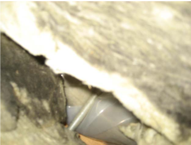
Kuva 69. Paikoin eristelevyt on asennettu yläpohjarakenteessa niin heikkotasoisesti, että höyrinsulkumuovi näkyy ullakotilaan (kuva on kohdalta, jossa eristeen päällä on todennäköisesti kuljettu, eristelevyjen saumoja/tai on auennut ja levyjä on liikkunut pois paikoiltaan).
