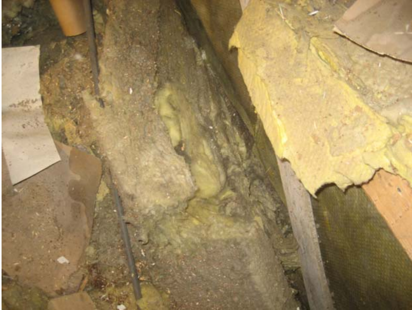
Kuva 40. Rakenneavauskohta AV.09–143. Avauskohtan ulkoseinän alapuolella olevan yläpohjarakenteen eristelevyt ovat poikkeuksellisen huonosti paikoillaan (joko alun perin huonosti asennetut eristeet tai eristeiden päällä jo liikuttu esim. kanava-asuennuksiin liittyen).
