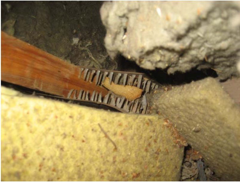
Kuva 24. Rakenneavauskohta AV.05–133. Kattotuolin naulalevyn kohdalla ei ollut eristystä ollenkaan. Myös kattotuolin sivulla on eristämätön ilmatila eristyskerroksessa. Kuva on otettu ennen kuin rakenteesta oli poistettu avaukseen liittyen eristettä.
