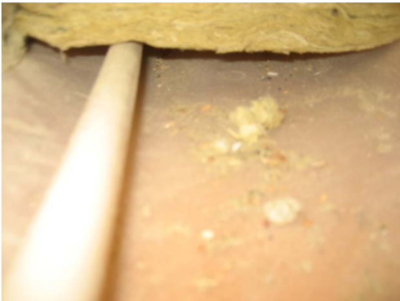
Kuva 33. Rakenneavauskohta AV.08-135. Sähköjohdon asennusputki on asennettu höyrynsulun päälle niin, että se painaa höyrynsulun kiinni kipsilevyyn ja saa aikaan eristeen ja höyrynsulun väliin ilmatilan (ilmataskun) ja painaa lisäksi paikoin myös eristesauvoja auki. Sähköjohdotukset olisi pitänyt asentaa höyrynsulun huonetilan puolelle koolauslaudoituskerrokseen, jolloin myös höyrynsulun lävisyltältä olisi välttytty (vrt. myös avaus AV.02-110).
