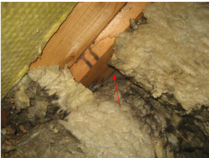
Kuva 17. Rakenneavauskohta AV.04–132. Kuvassa punaisella nuolella osoitetussa kohdassa ei ollut eristettä ollenkaan (kuvassa punaisen nuolen kärjen kohdalla näkyvä materiaali on höyrynsulkumuovikelmu).
