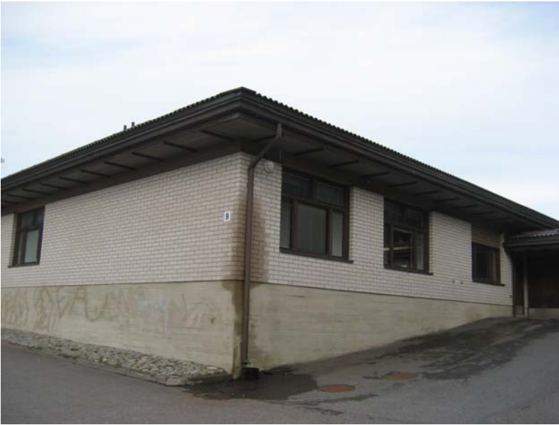
Kuva 60. Huonetilan 117 ulkoseinäkulmassa syöksytorvi vuotaa pahoin kastelleen ulkoseinäpintaa. Rakennuksen käyttäjien mukaan huonetila 117 sekä huonetila 119 ovat kylmimmät huoneet rakennuksessa.
