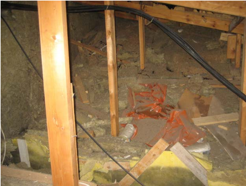
Kuva 72. Kuva ullakkotilasta (yläpohjan ontelosta). Paikoin tilaan on jätetty kaikki rakennusaikana (tai vesikateusinnan aikana) syntynyt rakennusjäte.
