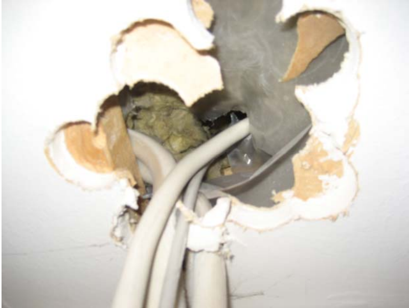
Kuva 5. Rakenneavauskohta AV.02–110. Höyrynsulkumuovi lävistyksessä on asennettu poikkeuksellisen huolimattomasti. Muoviin on tehty vain viiltoja, joiden kautta johdotukset on kuljetettu höyrynsulkumuovin yläpuolelta huonetilaan. Muovi- ja putkiliitosta ei tiivistetty mitenkään (ei esim. teippausta).
