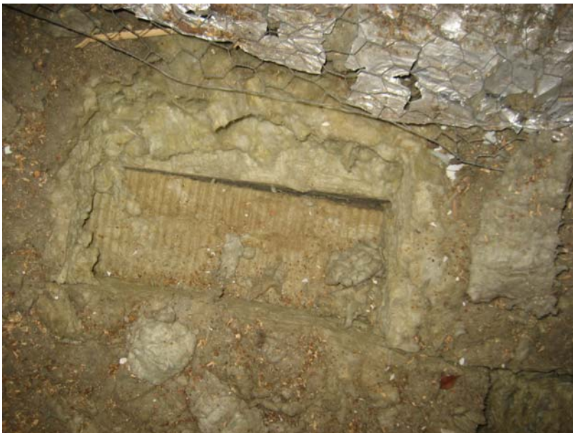
Kuva 30. Rakenneavauskohda AV.08–135 yläpohjan ontelotilasta käsin kuvattuna. Ullakkotilaa vasten oleva eristepinta on roskainen (sahajauhoa, koivun siementä jne.) ja mineraalivillajätepalat on jätetty eristepinnan päälle (ei ole poistettu). Kuvaa otettaessa oli pinnimäinen 125 mm paksu eriste jo poistettu avauskohdasta.
