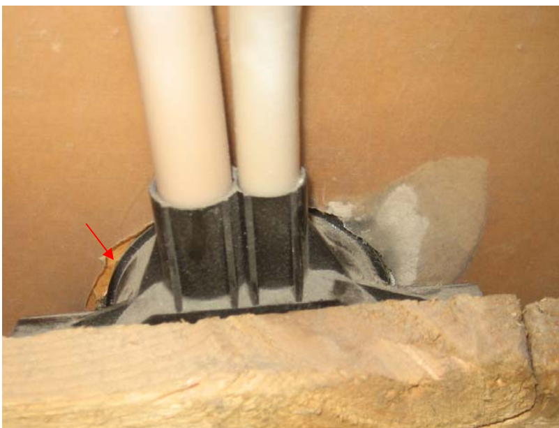
Kuva 38. Rakenneavauskohta AV.09–143. Höyrynsulkumuovin asennus on tässäkin lävistysrakenteessa tehty niin, ettei sulku muodosta tiivistä peittoa (muovia ei ole teipattu tai muutoin tiivistetty kiinni sähkörasiaan) ja rasian ja muovikelmun välinen sauma on auki, punainen nuoli).
