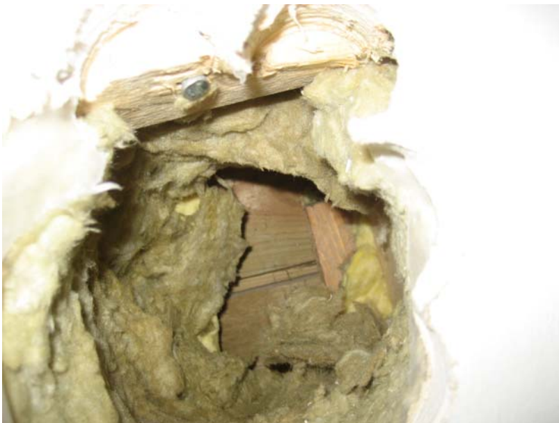
Kuva 2. Rakenneavauskohta AV.01–108. Kuvassa näkyy kipsilevyn ja höyrynsulkumuovin takainen vaakakoolaus sekä taaimpana ulkoverhoilupaneelin sisäpinta.
