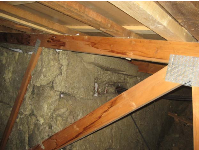
Kuva 65. IV-konehuoneen (huonetila 201) ulkoseinä ullakkotilasta kuvattuna. Eristeasennus on todella heikkotasoinen, seinän kantava tiilimuuraus paistaa villaeristeiden läpi, eristelevyt ovat epämääräisiä ja rikkoutuneita (onko eristelevyjä rakennusaikana säilötty huolimattomasti, onko kenties levyt asennettu toiseen kertaan tai onko rakenteiden suojaus rakennusaikana ollut puutteellista?). Tässä tutkimuksessa ei selvitetty tiilivilla-tiili-ulkoseinärakenteiden lämmöneristeiden kuntoa (seinärakenteissa ei lämpökuvauksissa ole havaittu varsinaisesti poikkeavaa), mutta myös em. ulkoseinät on syytä tutkia lisätutkimuksena eristeasennusten suhteen.
