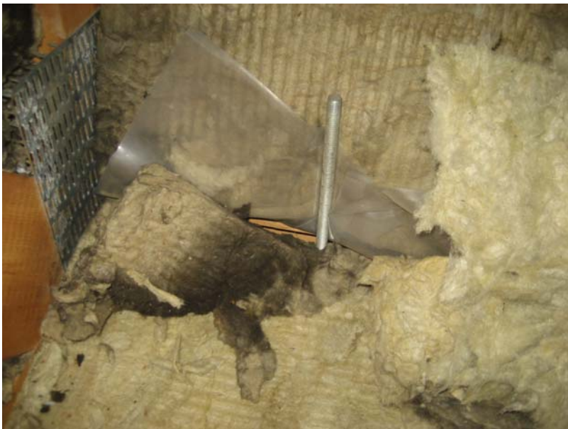
Kuva 11. Rakenneavauskohta AV.03-132. Yläpohjarakenteen vinokatto-osuuden höyrynsulku ei yhdy vaakakatto-osuuden höyrynsulkuun, liimapuupalkkiin liittyvän kierretangon kohdalla muovikelmu on vain taitettu lämmöneristelevyjen saumaan. Höyrynsulku on poikkeuksellisen huonosti asennettu. Tummat jäljet mineraalivillaeristeessä kertovat (kosteiden) ilmavirtauksen syntymisestä eristerokossa ja pölyn sitoutumisesta eristeeseen.
