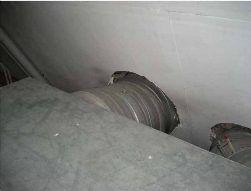
Kuva 64. IV-konehuoneessa (huonetila 201) ulkoseinässä olevat varaukset IV-kanaville on tiivistetty heikkotasoisesti eikä varaus täytä palo-osastointivaatimuksia missään muodossa.
