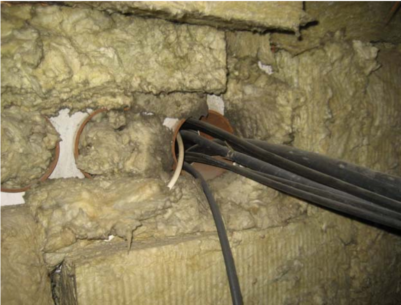
Kuva 66. IV-konehuoneessa (huonetila 201) ulkoseinässä ei sähköjohtojen lävistysvarausta ole tiivistetty ja eristetty asianmukaisesti, varaus ei täytä palo-osastointivaatimuksia. Mineraalivilla-asennus tiiliseinäpinnassa on heikkotasoinen.
