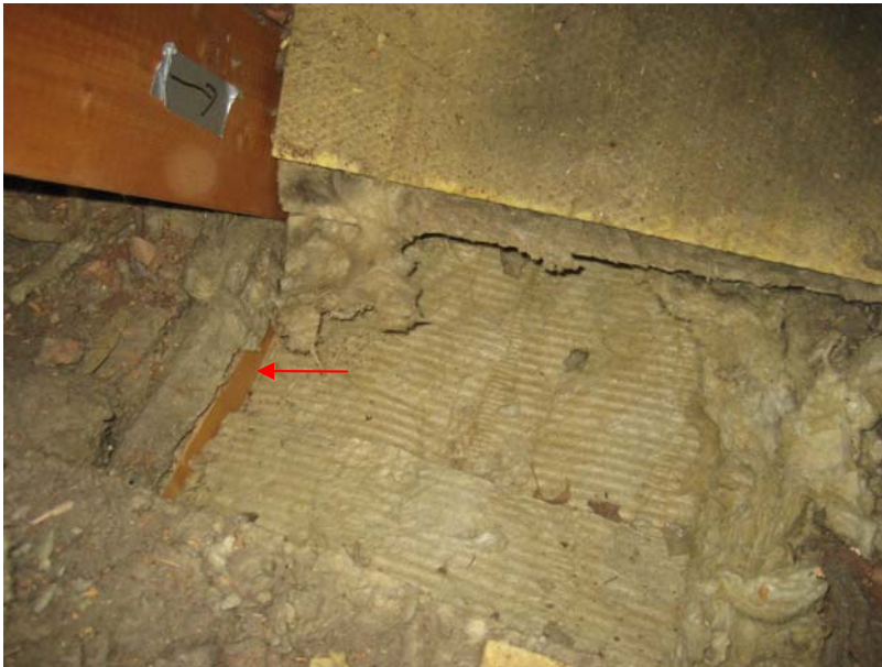
Kuva 10. Rakenneavauskohta AV.03-132. Kattotuolin alapaarteeseen liittyvän eristelevyn ja alapaarteiden välinen sauma on auki (saumassa on rako, punainen nuoli). Eristettä (eristelevyjä) on hieman painettu asentaessa kasaan (tai sitten eristelevyjen päällä on kuljettu siten, että eristelevyt ovat painuneet kasaan).
