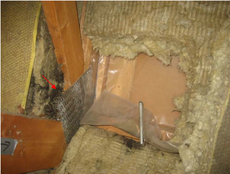
Kuva 12. Rakenneavauskohta AV.03-132. Kattotuolin kohdalla ei ole höyrinsulkua vaan se loppuu kattotuolin sivulle (muovikalvon reuna on taitettu eristelevyn saumaan). Höyrinsulkuasennuksessa (muovin saumoissa) ei ole käytetty tiivistystä (teippausta) ollenkaan eikä muovireunaa ole kiinnitetty muutoinkaan. Pääsääntöisesti muovikelmuja ei ole myöskään limitetty. Kuvassa kattoristikon naulauslevyn kohdalla (punainen nuoli) ei ollut mineraalivillaeristettä ollenkaan.
