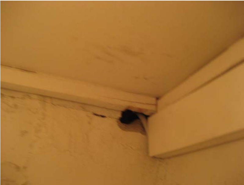
Kuva 62. Tiivistämätön varaus (kylmäsilta tavallaan) väliseinän ja yläpohjarakenteen rajakohdassa (yläpohjarakenteeseen menevät sähkö- ja/tai tietoliikennejohdot).
