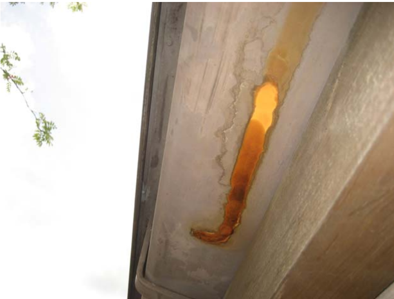
Kuva 61. Rakennuksen räystäskouruvuoto huonetilan 161 ikkunan kohdalla. Syöksytorvien ja räystäskourujen kunto on syytä tarkastaa, koska tässä tutkimuksessa havaittiin jo kaksi vuotokohtaa, vaikka syöksytorvia ja räystäskouruja ei varsinaisesti tutkittukaan.
