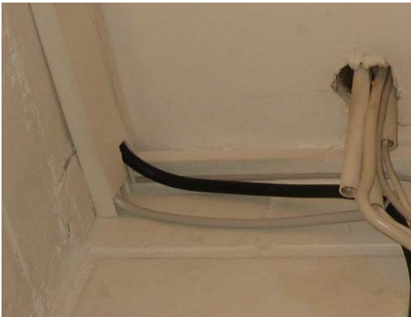
Kuva 4. Rakenneavauskohta AV.02–110. Yläpohjarakenteesta tulee huonetilaan 110 (puhelinkoppihuone) sähkö- ja tietoliikennejohdotuksia. Lävistysrakennetta ei ole viimeistely edes huonetilan puoleisen kipsilevytyksen osalta. Lämpökamerakuvauksessa on havaittu runsasta lämpövuotoa ko. lävistyskohdalla.
