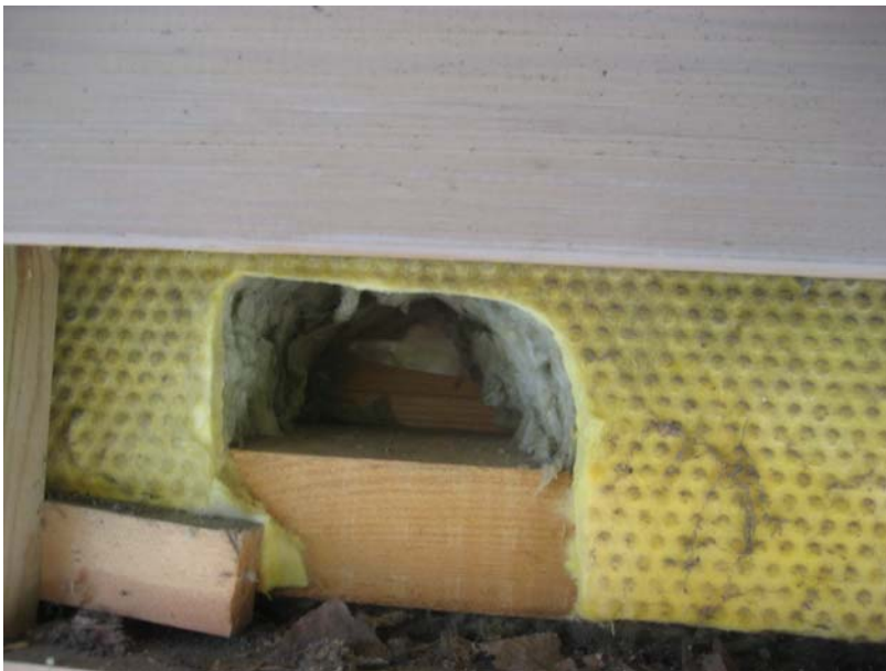
Kuva 52. Rakenneavauskohta AV.13–161 ulkotilasta käsin kuvattuna. Avauksen perusteella rakenteesta ei tehty merkkejä esim. tapahtuneista vesivuodoista tai syntyneistä kosteusvaurioista. Tuuletusraon koolausta on oiottu vaakasuuntaisiin kapuloin.
