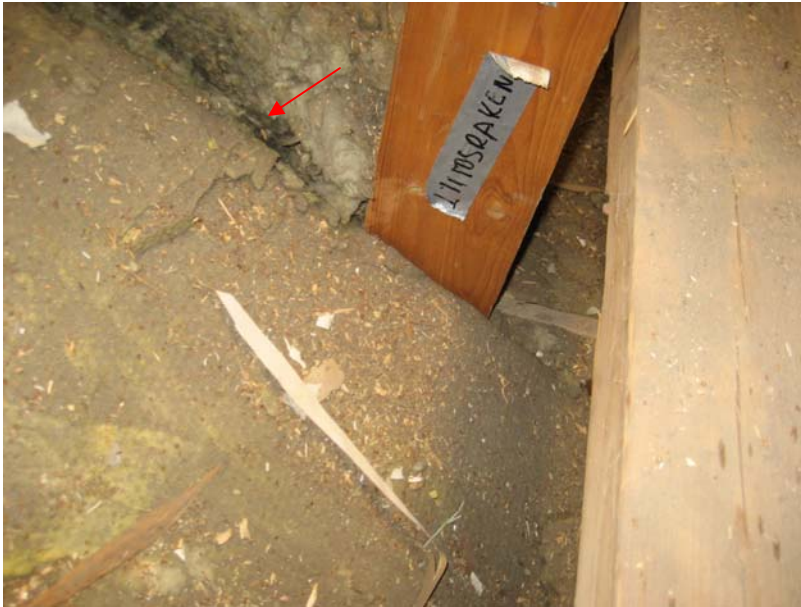
Kuva 19. Rakenneavauskohta AV.05–133 yläpohjan ontelotilasta käsin kuvattuna. Villapinta ullakkotilaa vasten on roskainen (sahajauhoa, puupaloja, koivun siementä jne.). Kattotuolin kohdalla eristeen yläpinta on muuta eristepintaa alempana (kattotuolin kohdalta puuttuu eristettä, punainen nuoli).
