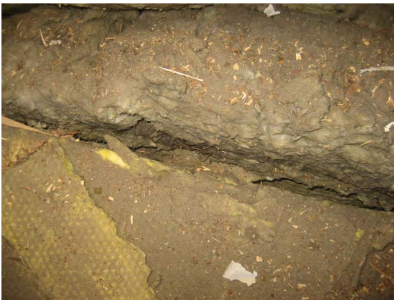
Kuva 20. Rakenneavauskohta AV.05–133. Avonainen eristelevyjen välinen sauma, sauma on auki yläpinnastaan useita senttimetrejä.
