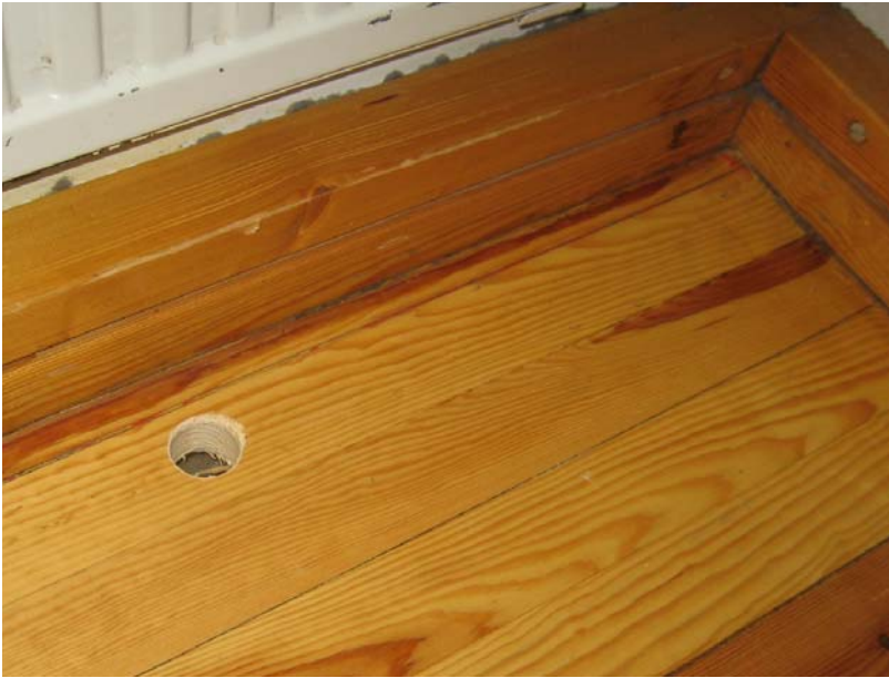
Kuva 43. Rakenneavauskohta AV.11–143. Avauskohdassa selvitetiin alapohjarakenteen rakennetyyppiä porareistä, havainnointi suoritettiin myös jalkalistan takaa lattialaudoituksen ja sisäkuorimuurauksen välisestä raosta.
