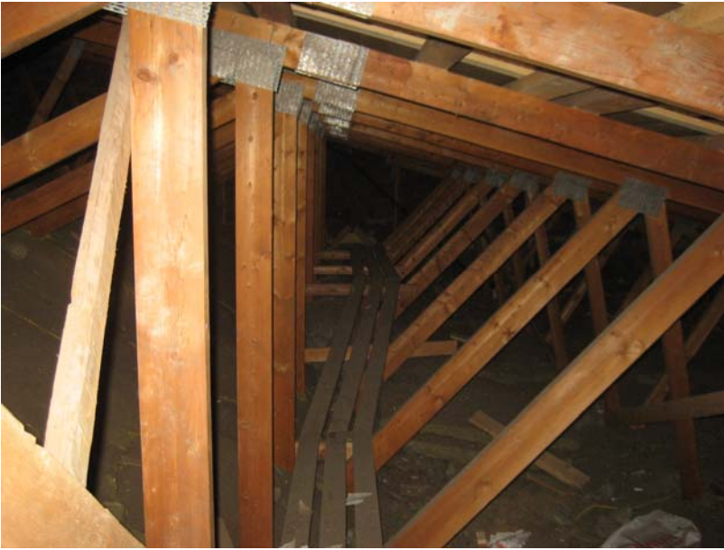
Kuva 76. Kulkusillat ullakotilassa (yläpohjan ontelossa) ovat hyvin kapeita ja kulku tilassa on hankalaa. Erityinen ongelma kulkuväylillä on pään lyöminen kattotuolin yläpaarteeseen matalassa tilassa. Lisäksi ullakotilaa ei ole valaistu.
