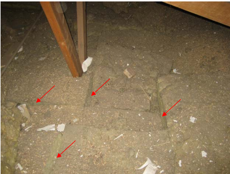
Kuva 73. Kuva ullakkotilasta (yläpohjan ontelosta). Ullakkotilassa (yläpohjan ontelossa) eristelevyjen pinta on hyvin roskainen (rakennusjätettä jne.), tilaan pääsee ulkoilmasta myös mm. koivun siemeniä. Eristelevy-asennus on heikkotasoinen, lähes kaikki eristelevyjen väliset saumat ovat jossain määrin auki (punaiset nuolet) ja levysaumastavat.
