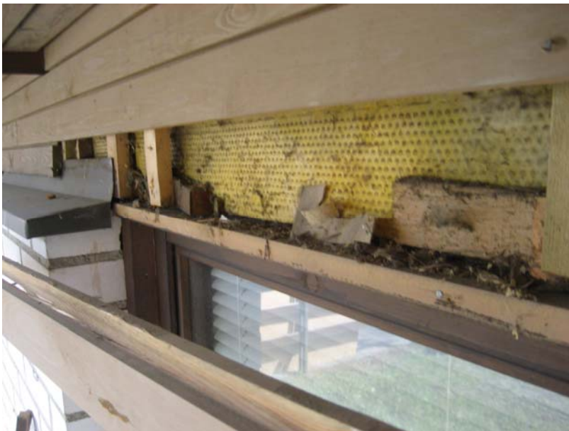
Kuva 50. Rakenneavauskohta AV.13–161 ulkotilasta käsin kuvattuna. Ikkuna-aukon peitelista ja ulkoverhouspaneeli ovat vastakkain niin, ettei ulkoilmasta ole suunniteltua rakoa ulkoseinän tuuletusrakoon (sama koskee myös tiiliulkokouren ja puupaneloinnin liitosrakennetta ikkunan vierellä).
