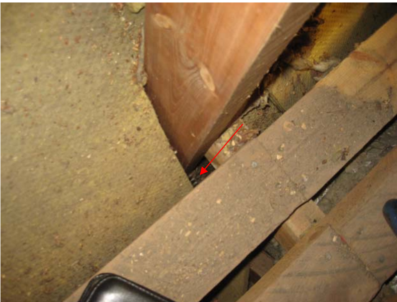
Kuva 67. Erityisen huonosti yläpohjarakenteissa on eristetty kattotuolien kohdat, kuvassa on punaisella nuolella osoitettu kattotuolisauvojen liitoskohta (naulalevyn kohta), jos eriste puuttuu kokonaan. Paikoin kattotuolin alapaarteen kohdalla ei ole mineraalivillaeristettä ollenkaan.
