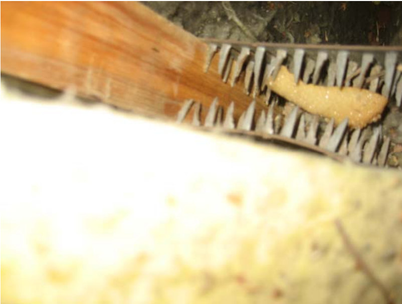
Kuva 68. Kattotuolien kohdalla ylesiesti eristettä puuttuu sauvojen (paarteiden) ylä- ja/tai alapuolelta ja erityisesti naulalevyjen kohdalla (kohdalla, jossa naulalevy ulottuu sauvan puupinnan yli).
