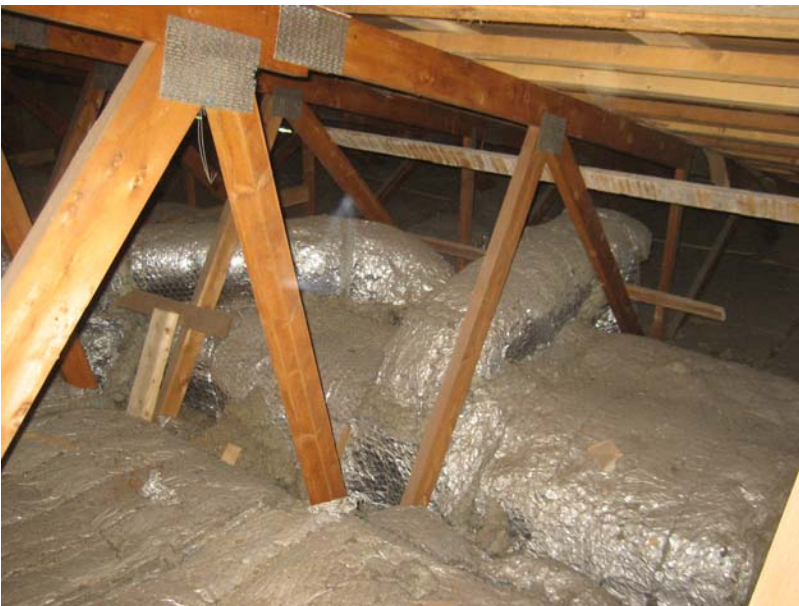
Kuva 75. Ullakkotilassa on paljon IV-kanavia, joiden huolto (puhdistus) matalassa tilassa on hankalaa. On todennäköistä, että kanavat on asennettu vasta se jälkeen, kun yläpohjarakenteen lämmöneristys on asennettu ja kanava-asennuksen yhteydessä on kuljettu eristepinoilla. Osa kanavista lepää yläpohjaeristeen päällä painaen melko kevyttä yläpohjaeristettä kasaan.
