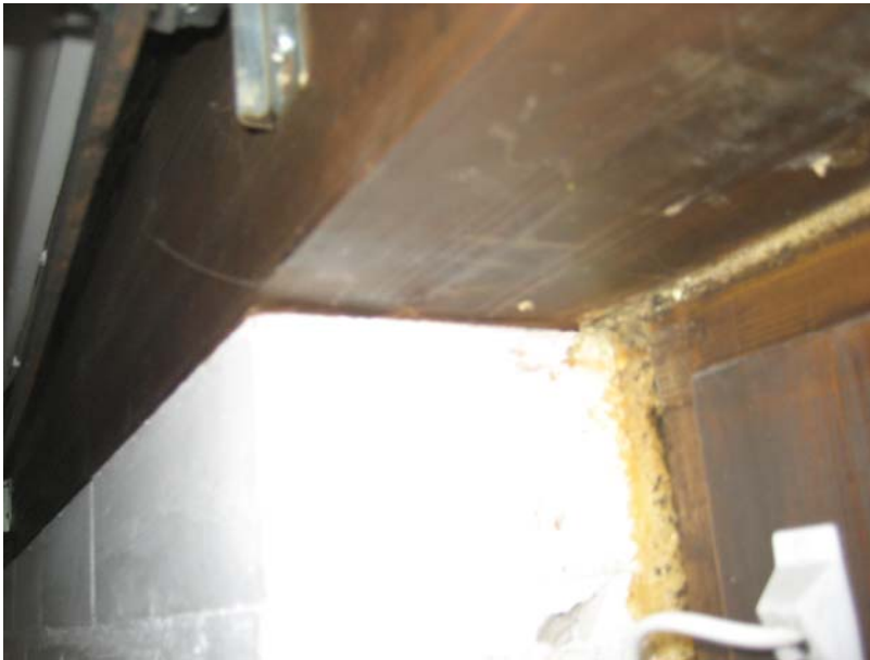
Kuva 27. Rakenneavauskohta AV.07-134 huonetilasta käsin kuvattuna (yläkarmisauma). Avaus suoritettiin poistamalla karmisauman puinen peitelistö. Karmisauman leveys on noin vain noin 5...6 mm, mutta kapeasta saumausraosta huolimatta polyuretaanivaahdon asennus on tehty asianmukaisesti.
