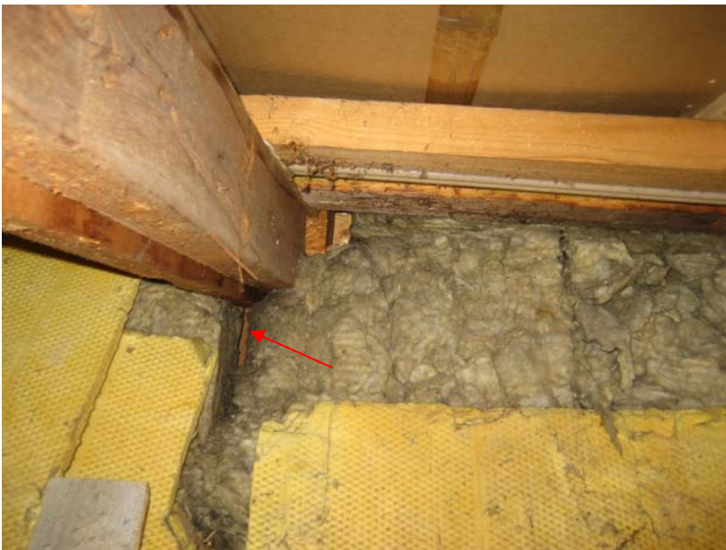
Kuva 71. Puuttuva tuulensuojalevypala. Eristevyn kunto tuulensuojalevyn takana on heikko (levy on rikkonainen). Paikoin eristystä liimapuupalkin/kattoristikon kohdalla ei ole ollenkaan (punainen nuoli).
