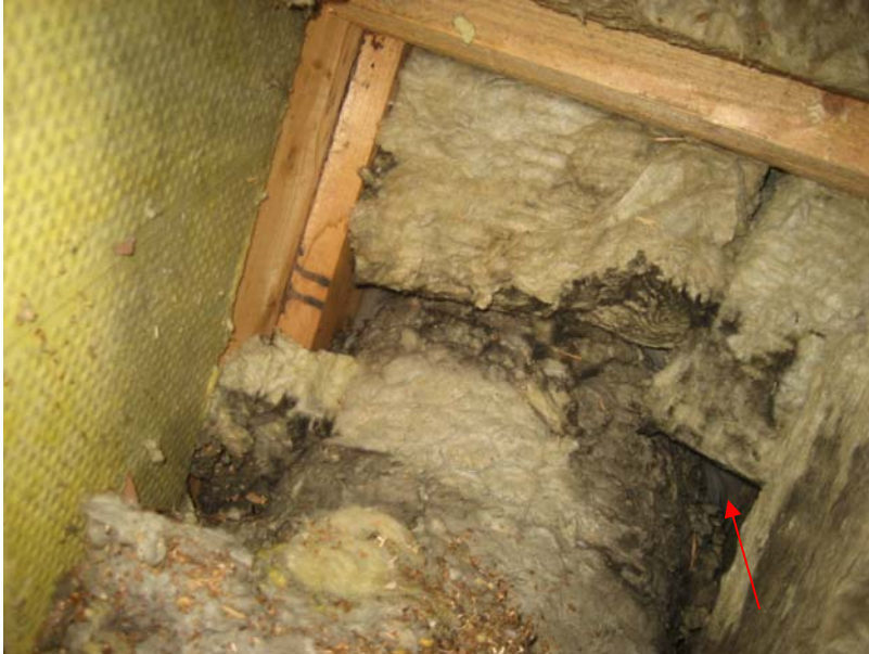
Kuva 16. Rakenneavauskohta AV.04–132. Kuvasta on pääteltävissä, että IV-konehuoneesta tapahtuu kanavavarausten kautta (kosteita) ilmavuotoja ullakkotilaan, mistä merkkeinä on eristepinnan tummuminen (pöly, ilmavirtaukset sinänsä, kosteat ilmavirtaukset erityisesti). Kuvassa punaisella nuolella osoitetussa kohdassa ei ollut eristettä ollenkaan.
