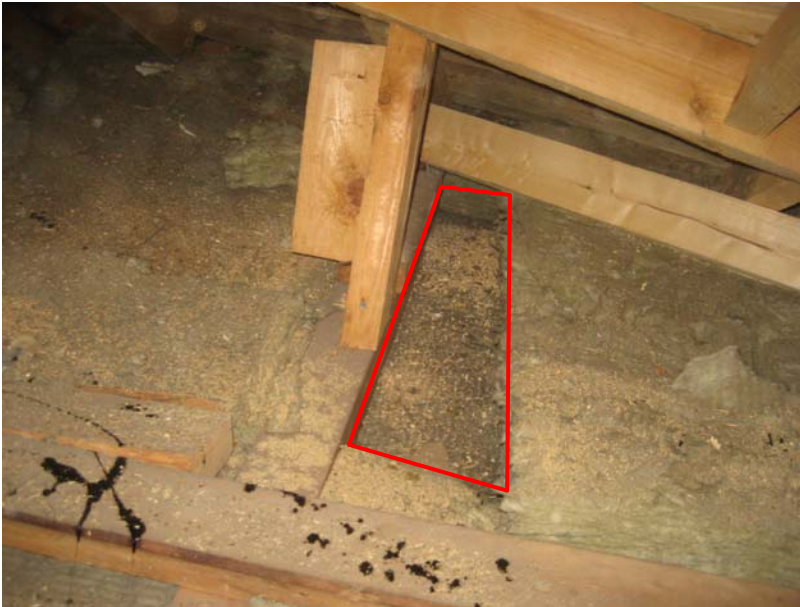
Kuva 70. Puuttuva eristelevypala (punaisella viivalla rajattu alue).
