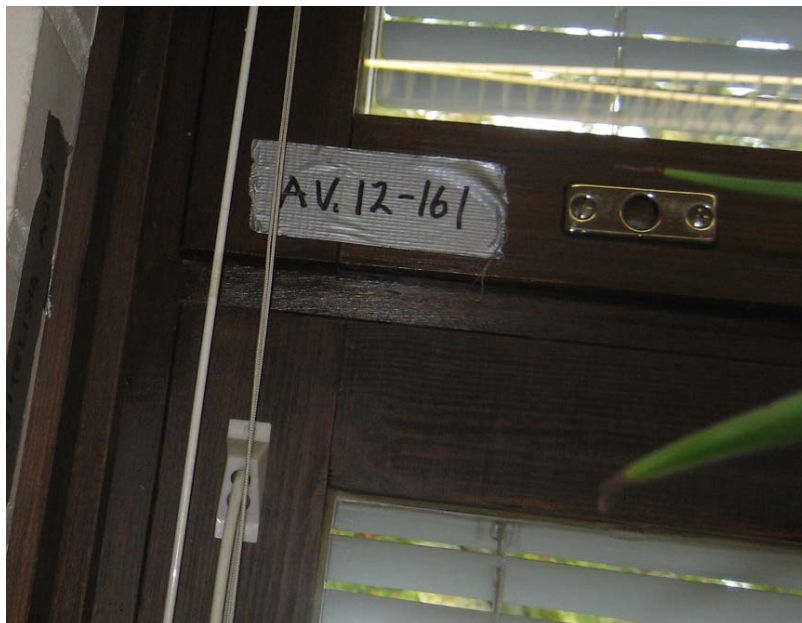
Kuva 46. Rakenneavauskohta AV.12–161. Ikkunapuitteiden välinen välikarmi (vaakakarmi) on umpipuitteita eikä siihen liity karmisaumaa. Lämpökuvauksessa todetut vuodot tapahtuvat puitteen ja karmin välisestä saumasta (ikkunatiiviste).
