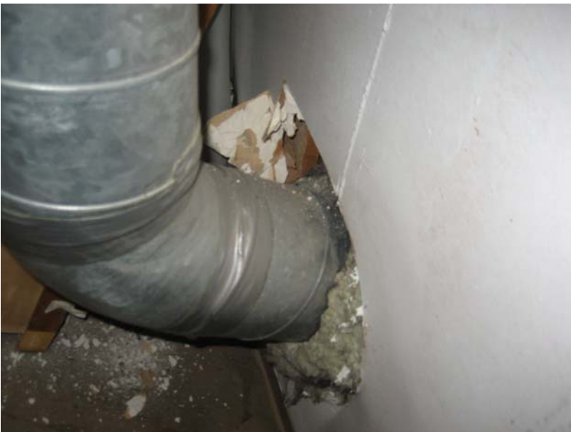
Kuva 63. IV-konehuoneessa (huonetila 201) ulkoseinässä olevat varaukset IV-kanaville on tiivistetty heikotasoisesti eikä varaus täytä palo-osastointivaatimuksia missään muodossa.
