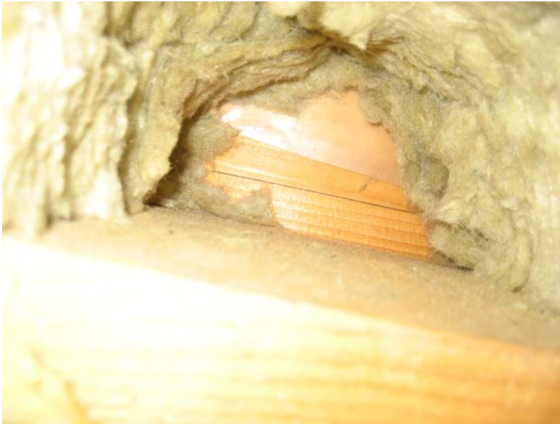
Kuva 53. Rakenneavauskohta AV.13–161 ulkotilasta käsin kuvattuna. Höyrynsulun reunaa ei tiivistetty (teipattu) kiinni liimapuupalkkipintaan.
