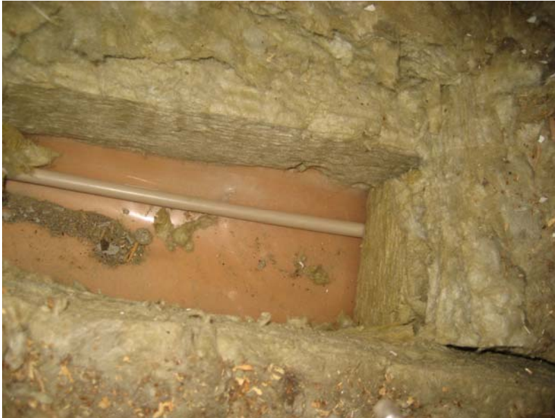
Kuva 32. Rakenneavauskohta AV.08-135. Kuvassa näkyy höyrynsulkumuovin pinnalle ullakkotilasta käsin asennettu sähköjohto (sähköjohdon asennusputki), jota ei ole huomioitu eristeasennuksessa (varaukset eristeessä putkijohdolle puuttuvat).
