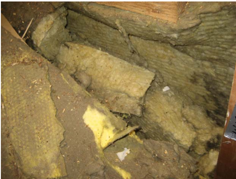
Kuva 21. Rakenneavauskohta AV.05–133. Kattotuolin kohdalla eristystyö on tehty huolimattomasti, leveysaumoja on auki eikä eristetilaa ole täytetty kokonaisuudessaan.
