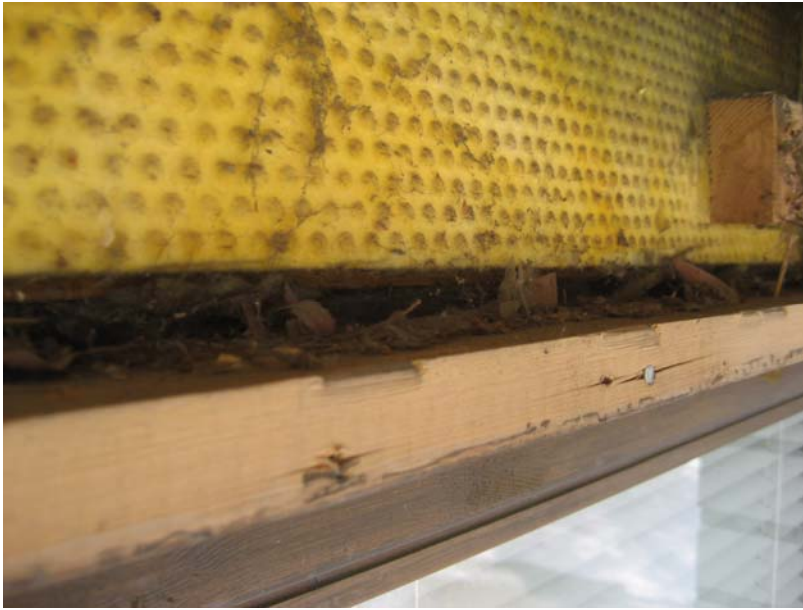
Kuva 51. Rakenneavauskohta AV.13–161 ulkotilasta käsin kuvattuna. Ikkunan yläkarmiin liittyvän karmisauman eristys olisi voitu ulottaa lähemmäksi tuulensuojavillan ulkopintaa (sauma on melkein eristämättömän liimapuupalkin ulkopintaan saakka). Ikkunakarmin päällys on kerännyt roskaa ulkoilmasta (lehtiä, puiden siemeniä jne.).
