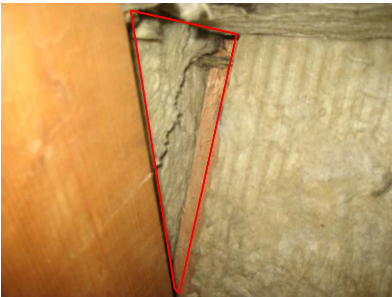
Kuva 13. Rakenneavauskohta AV.03-132. Kuvassa näkyvien kattoristikkosauvojen väliin jäävässä tilassa (punaisella viivalla rajattu alue) ei ollut mineraalivillaeristettä ollenkaan (oli ilmatila).
