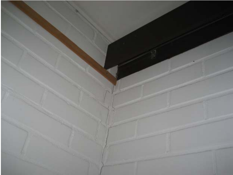
Kuva 29. Huonetilassa 134 oleva ulko- ja väliseinän välisen seinäkulman halkeama (huoneiden 117 ja 134 välinen väliseinä).
