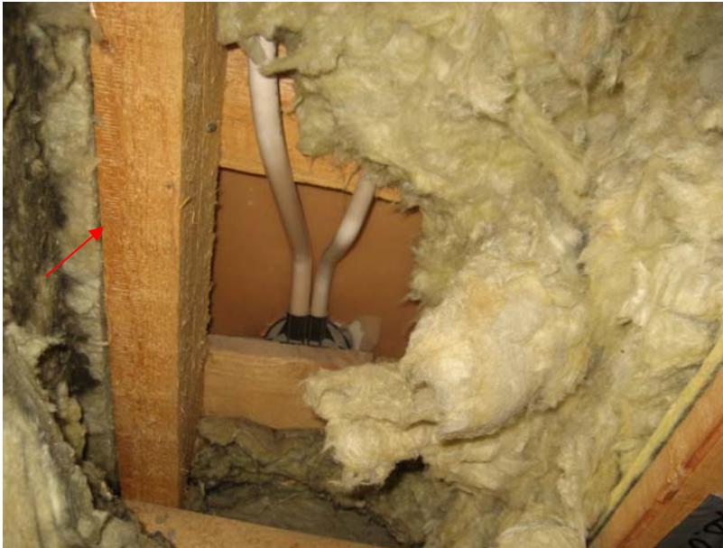
Kuva 37. Rakenneavauskohta AV.09–143. Kuvassa näkyy ilmaraossa oleva sähkörasia sekä huonetilan puoleinen rakennuslevytys (kipsilevy) ja höyrynsulkumuovi. Muovin sijoitus rakenteessa ei ole oikeaoppinen: muovin tulisi olla lämmöneristeen pinnassa niin, että ilmatilaan liittyvät koolaukset ja sähköjohdotuksen olisivat höyrynsulun huonetilan puolella (lämmöneriste tulisi ensisijaisesti asentaa kiinteää pintaa vasten). Eristelevyn ja 125x50-soiron välissä on melko leveä rako (punainen nuoli).
