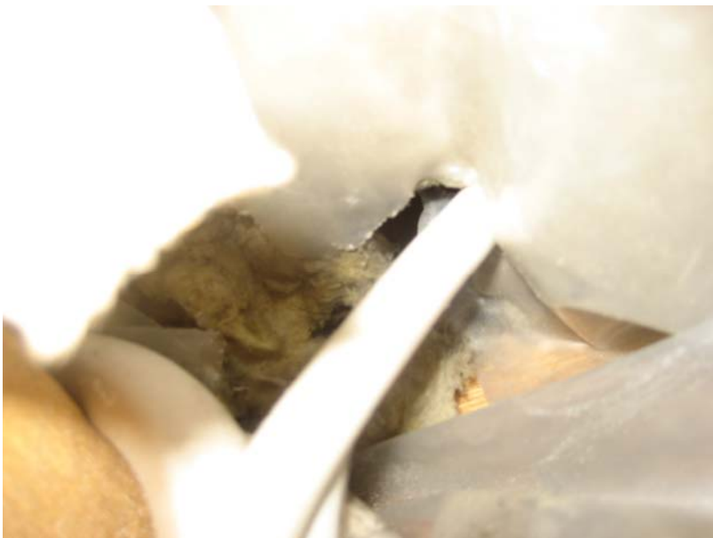
Kuva 6. Rakenneavauskohta AV.02–110. Lävistysvarauksen kohdalla myös lämmöneristeet on asennettu huolimattomasti (johdotuksien vierellä villatilassa on rakoja, villaa on sullottu epämääräisesti, villa ei täytä eristetilaa).
