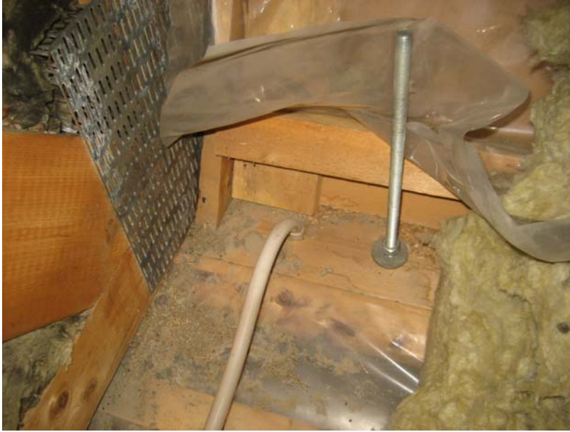
Kuva 14. Rakennearauskohta AV.03-132. Kuvassa näkyvän sähköjohdon suojausputken kohdalla eristelevy ei ollut työstetty ollenkaan (levyssä ei ollut varausta sähköjohdolle), mistä johtuen levy oli irti höyrynsulkumuovista (eristelevyn ja muovin välissä oli ilmarako). Yläpohjarakenteen vaakakatto-osuuden höyrynsulku loppuu vain liimapuupalkin päälle ilman kiinnitystä tai tiivistystä. Kuvassa näkyvä höyrynsulkuasennus oli olemassa oleva, muoveja ei ollut liikutettu ennen kuvanottoa.
