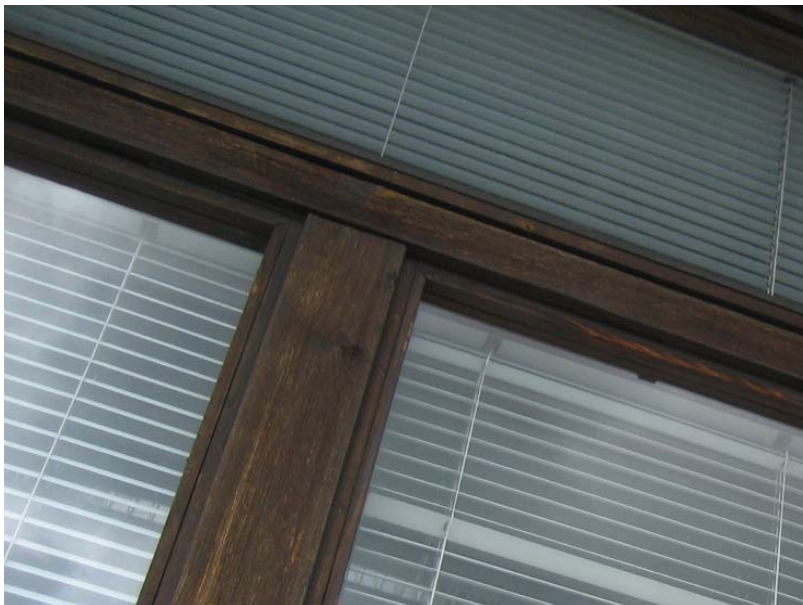
Kuva 25. Rakenneavauskohta AV.06–134 ulkotilasta käsin kuvattuna. Ikkunapuitteiden välinen välikarmi (vaakakarmi) on umpipuuta eikä siihen liity saumaa. Myös kuvassa näkyvä pystykarmi on umpipuuta.
