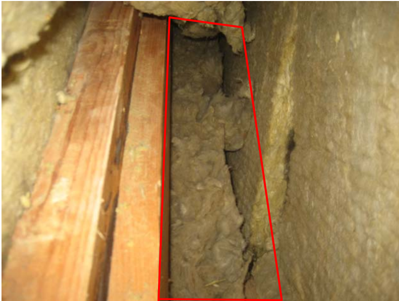
Kuva 22. Rakenneavauskohta AV.05-133. Kattotuolin kohdalla eristystyö on tehty huolimattomasti, leveysaumoja on auki eikä eristetilaa ole täytetty kokonaisuudessaan. Kuva on otettu ennen kuin rakenteesta oli poistettu avaukseen liittyen eristettä (punaisella viivalla rajattu alue kattotuolisauvan vierellä oli tyhjä onkalotila).
