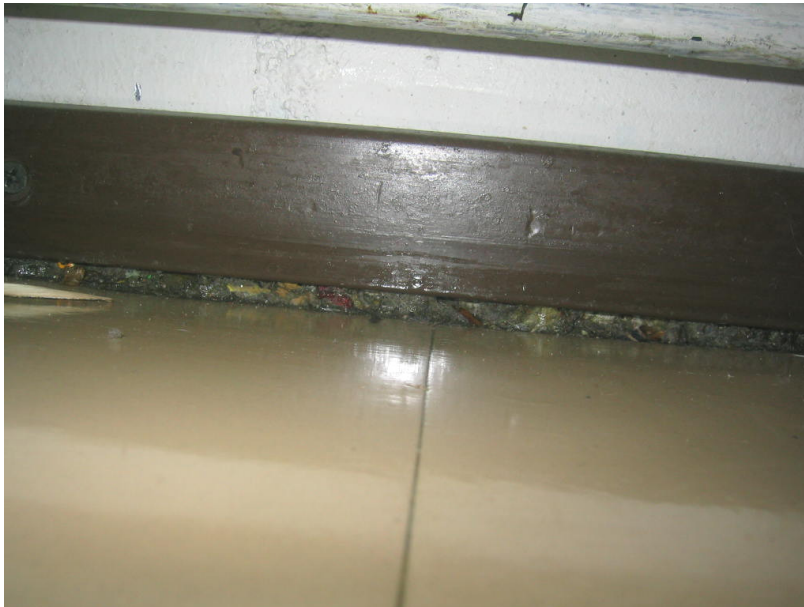
Kuva 6. Ulkoseinillä oli havaittavissa jonkin verran lattian painumista, joista ilmavirtaukset olivat hieman huonetilaan päin.
