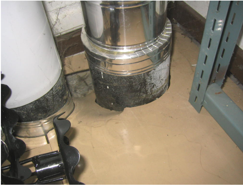
Kuva 7. Opettajien huoneessa olleen varaston 109 ulkoseinustalla oli täysin avonainen putkien läpivienti, josta on suora yhteys alapohjan maatyttöön. Kohdassa ilmavirtaukset olivat huonetilaan päin.
