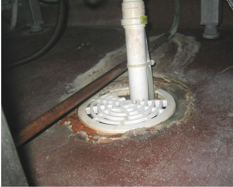
Kuva 9. Keittiön lattian pinnoite oli irronnut ja hajonnut lattiakaivon ympäriltä.
