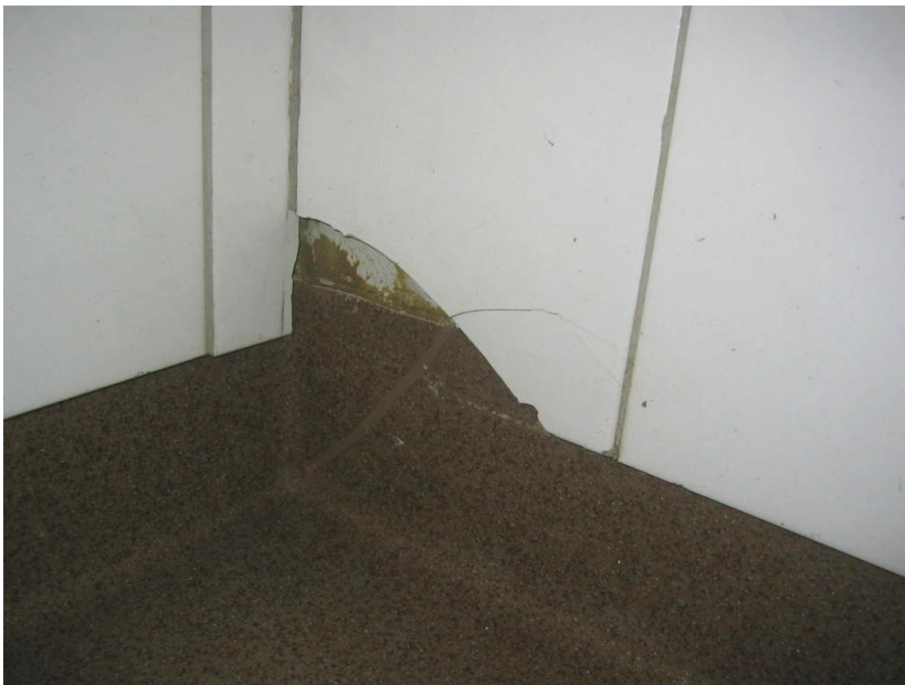
Kuva 10. Suihkutilojen seinälaatoitusten alimmat laatat olivat monin paikoin halkeilleet ja niistä oli irronnut paloja. Suihkuhuoneen 151 nurkassa maton ylösnoston yläreuna oli näkyvässä.
