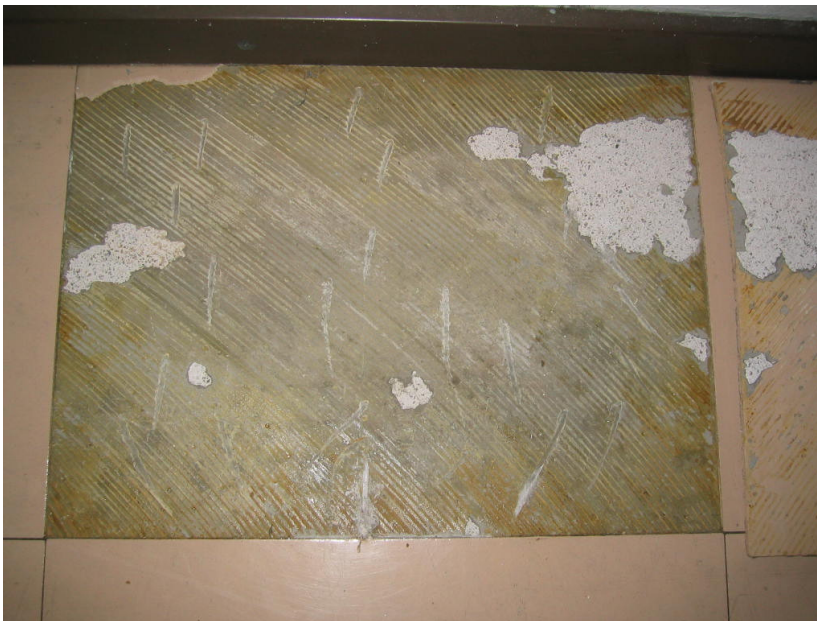
Kuva 8. Irrotetun vinyylilaatan reuna-alueilla oli selkeästi nähtävissä päältäpäin tulleen veden kellastuttamaa liimaa ja tasoitetta.
