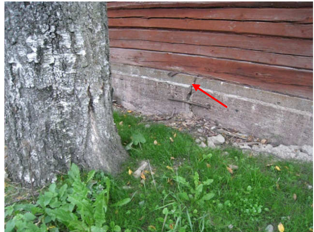
Kuva 4 Saunarakennuksen betonisokkelissa on useita halkeamia ja pinta on huono.
