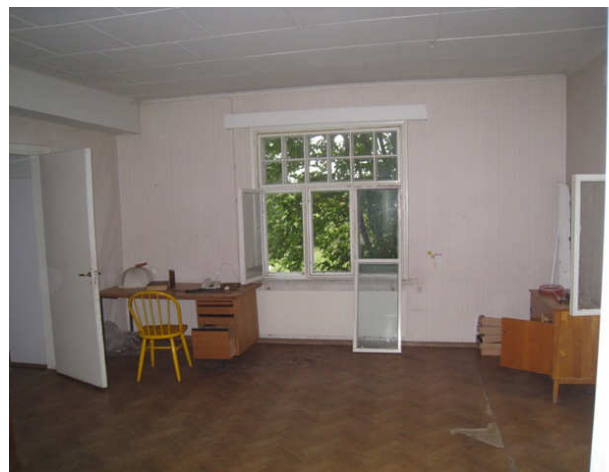
Kuva 48 Yleiskuva työnjohtajan asunnon alakerran olohuoneesta. Lämpöputket ovat lattiarakenteessa ja niissä on asbestipitoisia eristeitä.
