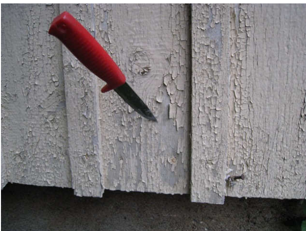
Kuva 29 Puukolla koestettiin puun kovuutta. Maalipinta on hyvin kulunut.
