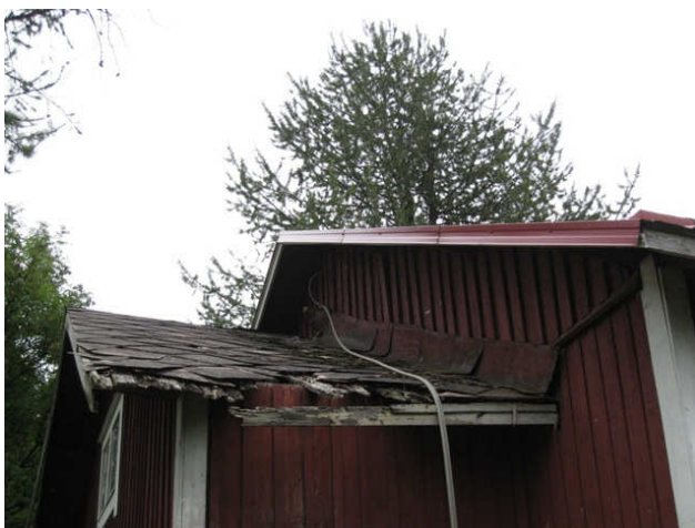
Kuva 17 Työväen asuinrakennuksen varaston katto on osin laho.
