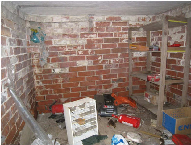
Kuva 43 Yleiskuva työnjohtajan asunnon kellarista, jonka tiiliseinät ovat märkiä.
