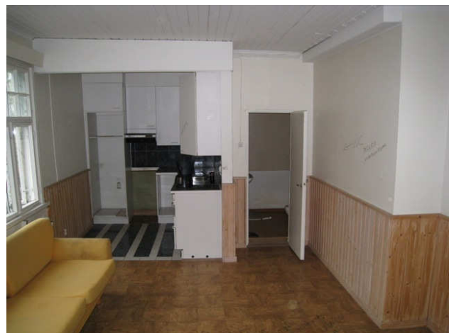
Kuva 54 Työnjohtajan asunnon yläkerran toisessa päädystä on olohuone-keittokomero, oikealla on wc-suihku-tilan avoin ovi.
