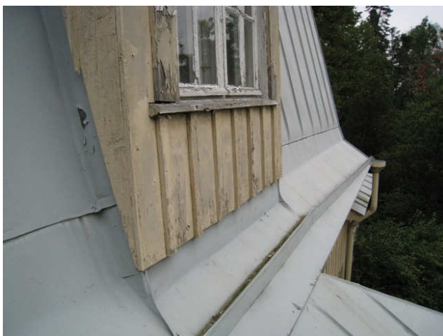
Kuva 35 Työnjohtajan asunnon yläkerran ikkunakaaveli on huonossa kunnossa.
