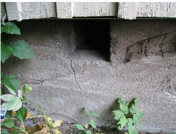
Kuva 41 Työnjohtajan asunnon sokkelissa on vain yksi tuuletusaukko alustatilaan.
