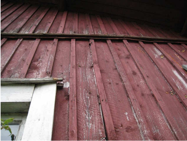
Kuva 13 Työväen asuinrakennuksen päätyseinässä rimasaumattu pysty-laudoitus on hatara.
