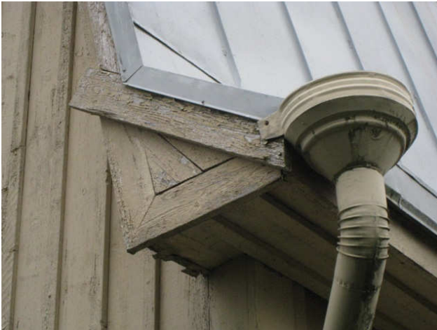
Kuva 33 Työnjohtajan asunnon räystäskoteloiden kunto on huono.
