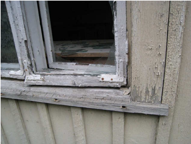
Kuva 31 Työnjohtajan asunnon keittiön ikkuna on rikki ja osin laho.
