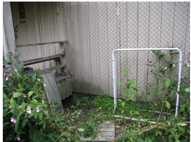
Kuva 40 Työnjohtajan asunnon kuistin seinävirrellä maanpinta on lähellä puuseinän alaosa ja maasto viettää taloon päin.
