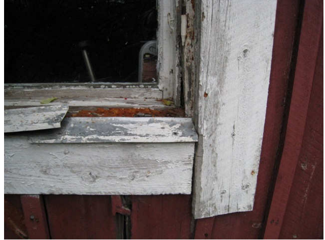
Kuva 14 Työväen asuinrakennuksen ikkunat ovat huonokuntoisia.
