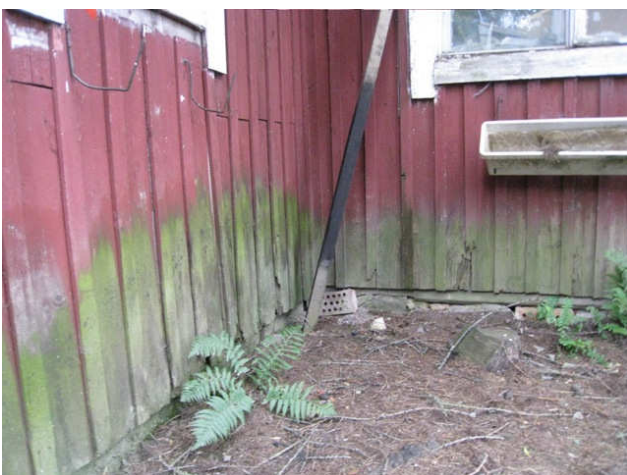
Kuva 11 Työväen asuinrakennuksen sisäänkäyntisivulla puuseinä on lähes maanpinnan tasalla ja se on kastunut roiskevesistä.
