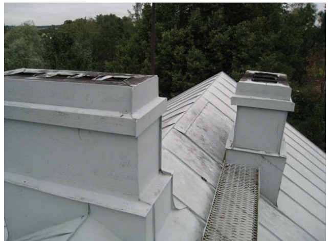
Kuva 36 Yleiskuva työnjohtajan asunnon vesikattolta, piiput on suojaamatta katoksella.
