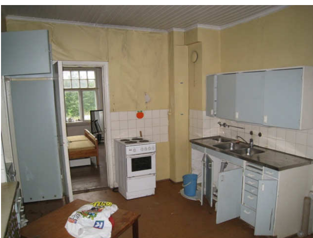
Kuva 47 Yleiskuva työnjohtajan asunnon alakerran keittiöstä, jossa voi havaita kantavien rakenteiden liikkuneen tai painuneen. Kalusteet ovat vanhoja.
