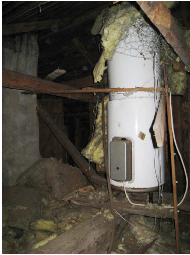
Kuva 19 Työväen asuinrakennuksen ullakolla oleva lämminvesivaraaja.
