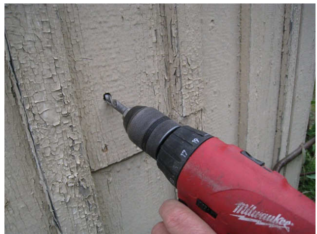
Kuva 30 Työnjohtajan asunnon ulkoverhouksen alla ei havaittu lisäeristettä..
