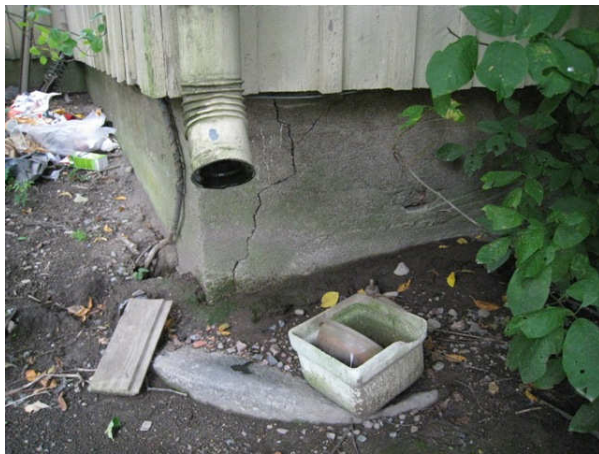
Kuva 39 Työnjohtajan asunnon perusmuurissa on halkeamia ja huono pinta. Sadevedet valuvat sokkelin juurelle.
