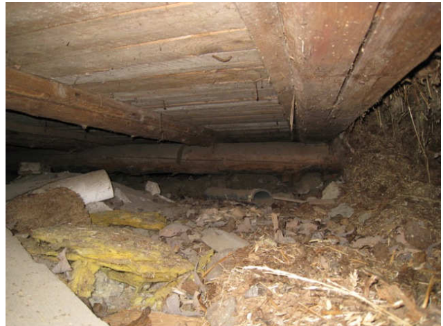
Kuva 16 Työväen asuinrakennuksen alapohjan alustatila,, oikealla turve-eriste on valunut alas..
