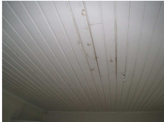
Kuva 50 Työnjohtajan asunnon alakerran katossa on vuotojälkiä yläkerran wc-sh:n alla.
