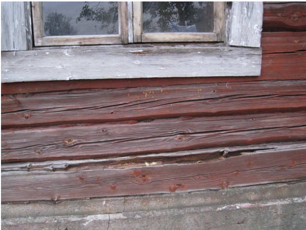
Kuva 3 Lahoja hirsii saunarakennuksen jokisivulla, ikkuna on huonokuntoinen.
