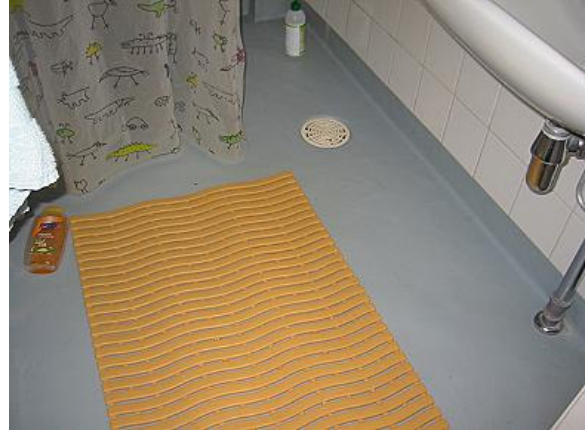
Kuva 16 2.kerroksen pesuhuoneiden muovimattoja paikoin irti alustastaan. Pintakosteuden korkeat jokaisessa. Kuva tilasta 73.
