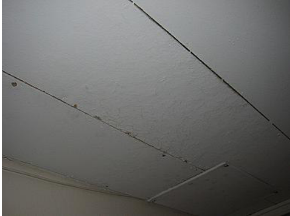
Kuva 15 Käytävän alakattolevyssä vanhoja, jo kuivuneita vesivuotojälkiä.
