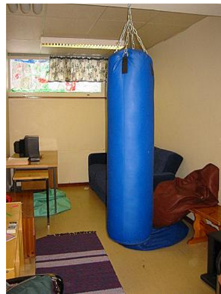
Kuva 12 1.kerrosn tilassa 47 emissioista johtu- vaa hajua. Tila hyvin kuuma. Pintakos- teuden tunnistimella ei havaittu normaali- sta poikkeavia kosteuksia.
