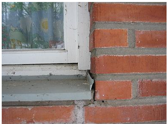
Kuva 6 Puutteellinen ikkunan vesipellin asennus.
