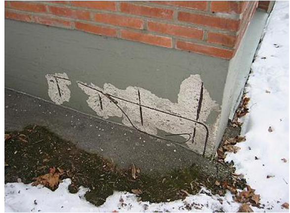
Kuva 4 Ruostunutta raudoitusta näkyvillä.
