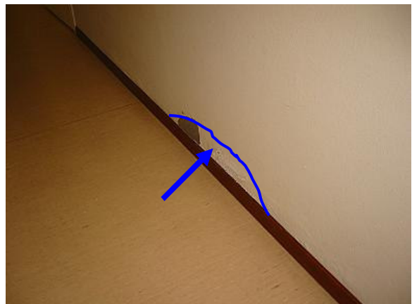
Kuva 8 Löylyhuoneen kohdalla väliseinässä normaalista korkeampi pintakosteus.
