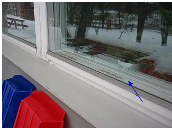
Kuva 2 Ikkunoiden rakenteissa kosteuden aiheuttamia jälkiä.
