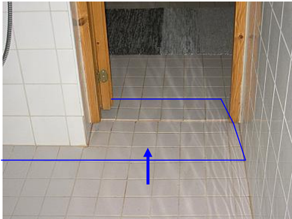
Kuva 11 Pesuhuoneen oviaukon kohdalla normaalia korkeampi pintakosteus jatku- en löylyhuoneen oven suuntaan.
