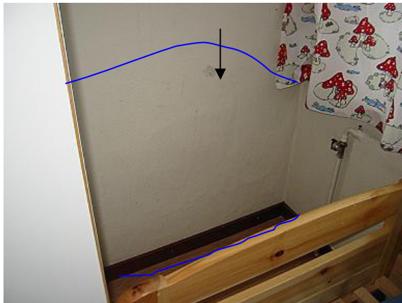
Kuva 17 Em. tilan viereinen makuuhuone (74). Seinässä (suihku toisella puolella) korkea pintakosteus ja jo näkyviä kosteusvaurioita.
