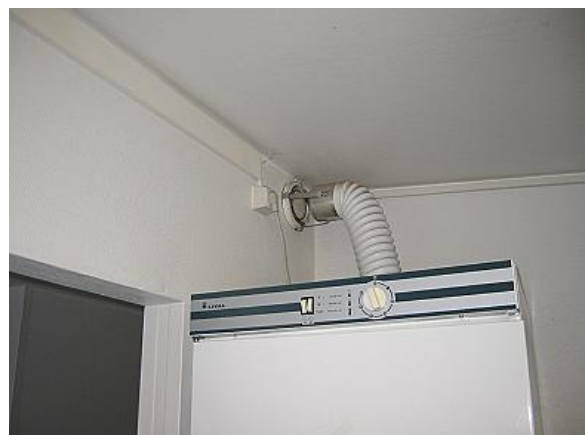
Kuva 20 Kuivauskaappien poistoilma johdetaan IV-kanaviin.
