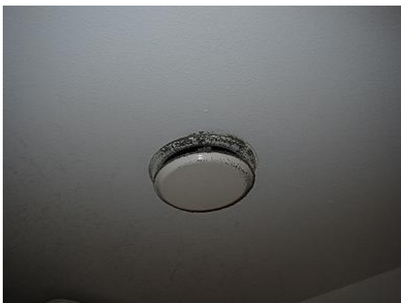
Kuva 19 IV-kanavat/ venttiilit likaiset.
