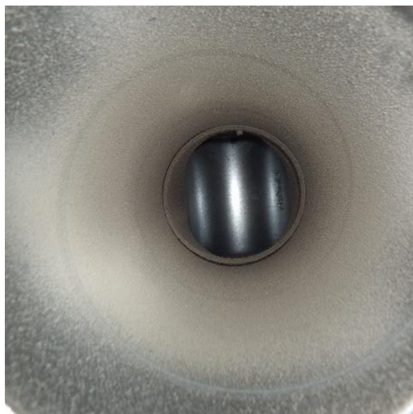
Kuva 4. Käytävän tuloilmakanavassa pölykertymää.
