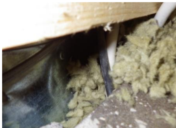
Kuva 18. Siivouskomeron kohdalla olevaa alapohjan ryömintätilan poistokanavan yläpohjan läpivientä ei ole tiivistetty yläpuolelta.
