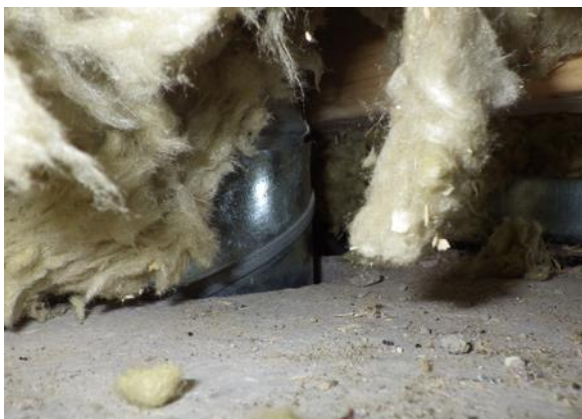
Kuva 17. Keittiön liesituulettimen poistokanavan yläpohjan läpivientä ei ole tiivistetty yläpuolelta.
