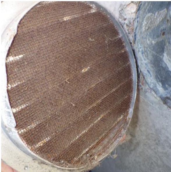
Kuva 11. Ryömintätilan ilmanvaihdon korvausil-masäleikköjen hyönteissuojat ovat tukossa.
