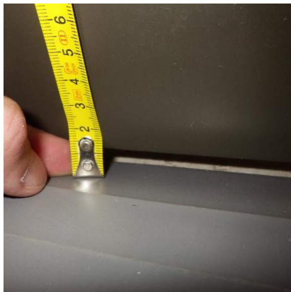
Kuva 14. Pesuhuoneen (057) oviraon korkeus on n. 10 mm.
