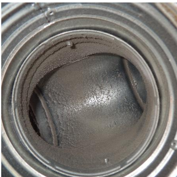
Kuva 3. Pesuhuoneen poistoilmakanava pölyinen.
