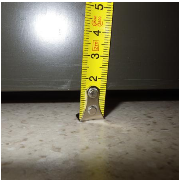
Kuva 13. Pesuhuoneen (051) oviraon korkeus on n. 15 mm.
