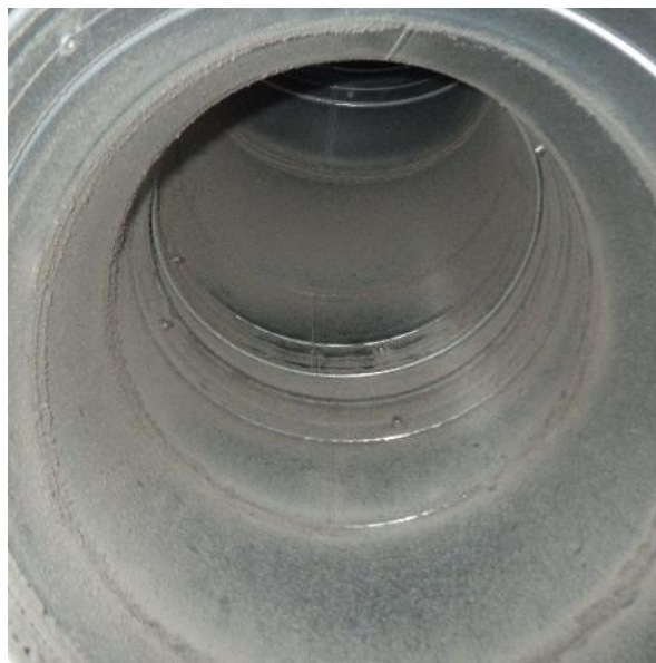
Kuva 6. Ilmanvaihtokoneelle tuleva poistoilmakanava pölyinen.
