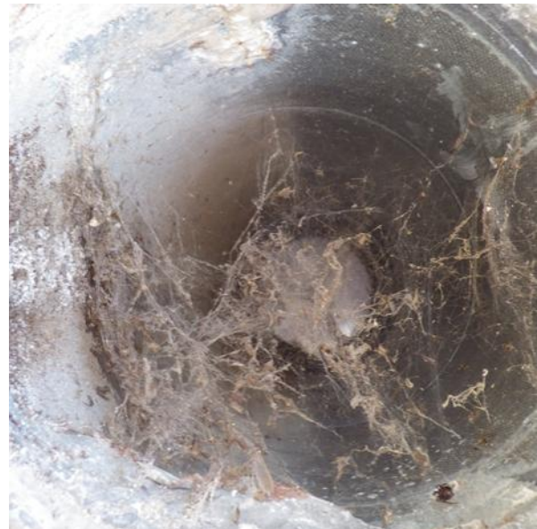
Kuva 12. Ryömintätilan perusmuurissa olevassa kor-vausilmakanavassa on pölyseittejä.
