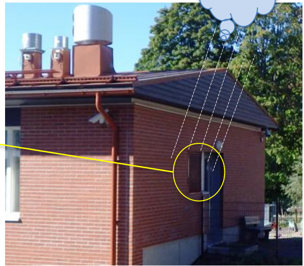
Kuva 10. Ulkoilmalaite (1) sijaitsee pohjoisseinällä.
