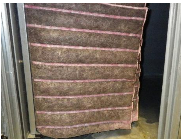
Kuva 7. Tuloilman suodatin on likainen. Suodatin on vaihdettu 14 kk sitten. Suodatinkammion pohjalla havaittavissa veden kertymisestä aiheutuneita jälkiä.
