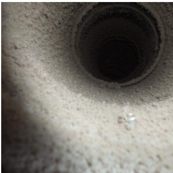
Kuva 5. Tilan 050 poistoilmakanava on erittäin pölyinen.
