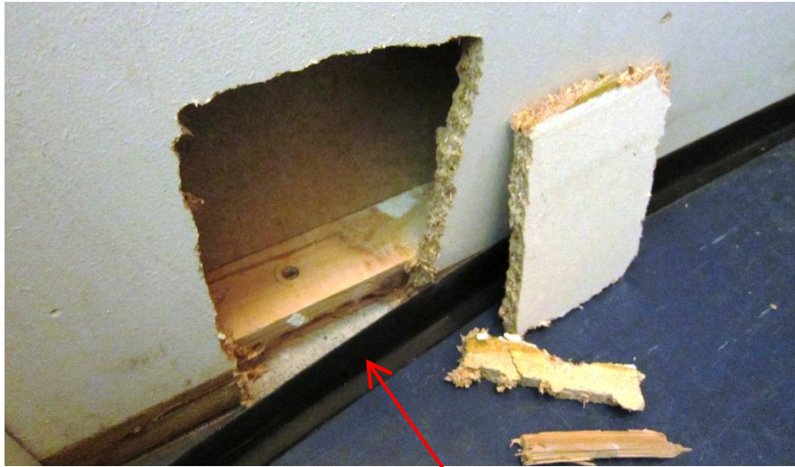
Kuva 9. Väliseinän alajuoksu on betonirakenteista alapohjaa vasten. Alajuoksusta on irrotettu pala mikrobianalyysiä varten.
