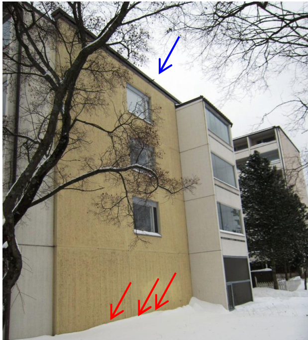
Kuvat 3 a ja b. Kosteusmittausten perusteella rasitetuin on ulkoseinän alaosa rakennuksen länsipuolella (punaiset nuolet). Kohdalla sijaitsee vesikaton ulosheittoputki (sininen nuoli).
