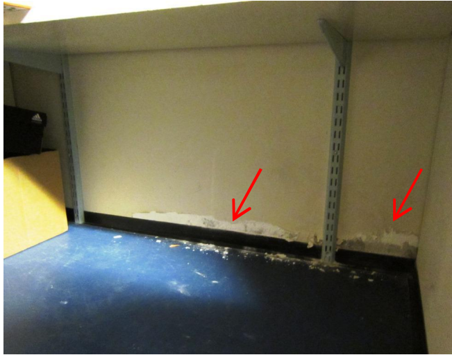
Kuva 7. Maali- ja tasoitepinnan kupruilua ulkoseinällä opettajien huoneen yhteydessä olevassa varastossa.
