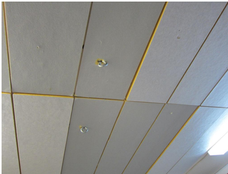
Kuva 12. Kuva askarteluhuoneen katossa olevista akustointilevyistä. Levyjen sivut ovat pinnoittamattomia. Kiinnikkeiden kohdalla on näkyvissä mineraalivillaa.
