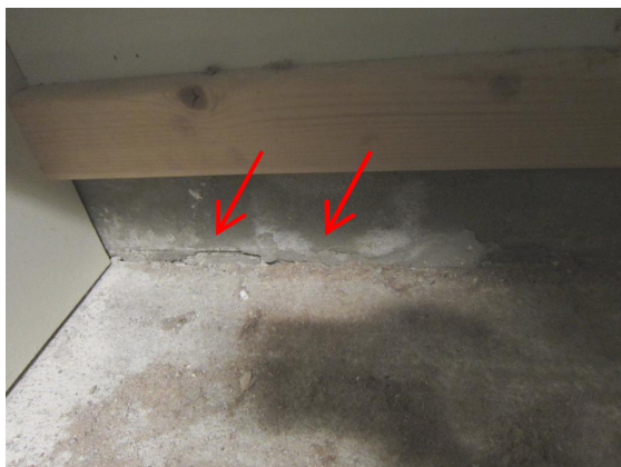
Kuva 5. Alapohjan ja ulkoseinän liittymä opettajien huoneessa ulkoseinää vasten olevan kaapin kohdalla.
