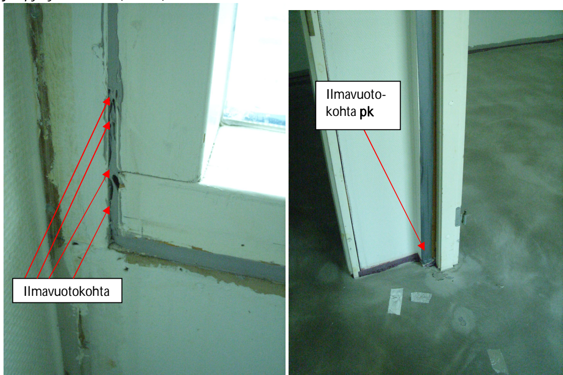
Kuva 4 (vasen). Tarkasteltu ulkoseinä us 106 . Tiivistysmassan asennus oli toteutettu huolimattomasti. Kuva 5 (oikea). Huonetilojen 113 ja 114 välinen oviaukko. Kaikki merkkiainekokein havaitut alapohjan ilmavuotokohdat olivat oviaukkojen pystykarmien kohdalla.
