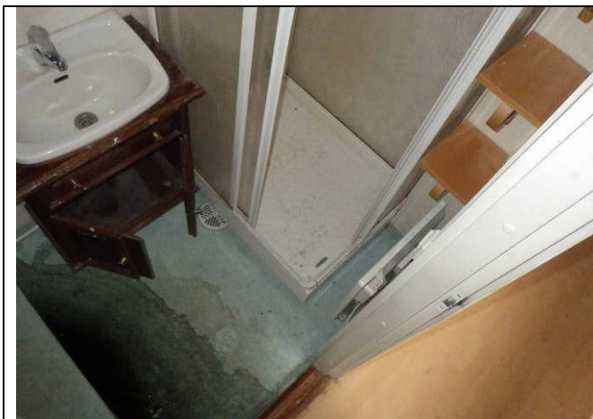
23. Suihkutilaa, lattialle on valunut nestettä.
