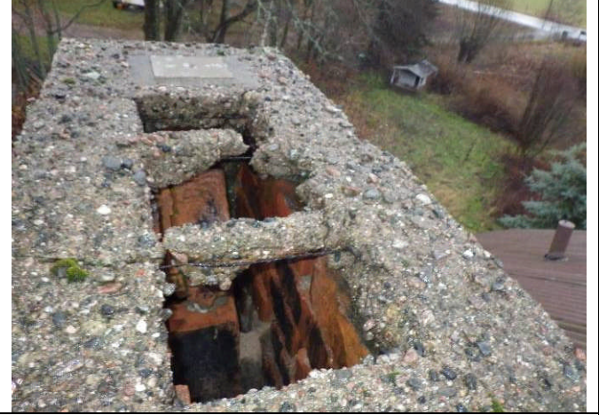
16. Hormin lakivalu on pahoin vaurioitunut ja tiiliä on irronnut.
