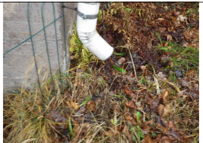
8. Sadevesiä ei ole ohjattu ohjeistuksen mukaan riittävän kauaksi rakennuksen vierustalta vaan ne ovat kastelleet perusmuuria.
