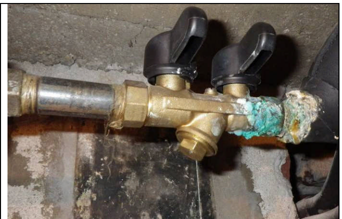
36. Vesiputkistossa on runsaasti vuotoja.
