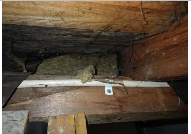
22. Vиноjen sisäkattojen tuuletusaukot ovat tarkastettavissa kohdissa ummessa, yläpohjarakenteen ja katteen välissä. Laudoissa on tummumaa.
