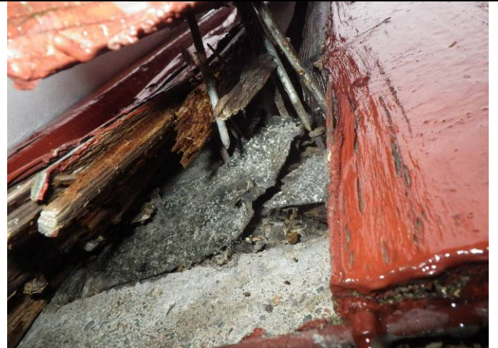
14. Tervapahvista tehtiin havainto seinärakenteen alaosasta.
