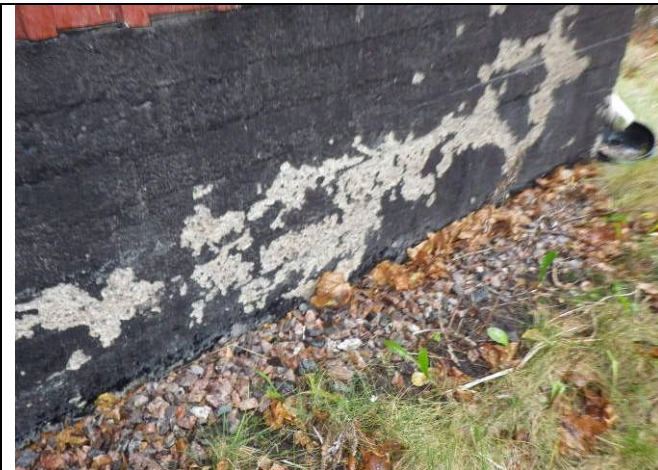
1. Rakennuksen sokkelipinnoilta irtoaa maalia.
