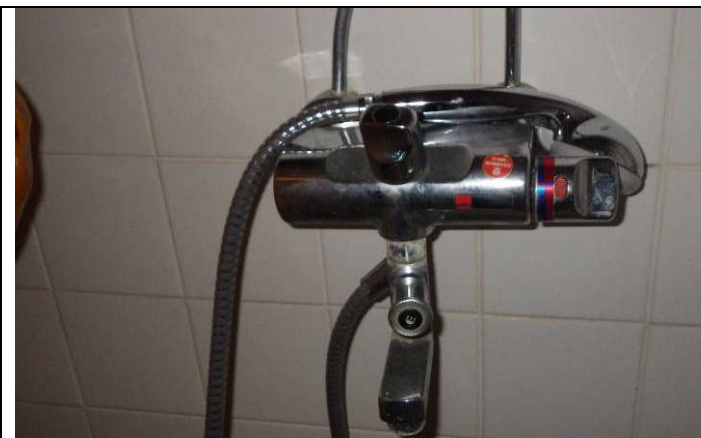
35. Vesikalusteet tulevat uusittaviksi.
