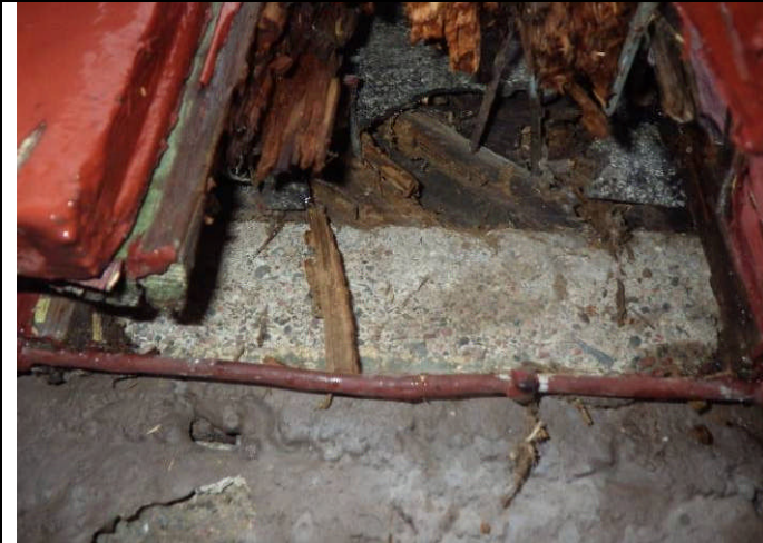
13. Rakennuksen julkisivuverhouksen alaosissa havaittiin laajalti lahovaurioita.
