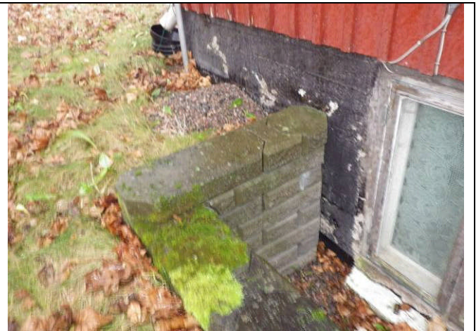
2. Rakennuksen vierustaa. Maanpinta on lähellä kellarin ikkunaa aiheuttaen kosteusrasitetta ko. kohtaan.
