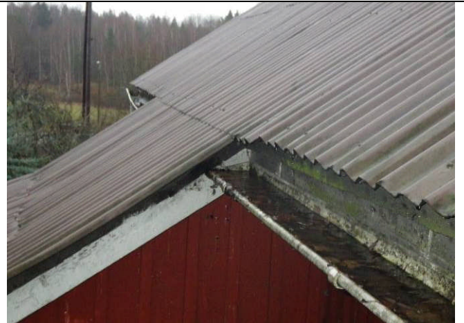
18. Otsalautoitus on sammaloitunut ja osittain vaurioitunut. Räystäskourussa seisoo vesi.
