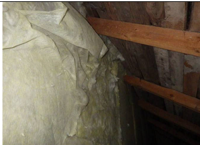
20. Yläkerran makuuhuoneiden sivuseinät on lämmöneristetty kattoon saakka tukkien tuuletusaukkoja.
