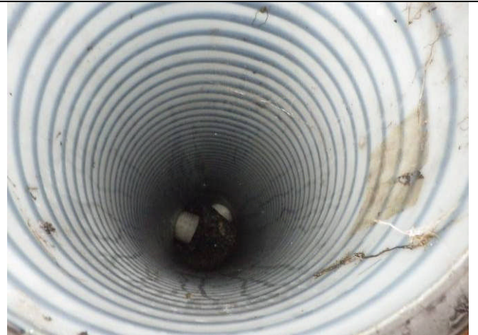
6. Salaojien tarkastuskaivo johon sadevesiä on ohjattu.
