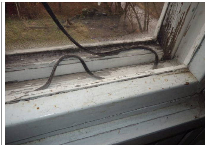
13. Ikkunoissa olevat vauriot vaativat kunnostusta
