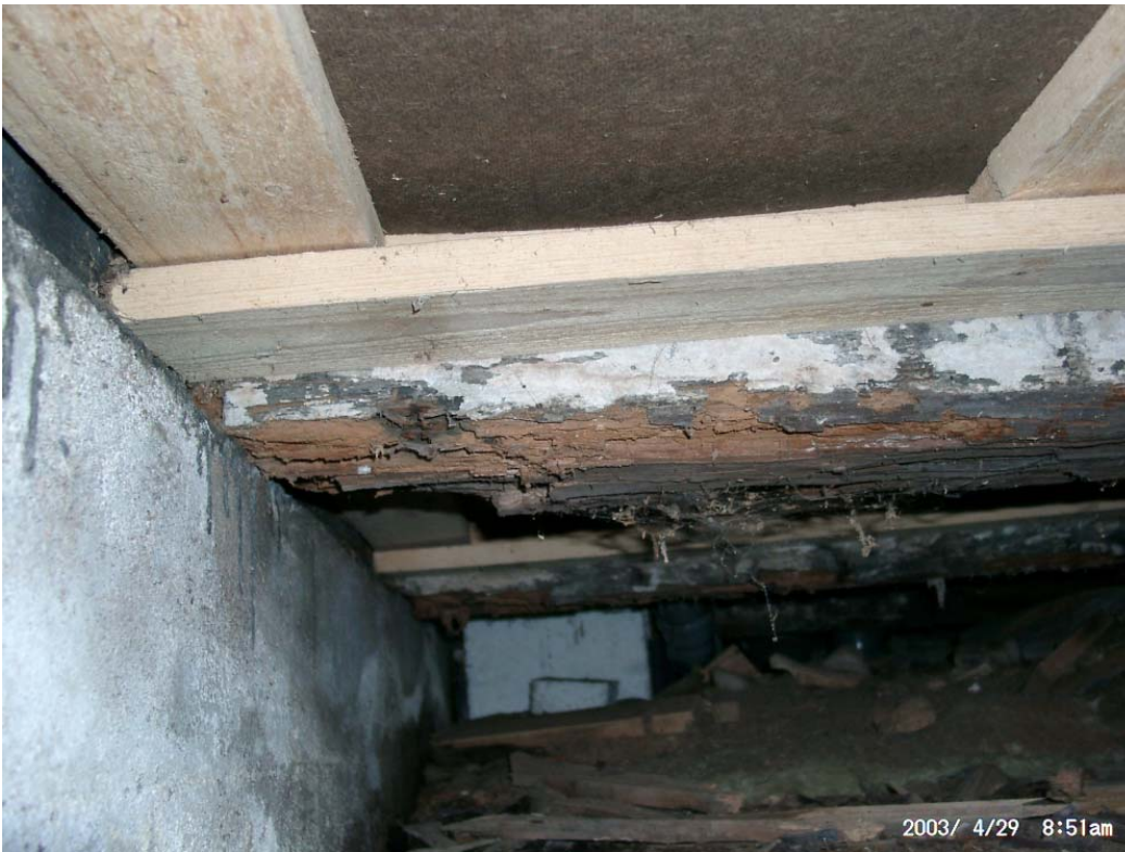
Kuva 1. Eteisen kohdalla oli alapohjan kannattajien alapinnalla jonkin verran havaittavissa lahovaurioita . Lahovauriot lienevät kuitenkin pääasiallisesti kannattajien alapinnalla, koska niitä ei ole uusittu eteisen alueen muun alapohjajakorjauksen yhteydessä.
