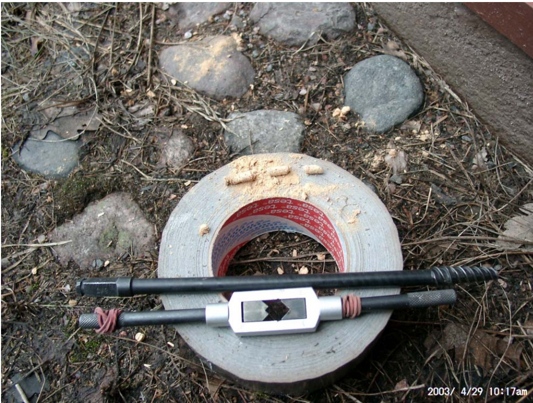
Kuva 11. WC:n kohdalta otettu puunäyte. Vuosilustokaira porattiin seinään miltei kokopituudeltaan ja näytteeksi saatiin vain hieman puuta ja puujauhoa. Hirttä näytteeseen olisi pitänyt saada ulkovuorauslaudoituksen alta ainakin ~100 mm, kun sitä saatiin vain ~30 mm. Hirsi vaikuttaa jonkin hyönteisen tuhoamalle. Asia tulee selvittää julkisivun huoltomaalauksen yhteydessä .
