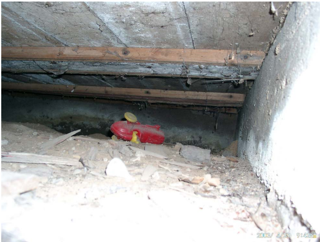
Kuva 8. Kaakkoisnurkalla alustilassa oli havaittavissa sokkeleiden pinnalla kosteuden aiheuttamia valkoisia kalkkijälkiä . Kuitenkin hiekkapohjalla olevat roskat ja puunpalat vaikuttava vaurioitumattomille, joten vaikuttaa sille ettei alustilaan olisi päässyt vettä yläpuolisesta rinteestä. Rakennus lienee perustettu kalliolle ja syvemmällä kallion pinnalla lienee vettä joka nousee sokkeleita pitkin ylös.
