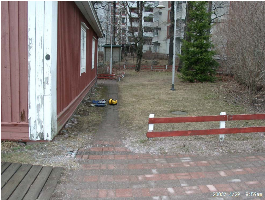
Kuva 3. Rakennuksen pohjoissivulla maanpinta oli laski loivasti rakennukseen päin. Seinän vierellä olevan polun kohdalla maanpinnan kallistus oli loivempi kuin nurmialueella. Alapohjan ontelossa maanpinta on 50...100 mm ja tuuletusaukoissa 0...50 mm alempana kuin rakennuksen ulkopuolella.
