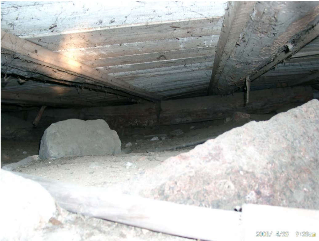
Kuva 9. Rakennuksen keskellä oli harjan suuntainen hirsi, joka jakoi alapohjan ontelon kahteen osaan. Hirsi oli alapinnaltaan maata vasten ainakin osittain. Siinä ei havaittu vaurioita.
