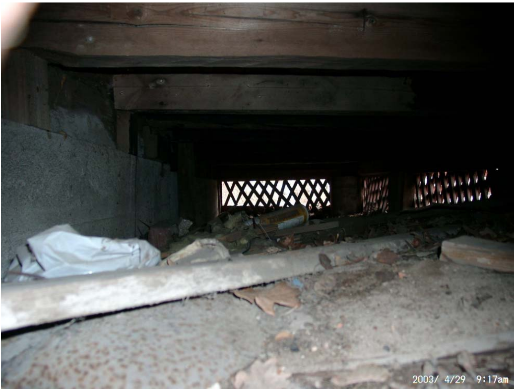
Kuva 6. Länsipäädyn sisäänkäynnin ja varastojen alustilan pohjalla oli runsaasti roskaa.
