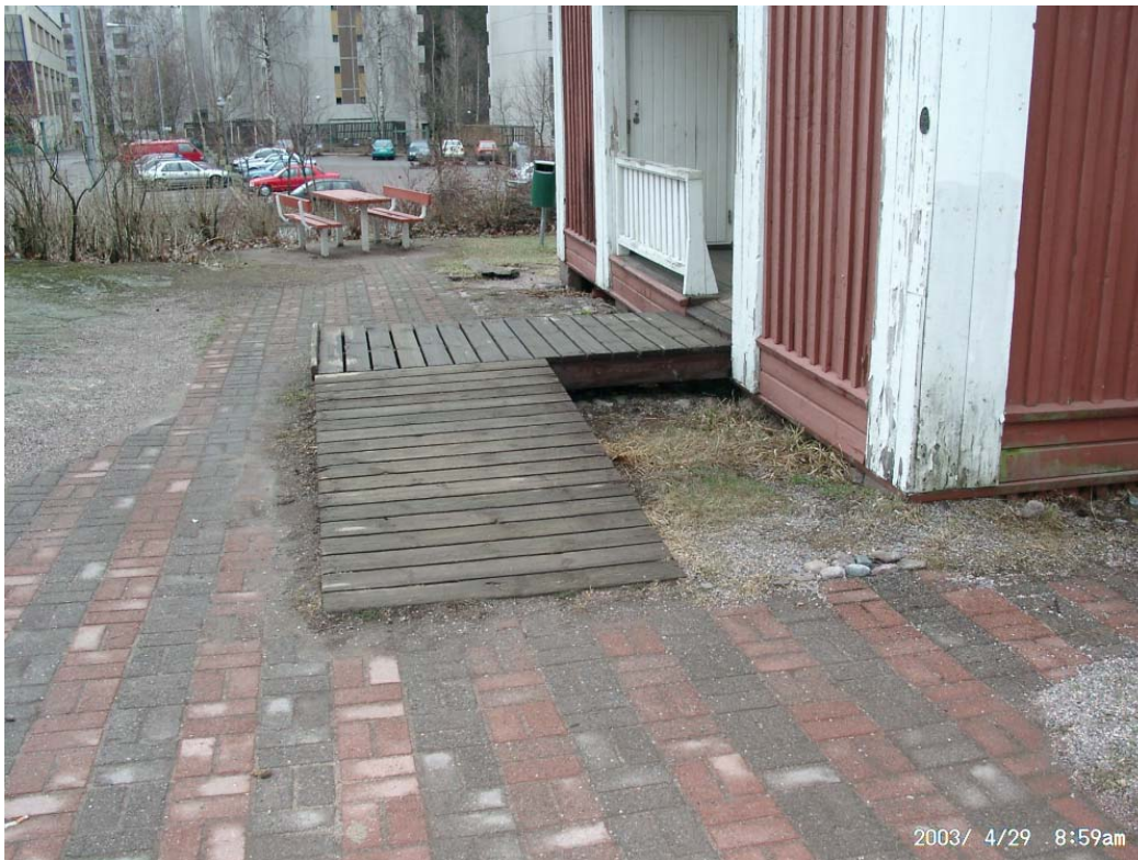
Kuva 4. Koillisnurkalla maanpinta oli aivan puuvorauksen alareunan tasolla. Nurkan puuvorauksessa on nähtävissä kosteuden aiheuttamia vaurioita. Vesikaton räystäällä on jalkarännit, jotka ohjaavat veden nurkkien kohdalla maahan. Koska syöksytorvet puuttuvat valuu vesi vapaasti maahan ja roiskuu myös seinälle.
