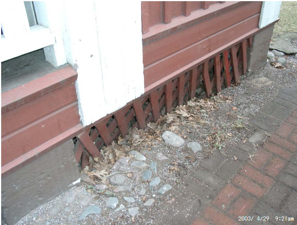
Kuva 7. Länsipäädyn alustilan ristikko oli vaurioitunut. Se tulisi suoristaa.
