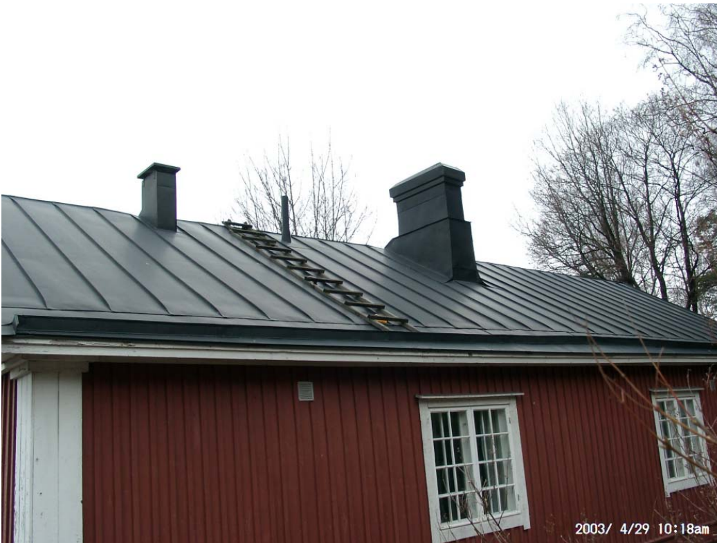
Kuva 12. Vesikatto oli uusittu pellityksiltään ja sikäli hyväkuntoinen. Piipun päällä ei ollut hattua, mutta IV-putkien päällä oli. Hattu olisi tarpeen koska rakennuksessa ei ole enää tulipesiä, jotka kuivattaisivat piipun sadevesistä. Piipun yläpää voi sadevesien seurauksena pakkasrapautua. Viemärin tuuletusputkea ei ollut lämmöneristetty. Vesikaton kunto arvioitiin maasta käsin koska talotikkaat puuttuvat. Lapetikkaat on kuten kuvassa näkyy, mutta kattosillat puuttuvat.
