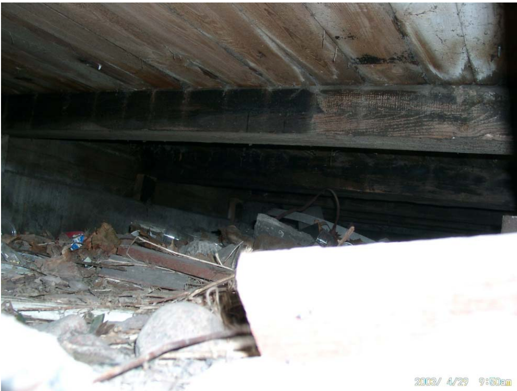
Kuva 10. Itäpäädyn sisäänkäynnin kohdalla alapohjan ontelossa oli pohjalla roskia, kuten toisessakin päädyssä. Sisäänkäyntiterassin kohdalla oli terassilautojen alapinnalla kosteuden aiheuttamia jälkiä. Laudat ovat säiden armoilla ja siten kuvan tilanne on normaalia. Laudat uusitaan sitten kun niiden kantavuus on loppu.
