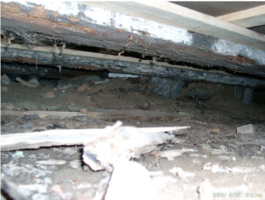
Kuva 2. Itäpäädyn tuulikaapin tienoilla oli tämä epämääräinen kohta. Joko alapohja on sortunut tai maanpinnalla on kiviä ja hiekkaa joka ulottuu alapohjaan saakka.
