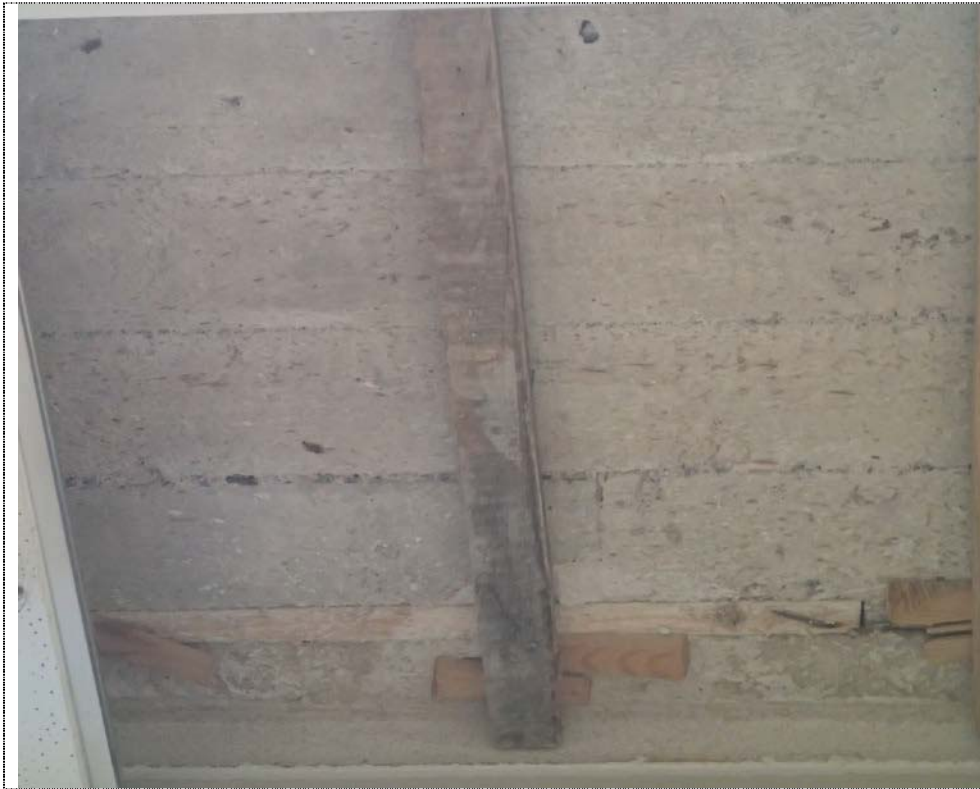
Kuva 5: Yläpohjarakenteen muottilaudat paikoin tummuneita.
