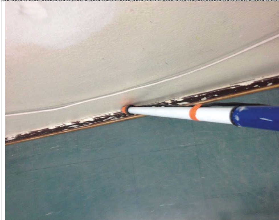
Kuva 21: Merkkiainekokeissa havaittiin vuotoilmareittejä lattian ja ulkoseinärakenteen liitoskohdissa.
