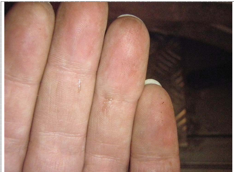
Kuva 36: Tuloilmakoneen TK01 suodattimella oli vettä.
