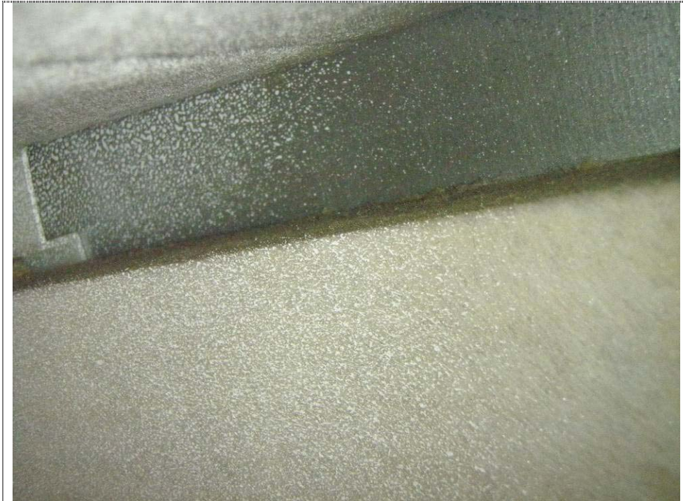
Kuva 39: Laajennusosan tuloilman liitäntälaatikoissa on reunoilta suojaamatonta mineraalivillaa.
