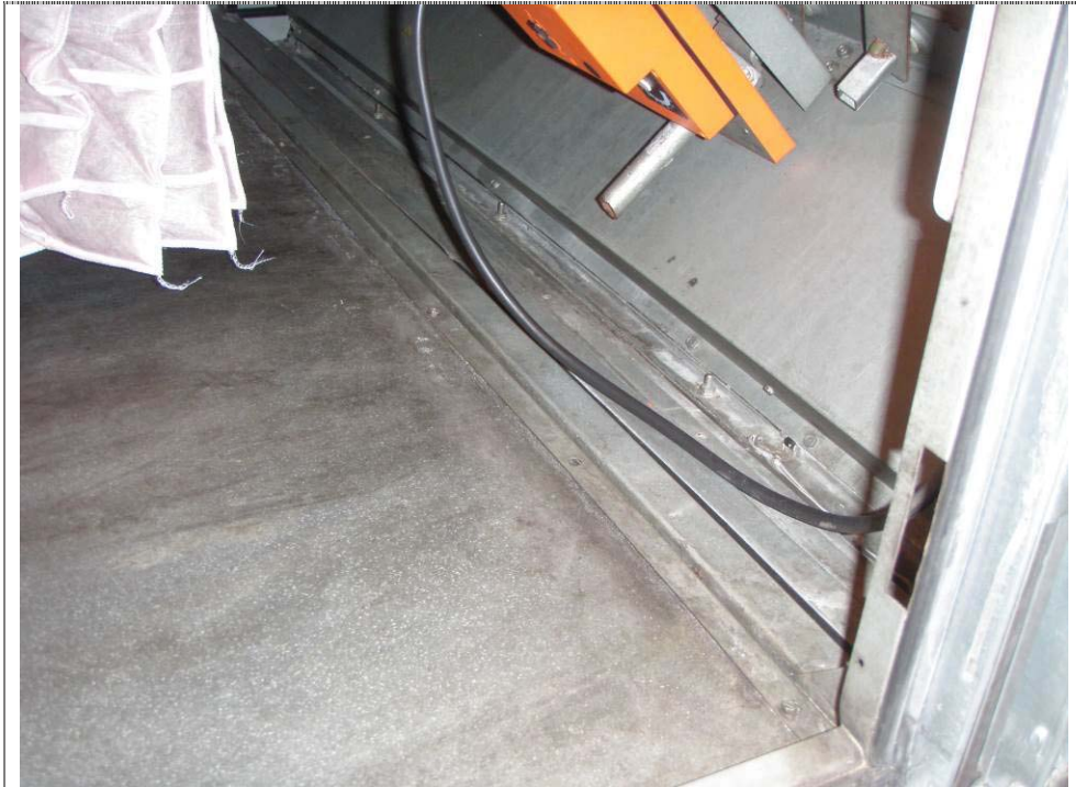
Kuva 37: Tuloilmakoneen 101 TK suodatinosassa kosteusjälkiä.
