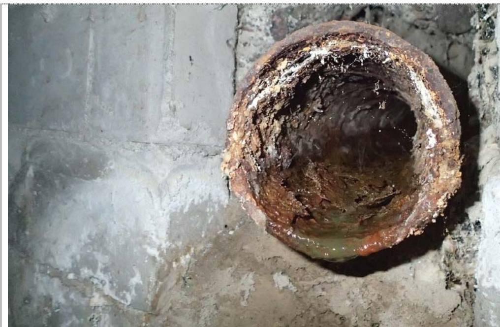
Kuva 26: Viemäriputki tihuttaa tilaan edelleen ruosteista vettä.
