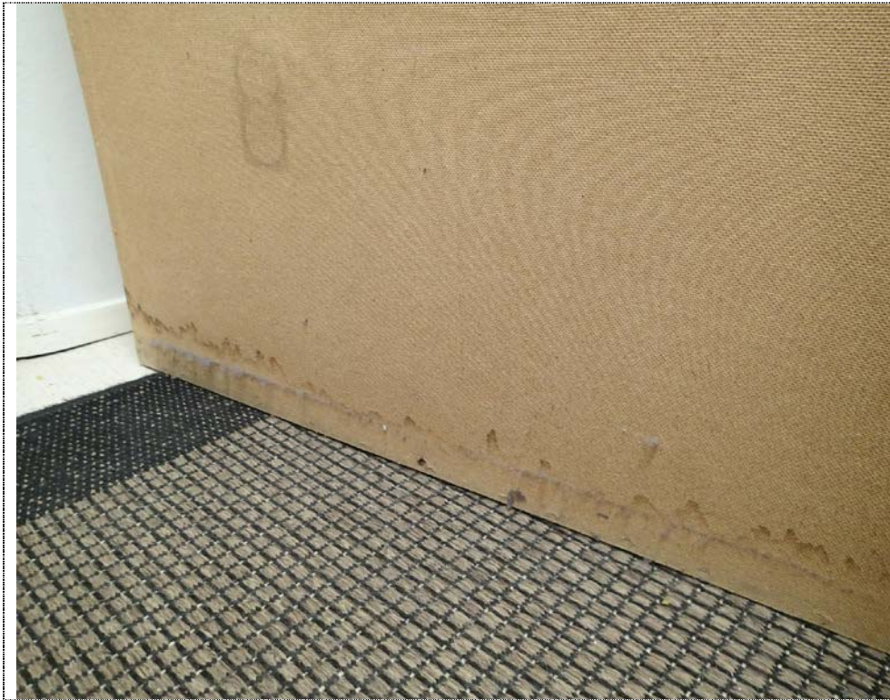
Kuva 19: Aulatila 232, kirjahyllyn takalevyn alahelman kosteusjäljet.
