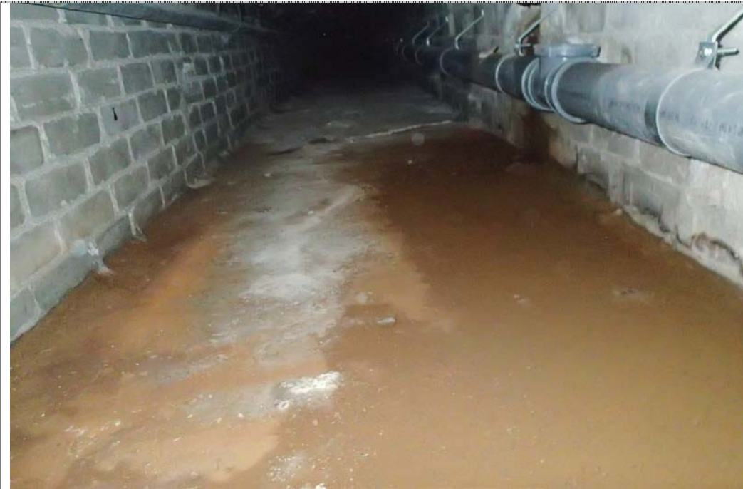
Kuva 25: Putkikanaali, tunkkainen ja epäsiisti, paikoin kosteutta.
