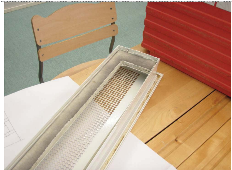
Kuva 40: Laajennusosan tuloilmasäleiköillä mineraalivillan sidontapinta on rikki.
