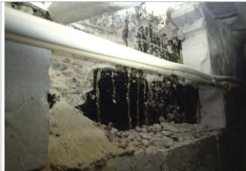
Kuva 24: Putkikanaali, kosteuden aiheuttamaan härmettä seinissä.
