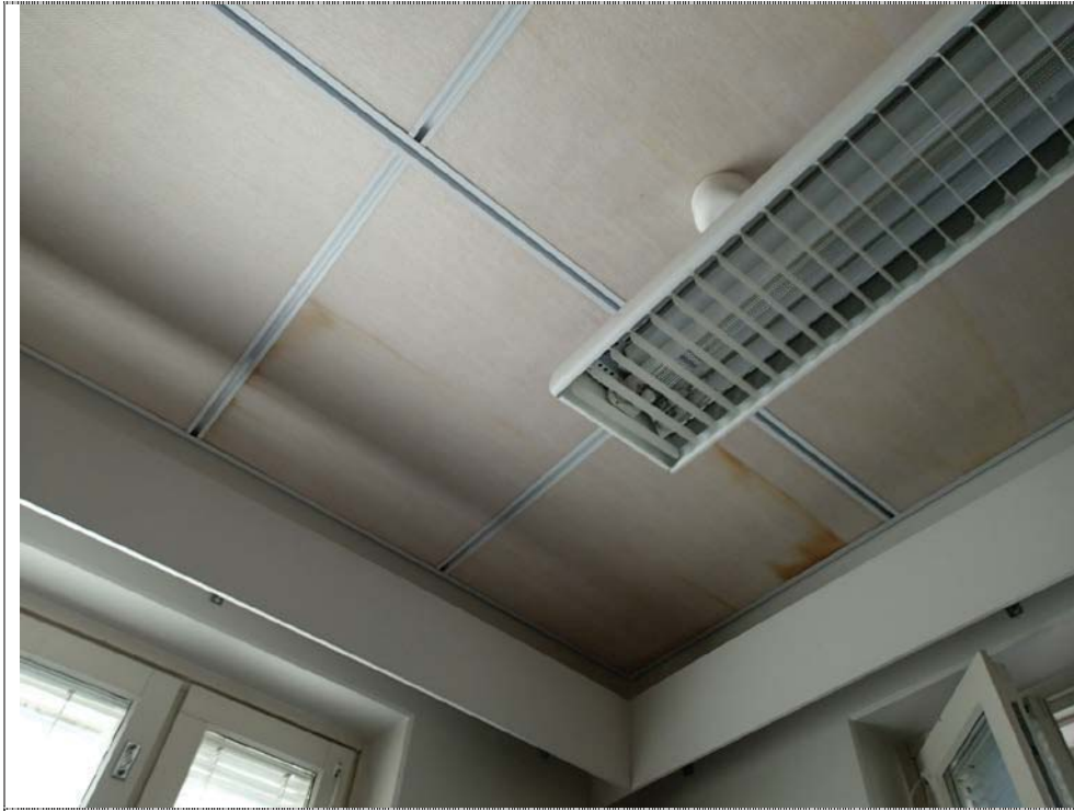
Kuva 11: Luokka 311, paikallisen kattovuodon aiheuttamat kosteusjäljet katon alapinnan akustolevyissä.
