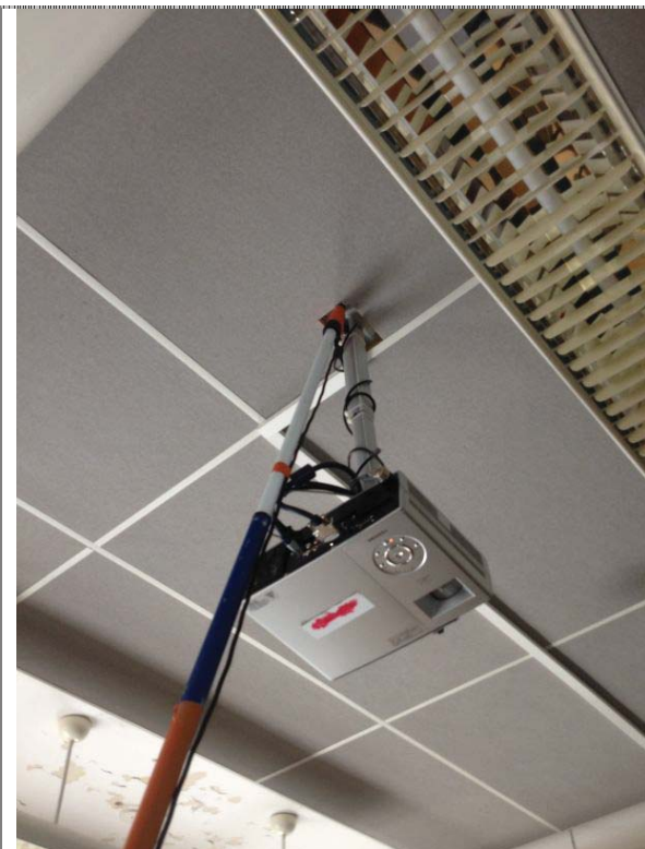
Kuva 8: Merkkiainekokeissa havaittiin vuotoilmareittejä läpivientien ja kiinnikkeiden juurista.
