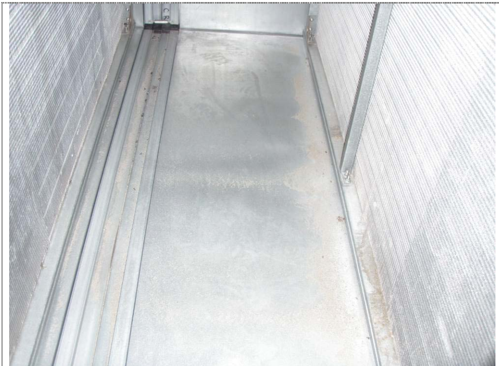
Kuva 38: Tuloilmakoneen TK01 LTO- ja lämmityspatterin välissä on ylimääräistä likaa ja kosteusjälkiä.
