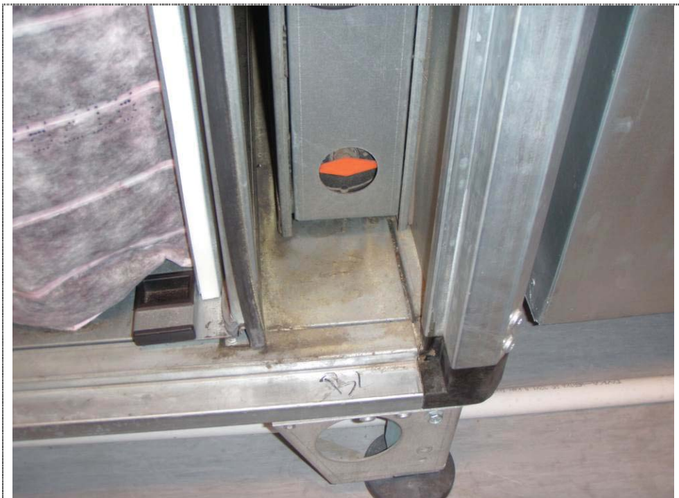
Kuva 34: Tuloilmakoneen TK02 suodatinosassa kosteusjälkiä.
