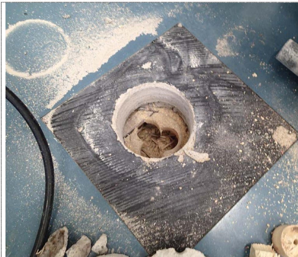
Kuva 16: Vinyylilaatat on liimattu asbestipitoiseksi tiedetyllä mustalla liimalla.
