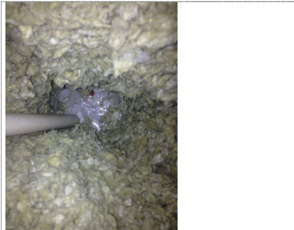
Kuva 15: Vuotopaikasta puhallusvillasta otettiin materiaalinäyte.
