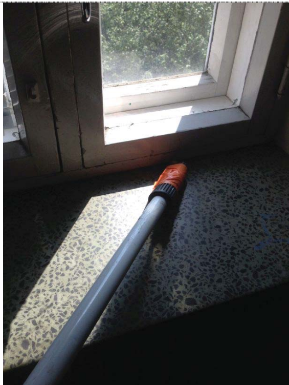
Kuva 4: Merkkiainekokeissa havaittiin vuotoilmareittejä ikkunan välirakenteissa sekä ikkunan ja ulkoseinärakenteen liitoskohdissa.
