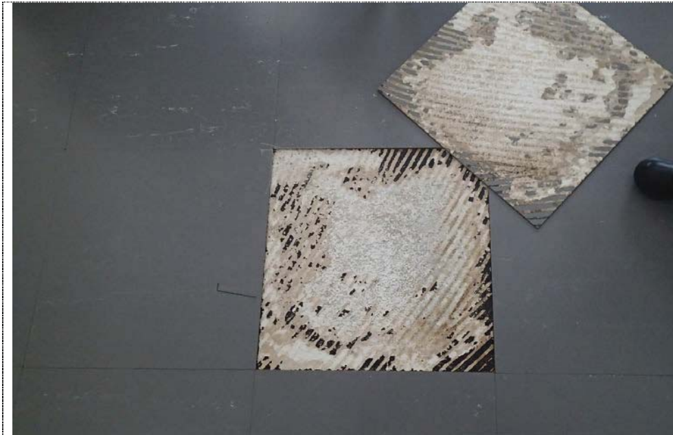
Kuva 29: Vanhat harmaat lattiapinnoitteet on liimattu mustalla, asbestipitoiseksi tiedetyllä liimalla.
