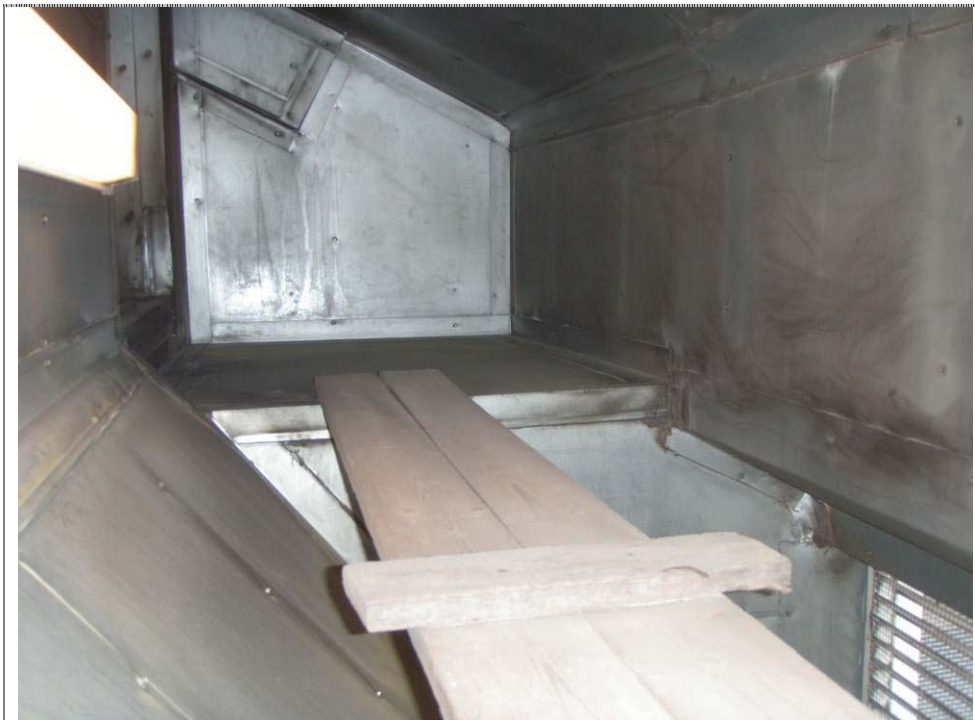
Kuva 31: Tuloilmakoneiden raitsilma otetaan raitsilmakammion yläreunasta.
