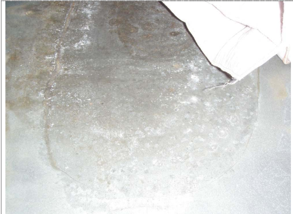
Kuva 35: Tuloilmakoneen TK03 suodatinosassa kosteusjälkiä.
