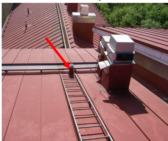
Kuva 5 Liian lyhyt tuuletusputki.
