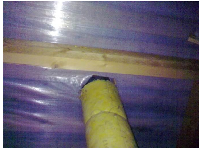
Kuva 3. Läpivienti ei ole tiivis.
