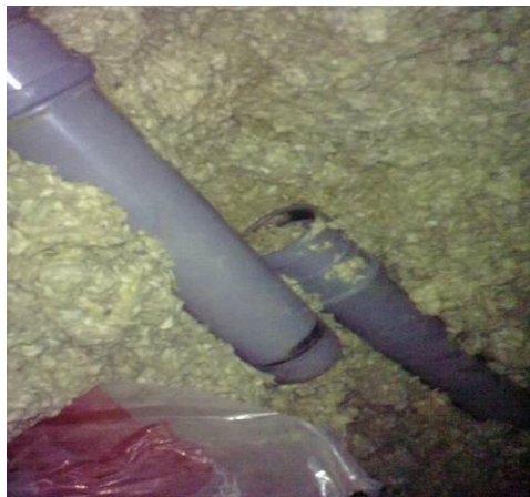
Kuva 2 Liitoksesta irti oleva putki.
