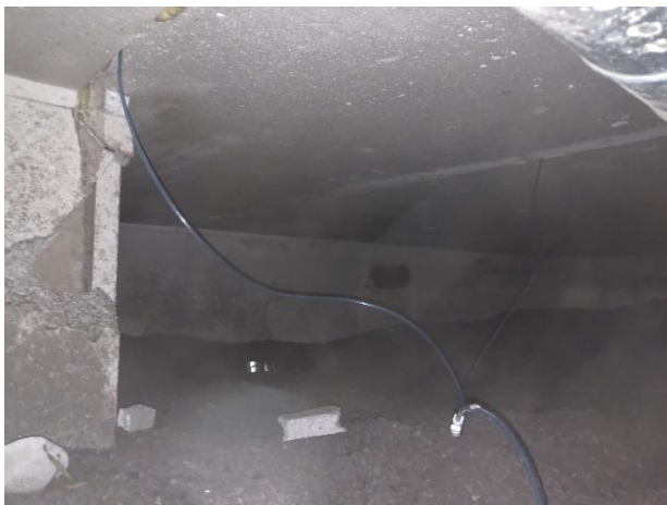
Kuva 15. Kaasun syöttö ryömintätilassa.
