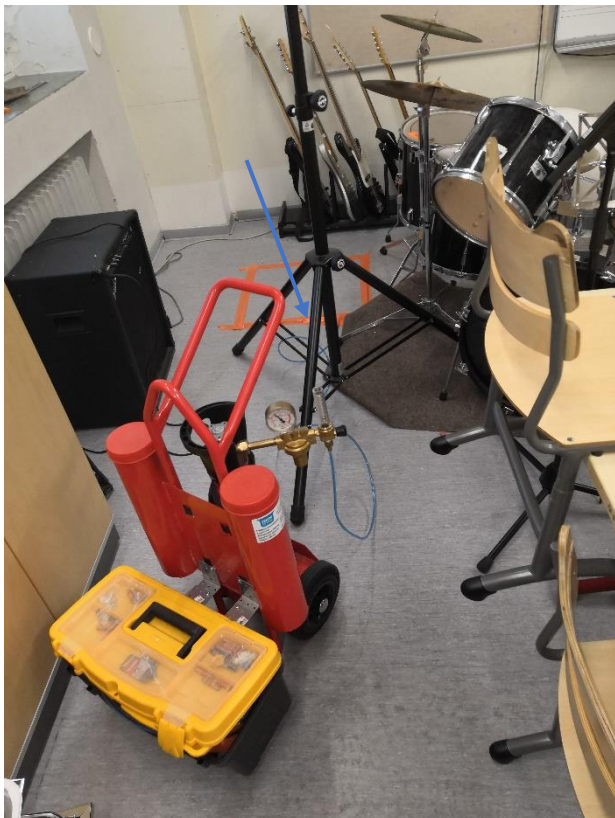
Kuva 8. Kaasun syöttö putkikanaaliin.
