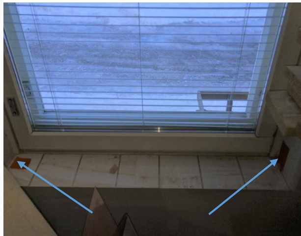
Kuva 19. Vuotoa ikkunan ja ulkoseinän liittymässä.
