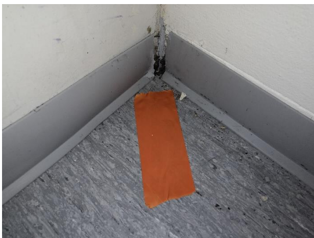
Kuva 10. Nurkan tiivistys on pettänyt.
