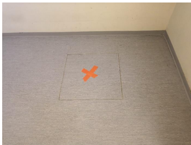
Kuva 11. Seuraavan huoneen 149 tarkastusluukussa havaittiin vuotoa.
