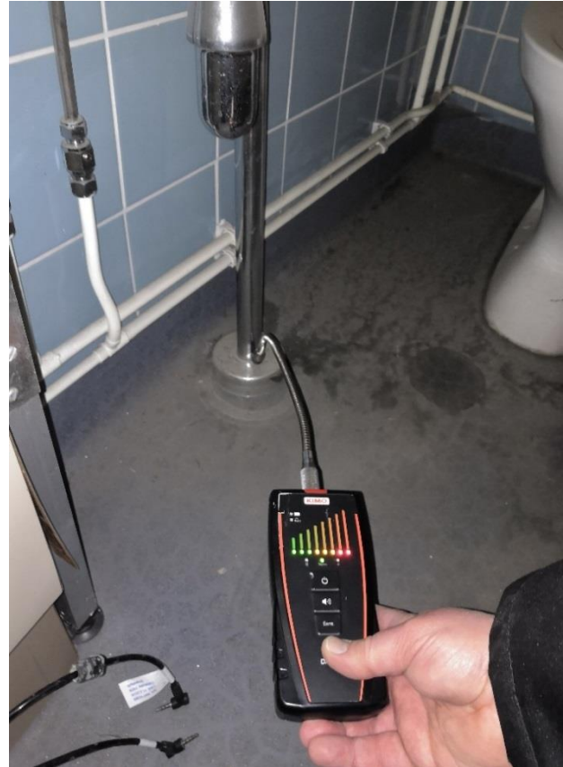
Kuva 4. Selkeää vuotoa lavuaarin viemäri liittymässä.
