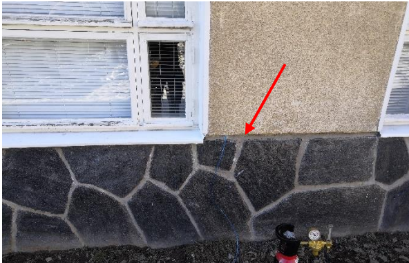
Kuva 12. Kaasun syöttökohta sokkelin ja seinäelementin saumakohtaan.
