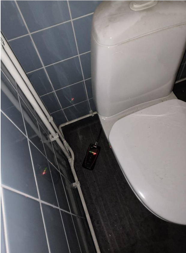
Kuva 3. Lievää vuotoa wc-viemärin liittymässä.
