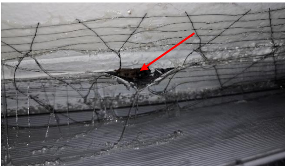
Kuva 5. Huoneeseen oli tehty tiivistyskorjauksia. Butyyliinauha on hieman auennut, mutta kaasunilmaisim ei havainnut vuotoa.
