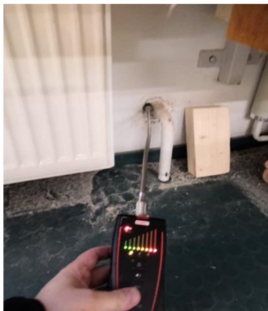
Kuva 21. Putkiläpiviennin kohdalla huomattava vuoto.
