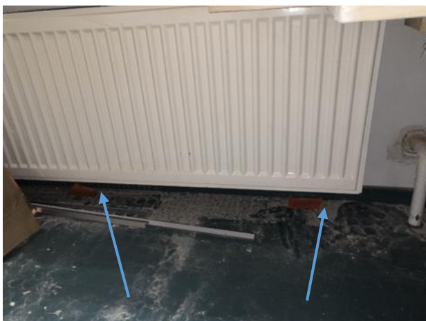
Kuva 20. Seinän ja lattian liittymässä lievää vuotoa.
