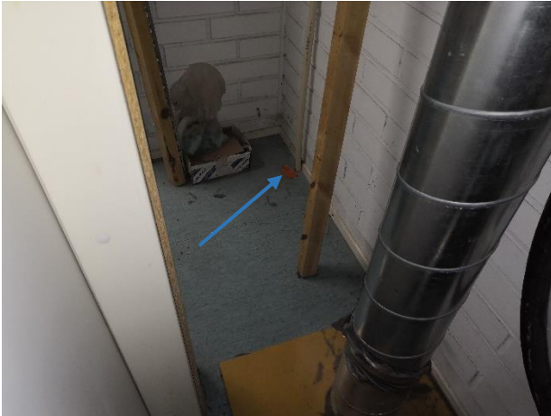
Kuva 17. Vuotoa sähköputken läpiviennissä.
