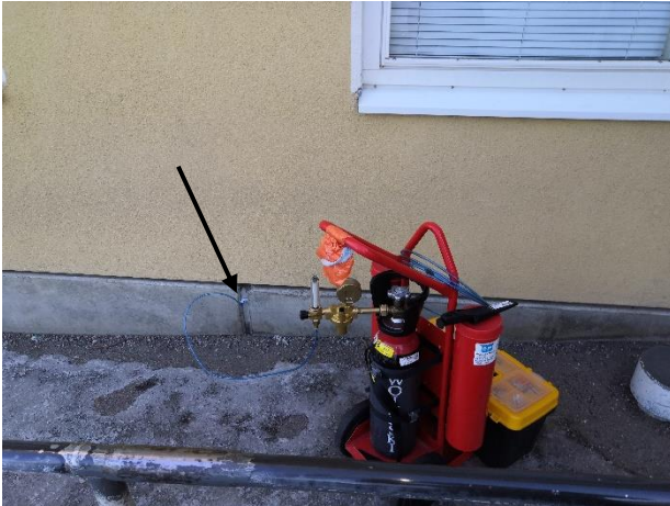
Kuva 22. Kaasun syöttö sokkeliin.
