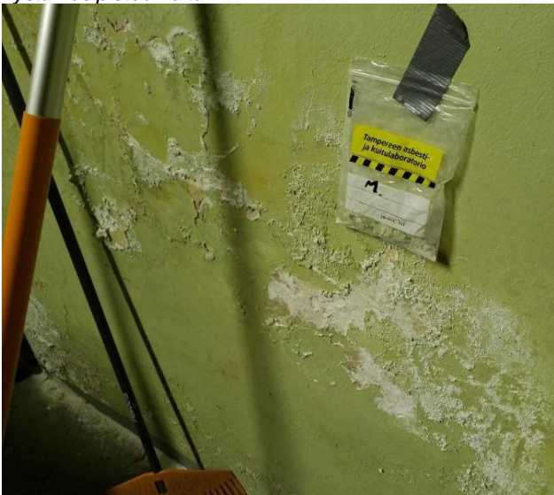
Kuva 6. Talon varasto ulkoiluvälineille 143. Näyte seinän vaurioalueelta.
