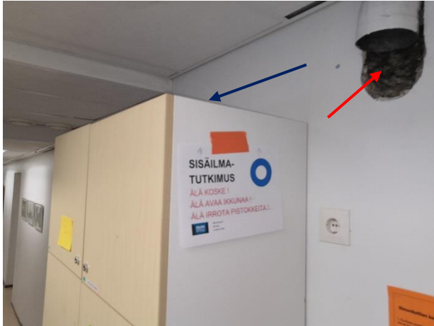
Kuva 32. Monistustilan 221 kuitunäytteen (sininen nuoli) vieressä on avonainen putken pätkä sekä mineraalivillaa (punainen nuoli). Kuitunäytteessä oli silti kuituja alle määritysrajan.
