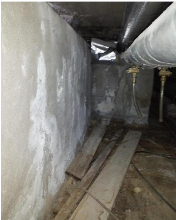
Kuva 16. Puutavaraa kanaalissa, joista osassa tummumaa.
