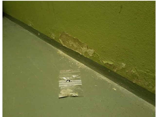
Kuva 5. Käytävä 129. Näyte seinän vauriokohdasta.
