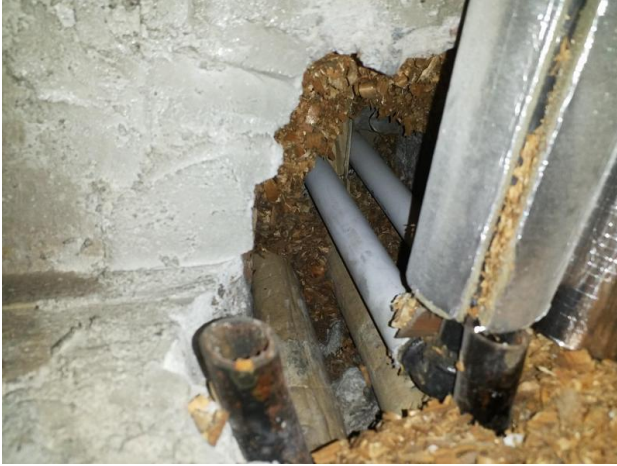
Kuva 22. Asuntolan käytävän lämpöputkien läpiviennit on auki
