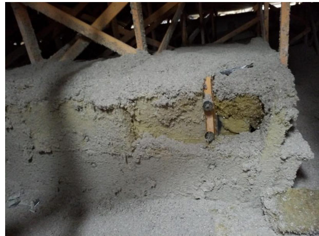
Kuva 31. Vinon katto-osuuden kulmasta on tippunut alas mineraalivillapaloja ja kulma on auki.
