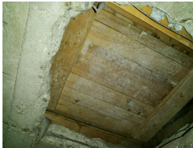
Kuva 17. Ruokalan toinen miesluukku. Luukku ei ole tiivis.
