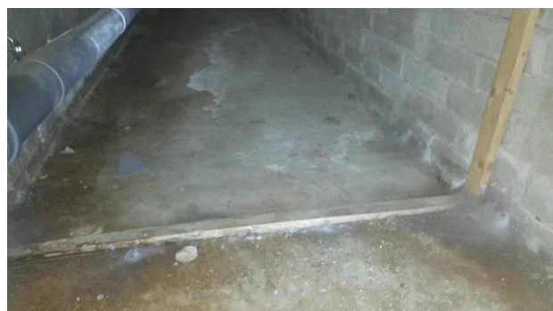
Kuva 21. Opetustila 150 miesluukun lähellä puurimoitus, jonka alapuussa mikrobivaurioita.
