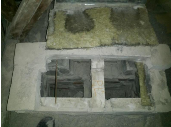
Kuva 29. Ullakon pysty-/vaakahormin liitoksessa pelti + ohut villa.
