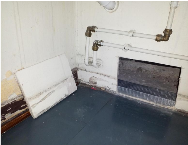
Kuva 4. OT3 huone 326, RA32. Näyte väliseinän kipsilevystä vesipisteen alta.
