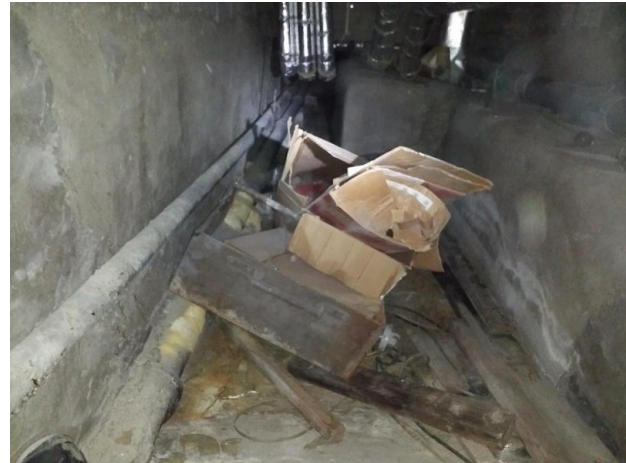
Kuva 13. Rakennusjätettä ruokalan/aulan alla.
