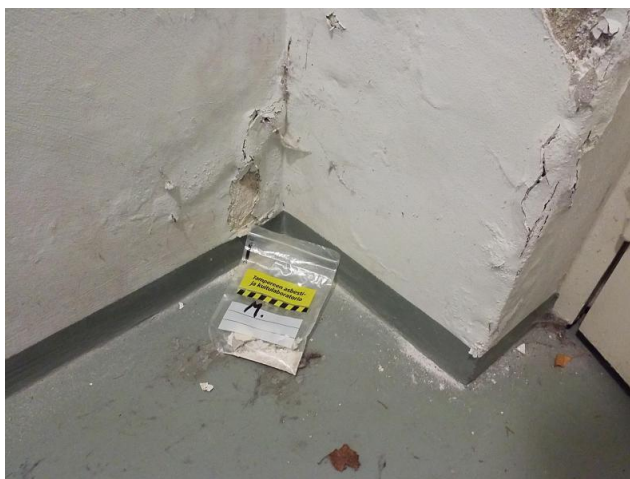
Kuva 8. Porrashuone 028. Näyte seinän kosteusalueelta.
