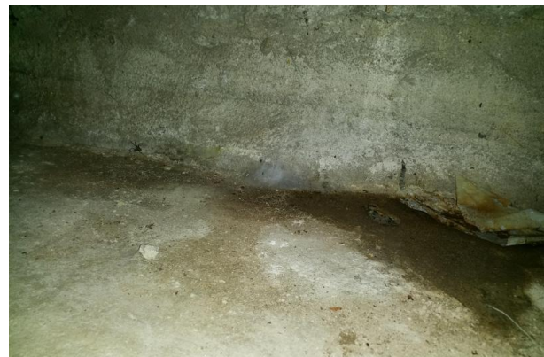
Kuva 15. Märkä alue liitoksen alla.
