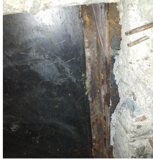
Kuva 23. Lähikuvaa, reunabetonointi on vajaa
