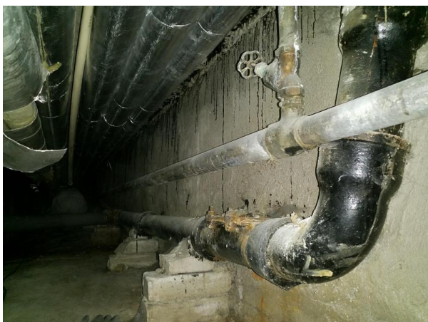
Kuva 18. Viemäriputki, jossa halkeama.
