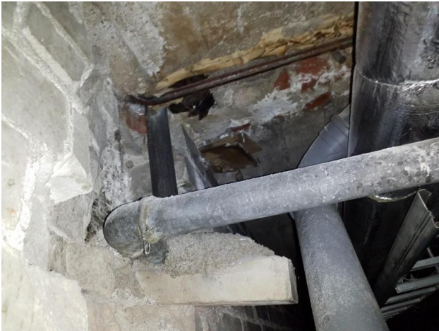
Kuva 12. Märkä kohta katossa käymälöiden alla.
