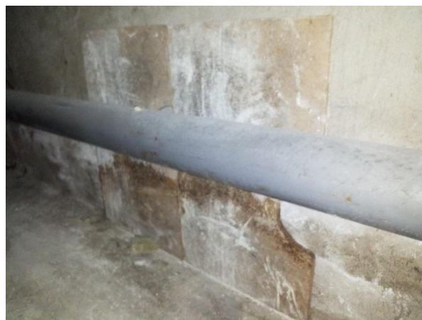
Kuva 19. Kaksi betonisokkelia vasten olevaa lastulevyn palaa tummuneet keittiön alla.
