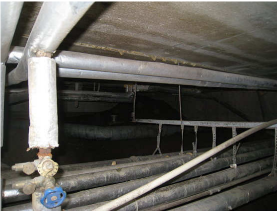
Kuva 27 Pohjaviemäri ja lämpö- sekä käyttövesiputkia kannatellaan samasta U-mallisesta metalliprofiilitangosta.
