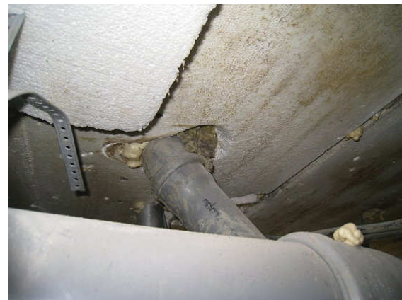
Kuva 16 Puutteellisesti tiivistetty viemärläpivienti keittiön kohdalla.
