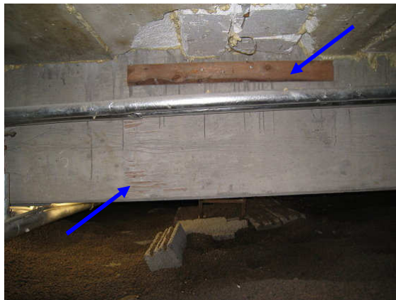
Kuva 15 Betonipalkissa kiinni lautta ja muottivanerin jäämiä.
