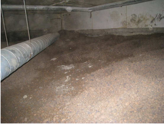
Kuva 7 IV-kanavan alapuolella kostea sepe- liä ja savea.
