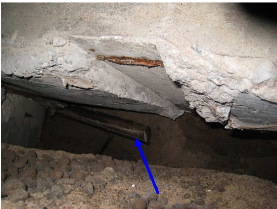
Kuva 11 Ruostunutta raudoitusta ja kosteus- ja mikrobivaurioitunutta laattaa .
