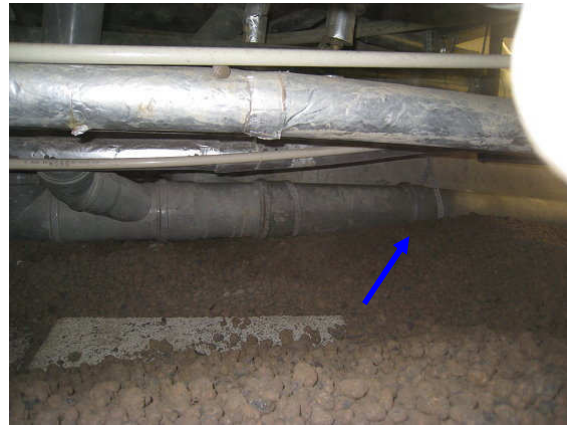
Kuva 28 Pohjaviemäri liitoksen kohdalta muuta viemäriinjaa korkeammalla.
