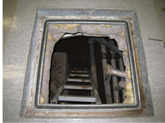
Kuva 2 Luukku nostettu paikaltaan. Lämpö- ja käyttövesiputket vaikeuttavat alustatilaan menoa.
