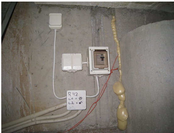
Kuva 3 Alustatilassa valaistus ja vikavirtasuojatut pistorasiat.
