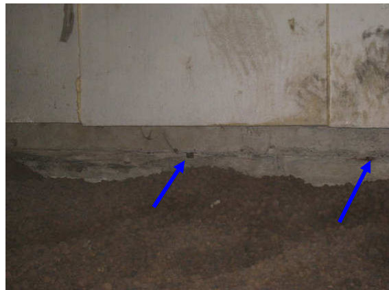
Kuva 12 Sideputa ja muottilaudan jäämiä sok- kelirakenteessa.
