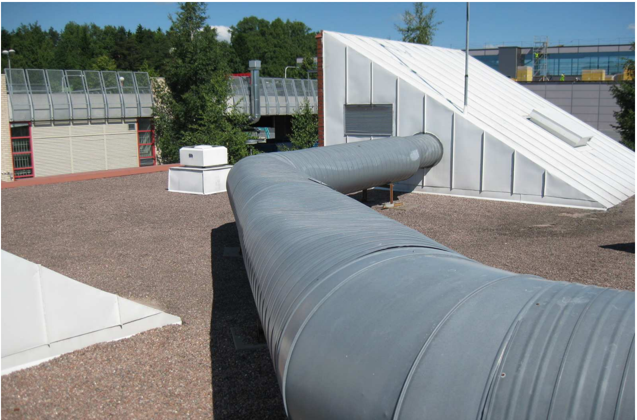
LVI-kuva 12. Yleiskuva vesikatolla olevasta raitisilmakanavasta, joka on painunut kasaan.
