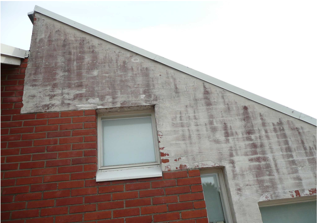
R- kuva 3. Ohutrapatuissa ulkoseinissä on todettavissa rappauksen irtoilua ja halkeilua.
