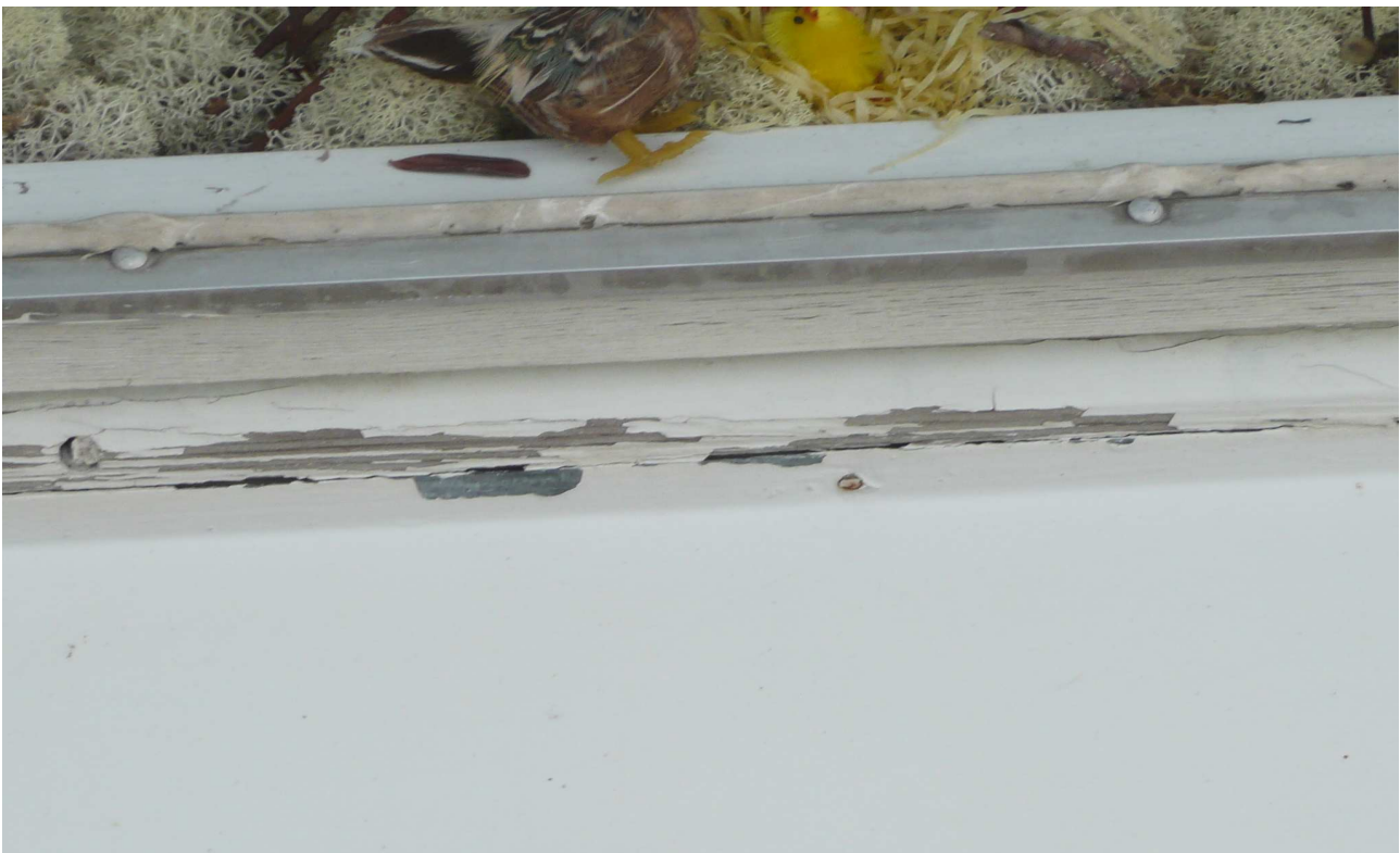
R-kuva 6. Ulkopuiteissa esiintyy kulumaa ja maalipinnan irtoilua.
