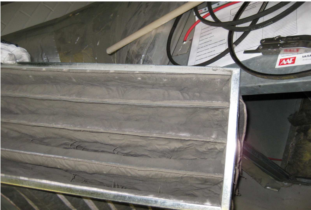
LVI-kuva 9. Yleiskuva tuloilmasuodattimista TP 1.
