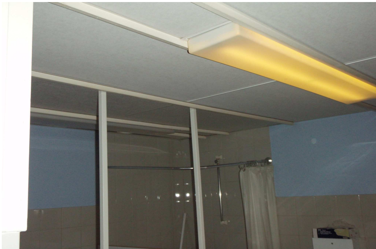
S-kuva 11. WC- tilojen valaistus.
