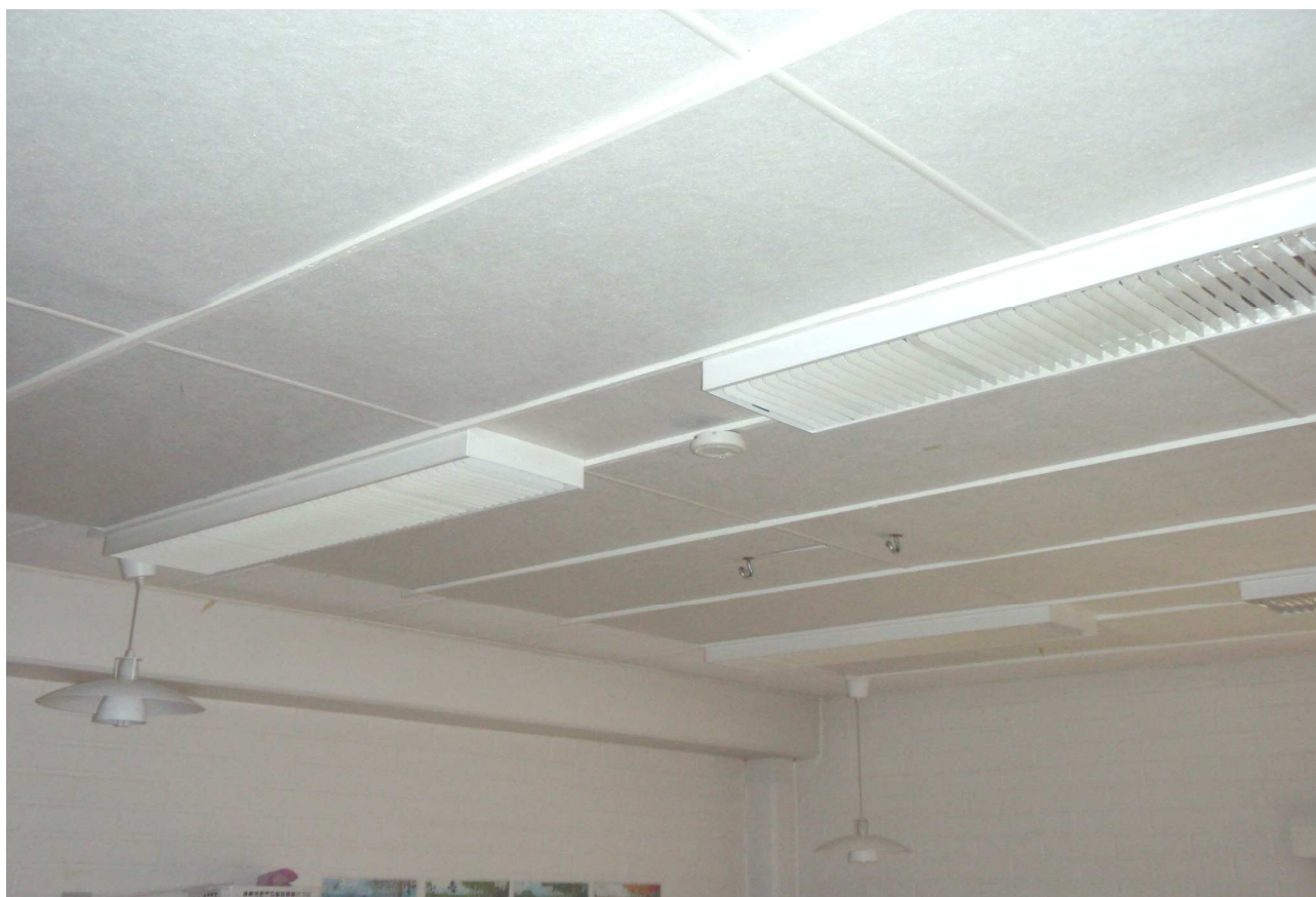
S-kuva 9. Käytävän valaistus.
