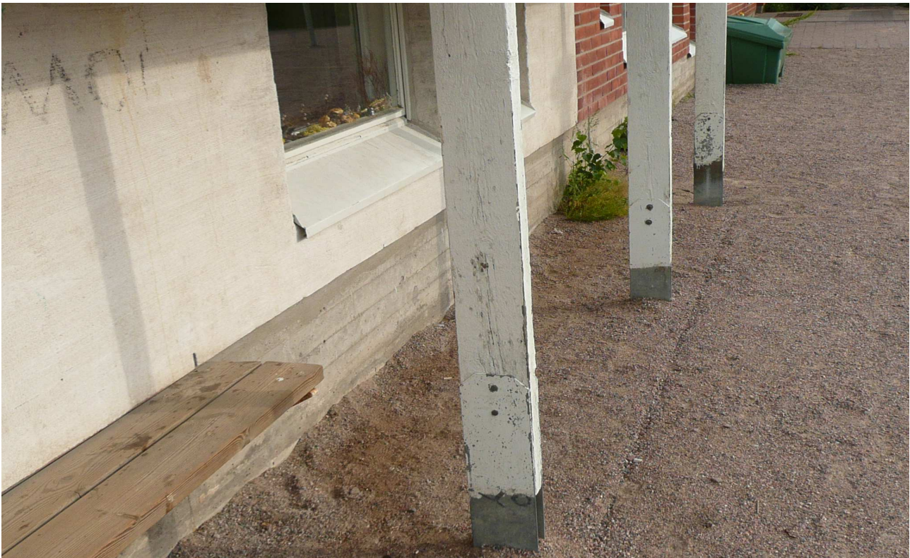
R-kuva 2. Katosten maalipinnassa esiintyy käytöstä aiheutunutta kulumaa.
