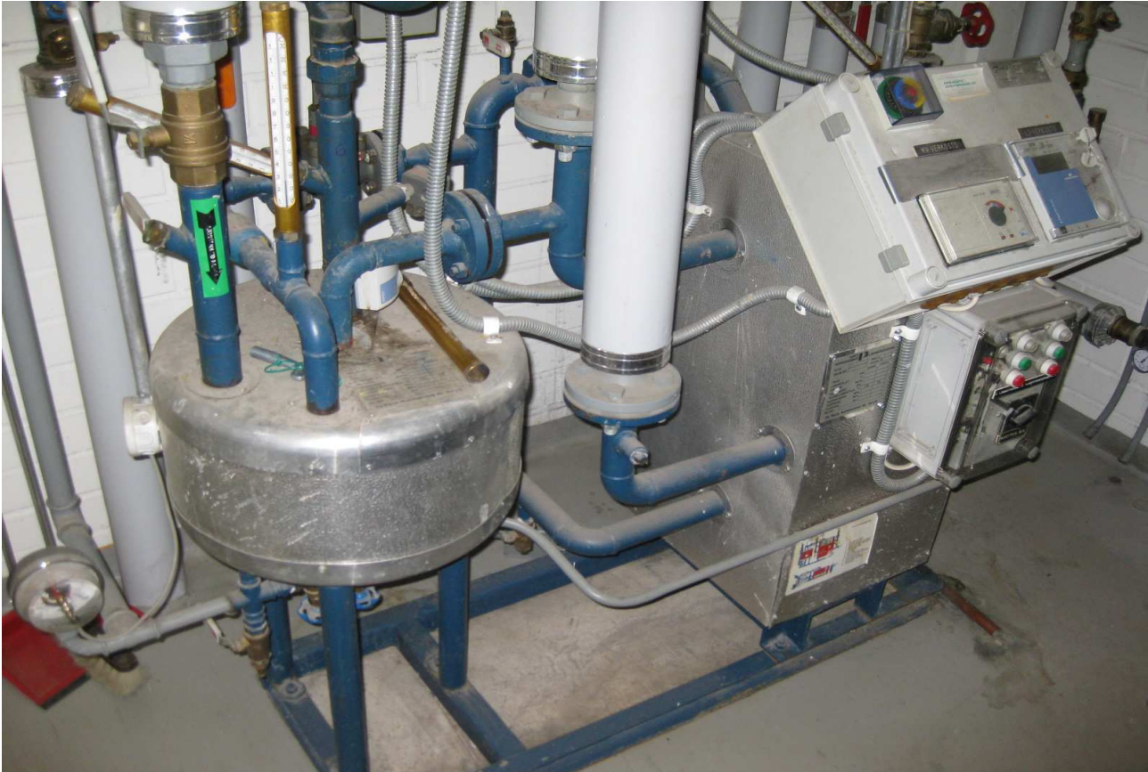
LVI-kuva 1. Yleiskuva lämmönjakuhuoneesta.
