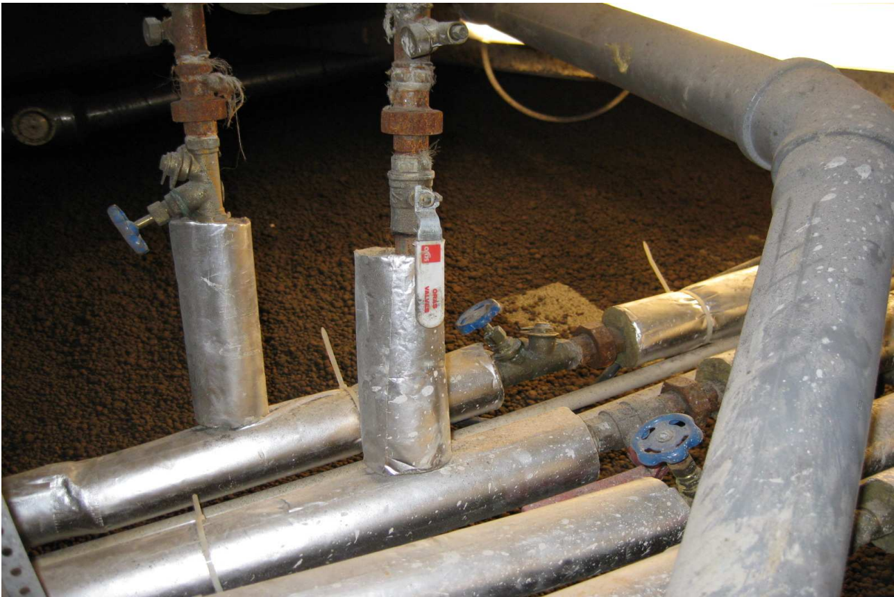
LVI-kuva 2. Yleiskuva lämpöjohtoverkoston venttiileistä.
