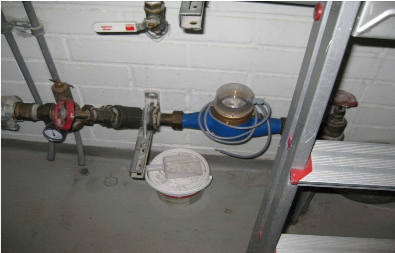
LVI-kuva 4. Yleiskuva vesimittarista ja pääsuluista.
