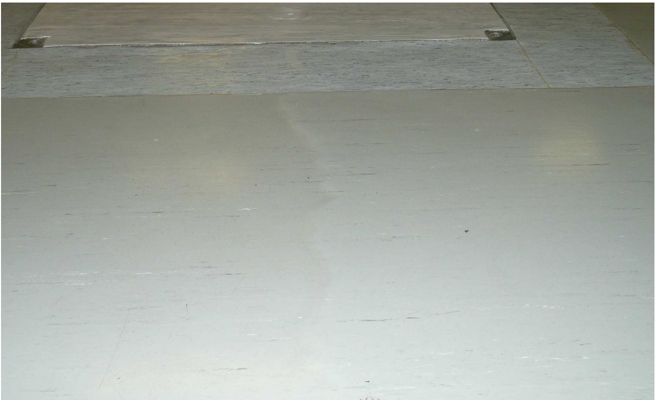
R-kuva 10. Lattioissa muovimaton alla esiintyy halkeamia.
