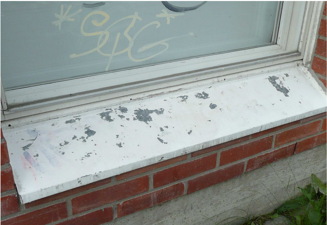
R-kuva 5. Ikkunoiden vesipeltien maalipinta hilseilee.
