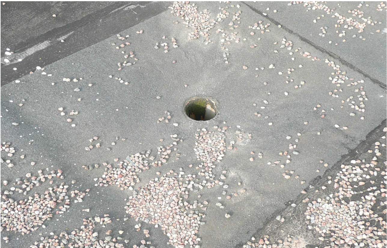
R-kuva 7. Yhden kattokaivon osalla ei ole suojakiveystä (singeliä), lisäksi kaivosta puuttuu sihti.
