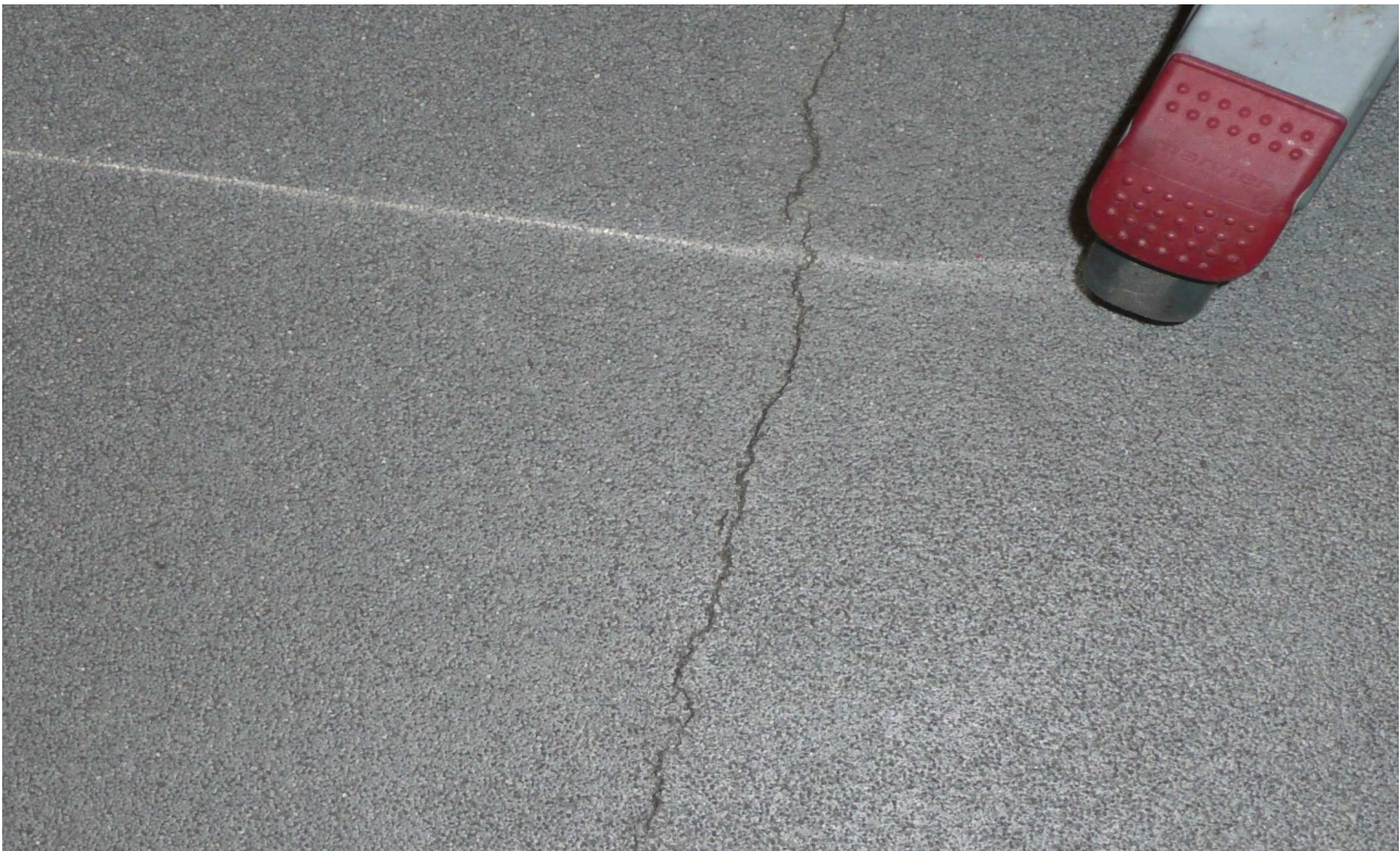
R-kuva 10. Keittiön lattiassa on halkeamia.
