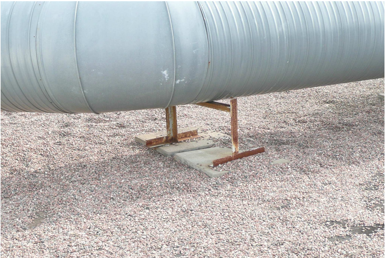
R- kuva 9. Katolla olevat iv-kanavien teräsrakenteiset kannattajat ovat melko ruosteessa.
