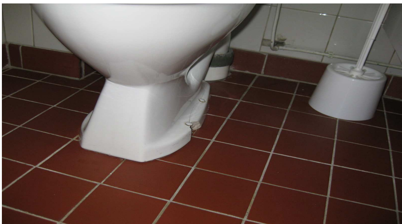
LVI-kuva 7. Yleiskuva rikki olevasta vesikalusteesta.
