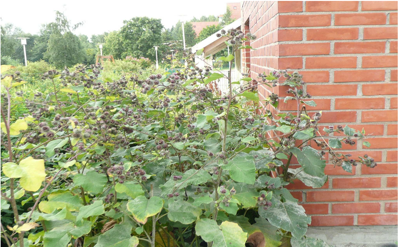
R-kuva 1. Osa pensaista on kiinni rakennuksen julkisivussa.
