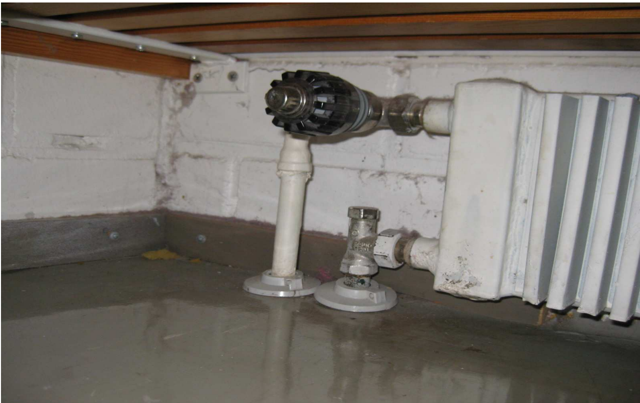
LVI-kuva 3. Yleiskuva patteriventtiilistä.
