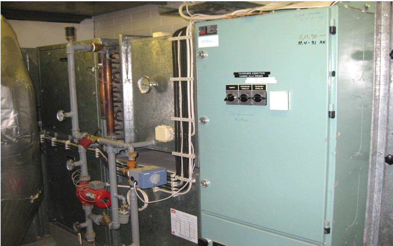
LVI-kuva 8. Yleiskuva IV- konehuoneesta.
