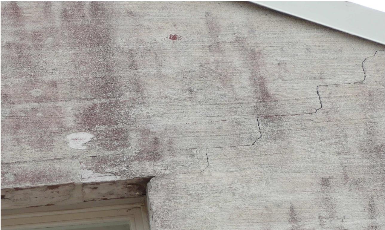
R- kuva 4. Ohutrapatuissa ulkoseinissä on todettavissa rappauksen irtoilua ja halkeilua.
