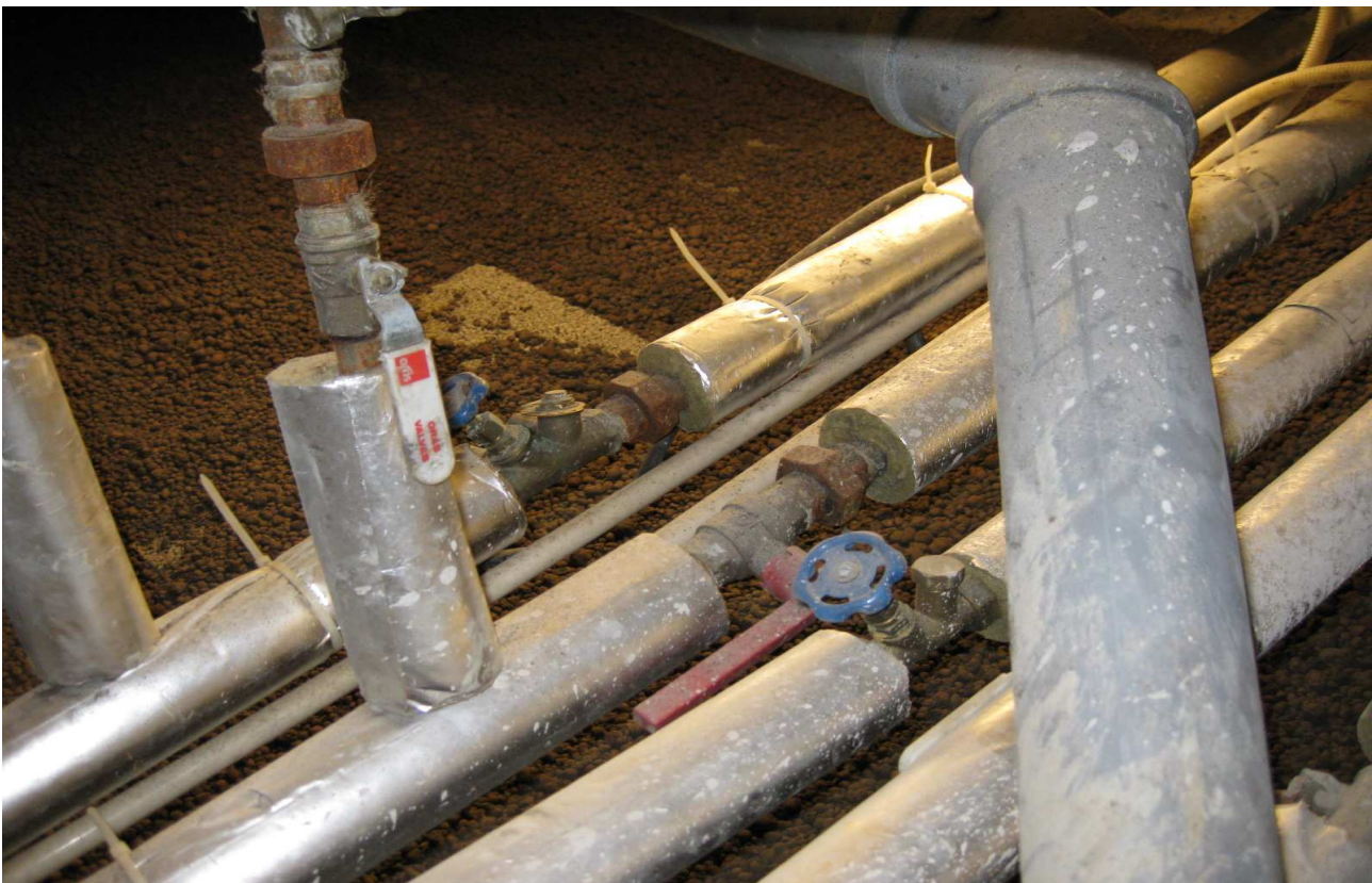
LVI-kuva 5. Yleiskuva käyttöveden sulku- ja säätöventtiilistä.
