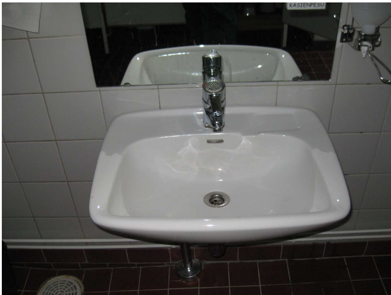
LVI-kuva 6. Yleiskuva vesikalusteista.
