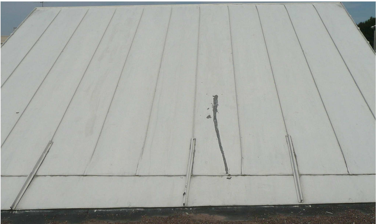
R-kuva 8. Peltikatteen maalipinnoissa esiintyy kulumia.
