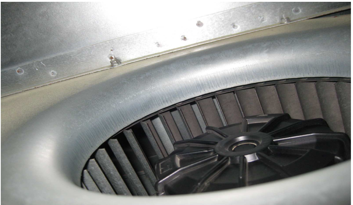
KUVA 10. Yleiskuva tuloilmapuhaltimesta TK 06.
