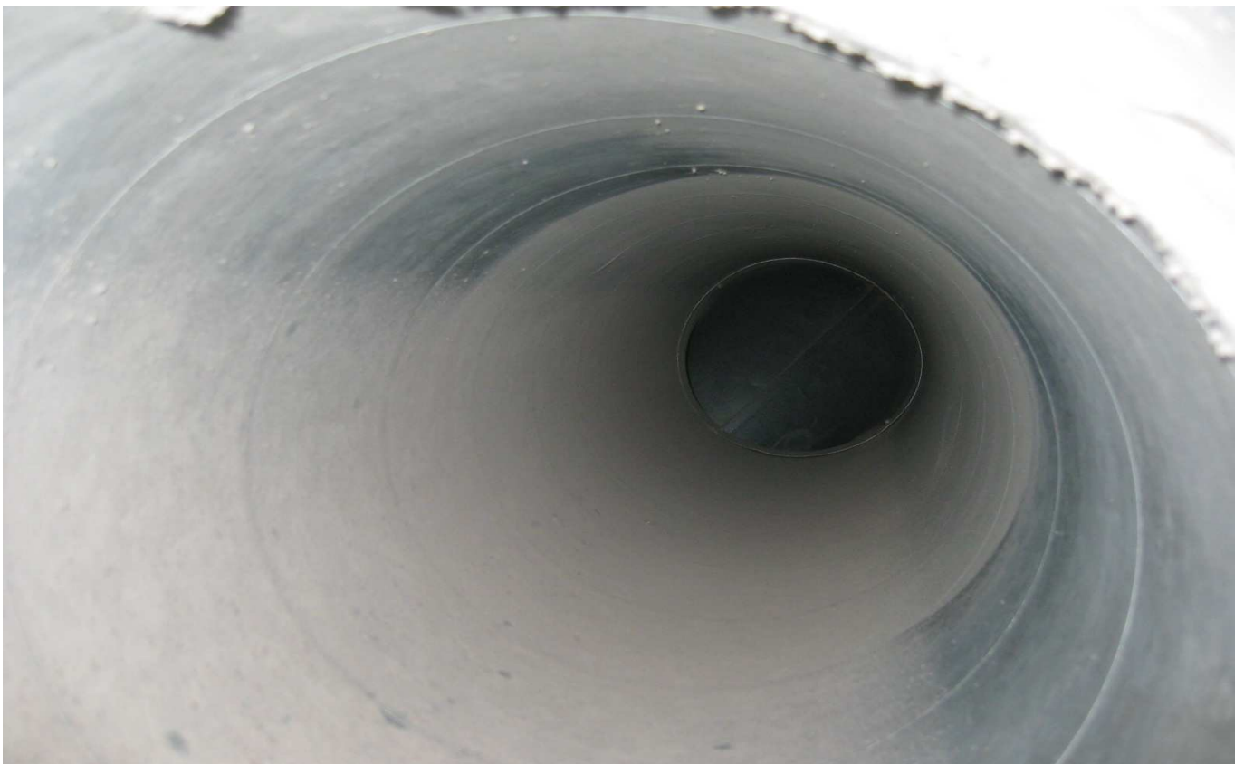
KUVA 20. Yleiskuva poistoilmakanavasta, joka on ullakkotiloissa.
