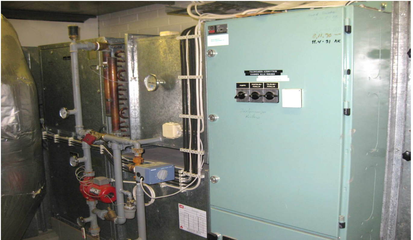
KUVA 1. Yleiskuva IV- konehuoneesta.
