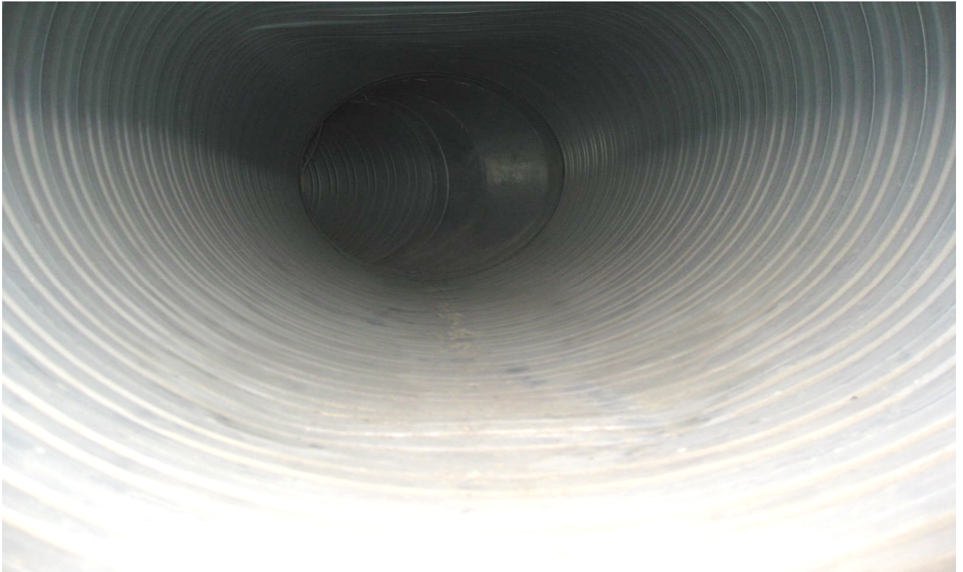
KUVA 15. Yleiskuva tuloilmakoneen TP1 raitisilmakanavasta.
