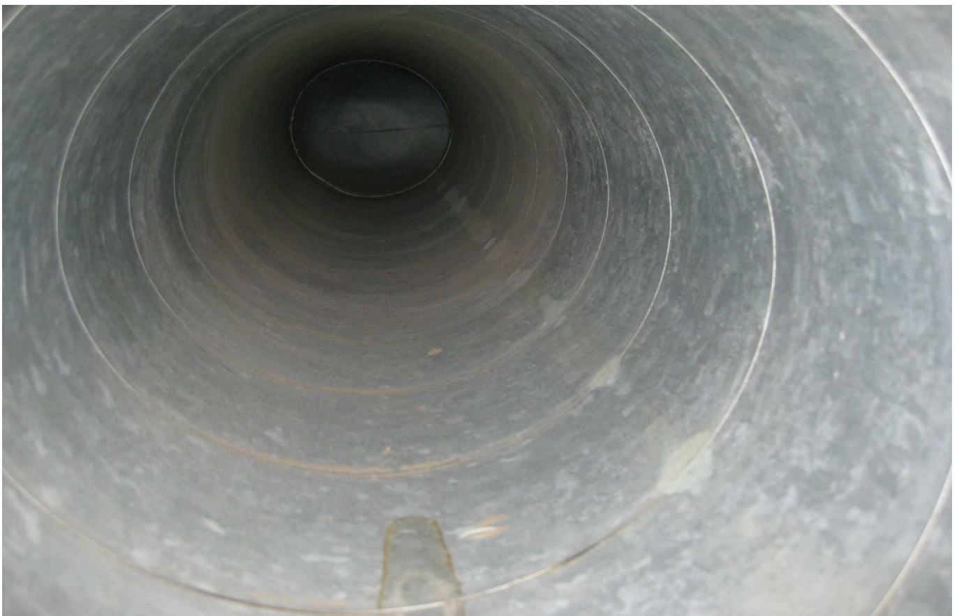
KUVA 18. Yleiskuva tuloilmakanavasta, joka on ullakkotiloissa.
