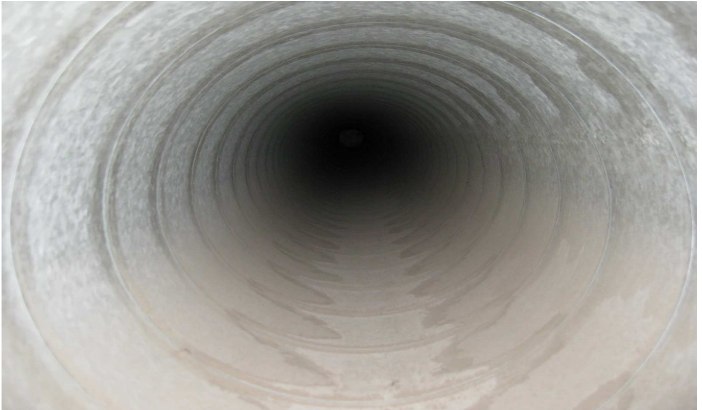
KUVA 17. Yleiskuva tuloilmakanavasta, joka on ullakkotiloissa.
