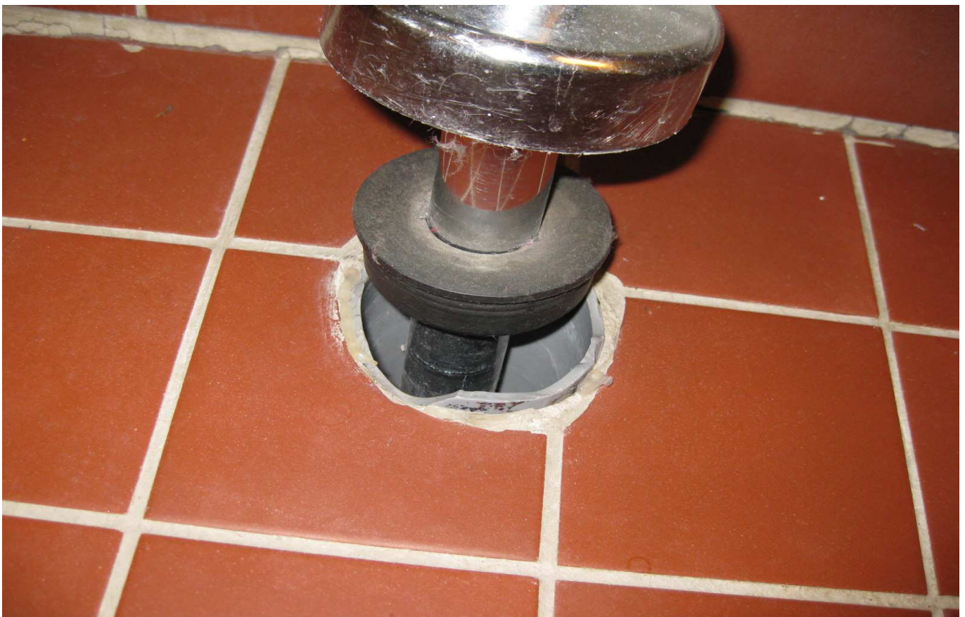
KUVA 24. Yleiskuva pesualtaan laskuputken tiivisteestä.
