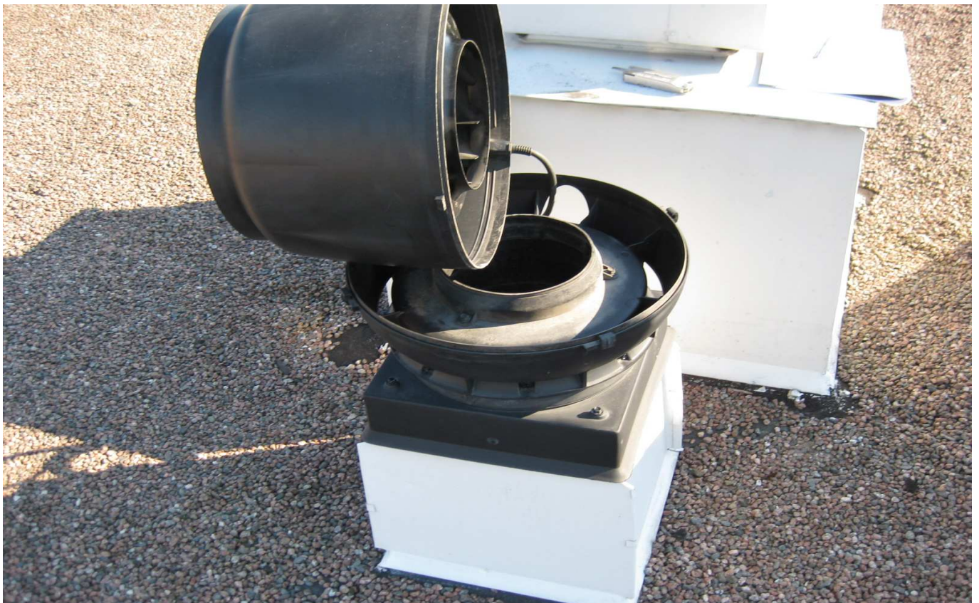
KUVA 12. Yleiskuva alustatilan poistoilmapuhaltimesta.
