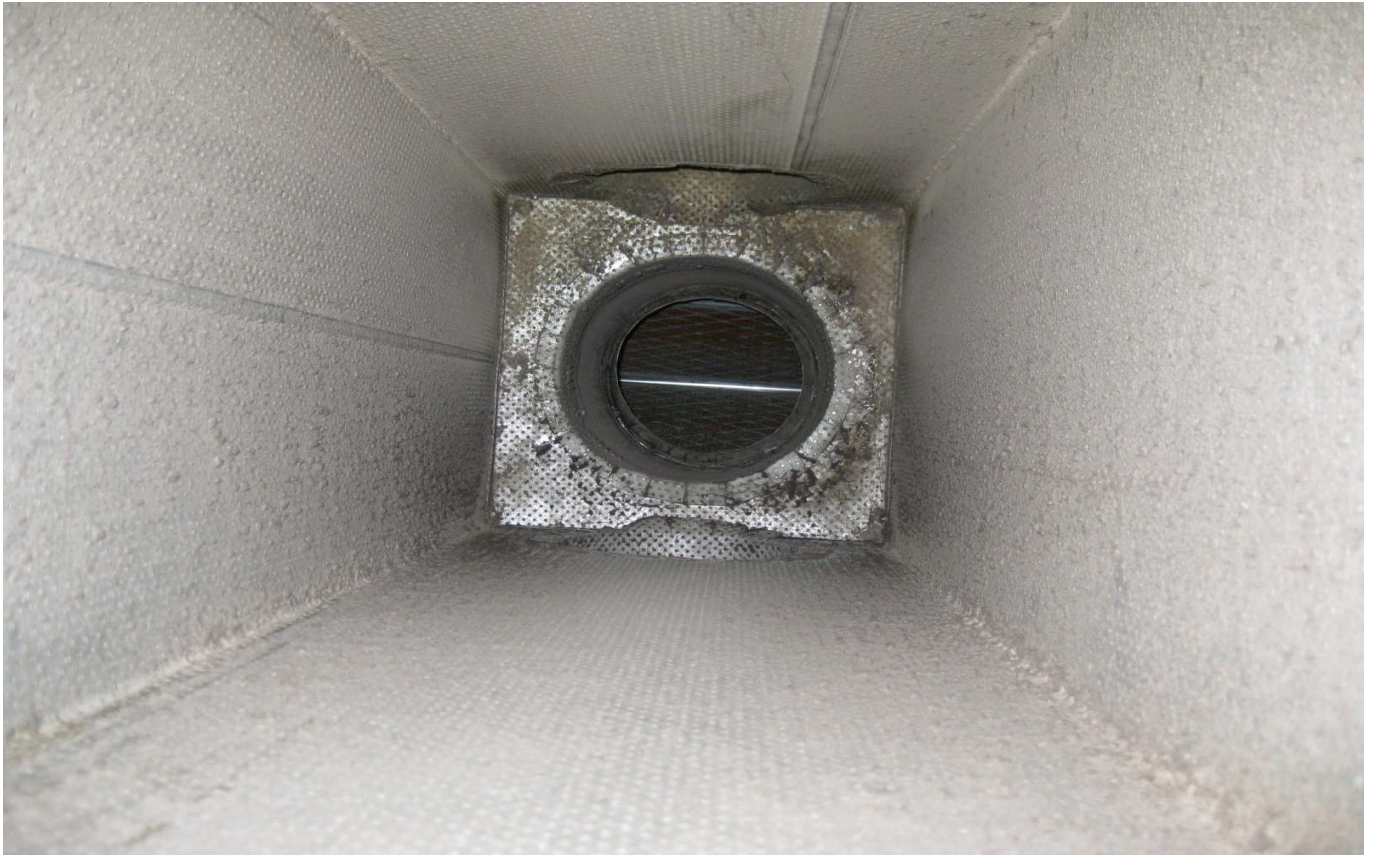
KUVA 21. Yleiskuva keittiön poistoilmakanavasta.
