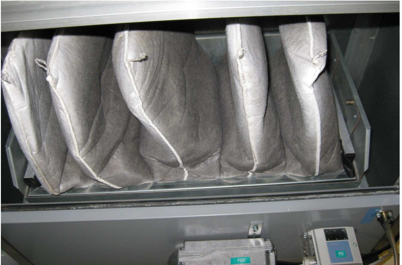
KUVA 9. Yleiskuva tuloilmasuodattimesta TK 06.
