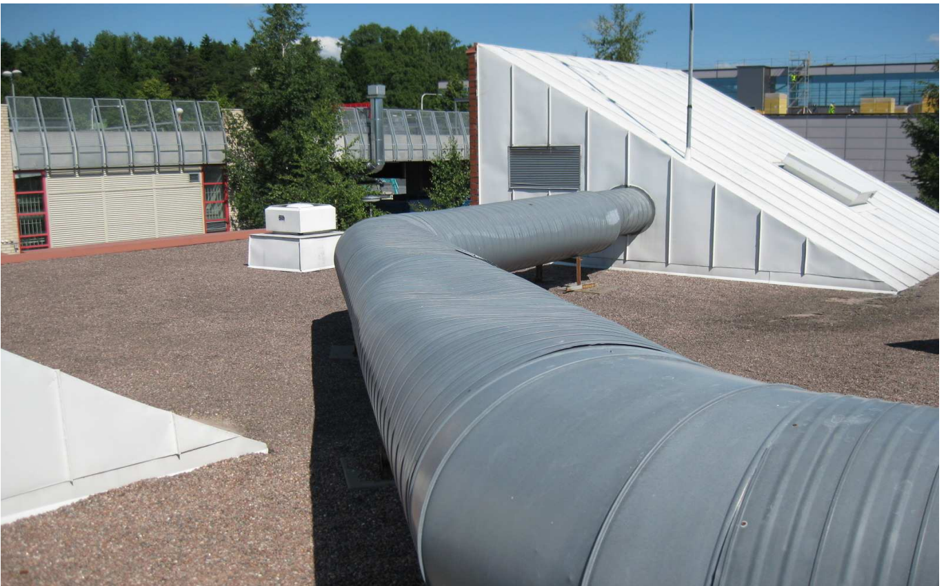
KUVA 14. Yleiskuva vesikatolla olevasta raitisilmakanavasta, joka on painunut kasaan (TP1).
