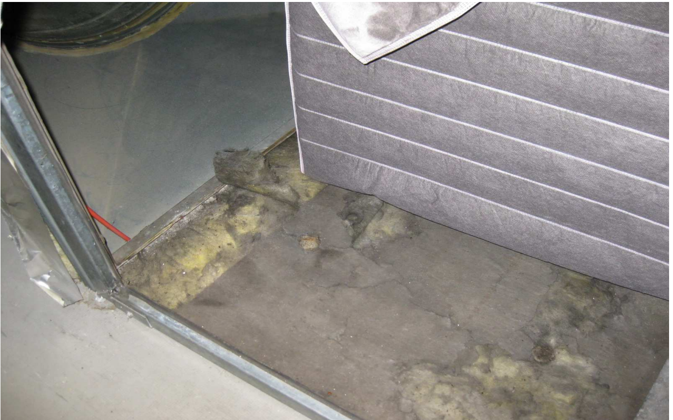
KUVA 6. Tuloilmakoneen kammiot on eristetty mineraalivillalla, joka on monin paikoin rikki.
