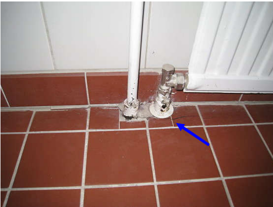
Kuva 9 Lattialaatoitus murtunut WC-/ PSH – tilassa 8.
