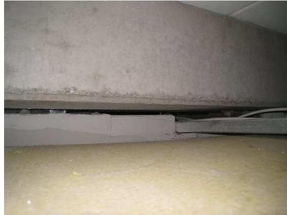
Kuva 18 Tiilimuurauksen ja betonipalkin välistä ilmayhteys eri tilojen välillä.
