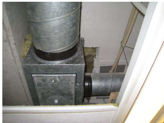
Kuva 34 Yläpohjassa oleviin läpivienteihin on sullottu mineraalivillaa.
