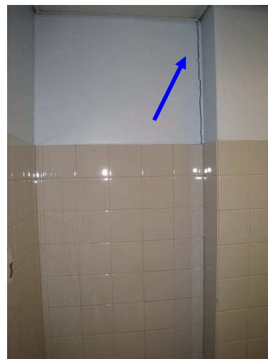
Kuva 16 WC-/ PSH –tilan seinässä halkeama. Seinälaatoituksessa ei vaurioita.
