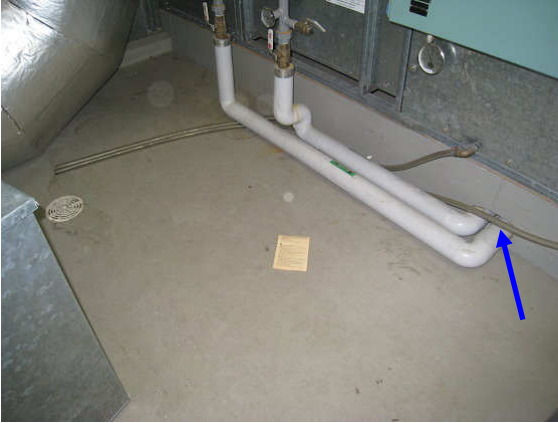
Kuva 35 IV-konehuoneen lattian rajassa tiivistämätön putkiläpivienti.
