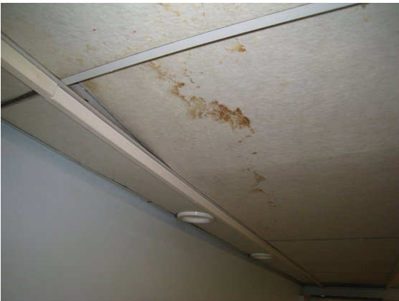
Kuva 27 Vesileikkitalan 25 kohdalla alakattolevyissä on vanhoja vesivuotojälkiä.
