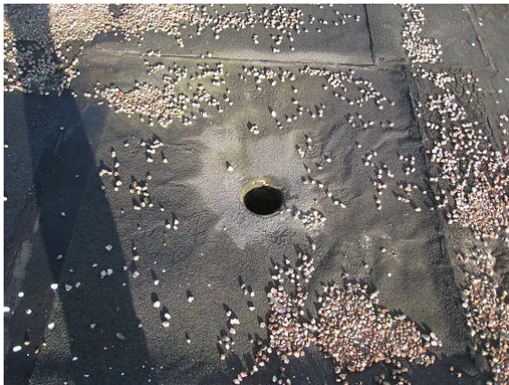
Kuva 3 Vesikatolla ei ole roskasihtejä. Viemäreihin pääsee singelisoraa ja kasvijätettä.
