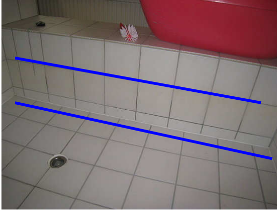
Kuva 11 Vesileikkitilan 9 laatoitetun altaan yhdellä sivustalla pintakosteus koholla.
