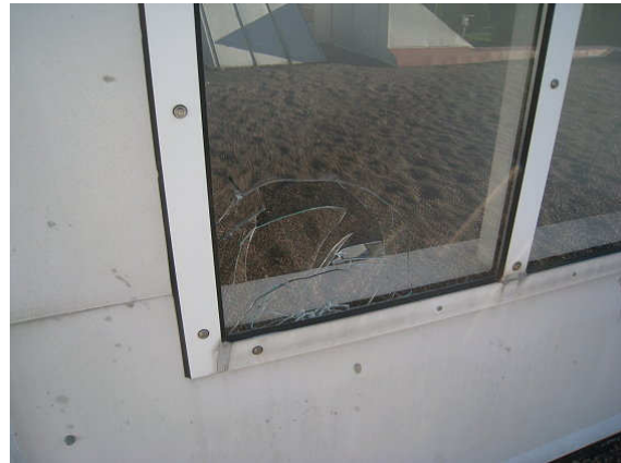
Kuva 38 Kattolyhdyssä olevan ikkunan rikottu lasi.
