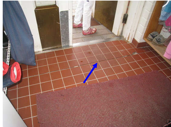
Kuva 14 Laatoitetussa lattiassa halkeama.
