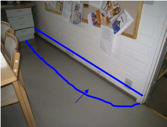
Kuva 19 Työh./ ruokailuh. 43. Väliseinän alaosalla ja lattiassa normaalista korkeampi pintakosteus.
