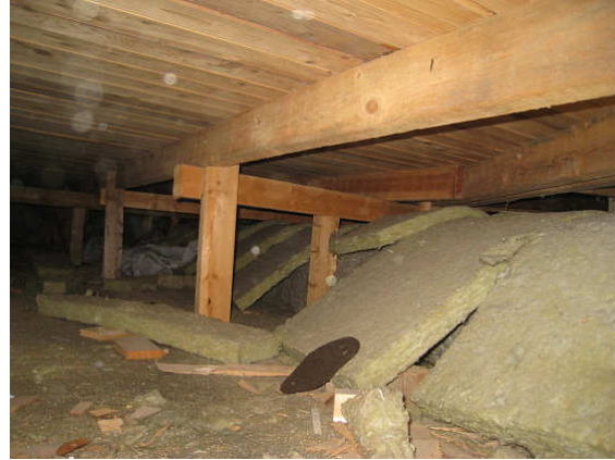
Kuva 24 Yläpohjatilan tuulettumista haittaavat sinne sijoitetut IV-kanavat eristeineen.
