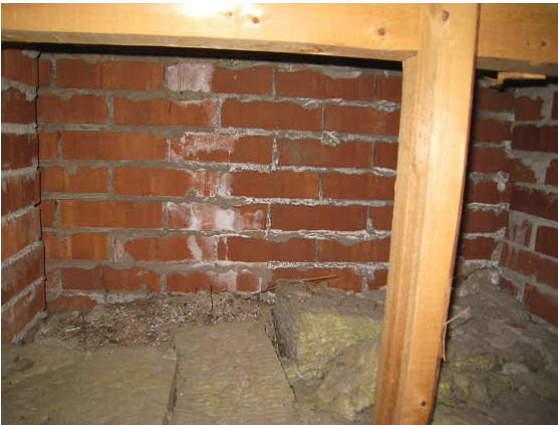
Kuva 43 Julkisivumuuraus kastunut läpi.
