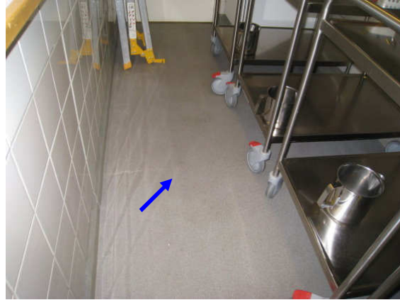
Kuva 12 Keittiön lattiassa on poikkisuuntainen halkeama.
