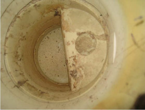
Kuva 41 Lattiakaivo kuiva. Rassaustulppa ei vaikuttanut tiiviiltä.
