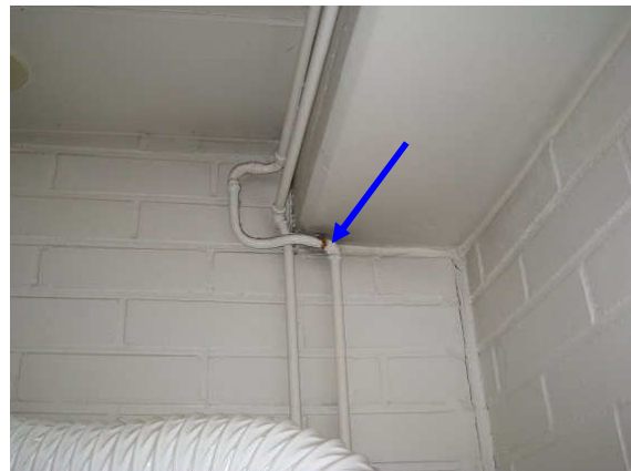
Kuva 40 Ruostevaurio putkien liitoksessa.
