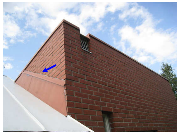
Kuva 22 Pellin ylösnoston tiivistys on epämääräinen.
