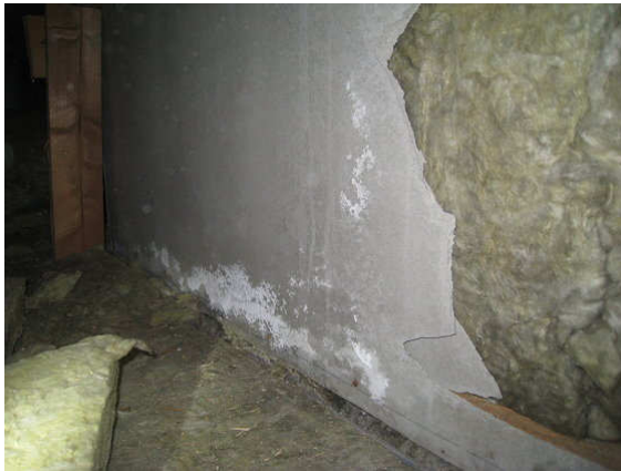
Kuva 31 Kattolyhdyin kohdalla yläpohjassa Luja-levyä, jossa yhdessä kosteuden aiheuttamia jälkiä.
