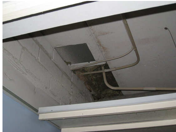
Kuva 26 WC-/ PSH –tilan 16 kohdalla vesivuotojälkiä läpiviennin kohdalla.
