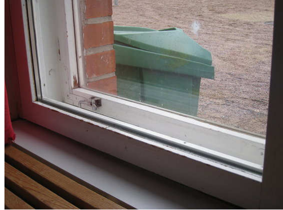
Kuva 36 Ikkunoiden puitteissa on maalivaurioita.
