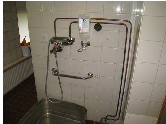
Kuva 10 Vesipisteen kohdalla seinässä useampia tiivistämättömiä porareikiä.
