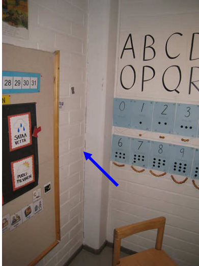
Kuva 17 Seinässä olevan halkeaman kohdalla ilmavuotojälkiä.
