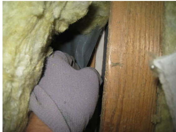
Kuva 32 Tutkitun kattolyhdyin kohdalla höyrynsulkumuovi ei ollut yhtenäinen.
