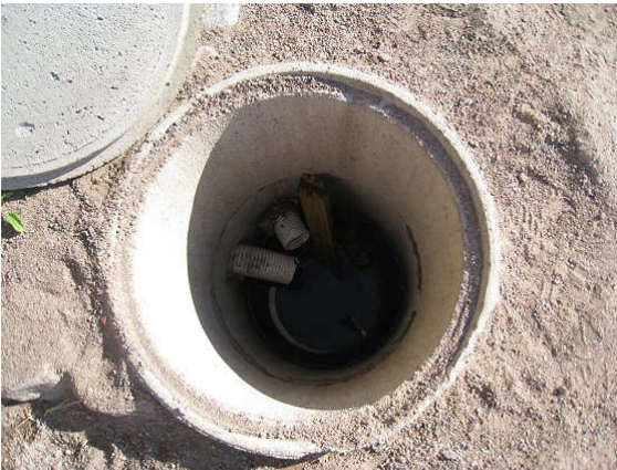
Kuva 7 Kaakon puoleisella sivustalla oleva salaojien tarkastuskaivo.
