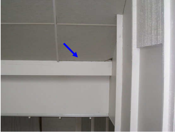
Kuva 29 Vesivuotojälki liikuntasalin 31 kohdalla vinon katto-osuuden alapäässä.
