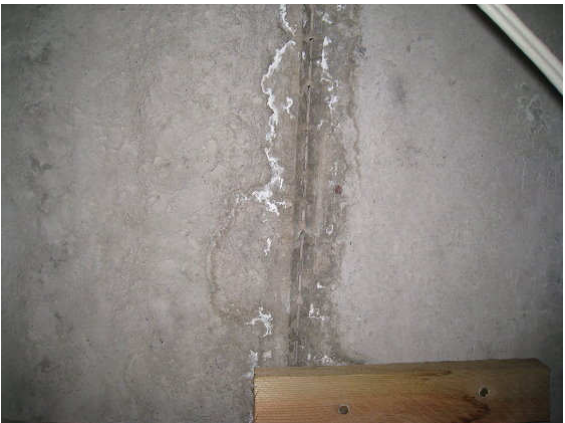
Kuva 28 Alakaton yläpuolella on ontelolaattojen sauma, jossa vanhoja vesivuotojälkiä.
