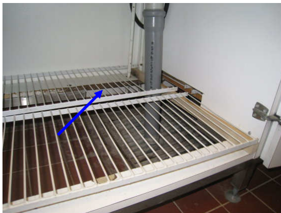
Kuva 15 Allaskaappien pohjalevyissä kosteuden aiheuttamia vaurioita. Alla lattia-kaivo.
