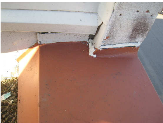
Kuva 21 Rästäspellityksien tiivistyksissä on puutteita.
