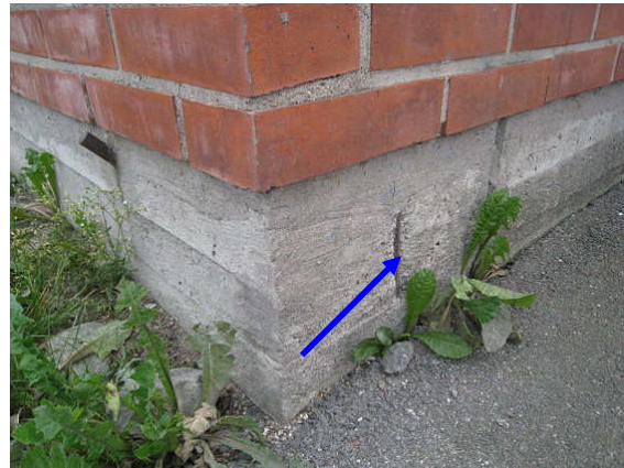
Kuva 8 Ruostunutta raudoitusta näkyvillä.
