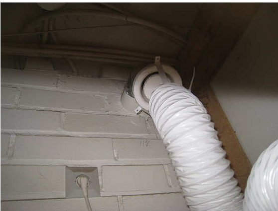
Kuva 39 Kuivauskaappien kosta ilma johdetaan poistoilmakanavaan.
