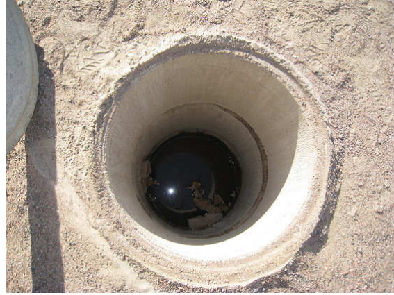
Kuva 6 Eteläkulman salaojien tarkastuskaivo.
