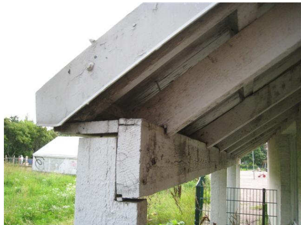
Kuva 26 Itäsivun katoksen palkki on irti "pilaritolpan" tuelta jonkin vääntymän tai perustusten liikkumisen takia.
