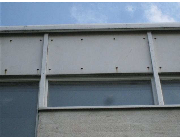
Kuva 11 Liikuntasalin yläosan levyverhouksen ruuvit/ naulat ovat ruosteessa.
