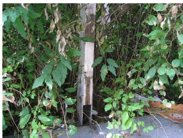
Kuva 24 Länsisivun katoksen "pilaritolpan" aliosa on kasvien sisällä piilossa.
