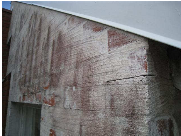
Kuva 21 Hyvin kulunut slammaus ja saumarako itäisivun eteläseinällä.
