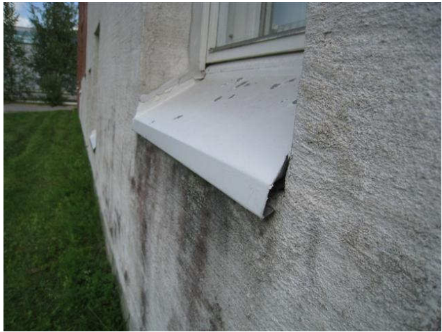
Kuva 20 Länsisivulla oleva lyhyeksi jäänyt ikkunan vesipellitys aiheuttaa värimuutosta
