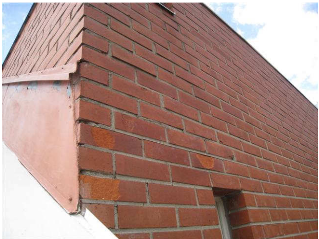
Kuva 18 Itäisivulla oleva juuripellitysvika ja tiilien pinnan lohkeamia.
