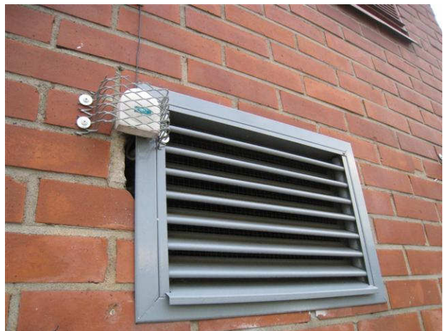
Kuva 16 LJH:n kohdalla säleikön liittymä seinään ei ole tiivis.
