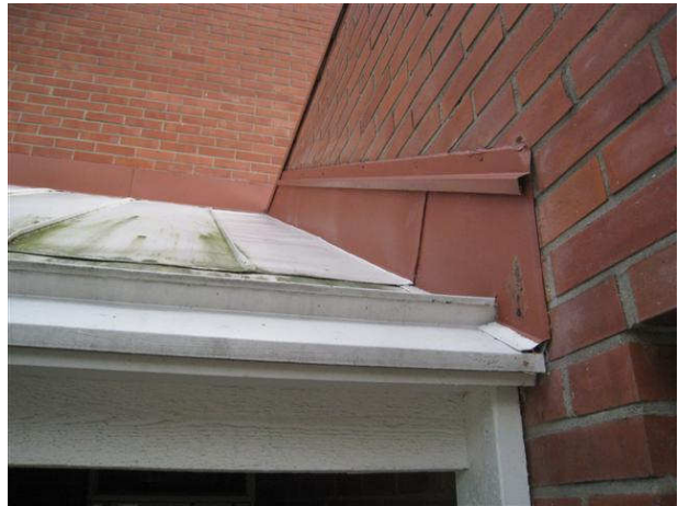
Kuva 14 Keittiön sisäänkäyntikatoksen juurinos- ton tiiveys on kitin varassa.
