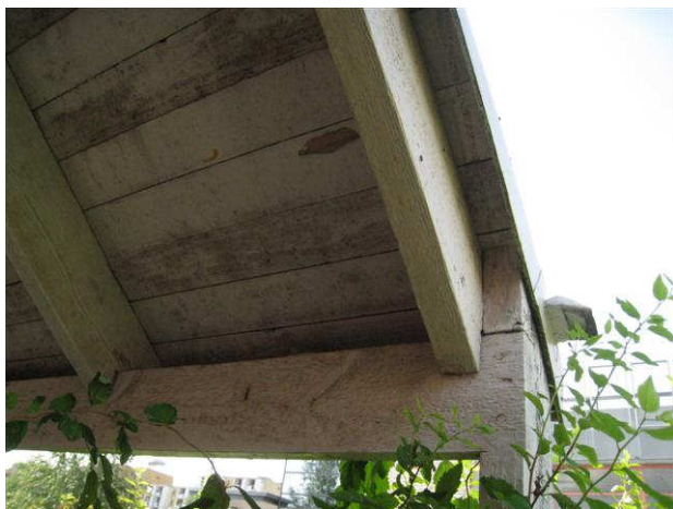
Kuva 23 Länsisivun katoksen aluslaudoitus on homeessa.
