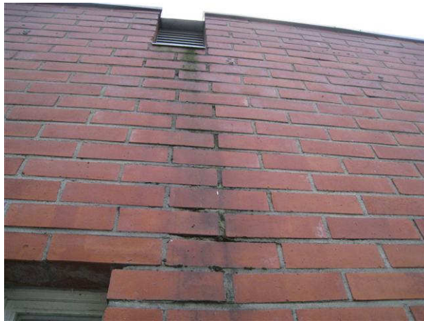
Kuva 9 Julkisivua rasittaa yläpohjan tuuletusaukkojen pellitysten viat.
