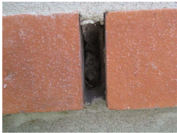
Kuva 8 Tiilimuurauksen pystyrako, joka on ummessa. Muurauksen takana ei ole tuuletusväliä, joten saumoilla ei ole väliä.
