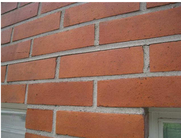
Kuva 17 Vaakasuuntaisia tiilimuurauksen ja saumojen välisiä rakoja/ halkeamia Itäisivulla.
