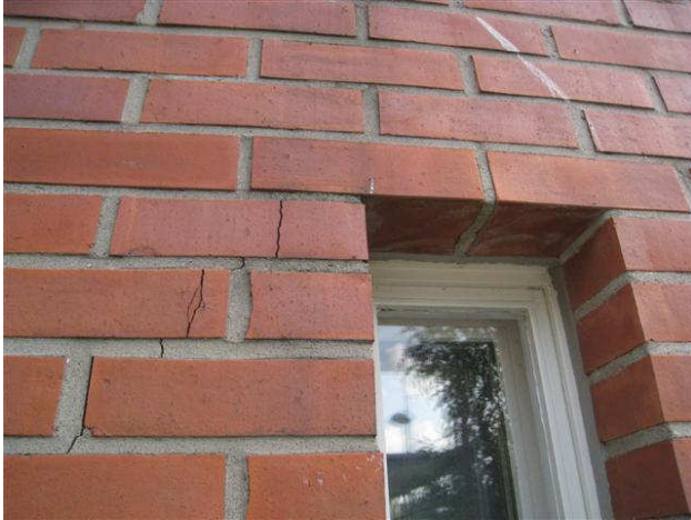
Kuva 13 Tiilimuurauksen porrasmainen halkeilu länsisivulla.
