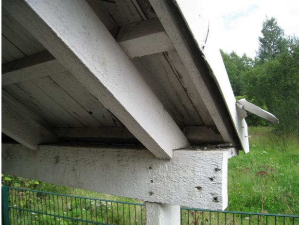
Kuva 25 Itäsivun katoksen rakenteissa on hyllyjä, jotka kastuvat viistosateella.
