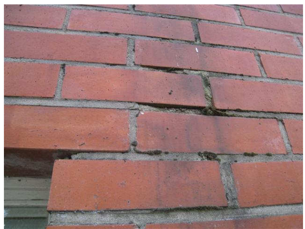
Kuva 10 Pellityksen päältä valunut vesi kuluttaa saumoja ja aiheuttaa sammalkasvua.
